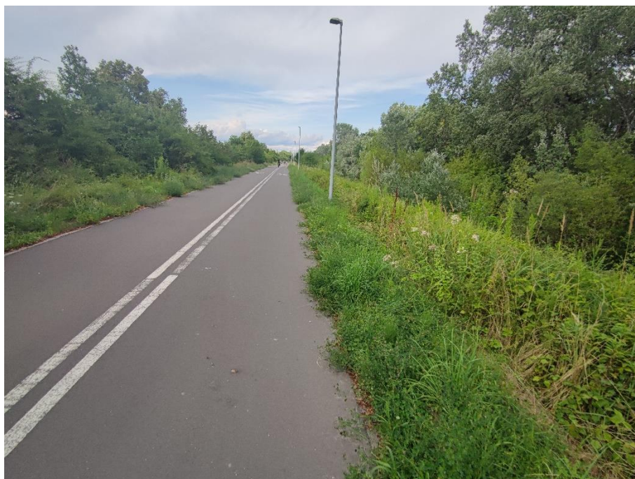
Fot.2. Widok na wał w km 1+300. Widoczne krzewy i drzewa na skarpach wału.
