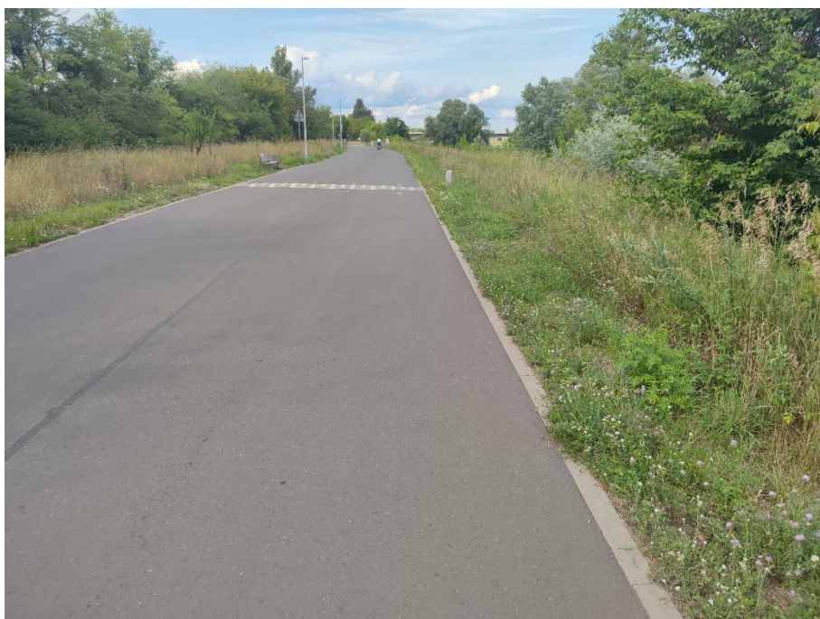
Fot.12. Widok na skarpy oraz koronę wału w km 0+200. Widoczne krzewy i drzewa na skarpach wału.
