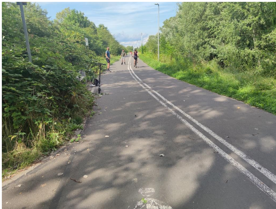
Fot.1. Widok na wał w km 1+370 - koniec wału. Widoczne krzewy i drzewa na skarpach wału.
