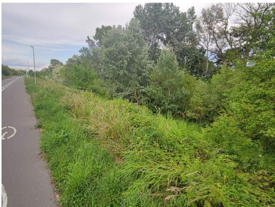
Fot.4. Widok na skarpe odwodną i koronę wału w km 1+100. Widoczne krzewy i drzewa na skarpie wału.
