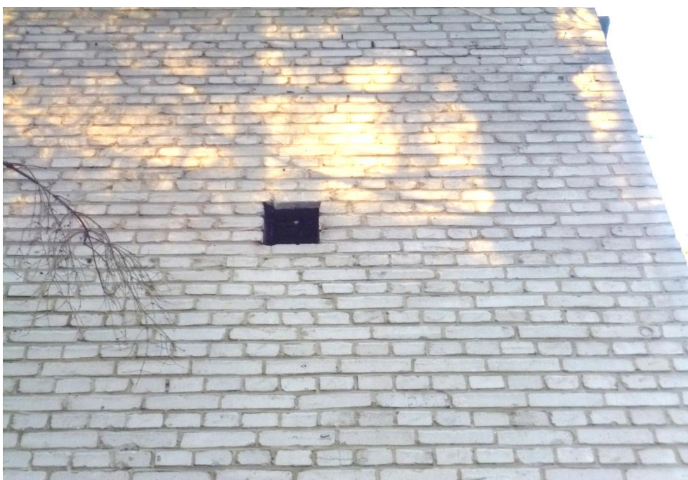
Foto.15. Niezabezpieczony otwór wentylacyjny wschodniego szczytu sali gimnastycznej. Fot. Przemysław Kubacki.
