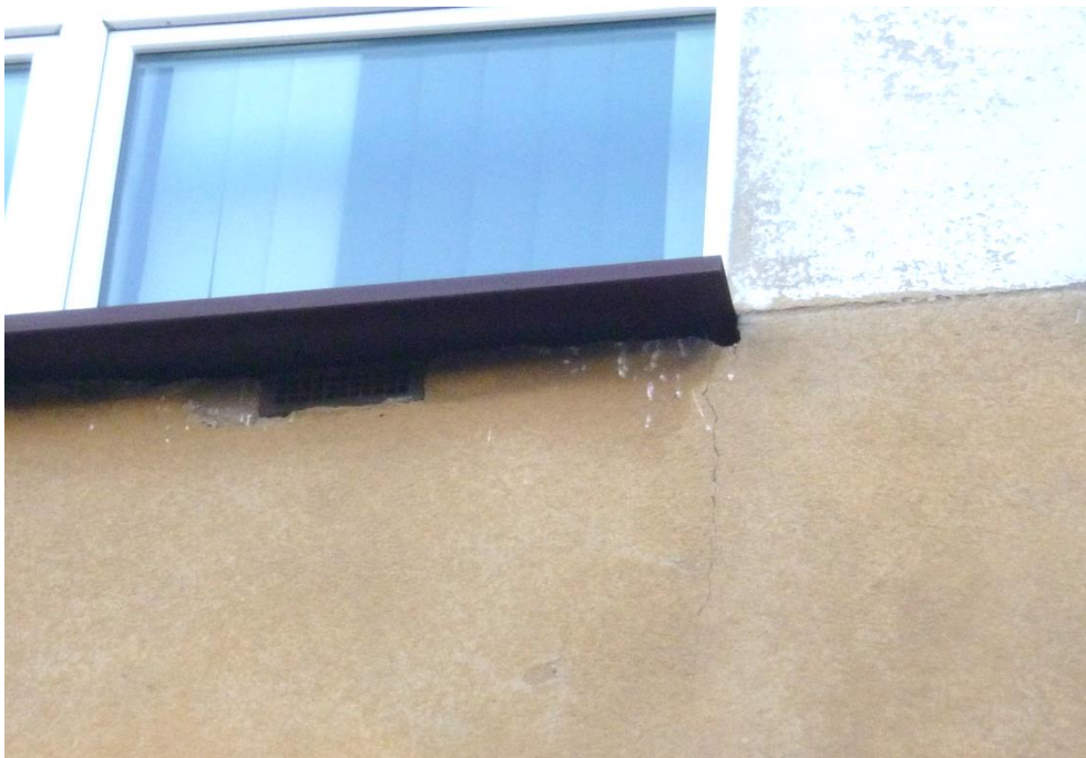
Foto.6. Siedlisko wróbla, pod parapetem okiennym zachodniej ściany budynku „A”, z zabrudzoną odchodami ścianą. Fot. Przemysław Kubacki.
