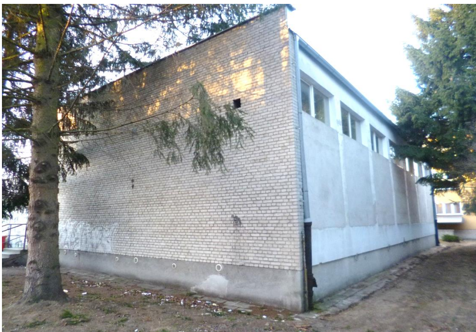
Foto.14. Wschodni szczyt sali gimnastycznej z niezabezpieczonym otworem wentylacyjnym. Fot. Przemysław Kubacki.
