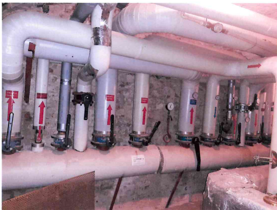
Widok na układy rozdzielacze w pomieszczeniu rozdzielaczy w piwnicy budynku A
