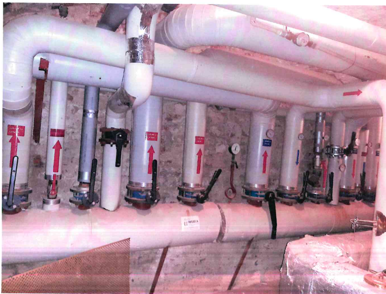
Rys. nr 2 – zdjęcie pomieszczenia rozdzielaczy w piwnicy w budynku A
