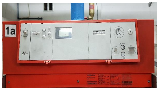
rys. 4 tablica kotła wyposażona w regulator stałotemperaturowy.
