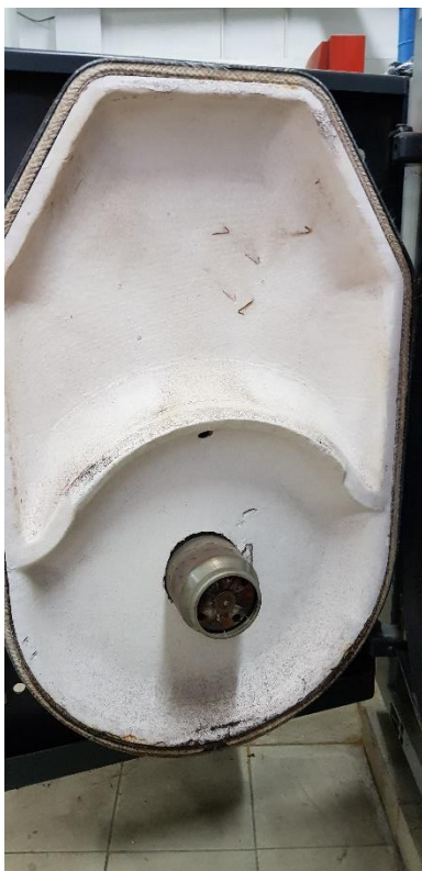
rys. 16 izolacja termiczna drzwi kotła jest w całości, brak śladów pęknięć czy odkształceń termicznych w stanie bardzo dobrym.
