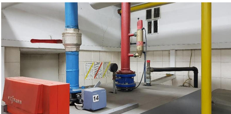
rys. 2 wyposażenie kotła. Na kotle zamontowane są: zawory odcinające, zasuwą regulacyjną z napędem, kontrola poziomu wody AFRISO, zawór bezpieczeństwa i manometr kontrolny. Wszystkie urządzenia sprawne.
