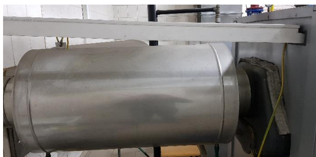
rys. 5 układ spalinowy wyposażony w tłumik dźwięku zamontowany w czopuchu kotła.
