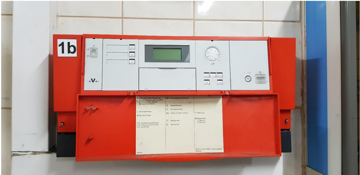
rys. 18 regulator kompletny i sprawny technicznie z kompletem czujników rozmieszczonych na obiekcie.
