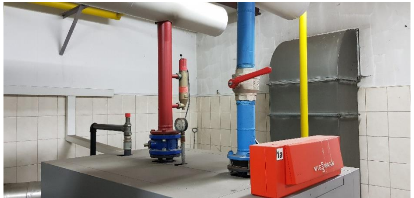
rys. 11 wyposażenie kotła. Na kotle zamontowane są: zawory odcinające, zasuwę regulacyjną z napędem, kontrola poziomu wody AFRISO, zawór bezpieczeństwa i manometr kontrolny. Wszystkie urządzenia sprawne.
