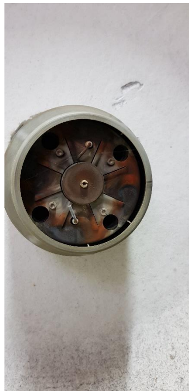
rys. 17 rura palnika i tarcza spiętrzająca posiada ślady pracy, natomiast brak pęknięć czy odkształceń termicznych.
