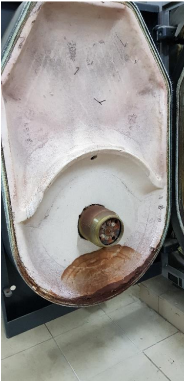
rys. 8 izolacja termiczna drzwi kotła jest w całości, brak śladów pęknięć czy odkształceń termicznych. Do wymiany ewentualnie sznur uszczelniający.
