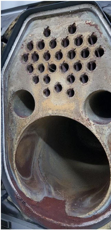
rys. 6 komora spalania kotła posiada komplet zawirowywaczy spalin. Powierzchnie wymiany ciepła są pełne i nie widać śladów odkształceń termicznych ani śladów nieszczelności. Niewielkie osady pozostałości spalania są do wyczyszczenia.
