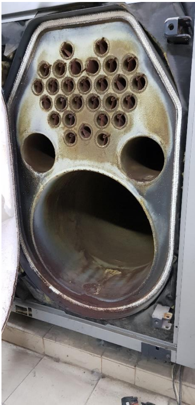
rys. 14 komora spalania kotła posiada komplet zawirowywaczy spalin. Powierzchnie wymiany ciepła są pełne i nie widać śladów odkształceń termicznych ani śladów nieszczelności. Niewielkie osady pozostałości spalania są do wyczyszczenia.
