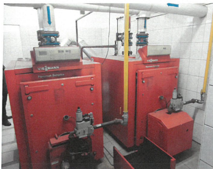
Fot. 1. Istniejące kotły firmy Viessmann.
