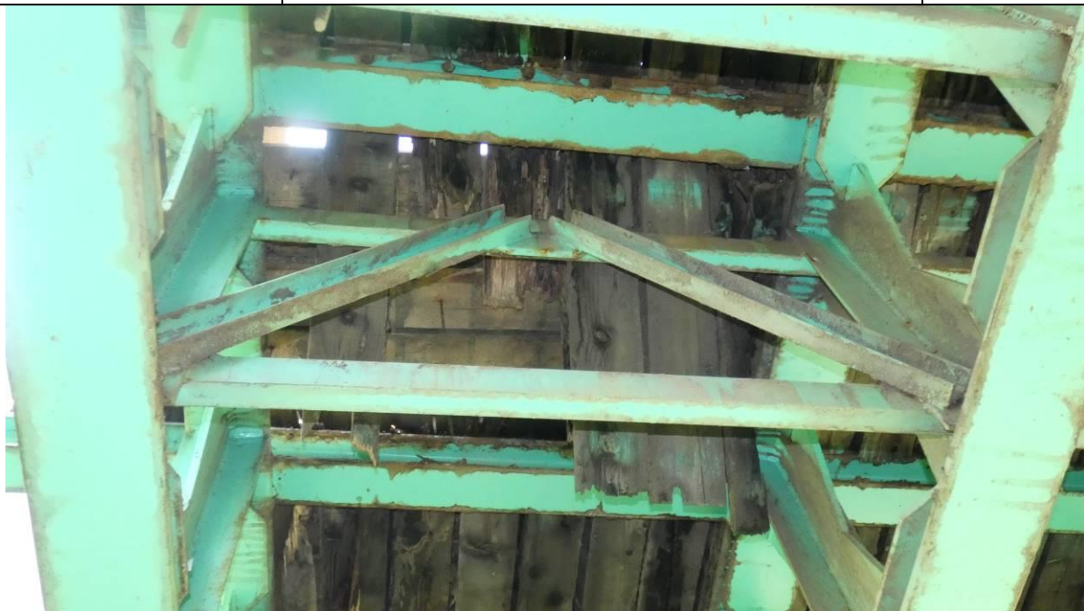
Fot. 5. Uszkodzenie dyliny obiektu
