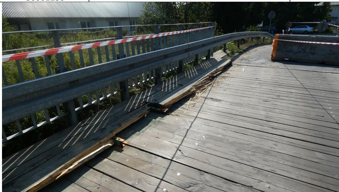
Fot. 3. Ubytki dyliny drewnianej
