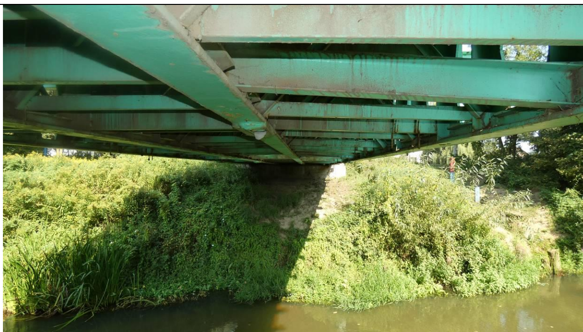
Fot. 4. Deformacje konstrukcji stalowej
