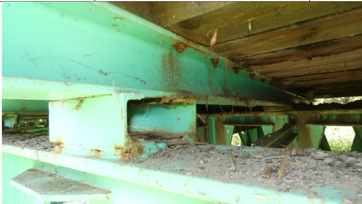
Fot. 7. Zanieczyszczenia konstrukcji stalowej
