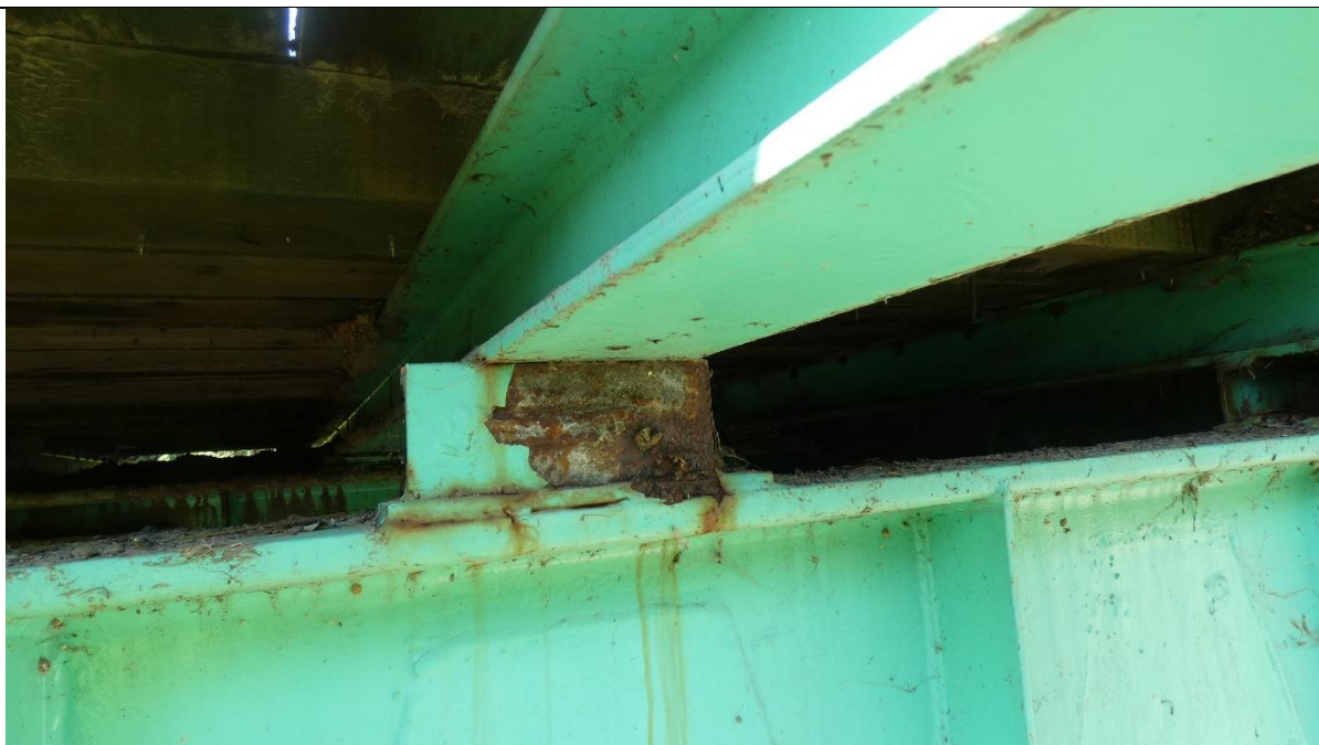
Fot. 6. Ogniska korozji konstrukcji stalowej
