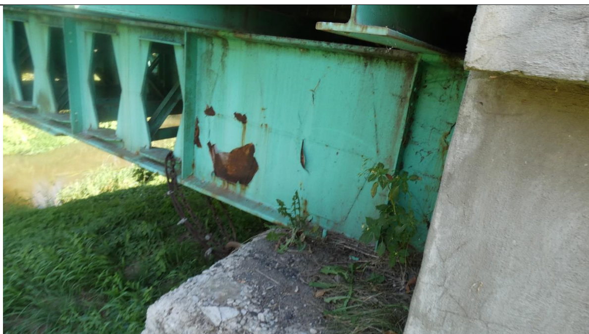
Fot. 10. Zanieczyszczenia ławy podłożyskowej
