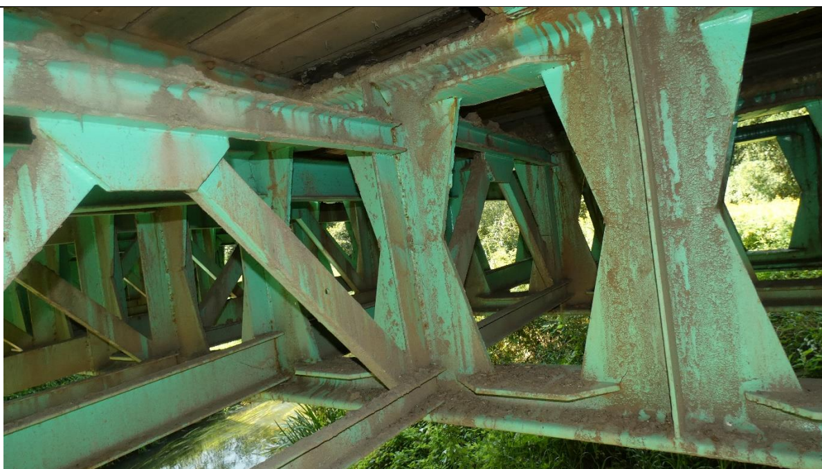
Fot. 8. Zanieczyszczenia konstrukcji stalowej
