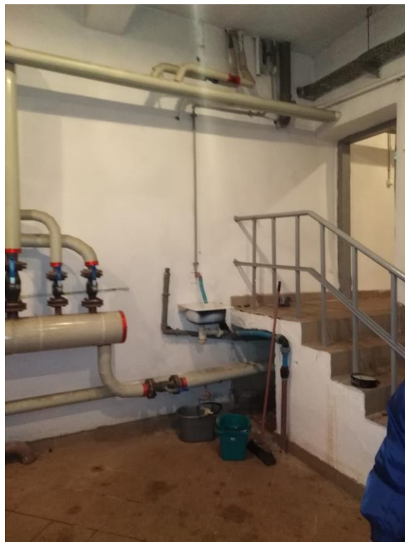
Fot. nr 6 węzeł cieplny
