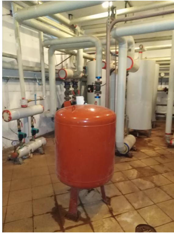
Fot. nr 5 węzeł cieplny
