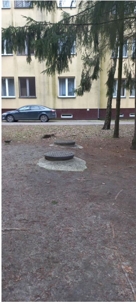
Fot. nr 9 komora ciepłownicza
