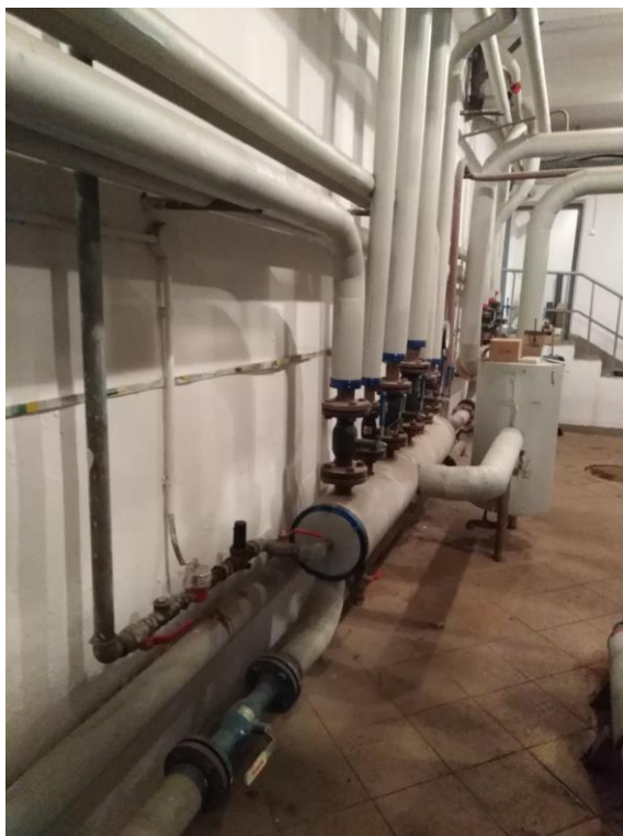
Fot. nr 7 węzeł cieplny
