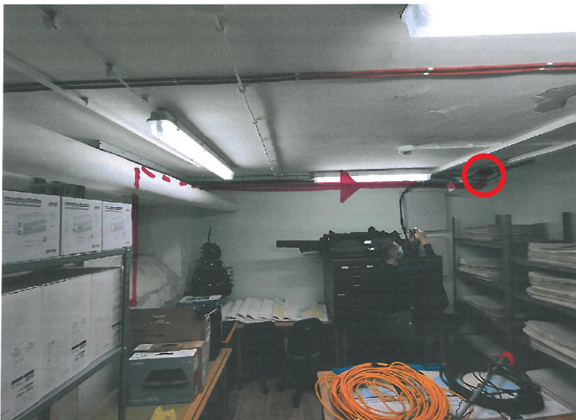
Rys. 2. Budynek 10. Czerwoną linią oznaczono trasę układania kabli. Czerwonym kółkiem oznaczono miejsce wprowadzenia kabli przez strop do istniejącej serwerowni.
