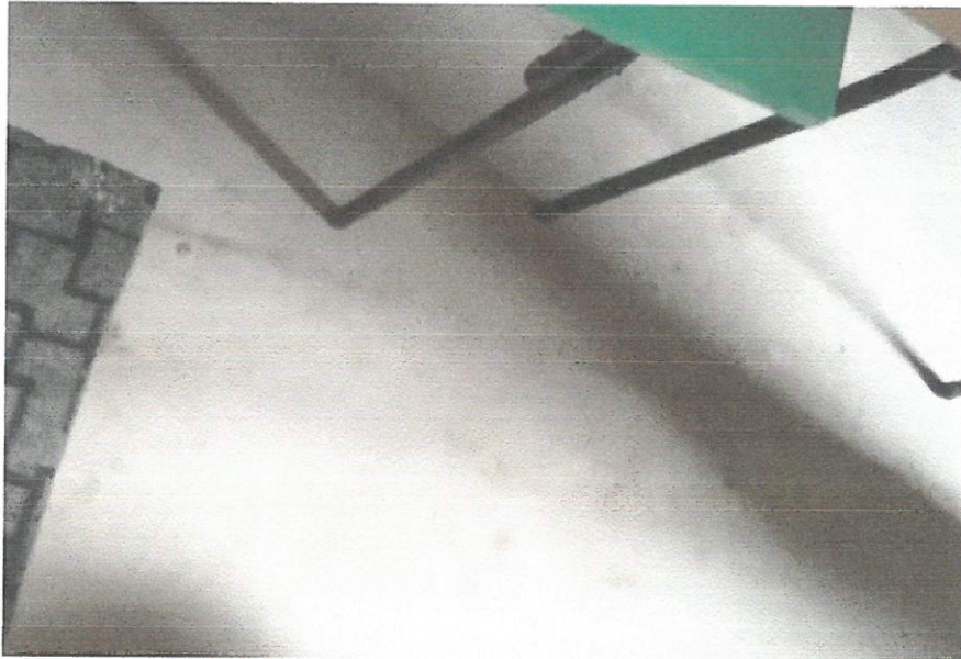
Rys. 2 Widok na posadzkę w pomieszczeniu oznaczonym jako M4
