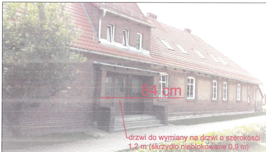
Fot. nr 1 - Widok drzwi Dz1 do wymiany
