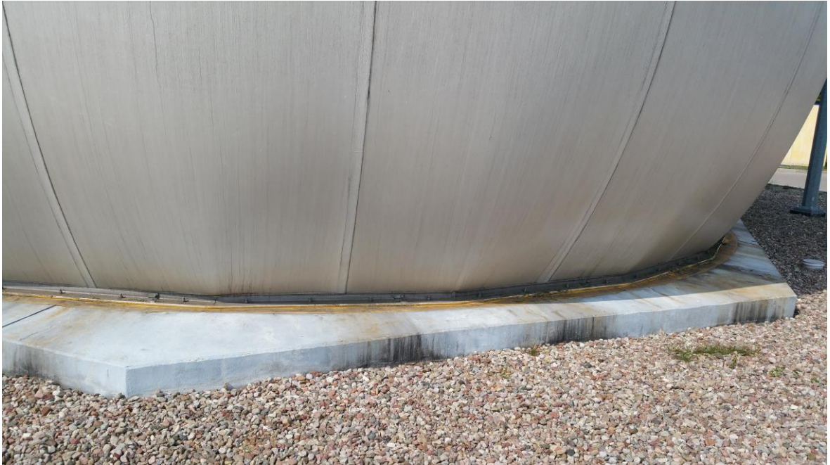
Fot. nr19 – Zbiornik biogazu OB.28
