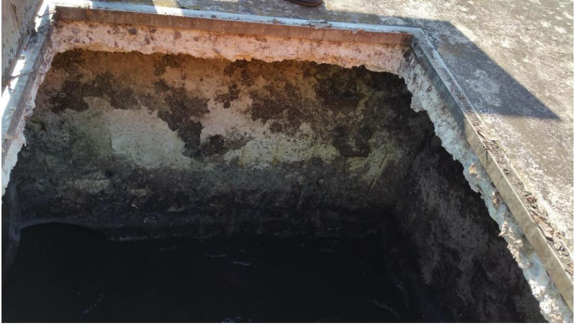
Fot. Nr9 – Komora wlotowa Ob. nr 2 korozja wnętrza
