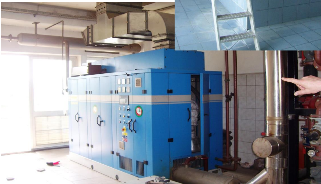
Fot. Nr26 – Pomieszczenie / Hala Agregatorni OB.26.1
