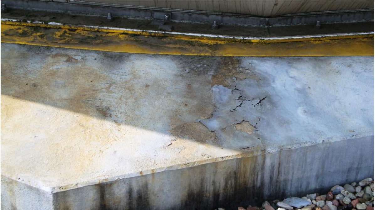
Fot. Nr20 – Zbiornik biogazu OB.28 uszkodzenie powłoki
