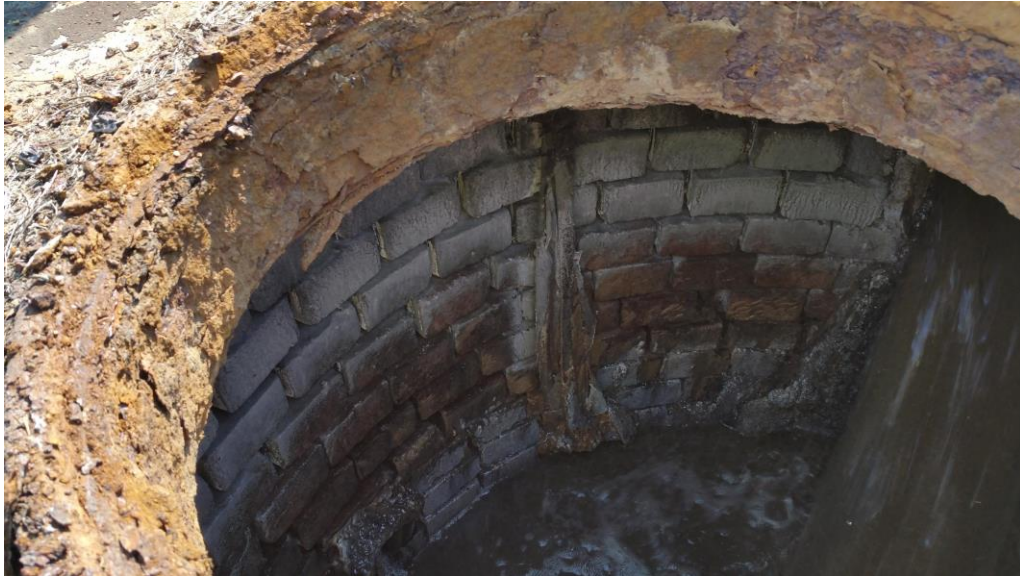
Fot. nr 2 – Studzienka średnicy 1200- dopływ z pompowni Gdańska
