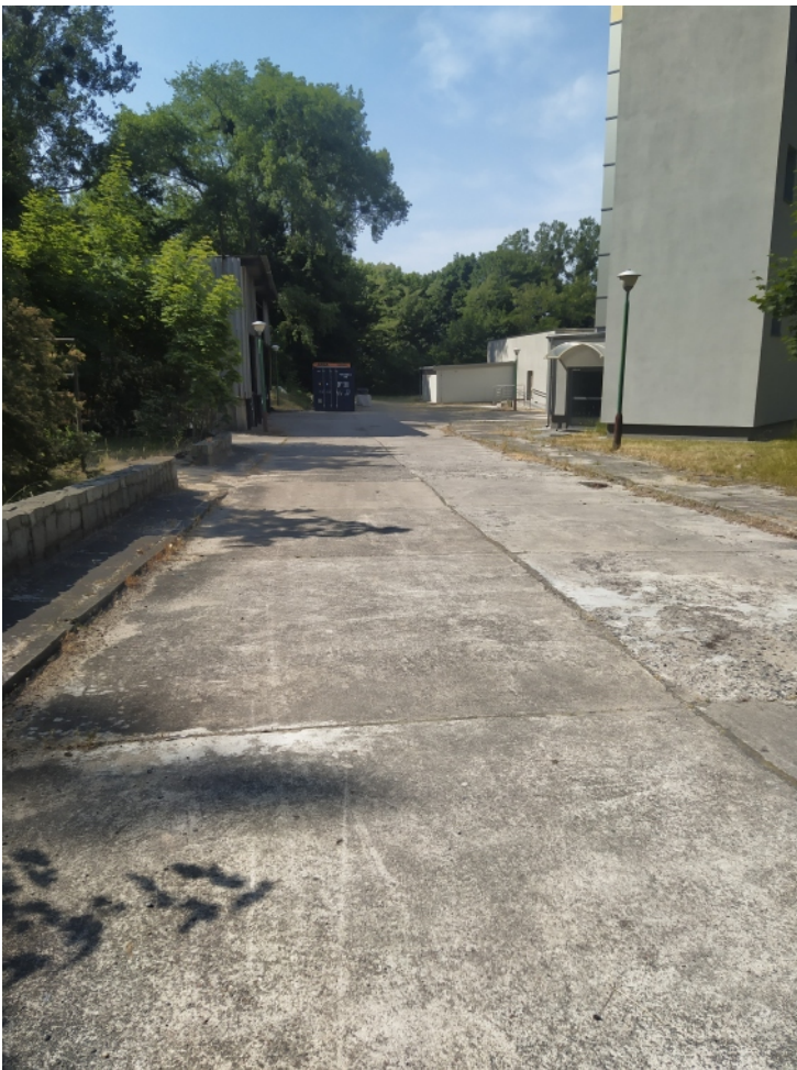
9.Nawierzchnia ist. betonowa drogi do remontu
