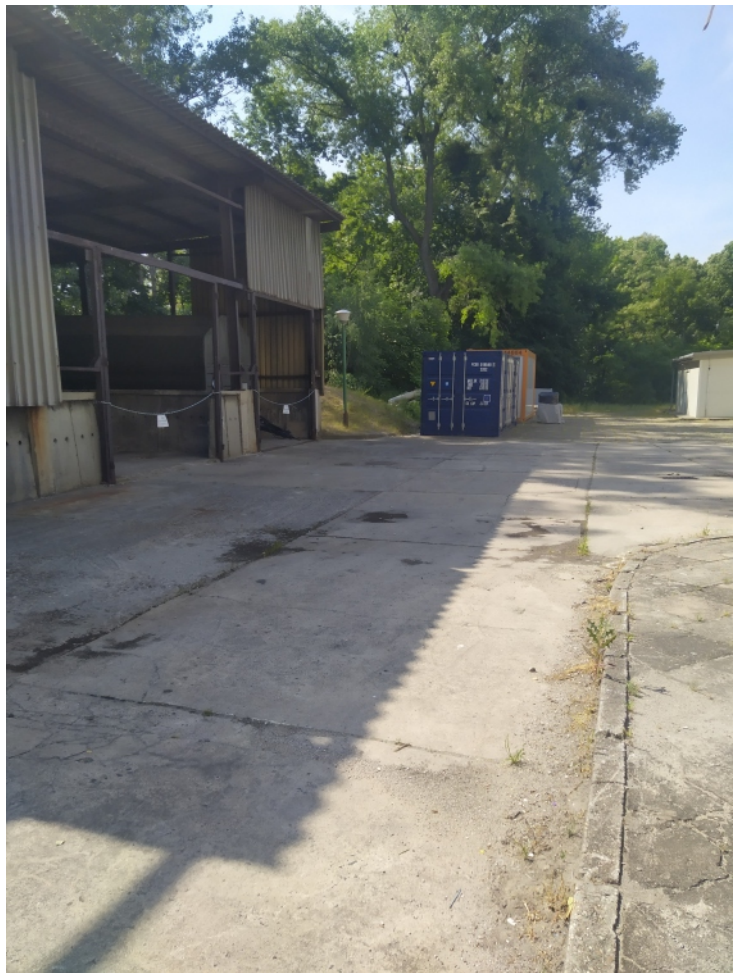
10.Nawierzchnia ist. betonowa drogi do remontu
