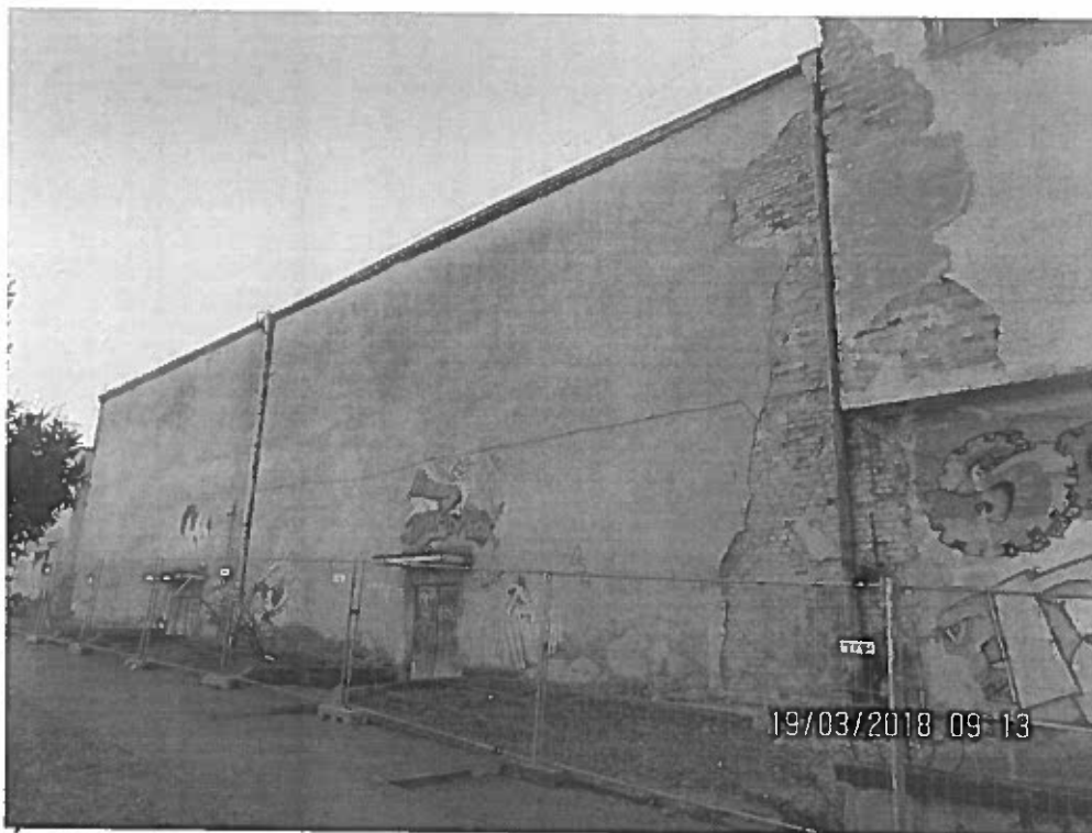
Zdjęcie nr 9. Widok elewacji bocznej – zły stan techniczny tynków
