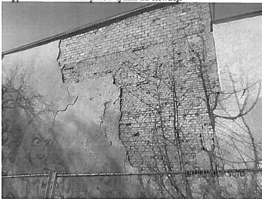
Zdjęcie nr 3. Widok ubytków tynku na elewacji
