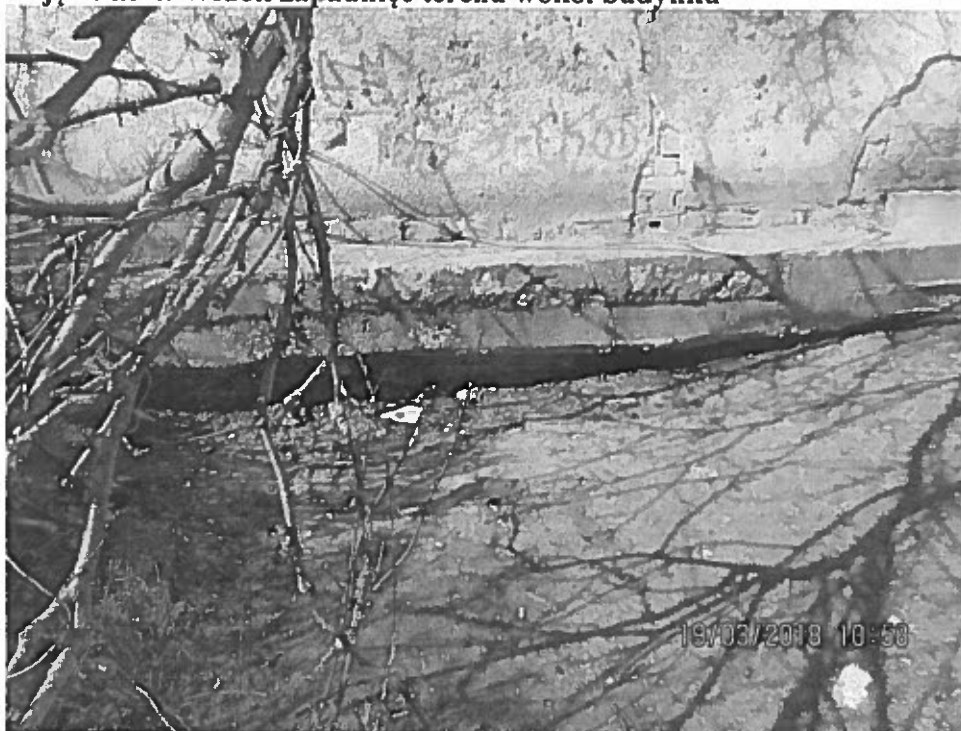
Zdjęcie nr 4. Widok zapadnięć terenu wokół budynku
