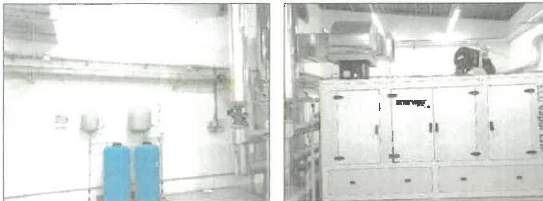
Rysunek 26. Wnętrze siłowni biogazowej.
