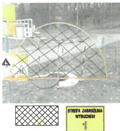
Rysunek 23. Zabezpieczenie wodne w pobliżu węzła rozdzielczego.
