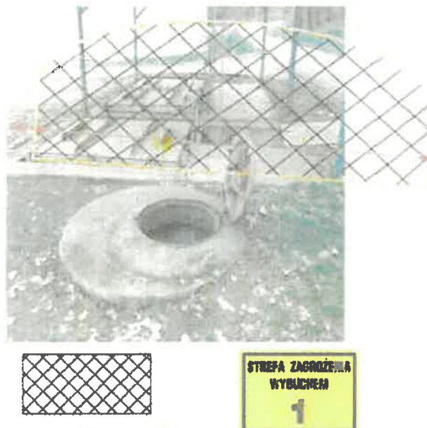
Rysunek 19. Komora z rurowciągami biogazu.
