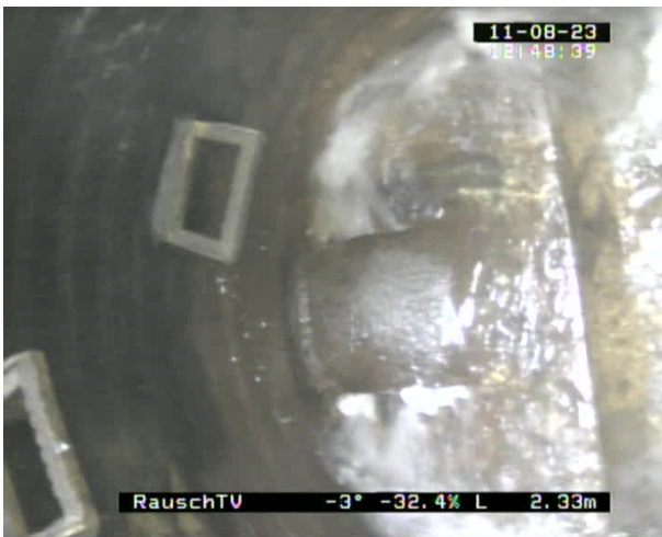
2.32 m - [BR--] pęknięcie rury, zawal kanału, pęknięcie, cała rura
