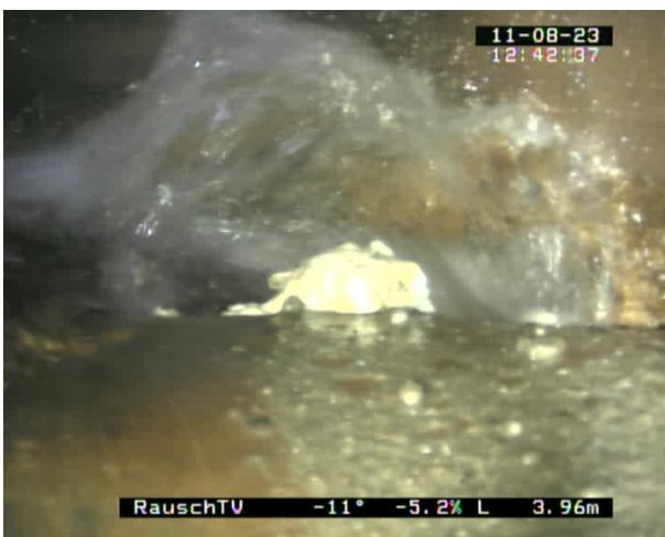
3.96 m - [CMEL] korozja, zaprawa do spoin, infiltracja, z lewej
