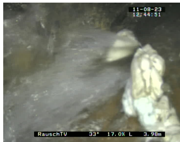
3.98 m - [CC-U] korozja, złącze rur, w dnie
