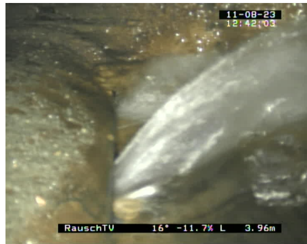
3.96 m - [CMEU] korozja, zaprawa do spoin, infiltracja, w dnie
