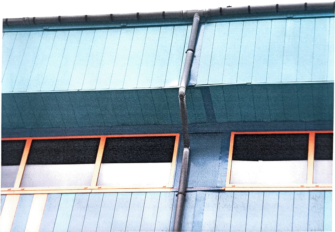
Fot. 2 Odształcenia blach poszycia w rejonie dylatacji – elewacja południowa.
