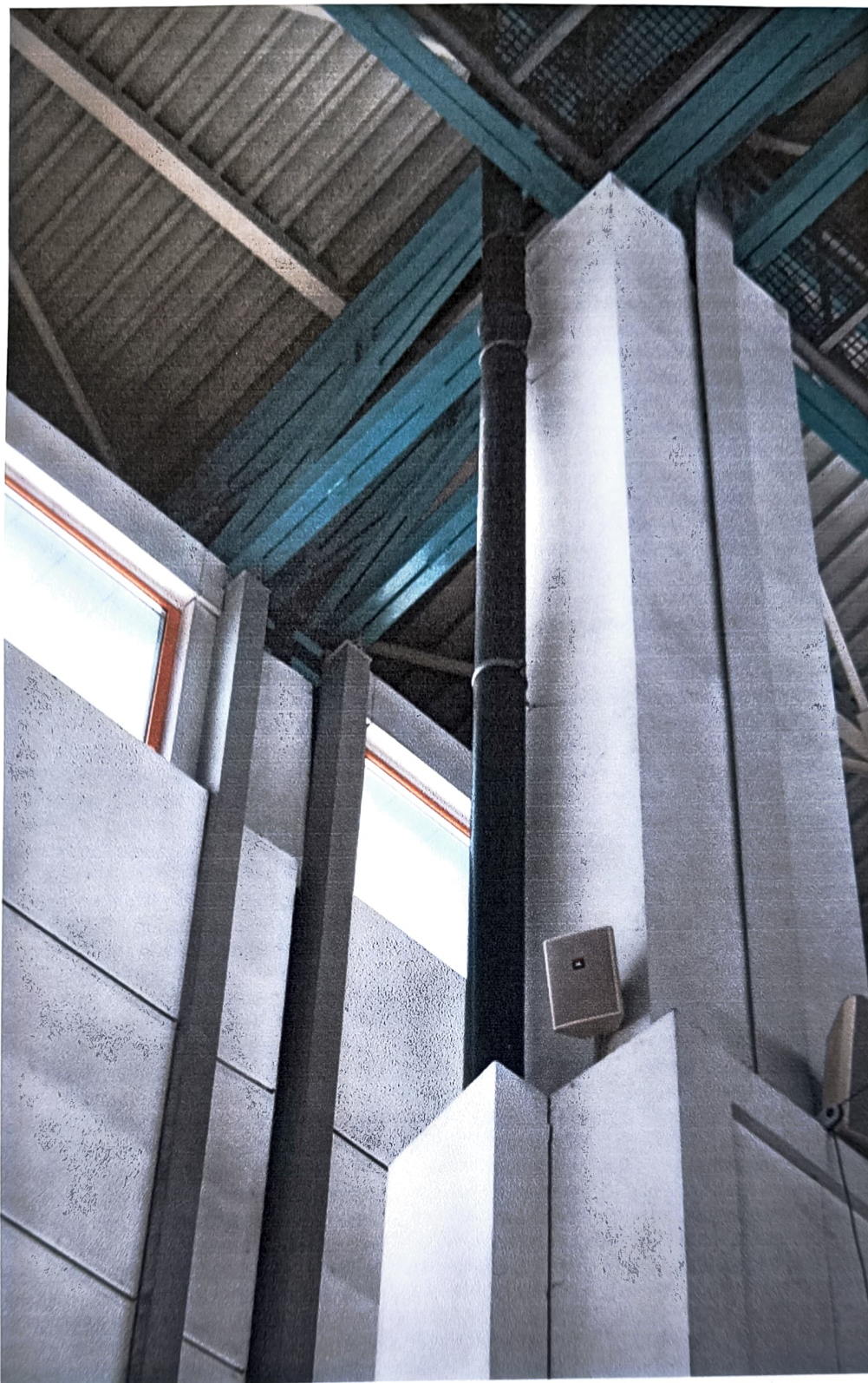
Fot. 5 zajemne przemieszczenia słupów głównej konstrukcji nośnej i obudowy przy dylatacji w ścianie południowej.
