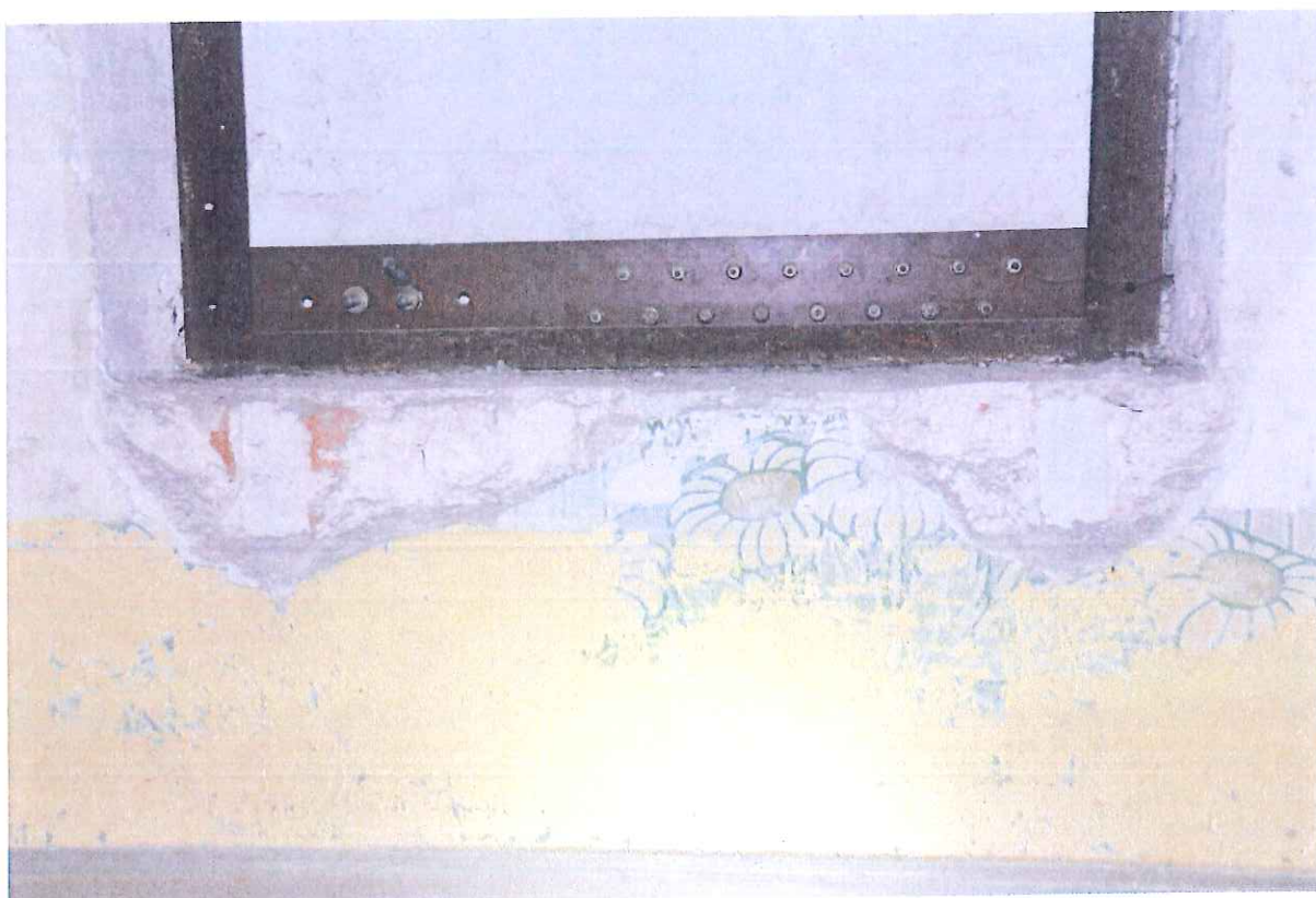
Fot. 27. Piętro I. Zniszczenia polichromii powstałe w wyniku wyrwania elementów metalowych ze ściany.
