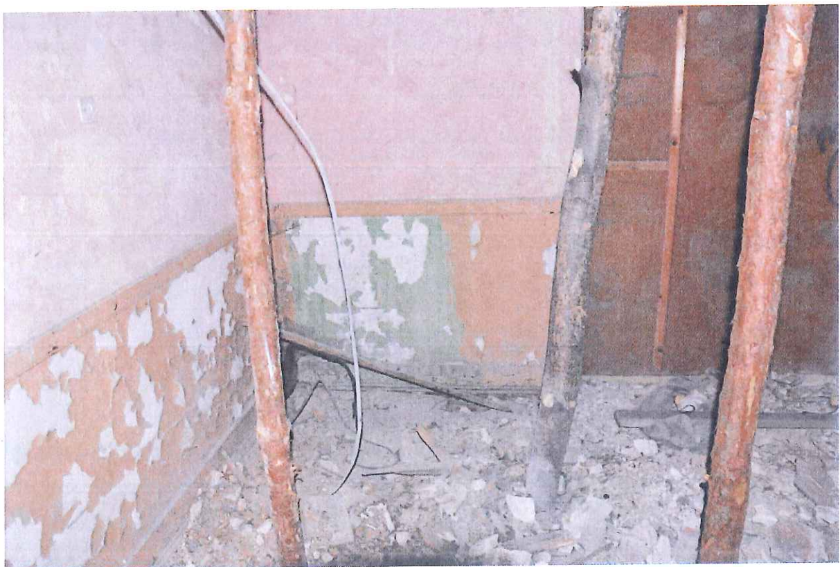
Fot. 39. Piętro II. Zniszczenia polichromii spowodowane przez zawilgocenie wnętrza. Widoczne spękania i odspojenia warstwy malarskiej.
