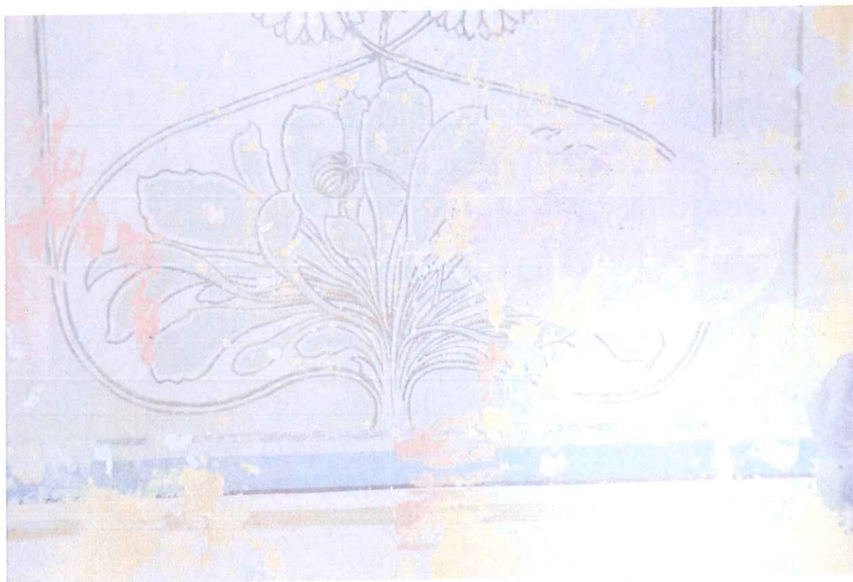
Fot. 25. Piętro I. Zniszczenia polichromii w miejscu wykonanej odkrywki spowodowane przez zawilgocenie wnętrza.
