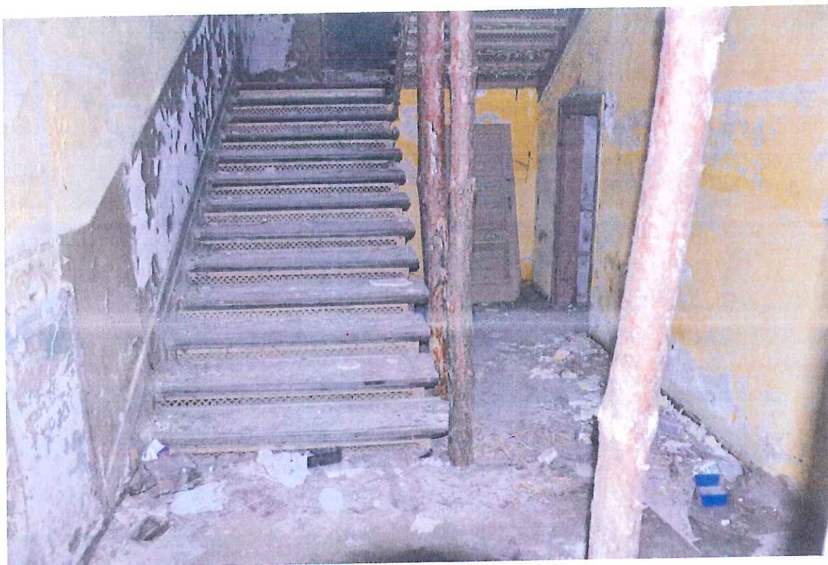
Fot. 6. Parter. Widok na klatkę schodową. Widoczne zniszczenia warstwy malarskiej spowodowane przez wodę podciąganą kapilarnie z gruntu.
