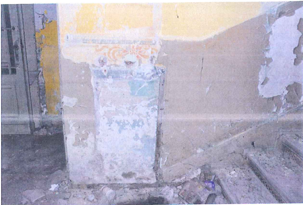
Fot. 10. Parter. Widoczne zniszczenia warstwy malarskiej spowodowane przez wodę podciąganą kapilarnie z gruntu.
