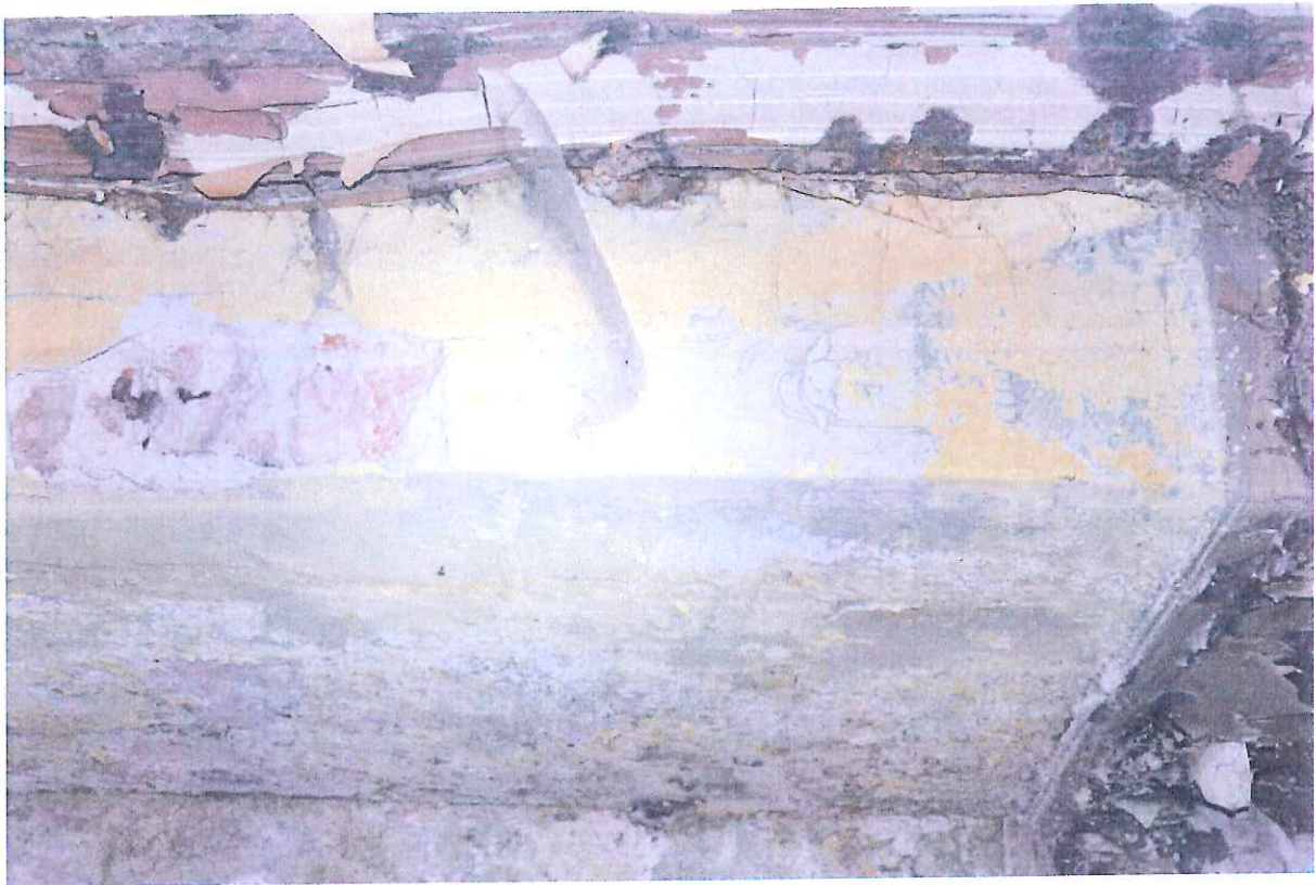
Fot. 18. Piętro I. Widoczne zalanie ściany przez wody opadowe. Na powierzchni widoczny wzrost grzybów pleśniowych.
