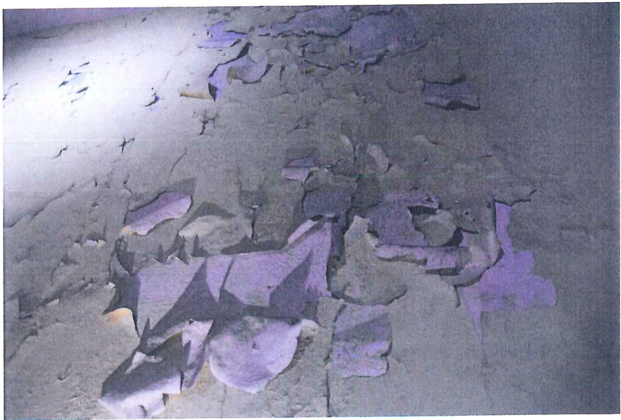
Fot. 23. Piętro I. Zniszczenia polichromii spowodowane przez wody opadowe.
