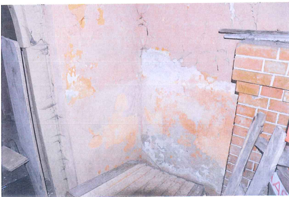
Fot. 11. Parter. Widoczne zniszczenia warstwy malarskiej spowodowane przez wodę podciąganą kapilarnie z gruntu.
