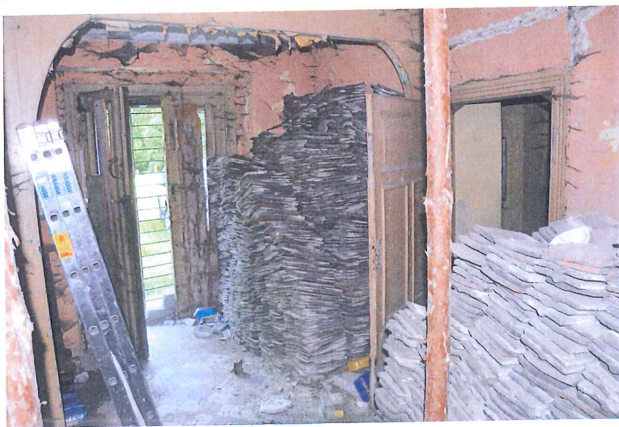
Fot. 7. Parter. Widok na wejście główne. Dachówki oparte o niezabezpieczoną ścianę.
