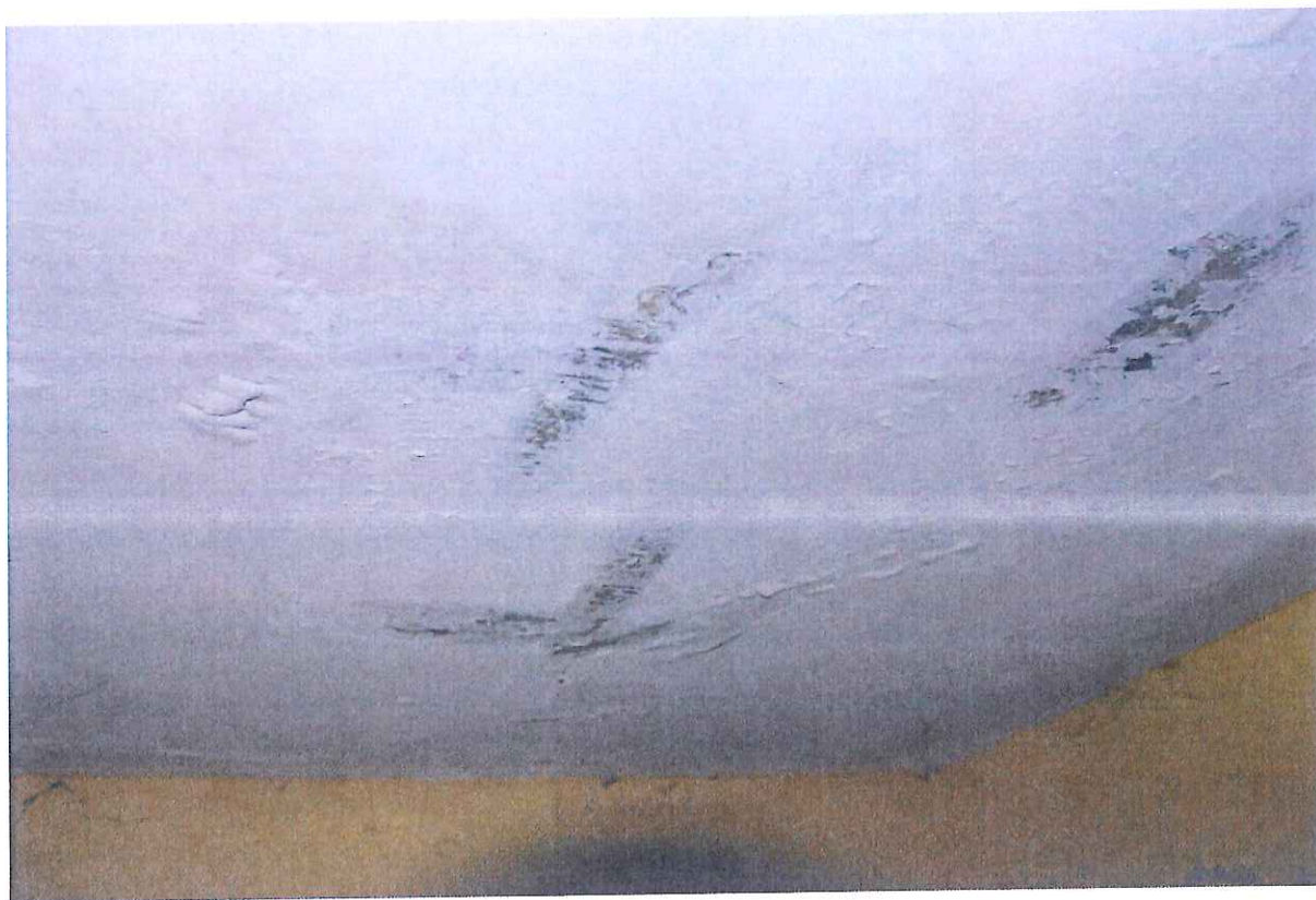
Fot. 30. Piętro I sufit. Odkrytki w narożnikach holu głównego. Widoczne odspojenia warstwy malarskiej.
