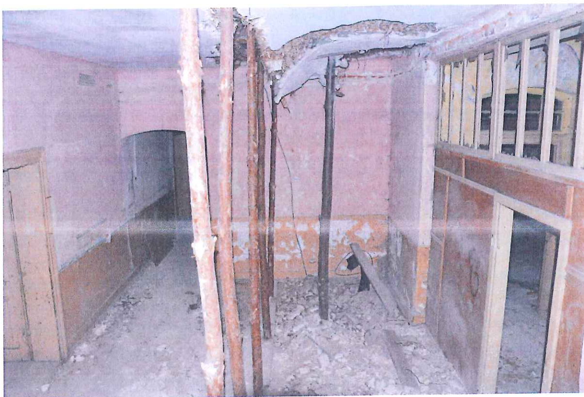
Fot. 2. Hol na II piętrze. Stan z 2016 roku. Widoczne ubytki warstwy malarskiej na ścianach.
