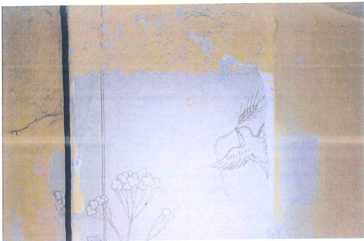
Fot. 4. Hol na I piętrze. Stan z 2016 roku. Widoczne spękania i odspojenia warstwy malarskiej.
