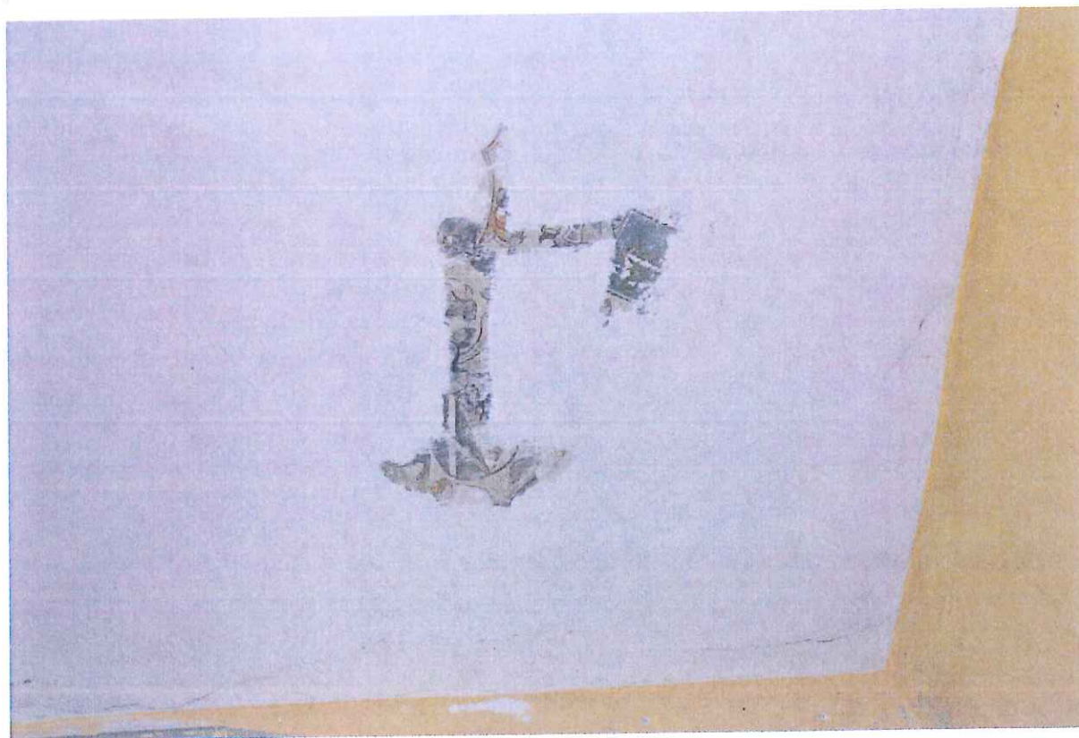
Fot.31. Piętro I sufit. Odkrytki w narożnikach holu głównego. Widoczne odspojenia warstwy malarskiej.
