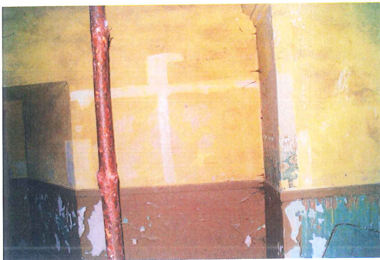
Fot. 5. Hol na I piętrze. Stan z 2016 roku. Widoczne spękania i odspojenia warstwy malarskiej.
