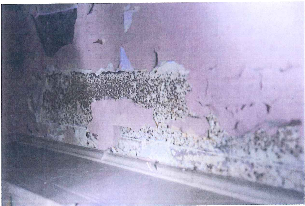
Fot. 9. Parter. Stalowa belka pokryta polichromią. Utrzymujące się zawilgocenie wnętrza odpowiada za korozję elementów metalowych.
