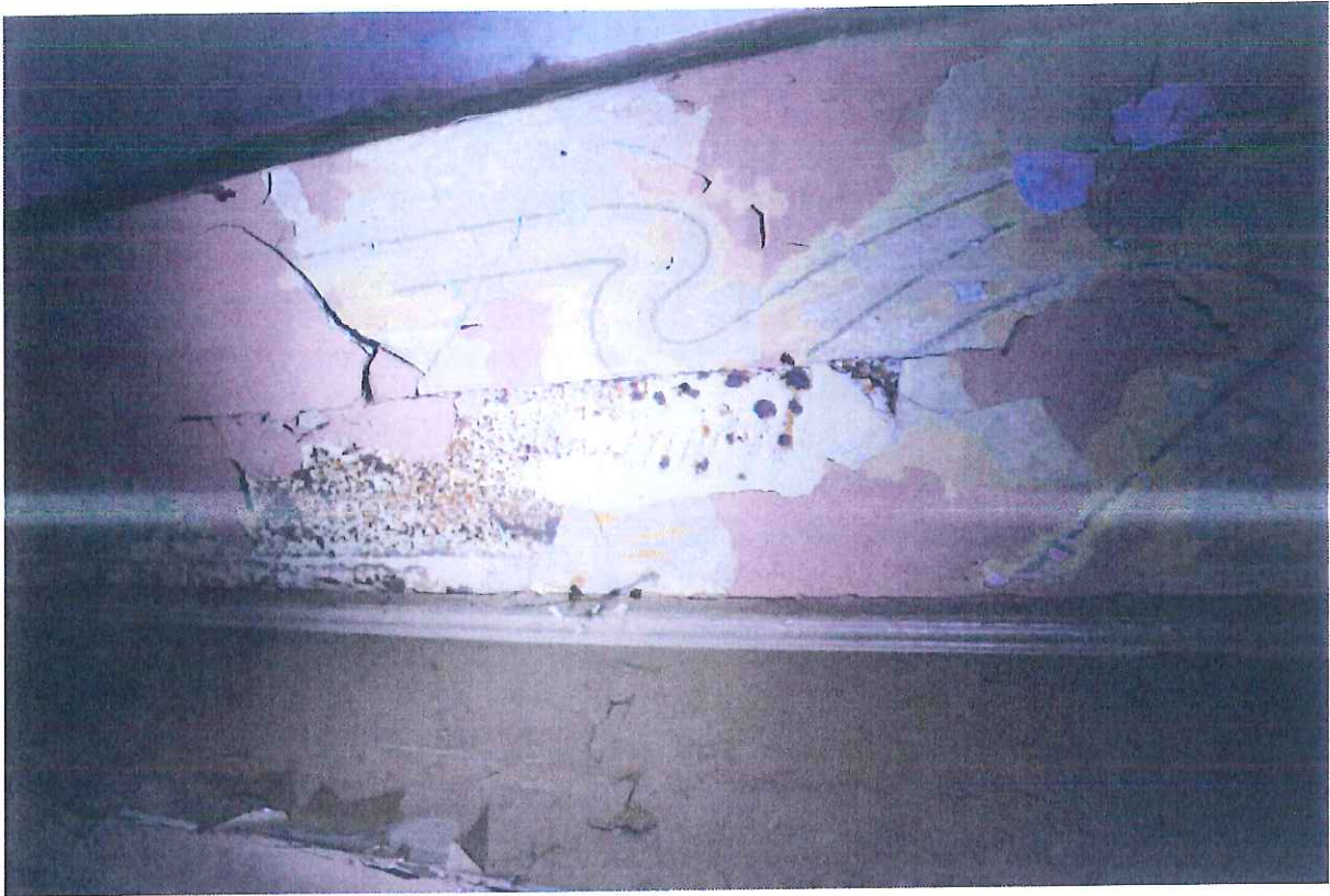
Fot.8. Parter. Stalowa belka pokryta polichromią. Utrzymujące się zawilgocenie wnętrza odpowiada za korozję elementów metalowych.
