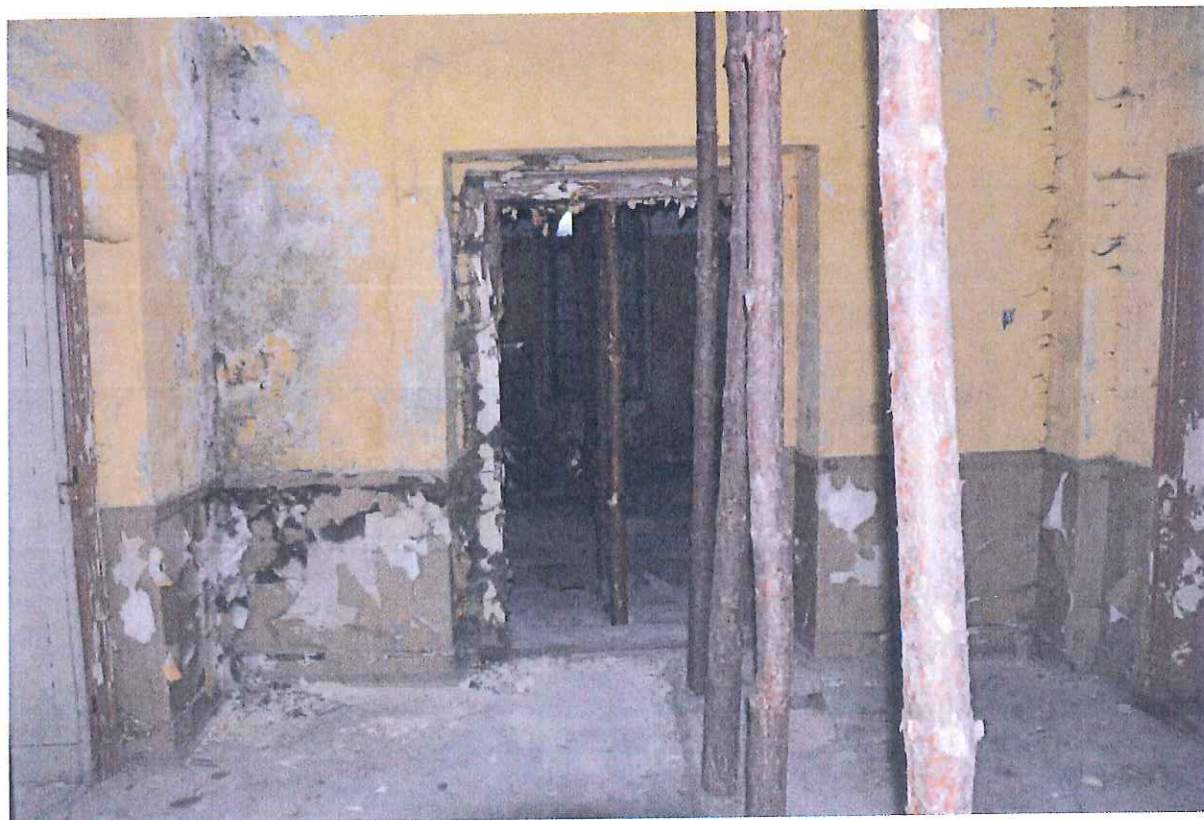
Fot. 17. Piętro I. Widoczne zalanie ściany przez wody opadowe. Na powierzchni widoczny wzrost grzybów pleśniowych.
