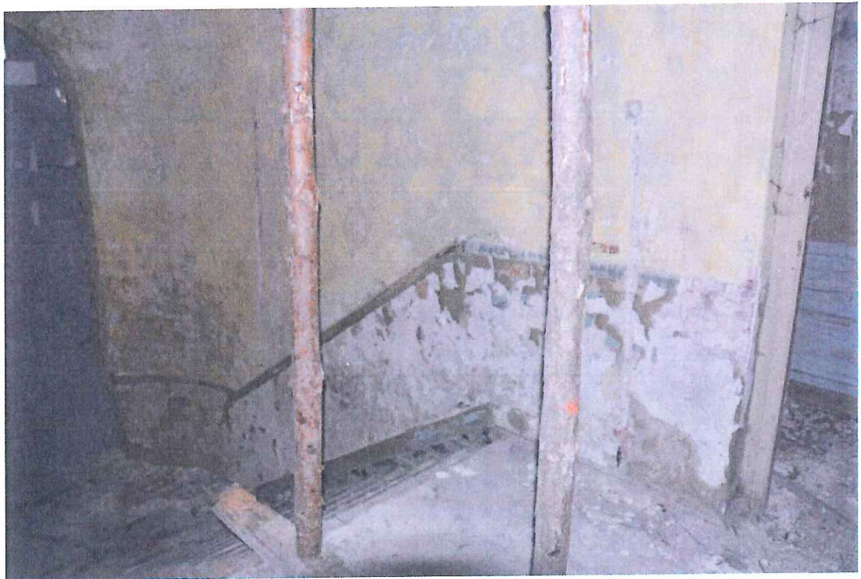
Fot. 35. Klatka schodowa. Zniszczenia spowodowane przez wody opadowe i zawilgocenie wnętrza. Widoczne odspojenia i ubytki warstwy polichromii.
