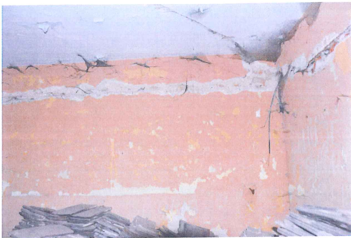
Fot. 12. Parter. Widoczne odspojenia warstwy malarskiej na suficie i bruzdy po wyrwanej instalacji elektrycznej na ścianach.
