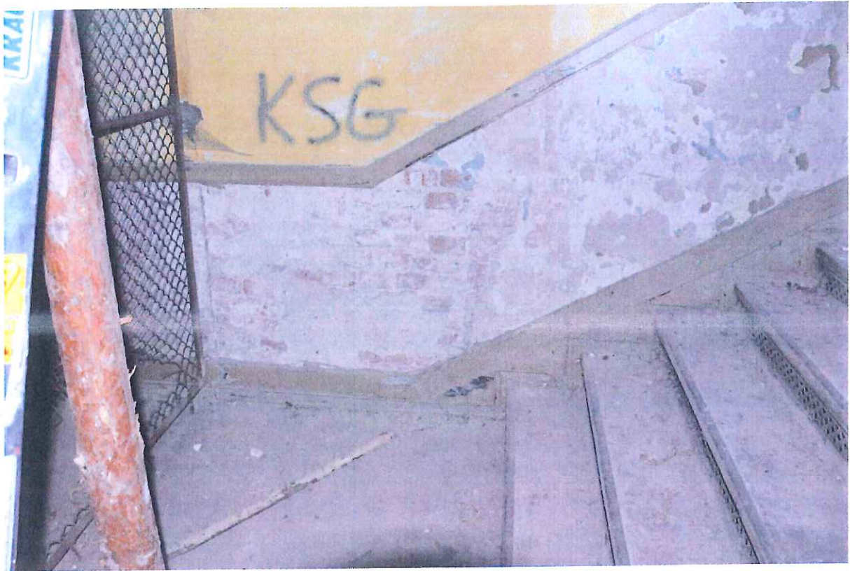
Fot. 14. Piętro I. Widoczne ubytki polichromii w strefie lamperii.
