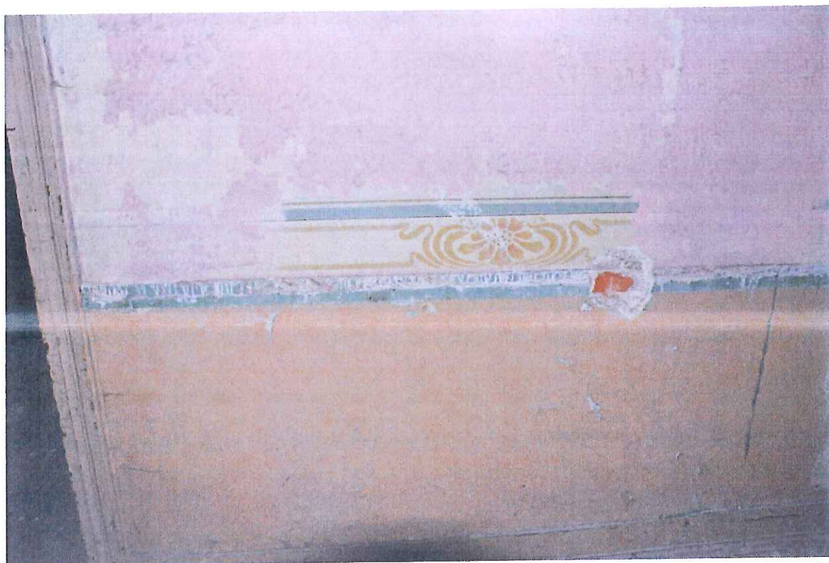
Fot.40. Piętro II. Zniszczenia polichromii spowodowane przez zawilgocenie wnętrza. Widoczne spękania i odspojenia warstwy malarskiej.
