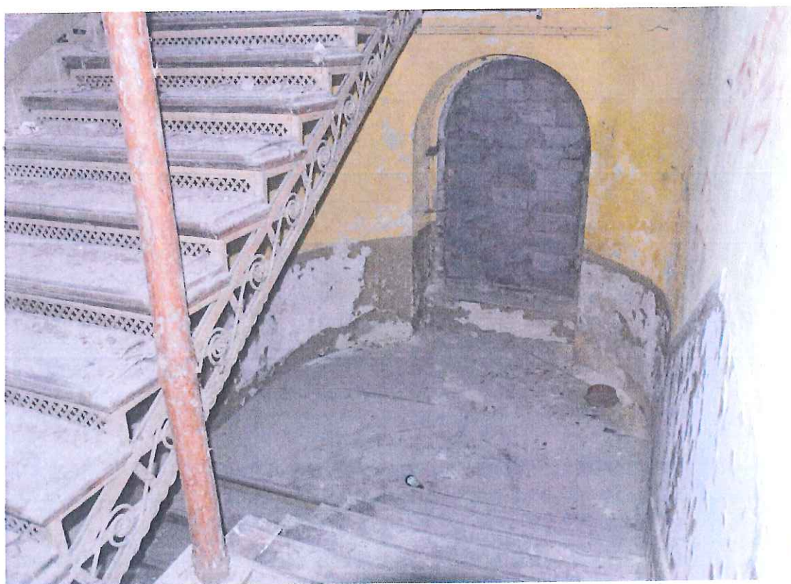
Fot. 13. Klatka schodowa. Widoczne ubytki polichromii w strefie lamperii oraz zawilgocenie muru wokół okna.
