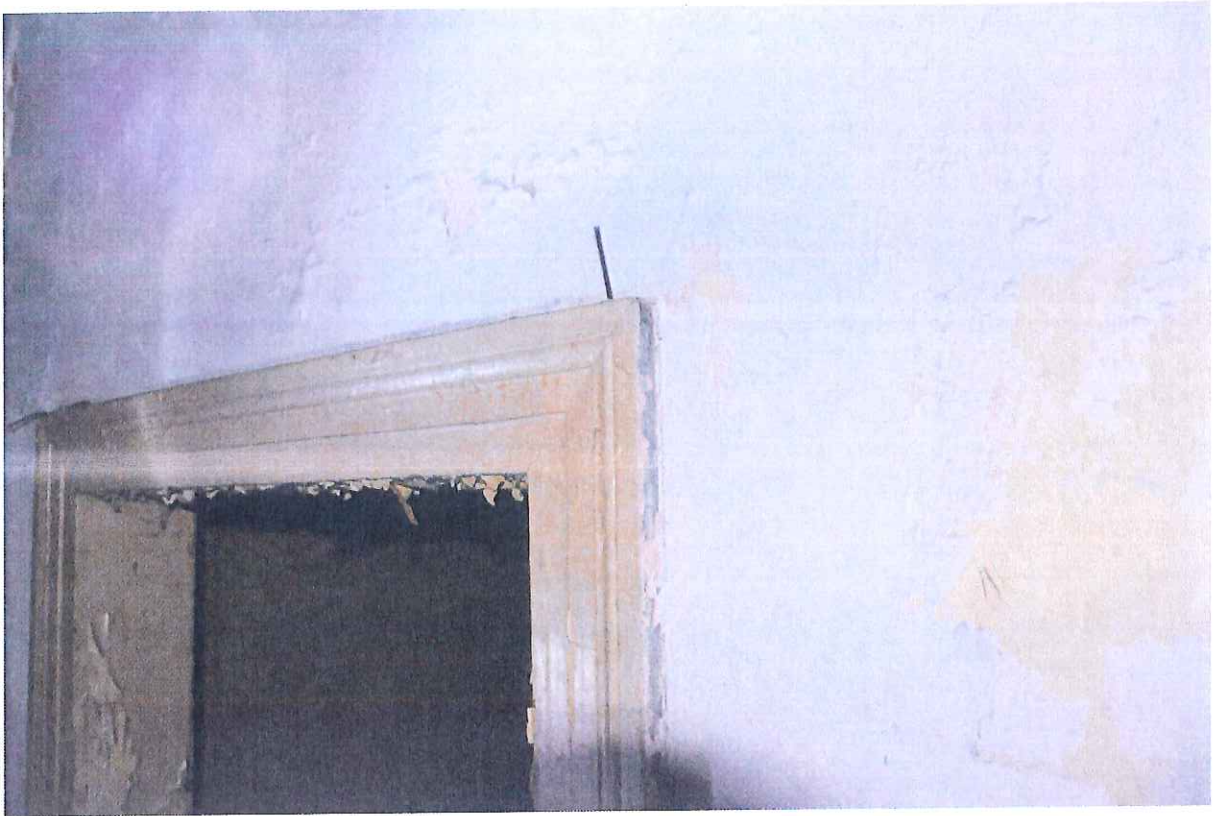
Fot.38. Piętro II. Zniszczenia polichromii spowodowane przez zawilgocenie wnętrza. Widoczne spękania i odspojenia warstwy malarskiej.
