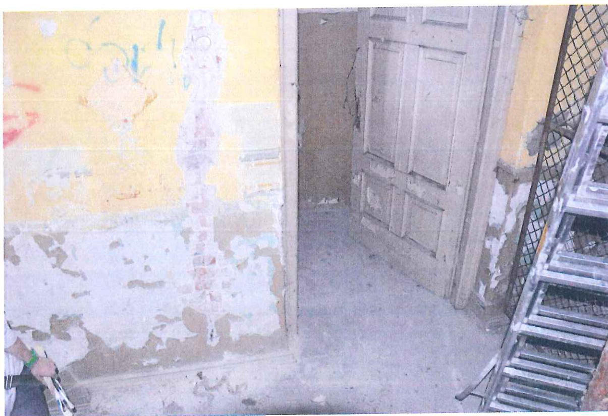
Fot. 3. Hol na I piętrze. Stan z 2016 roku. Widoczne miejsca po wyrwanej instalacji elektrycznej.
