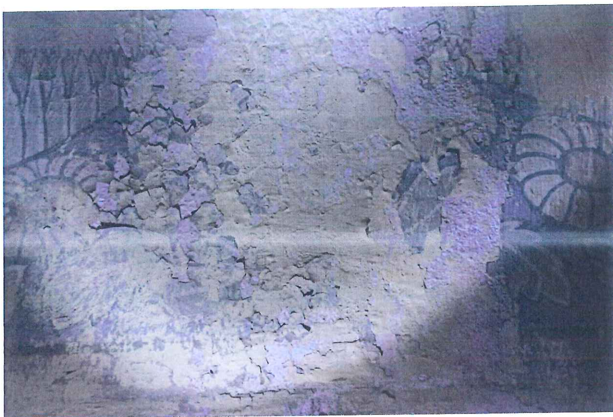
Fot. 24. Piętro I. Zniszczenia polichromii w miejscu wykonanej odkrywki spowodowane przez wody opadowe.
