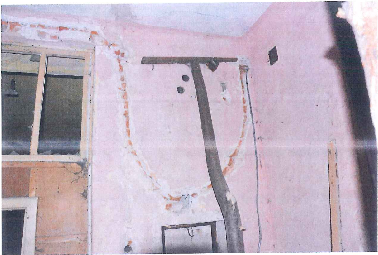
Fot.42. Piętro II. Zniszczenia polichromii spowodowane przez wyrwanie instalacji elektrycznej ze ściany.
