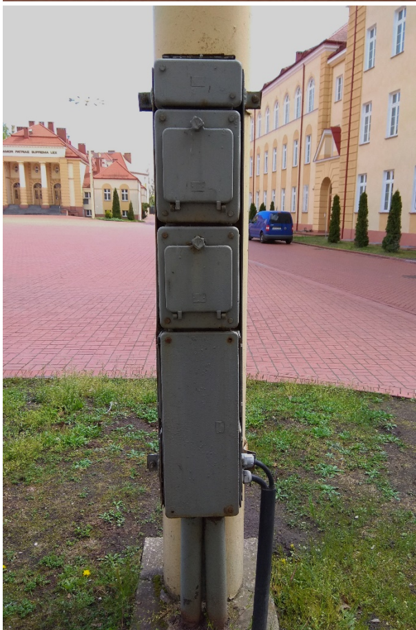
Zdjęcie 2 - Istniejące żeliwne rozdzielnice słupowe
