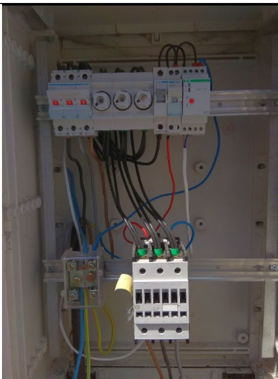
Zdjęcie 3 – Wyposażenie szafki zasilająco-ster.
