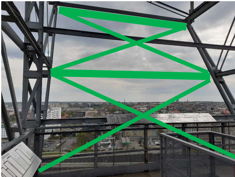
Fot. 7 Miejsce zabudowy rygla ze stężeniami wraz z ich orientacyjną lokalizacją.
