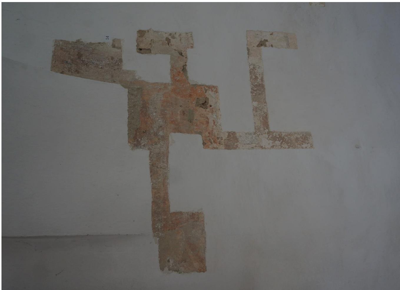
Fot.37 Synagoga Nowomiejska w Dębicy. Odkrywka stratygraficzna na ścianie południowej w oryginalnej sali modlitw. Pod wtórnymi nawarstwieniami znajdują się fragmenty zabytkowej polichromii z 2 poł XVIII w. z iluzjonistycznie namalowanym filarem. Widoczna warstwa malarska jest źle zachowana, wymaga doczyszczenia, posiada ubytki i odspojenia warstwy pobiałą z polichromią.
