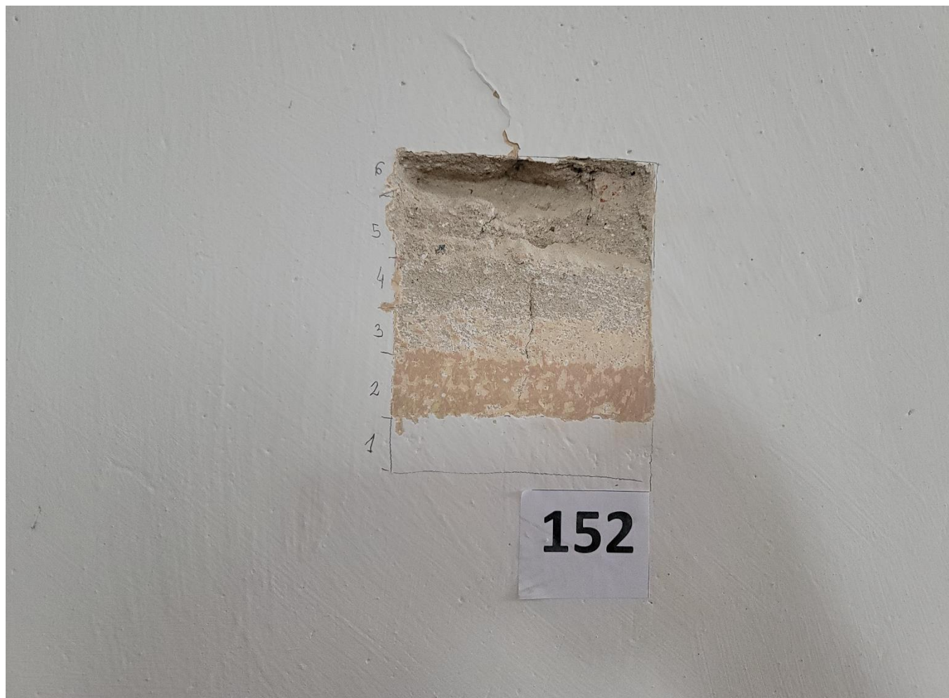
Fot.54 Synagoga Nowomiejska w Dębicy. Odkrywka stratygraficzna na ścianie północnej synagogi w oryginalnej sali modlitw. Widoczne współczesne przekształcenia malarskie powierzchni ścian. Bezpośrednio na cegle znajduje się zaprawa i pobiała wapienna z lat 30-tych XX w
