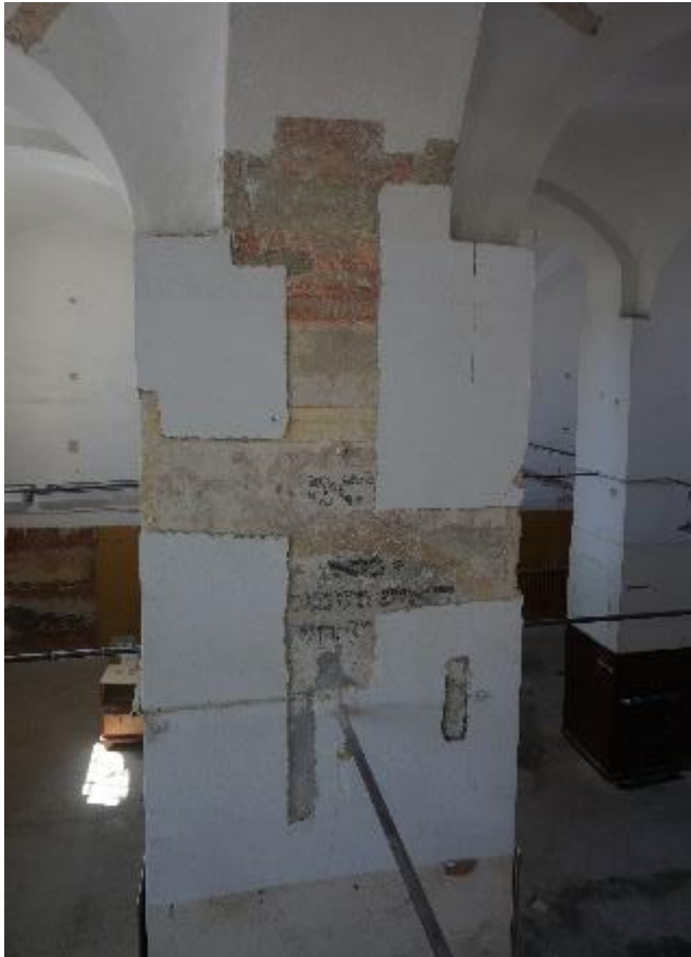
Fot. 23 Synagoga Nowomiejska w Dębicy. Odkrywka stratygraficzna na filarze pierwotnie oddzielającym salę modlitw od babińca na górnej kondygnacji. Pod wtórnymi warstwami przemalowań i zaprawy wapienno-piaskowej znajdują się fragmenty zabytkowej polichromii z 2 poł XVIII w. z inskrypcją ujętą w dekoracyjnym kartuszu. Widoczna warstwa malarska jest źle zachowana, posiada ubytki i przetarcia do zaprawy.
