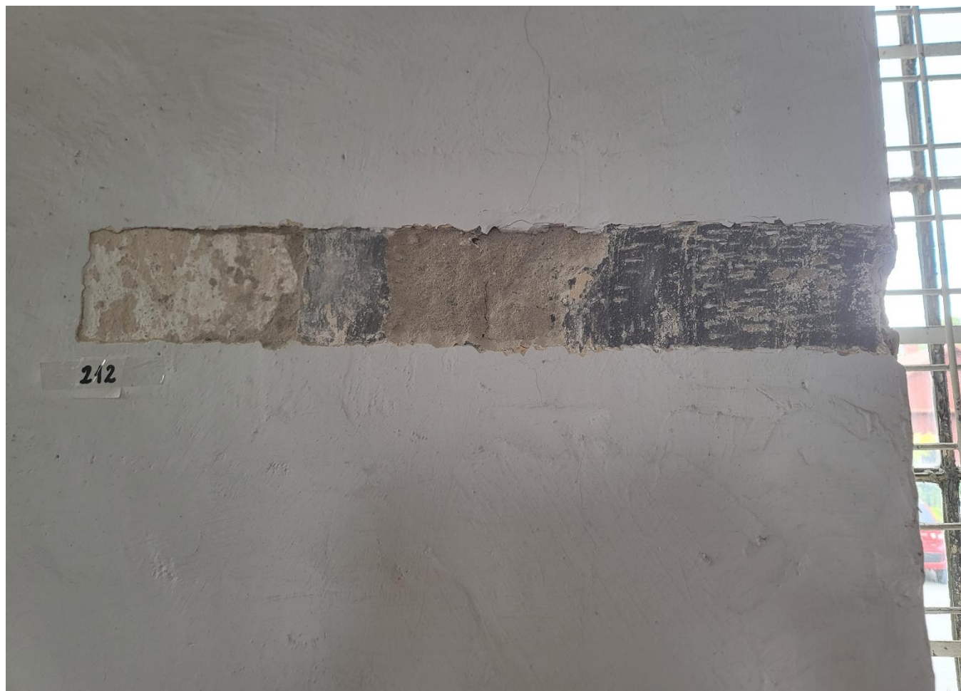
Fot.41 Synagoga Nowomiejska w Dębicy. Odkrywka stratygraficzna na ścianie południowej w oryginalnej sali modlitw. Widoczne współczesne przekształcenia malarskie i architektoniczne ścian (przemurowanie glífów okiennych). Najniżej położona ciemnoszara warstwa stanowi pobiałę wapienną zabrudzoną na skutek pożaru w czasie II wojny światowej.
