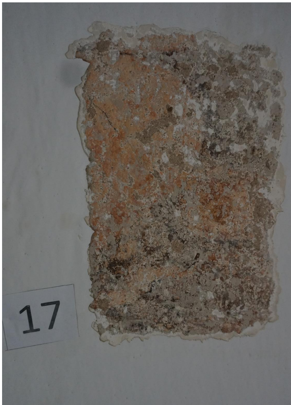
Fot. 6. Synagoga Nowomiejska w Dębicy. Odkrywka stratygraficzna w narożniku sklepienia. Pod kilkoma warstwami pobiły wapiennej i cienkim zatarciu z zaprawy cementowej znajdują się fragmenty zabytkowej polichromii z 2 poł XVIII w. z przedstawieniem wazonu z kwiatami. (?) Widoczna warstwa malarska wymaga doczyszczenia, posiada ubytki i przetarcia do zaprawy.
