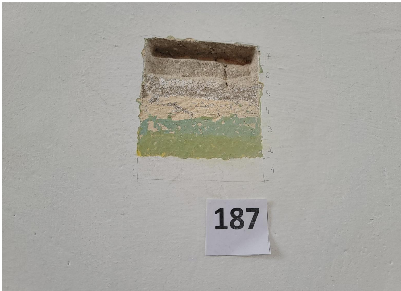
Fot. 34 Synagoga Nowomiejska w Dębicy. Odkrywka stratygraficzna na ścianie wschodniej. Widoczne wtórne nawarstwienia z zaprawy wapienno-piaskowej i powłok malarskich.
