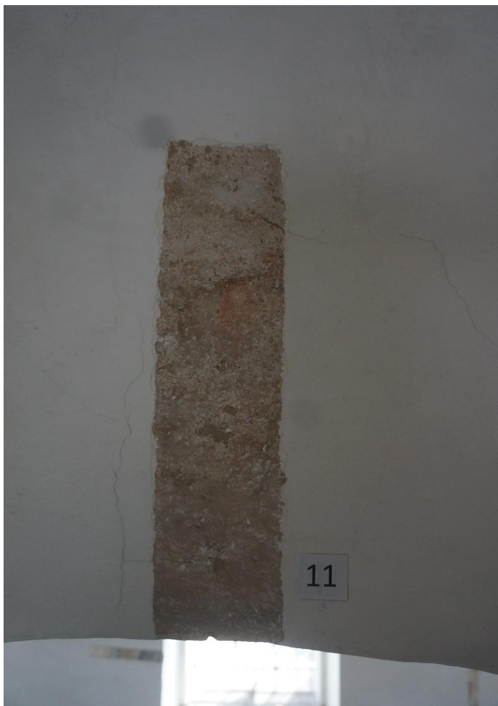
Fot. 3. Synagoga Nowomiejska w Dębicy. Odkrywka stratygraficzna w południowej części sklepienia znajdującego się nad bimą. Pod kilkoma warstwami pobiły wapiennej i cienkim zatarciu z zaprawy cementowej znajdują się fragmenty zabytkowej polichromii z 2 poł XVIII w. Widoczna warstwa malarska wymaga doczyszczenia, posiada ubytki i przetarcia do zaprawy.
