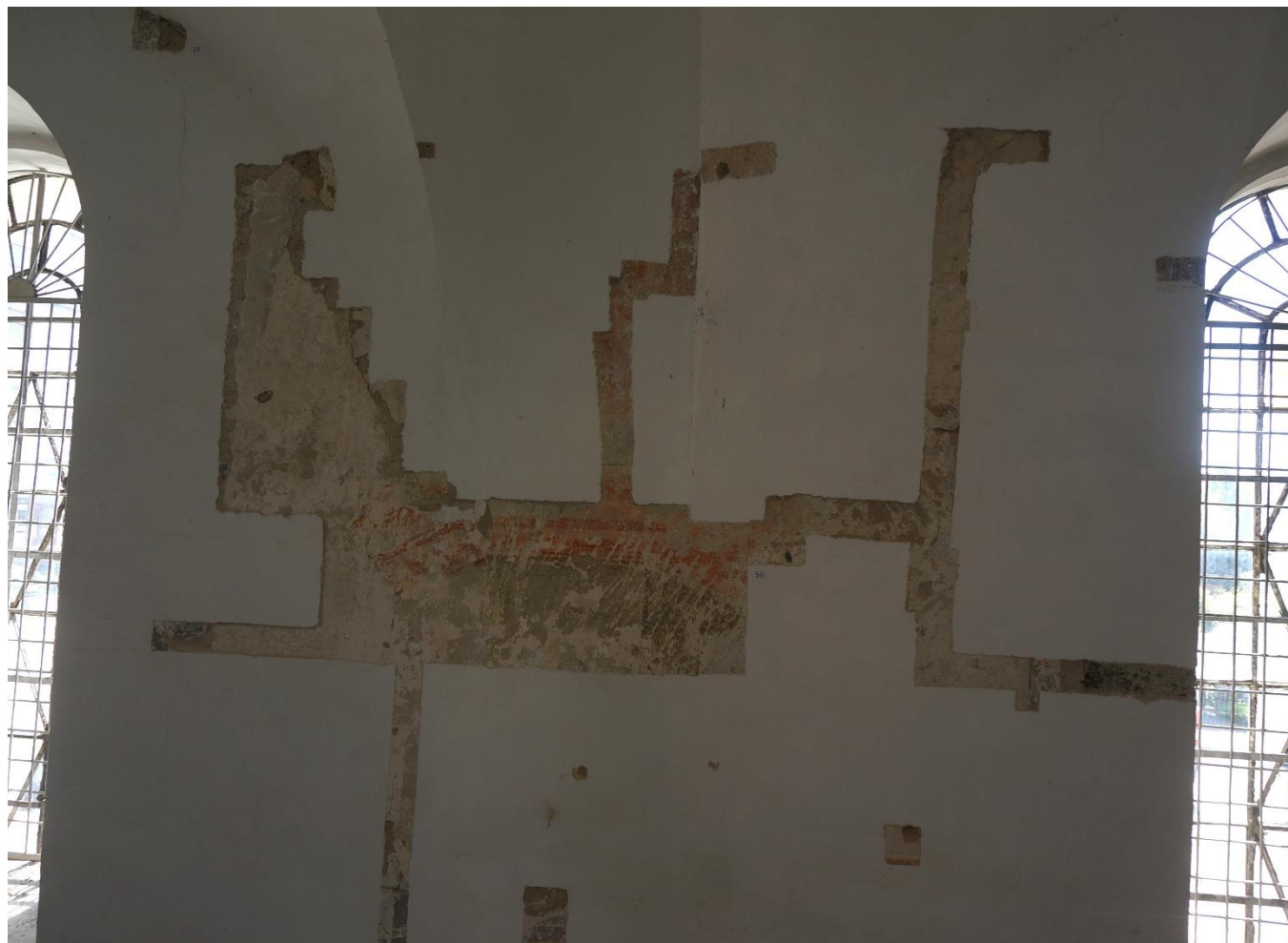
Fot.39 Synagoga Nowomiejska w Dębicy. Odkrywka stratygraficzna na ścianie południowej w oryginalnej sali modlitw. Widoczny fragment z 2 poł XVIII w. z iluzjonistycznie malowanym filarem podtrzymującym gurt sklepienny. Warstwa malarska znajduje się w złym stanie zachowania, na powierzchni występują uszkodzenia mechaniczne (zarysowania), powstałe w celu zwiększenia przyczepności podłoża dla kolejnych warstw zaprawy.
