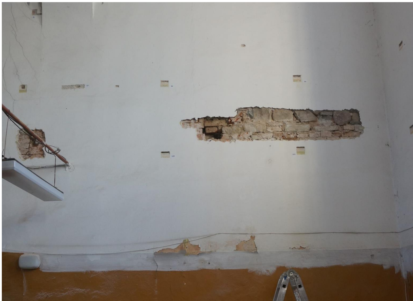
Fot.46 Synagoga Nowomiejska w Dębicy. Widok na odkrywkę architektoniczną na ścianie zachodniej synagogi. Przy lewej krawędzi odkrywki widać cegły, którymi zamurowane zostało okno. Biegące do góry pęknięcie w tynku określa krawędź prawego głifu okiennego z końca XVII w.
