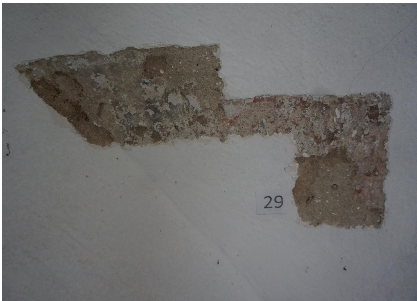
Fot. 10 Synagoga Nowomiejska w Dębicy. Odkrywka stratygraficzna na sklepieniu. Pod kilkoma warstwami pobiałej wapiennej i cienkim zatarciu z zaprawy cementowej znajdują się fragmenty zabytkowej polichromii z 2 poł XVIII w. Widoczna warstwa malarska jest bardzo źle zachowana, posiada liczne ubytki i przetarcia do zaprawy.
