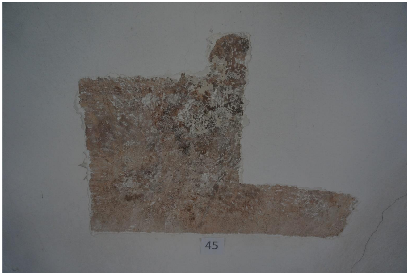
Fot. 14 Synagoga Nowomiejska w Dębicy. Odkrywka stratygraficzna na sklepieniu. Pod kilkoma warstwami pobiły wapiennej i cienkim zatarciu z zaprawy cementowej znajdują się fragmenty zabytkowej polichromii z 2 poł XVIII w. Widoczna warstwa malarska jest źle zachowana, posiada liczne ubytki i przetarcia do zaprawy.
