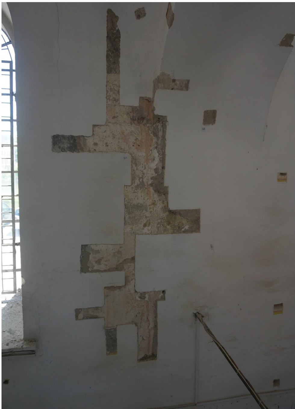
Fot.38 Synagoga Nowomiejska w Dębicy. Odkrywka stratygraficzna na ścianie południowej w oryginalnej sali modlitw. Pod wtórnymi nawarstwieniami znajdują się fragmenty zabytkowej polichromii z końca XVII w. i 2 poł XVIII w. z iluzjonistycznie malowanym filarem podtrzymującym gurt sklepienny. Widoczna pierwotna warstwa malarska jest bardzo źle zachowana i nieczytelna.
