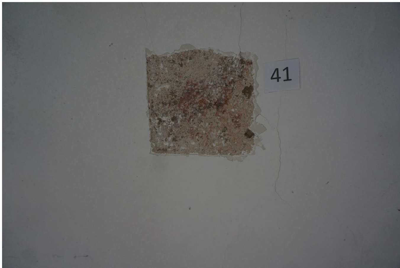
Fot. 12 Synagoga Nowomiejska w Dębicy. Odkrywka stratygraficzna na sklepieniu. Pod kilkoma warstwami pobiły wapiennej i cienkim zatarciu z zaprawy cementowej znajdują się fragmenty zabytkowej polichromii z 2 poł XVIII w. Widoczna warstwa malarska jest bardzo źle zachowana, posiada liczne ubytki i przetarcia do zaprawy.
