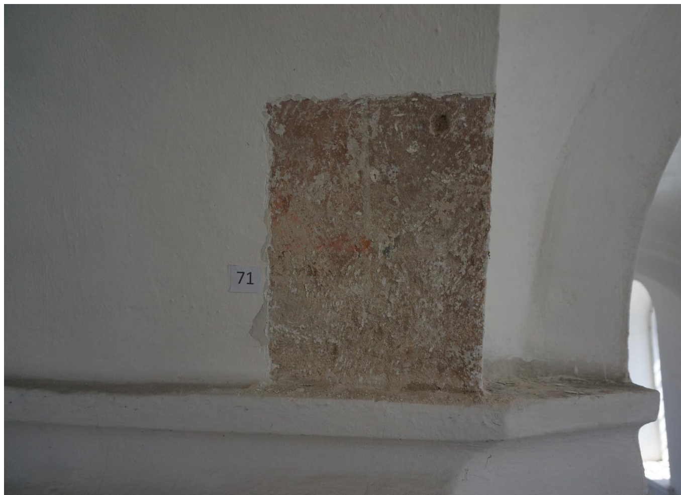
Fot. 17 Synagoga Nowomiejska w Dębicy. Odkrywka stratygraficzna na łuku gurty sklepiennej. Pod kilkoma warstwami pobiałej wapiennej i cienkim zatarciu z zaprawy cementowej znajdują się fragmenty zabytkowej polichromii z 2 poł XVIII w. z dekoracją ramowo-płycinową. Widoczna warstwa malarska jest źle zachowana, posiada liczne przetarcia i wymaga doczyszczenia z zaprawy cementowej.
