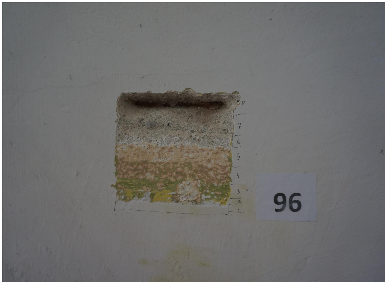
Fot.47 Synagoga Nowomiejska w Dębicy. Odkrywka stratygraficzna na ścianie zachodniej w oryginalnym babińcu. Widoczne współczesne przekształcenia malarskie. Najniżej położona ciemnoszara warstwa stanowi pobiałę wapienną zabrudzoną na skutek pożaru w czasie II wojny światowej.
