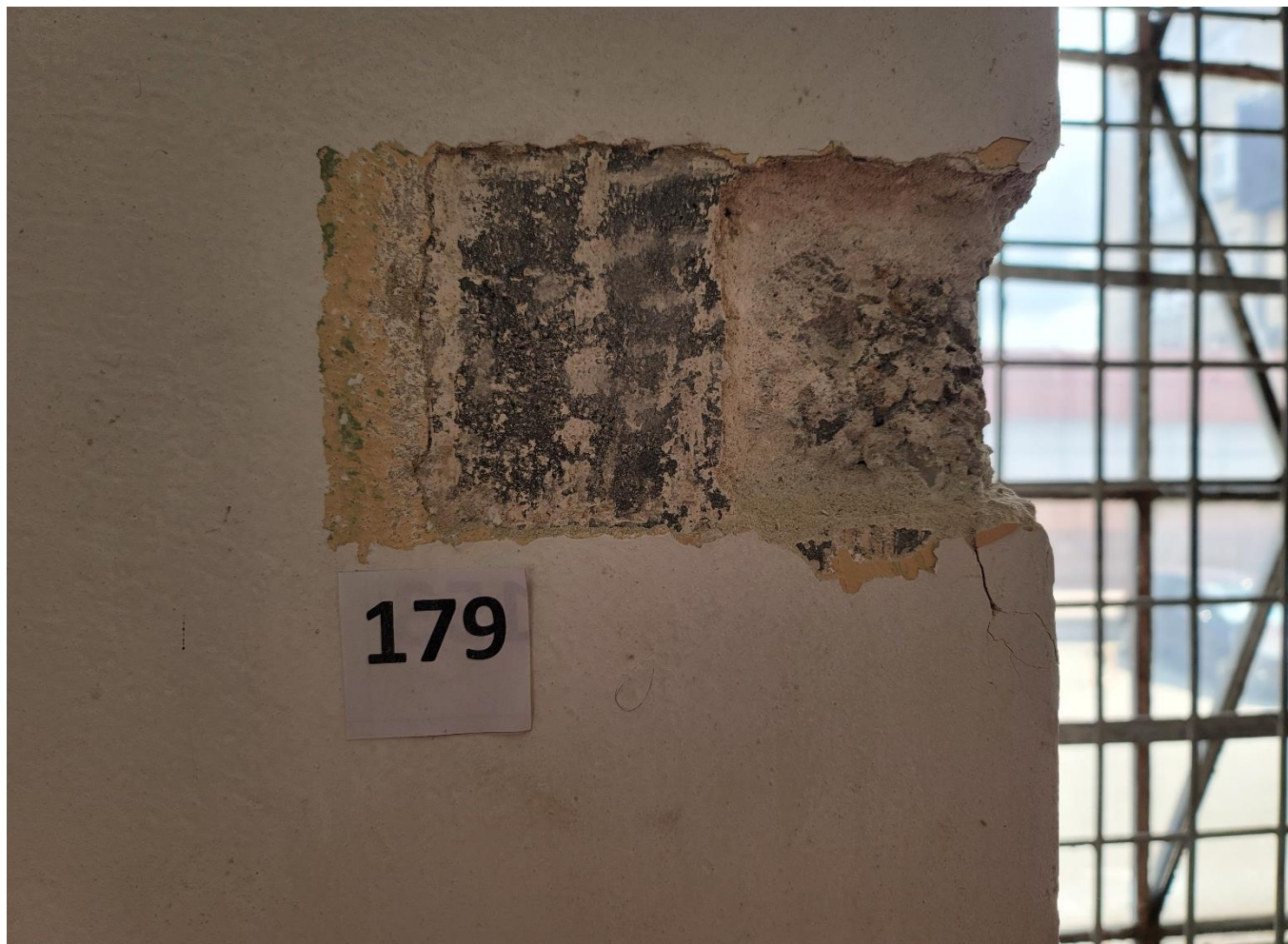
Fot. 33 Synagoga Nowomiejska w Dębicy. Odkrywki stratygraficzne na ścianie wschodniej. Widać przemurowanie glifu okiennego wykonane w latach 30-tych XX w. przy użyciu cegieł i bardzo silnej zaprawy cementowej z żwirem. Bezpośrednio na zaprawie cementowej znajduje się warstwa tynku wapienno-cementowego z pobiałą, która została silnie zabrudzona w wyniku pożaru spowodowanego działaniami wojennymi.
