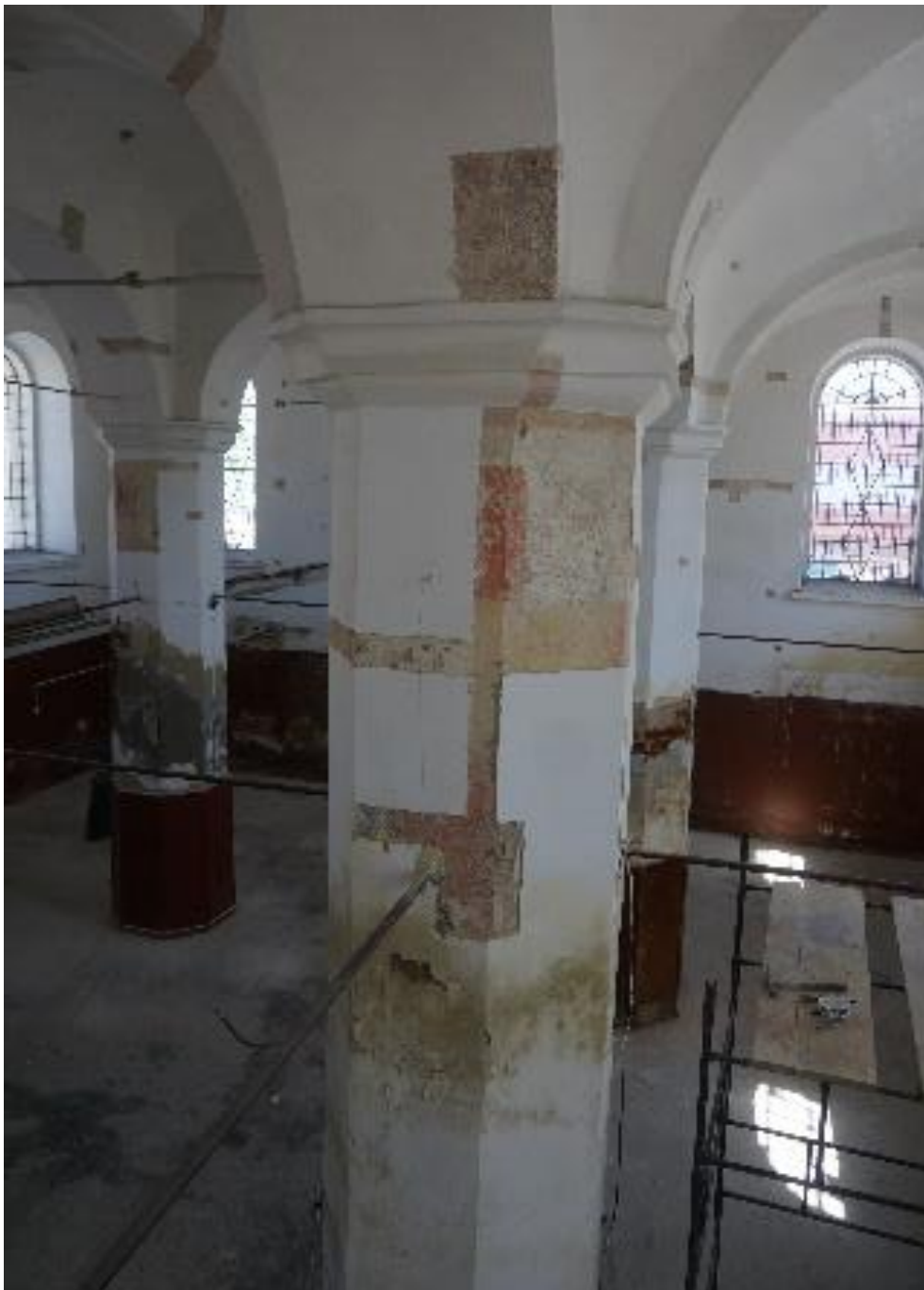
Fot. 24 Synagoga Nowomiejska w Dębicy. Odkrywka stratygraficzna na filarze bimy. Pod kilkoma warstwami pobiąły wapiennej i cienkim zatarciu z zaprawy cementowej znajdują się fragmenty zabytkowej polichromii z 2 poł XVIII w. z trójbarwnym pseudoboniowaniem. Widoczna warstwa malarska w górnej części filara jest dobrze zachowana, posiada ubytki i przetarcia do zaprawy.
