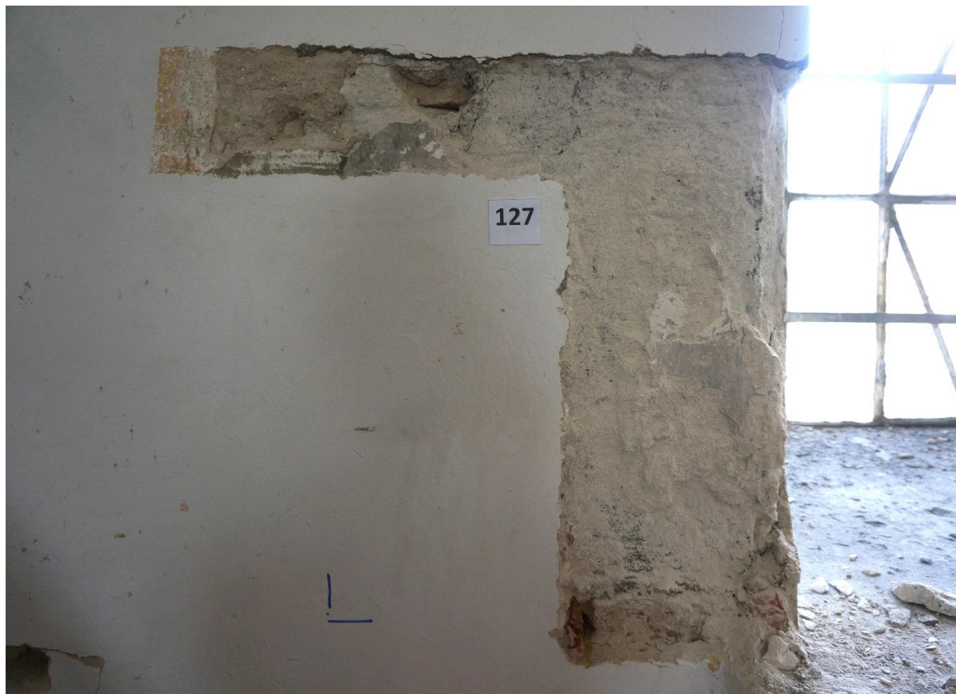
Fot.52 Synagoga Nowomiejska w Dębicy. Odkrywka stratygraficzna na ścianie zachodniej w oryginalnej sali modlitw. Widoczne współczesne przekształcenia malarskie i architektoniczne ścian (przemurowanie gładów okiennych). Najniżej położona ciemnoszara warstwa stanowi pobiałę wapienną zabrudzoną na skutek pożaru w czasie II wojny światowej.
