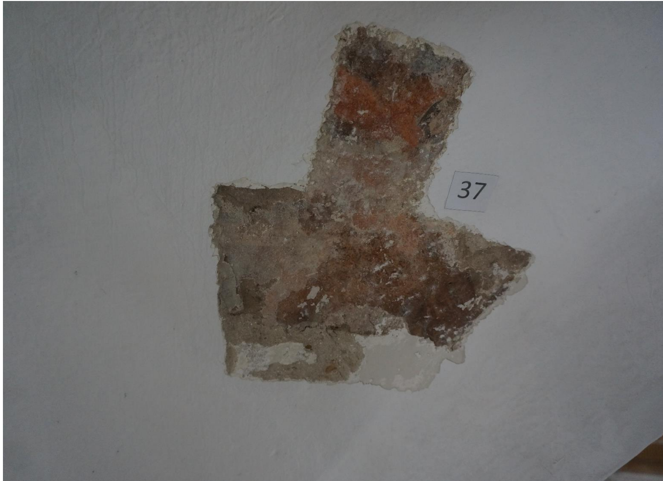
Fot. 11 Synagoga Nowomiejska w Dębicy. Odkrywka stratygraficzna na sklepieniu. Pod kilkoma warstwami pobiły wapiennej i cienkim zatarciu z zaprawy cementowej znajdują się fragmenty zabytkowej polichromii z 2 poł XVIII w. Widoczna warstwa malarska jest źle zachowana, wymaga doczyszczenia, posiada ubytki i przetarcia do zaprawy.
