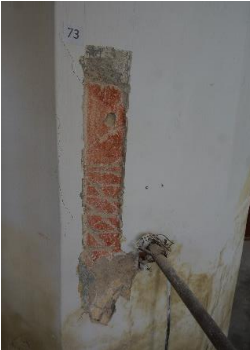
Fot. 25 Synagoga Nowomiejska w Dębicy. Odkrywka stratygraficzna na filarze bimy. Pod kilkoma warstwami pobiaty wapiennej i cienkim zatarciu z zaprawy cementowej znajdują się fragmenty zabytkowej polichromii z 2 poł XVIII w. z trójbarwnym pseudoboniowaniem. Widoczna warstwa malarska jest źle zachowana, posiada ubytki i przetarcia do zaprawy.
