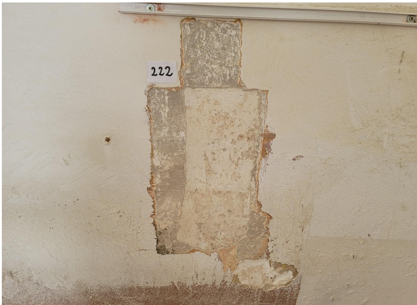
Fot.42 Synagoga Nowomiejska w Dębicy. Odkrywka stratygraficzna na ścianie południowej w oryginalnej sali modlitw. W centralnej części odkrywki widać oryginalną warstwę zaprawy wapienno-piaskowej z pobiłą wapienną. Położona na niej cienka warstwa zaprawy z pobiłą wapienną została zabrudzona na skutek pożaru w czasie II wojny światowej.
