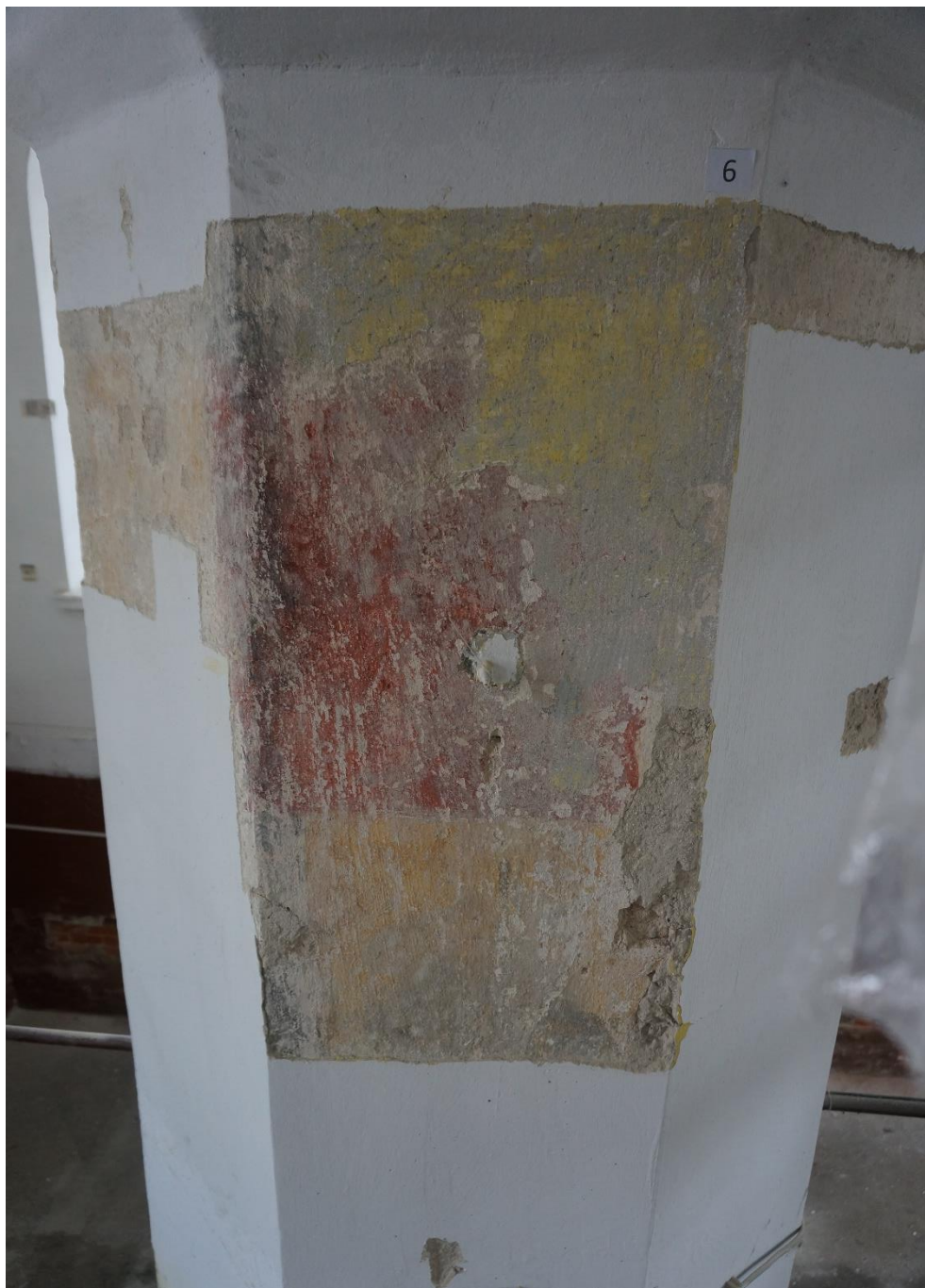
Fot. 22 Synagoga Nowomiejska w Dębicy. Odkrywka stratygraficzna na filarze bimy. Pod kilkoma warstwami pobiły wapiennej i cienkim zatarciu z zaprawy cementowej znajdują się fragmenty zabytkowej polichromii z 2 poł XVIII w. z trójbarwnym pseudoboniowaniem. Widoczna warstwa malarska jest źle zachowana, posiada ubytki i przetarcia do zaprawy.
