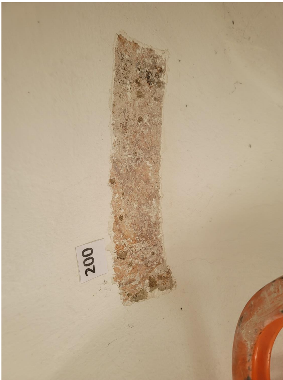
Fot. 21 Synagoga Nowomiejska w Dębicy. Odkrywka stratygraficzna na sklepieniu. Pod kilkoma warstwami pobiaty wapiennej i cienkim zatarciu z zaprawy cementowej znajdują się fragmenty zabytkowej polichromii z 2 poł XVIII w. Widoczna warstwa malarska jest źle zachowana, posiada liczne przetarcia do zaprawy.
