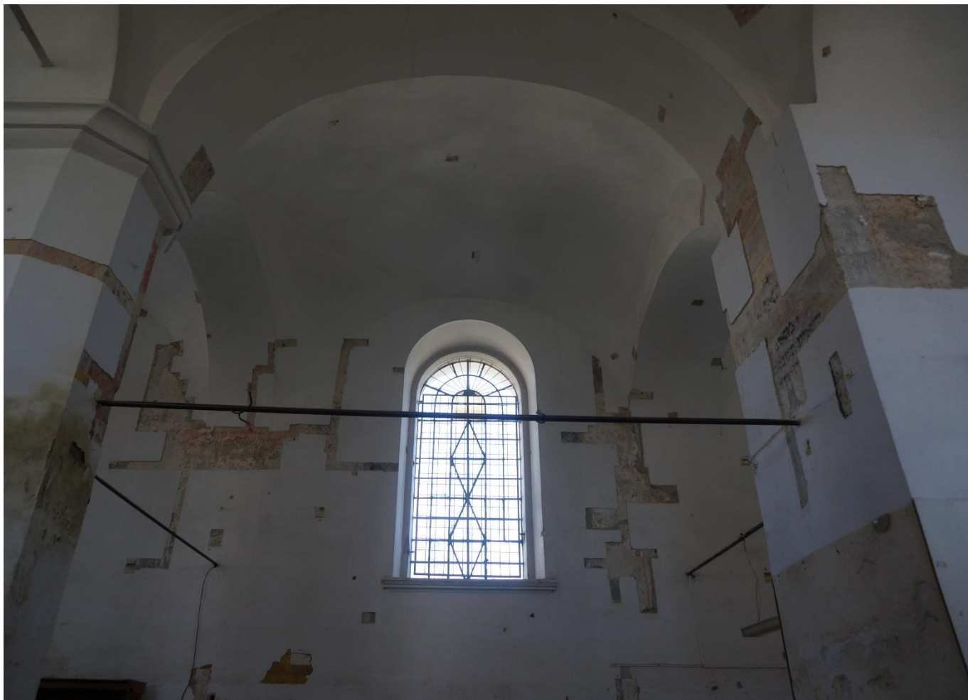
Fot. 35 Synagoga Nowomiejska w Dębicy. Widok na odkrywki stratygraficzne w części południowo-zachodniej pierwotnej sali modlitw. Widoczne fragmenty barokowej dekoracji malarskiej z 2 poł. XVIII w.
