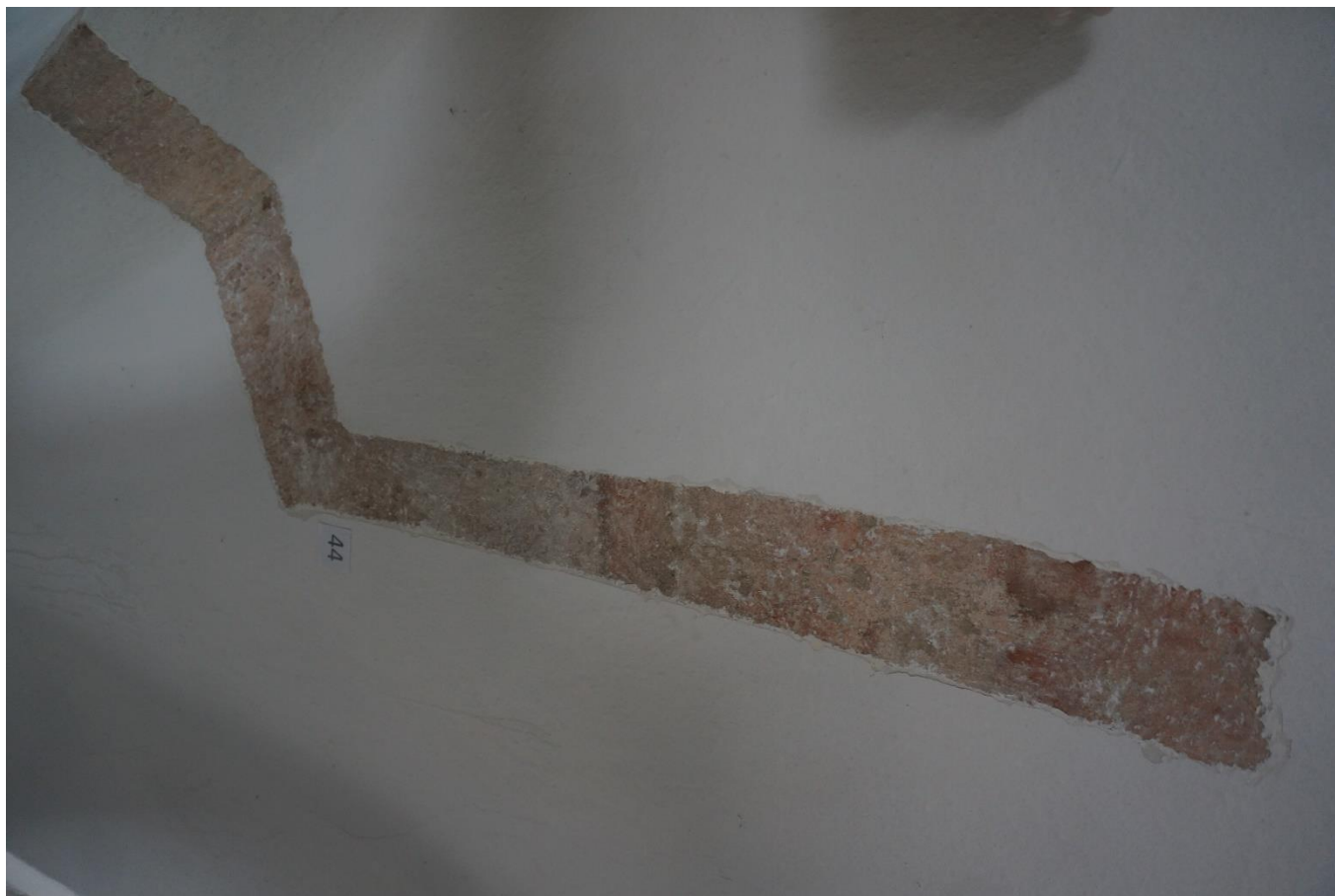
Fot. 13 Synagoga Nowomiejska w Dębicy. Odkrywka stratygraficzna na sklepieniu. Pod kilkoma warstwami pobiły wapiennej i cienkim zatarciu z zaprawy cementowej znajdują się fragmenty zabytkowej polichromii z 2 poł XVIII w. Widoczna warstwa malarska jest źle zachowana, posiada liczne ubytki i przetarcia do zaprawy.
