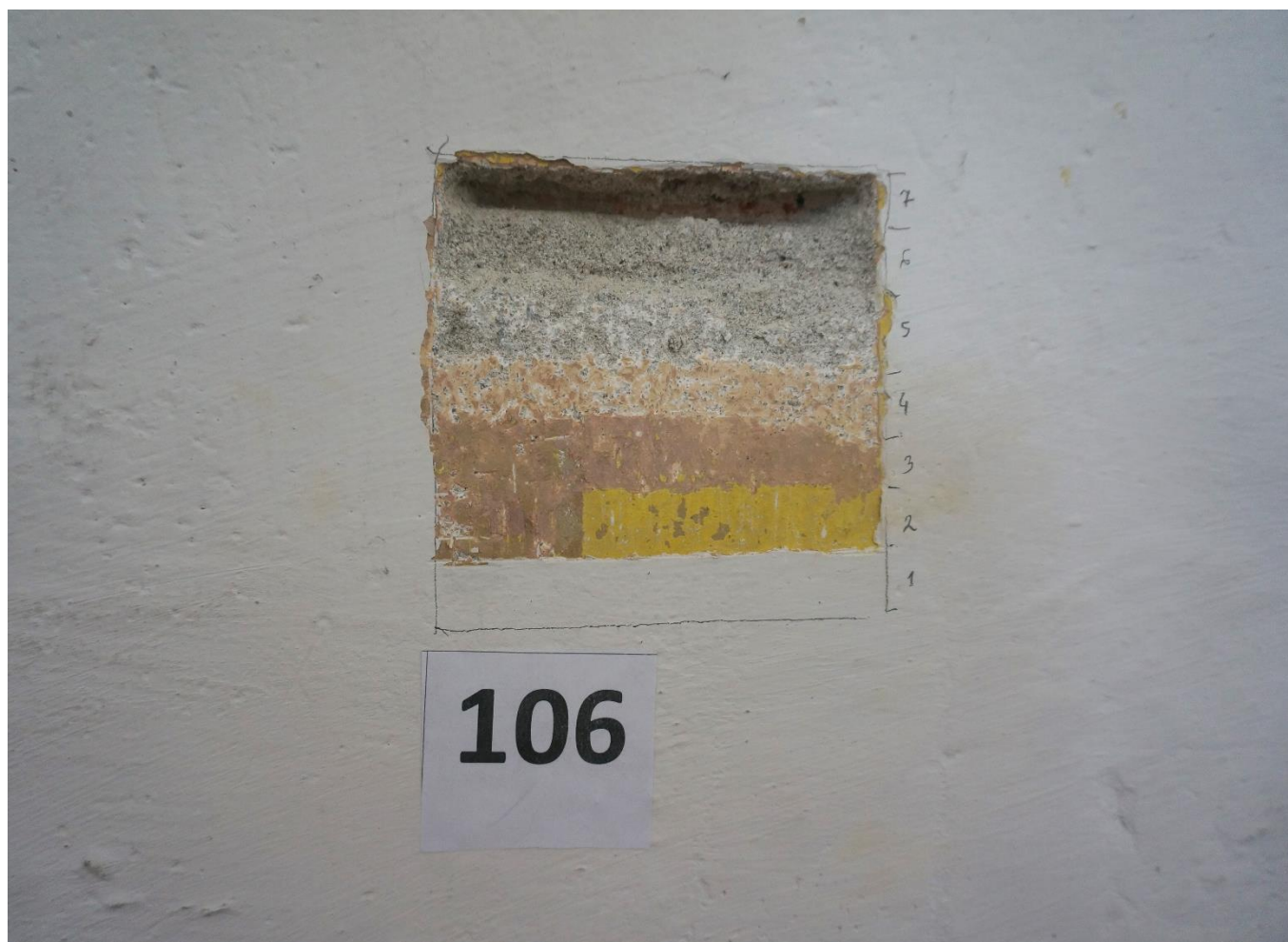
Fot.51 Synagoga Nowomiejska w Dębicy. Odkrywka stratygraficzna na ścianie północnej synagogi. Widoczne współczesne przekształcenia malarskie powierzchni ścian. Bezpośrednio na cegle znajduje się zaprawa i pobiata wapienna z lat 30-tych XX w.
