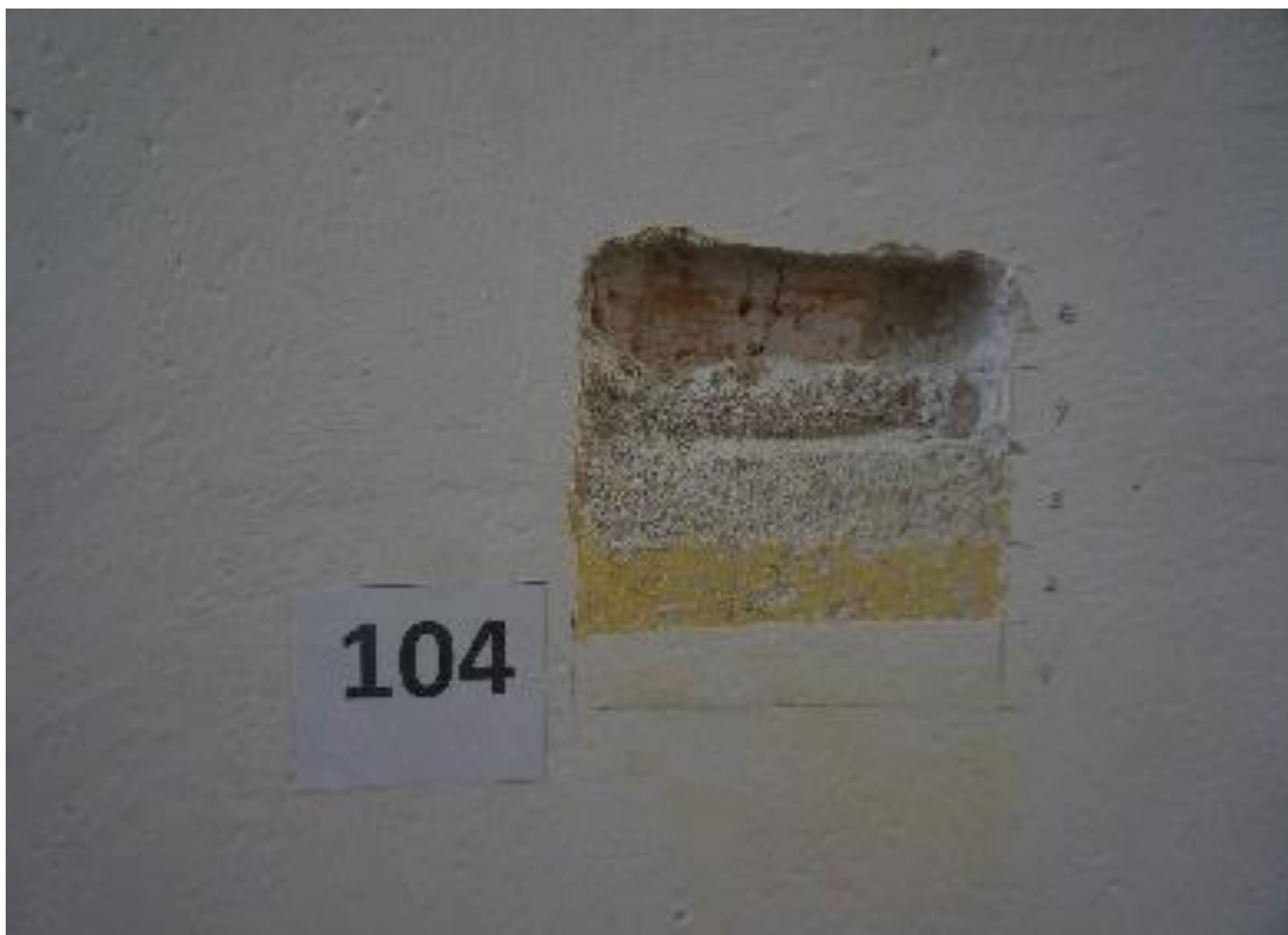
Fot. 26 Synagoga Nowomiejska w Dębicy. Odkrywka stratygraficzna na prostokątnym filarze. Widoczne wtórne nawarstwienia z zaprawy wapienno-piaskowej i powłok malarskich.
