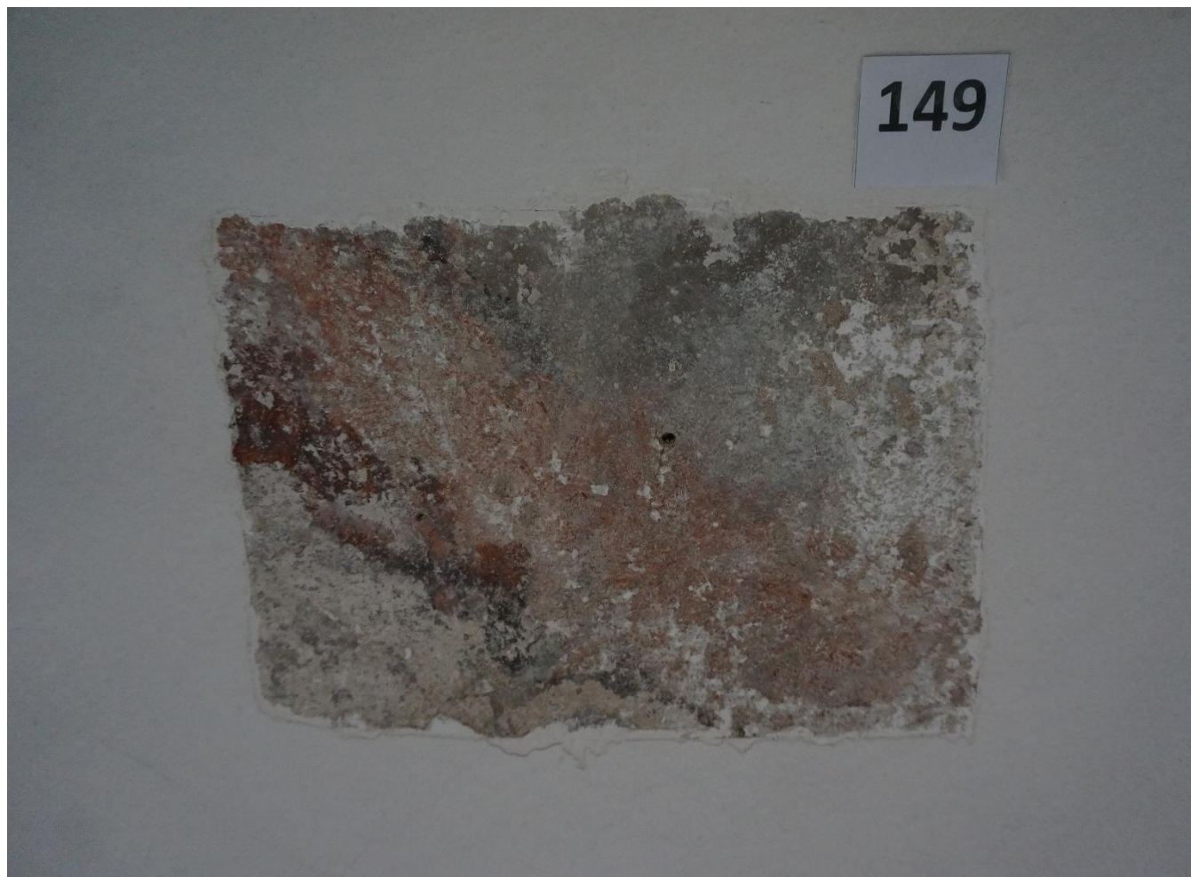
Fot. 19 Synagoga Nowomiejska w Dębicy. Odkrywka stratygraficzna na sklepieniu. Pod kilkoma warstwami pobiału wapiennej i cienkim zatarciu z zaprawy cementowej znajdują się fragmenty zabytkowej polichromii z 2 poł XVIII w. Jest to najlepiej zachowany fragment polichromii w górnej części sklepienia w sali modlitw. Widoczna warstwa malarska jest źle zachowana, posiada liczne przetarcia i wymaga doczyszczenia z zaprawy cementowej.
