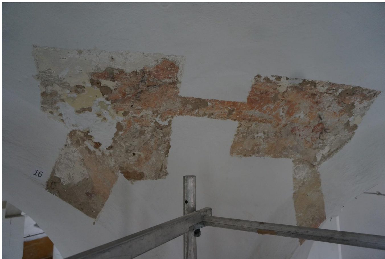
Fot. 5. Synagoga Nowomiejska w Dębicy. Odkrywka stratygraficzna w narożniku sklepienia. Pod kilkoma warstwami pobiły wapiennej i cienkim zatarciu z zaprawy cementowej znajdują się fragmenty zabytkowej polichromii z 2 poł XVIII w. z przedstawieniem wazonu z kwiatami. (?) Widoczna warstwa malarska wymaga doczyszczenia, posiada ubytki i przetarcia do zaprawy.
