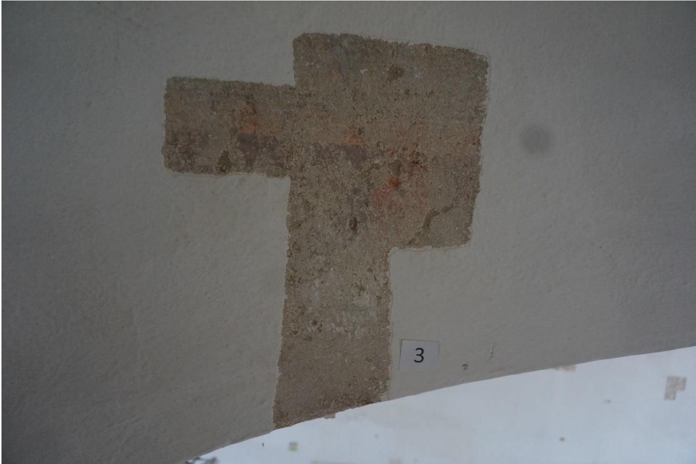
Fot. 2. Synagoga Nowomiejska w Dębicy. Odkrywka stratygraficzna w południowej części sklepienia znajdującego się nad bimą. Widoczne fragmenty zabytkowej warstwy malarskiej z 2 poł XVIII w. Warstwa malarska posiada ubytki i przetarcia, jest silnie zabrudzona i zespojona z cienką warstwą zaprawy cementowej.
