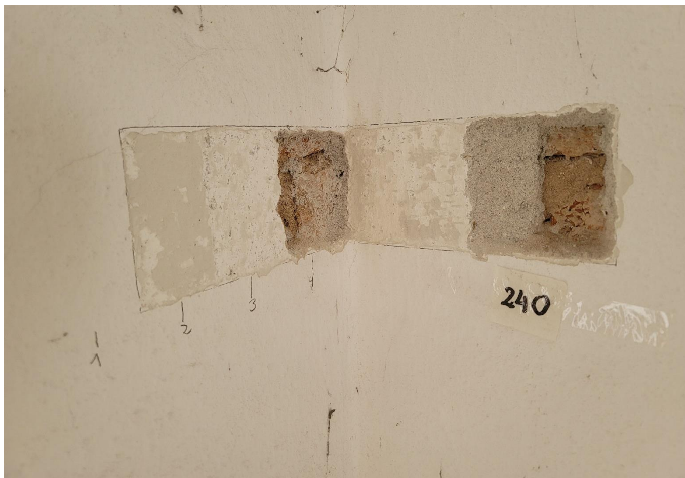
240 Fot.48 Synagoga Nowomiejska w Dębicy. Odkrywka stratygraficzna w narożniku ścian południowej i zachodniej. Widoczne współczesne przekształcenia malarskie powierzchni ścian. Bezpośrednio na cegle znajduje się zaprawa i pobiałą wapienna z lat 30-tych XX w.
