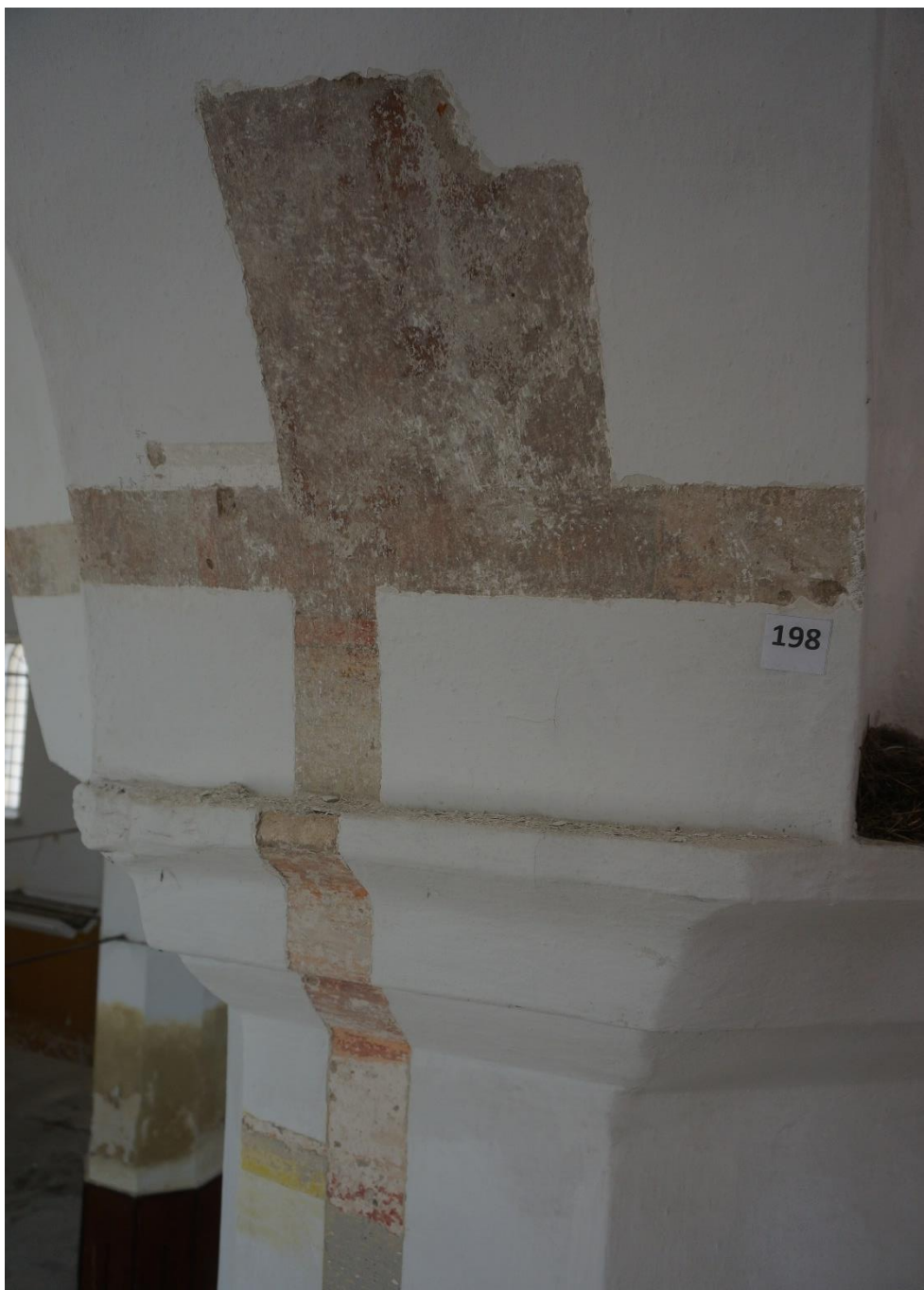
Fot. 20 Synagoga Nowomiejska w Dębicy. Odkrywka stratygraficzna na łuku gurty sklepiennej i gzymsie filara. Widoczne odsłonięte fragmenty zabytkowej polichromii z 2 poł XVIII w. z dekoracją ramowo-płycinową i polichromowanym gzymsem. Warstwa malarska jest źle zachowana, posiada liczne przetarcia i wymaga doczyszczenia z zaprawy cementowej.
