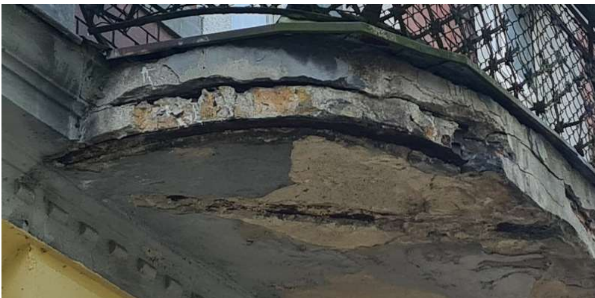
Fot.3 Obraz zniszczeń konstrukcji stalowej i jej otuliny.
