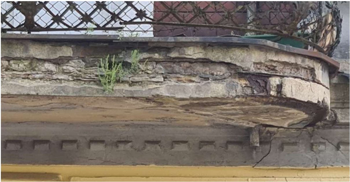
Fot.4 Widok destrukcji płyty ceglanej, korozji ramy nośnej i rozwijającej się roślinności.
