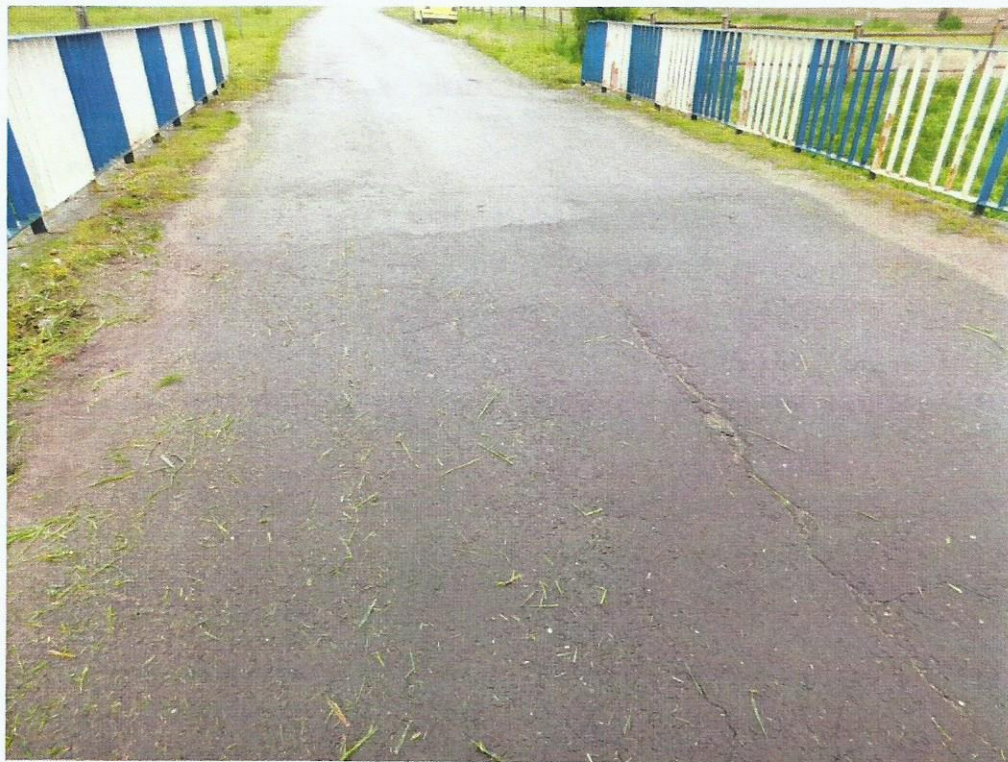
Siatki spękań oraz miejscowe ubytki nawierzchni bitumicznej na dojeździe spowodowane wieloletnią eksploatacją obiektu oraz osiadaniem podbudowy,
