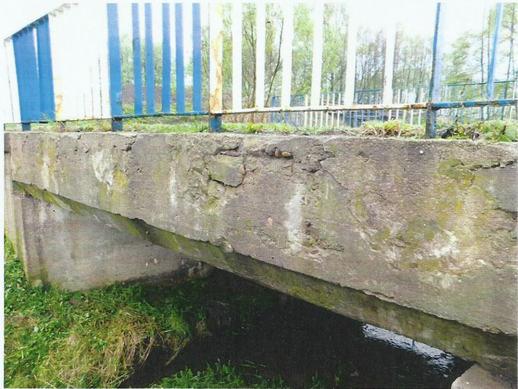
Rozległa i intensywna degradacja betonowej powierzchni belek podporęczowych stanowiących monolit z dźwigarem, spowodowana wieloletnią erozją.
