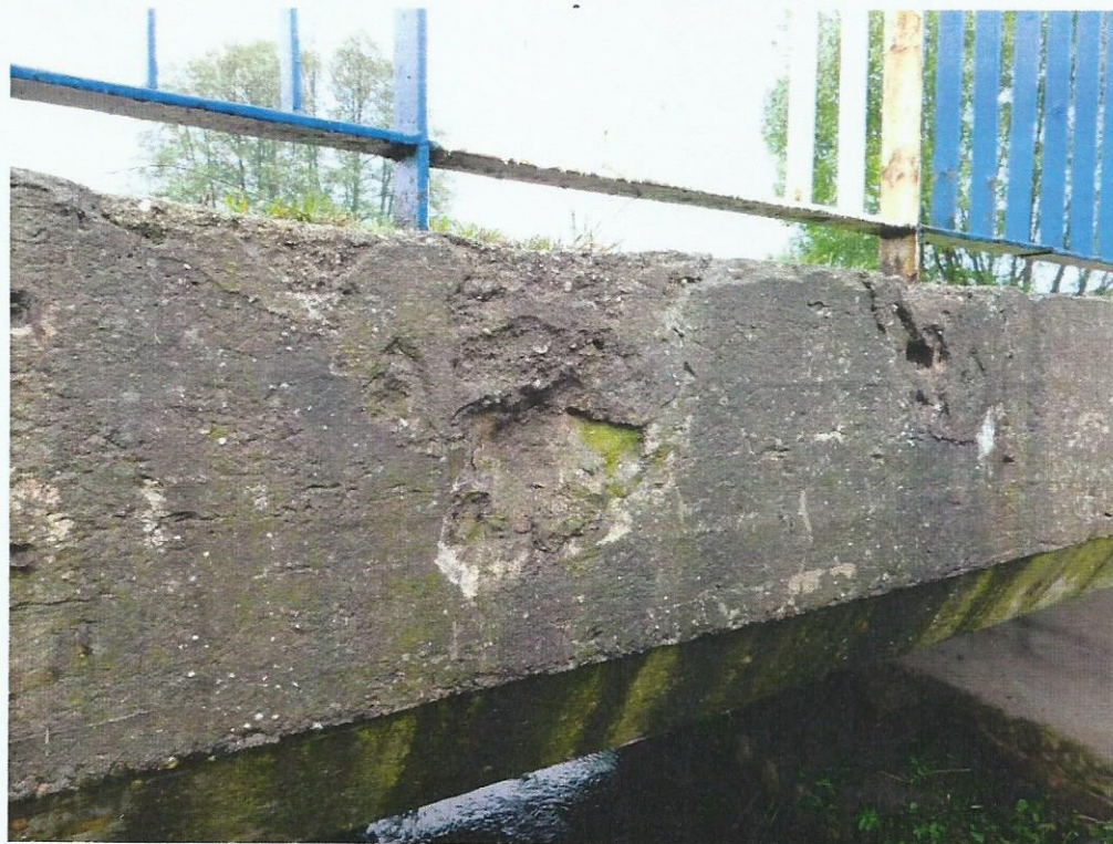
Rozległa i intensywna degradacja betonowej powierzchni belek podporęczowych stanowiących monolit z dźwigarem, spowodowana wieloletnią erozją.
