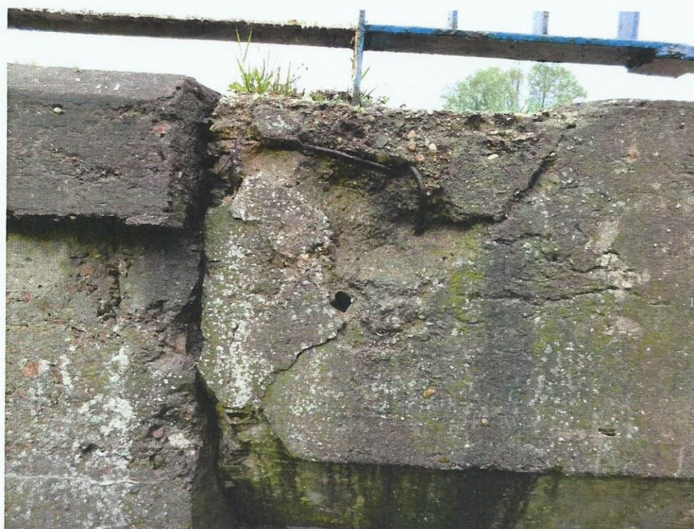
Ubytki betonu belek podporęczowych w obrębie szczeliny dylatacyjnej spowodowane zablokowaniem przesuwów. Widoczne osłonięte korodujące zbrojenie przyspieszające procesy degradacyjne.
