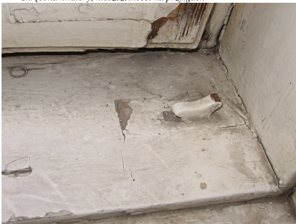
Unieruchomiony zaczep przeciwwiatrowy, ognicia narożnika kwatery od przeciekającej wody.
