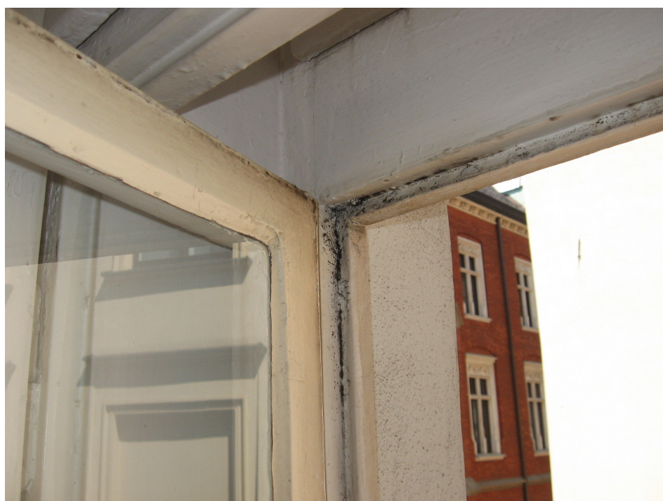
Czarne osady świadczące o nieszczelnościach na przylgach.
