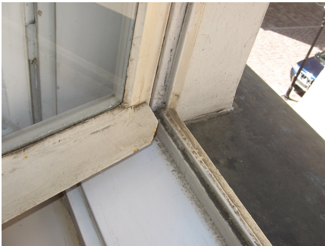
Czarne osady świadczące o nieszczelnościach na przylgach.
