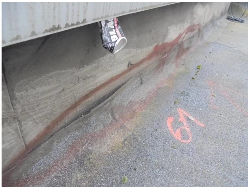
Foto 84. Nieszczelność nr 61 – odspojenie izolacji wodochronnej od ściany attyki.
