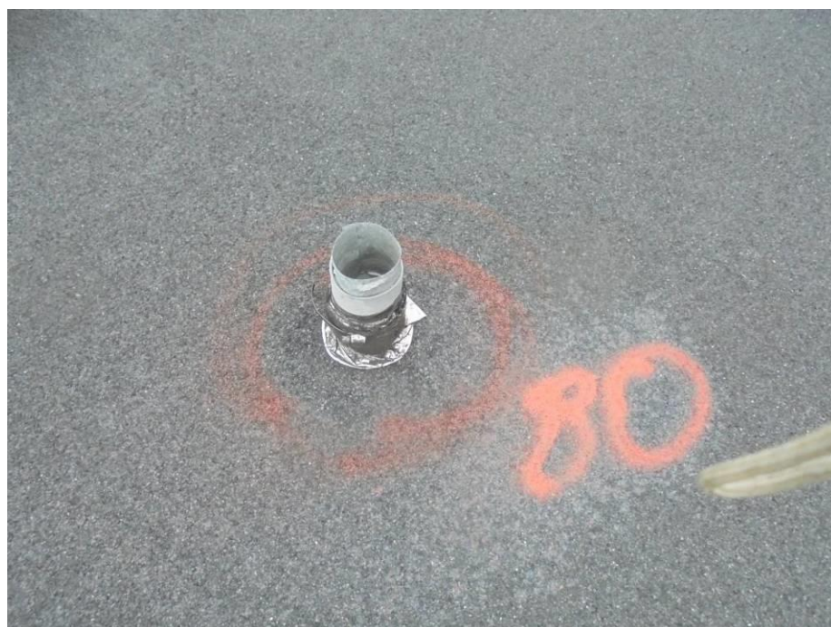
Foto 107. Nieszczelność nr 80 – brak uszczelnienia przebicia rurowego.
