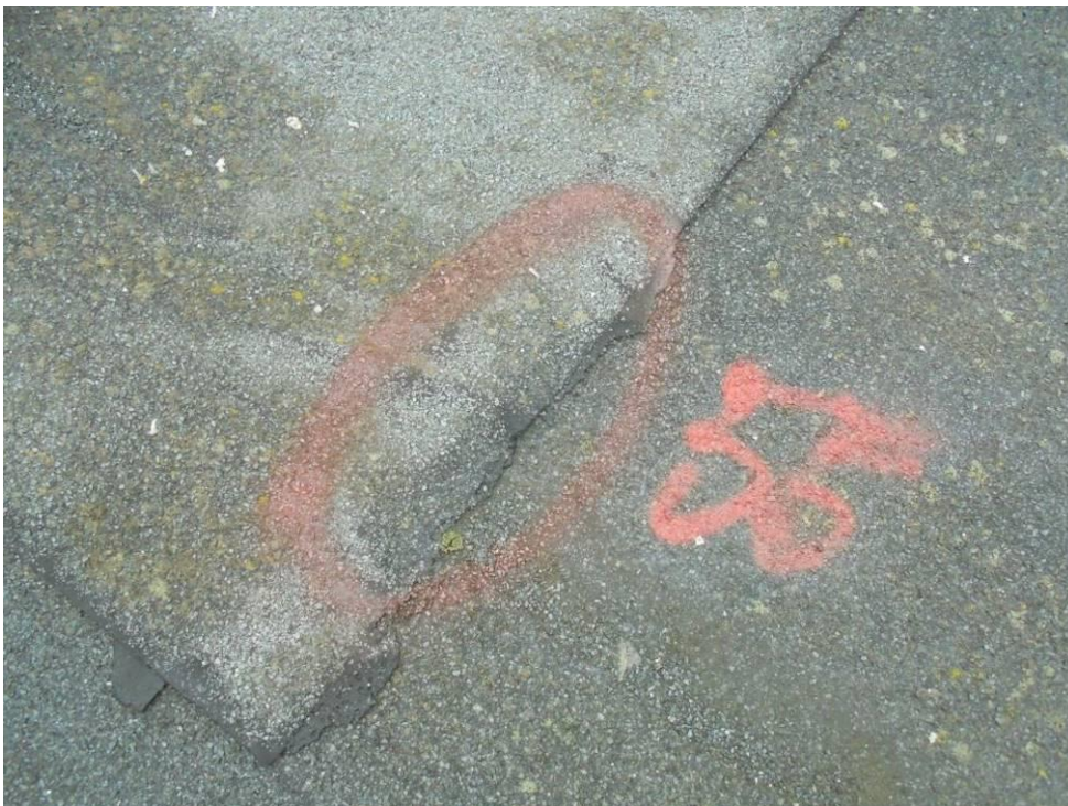
Foto 77. Nieszczelność nr 55 – rozszczerlenie styku pomiędzy sąsiednimi arkuszami papy.
