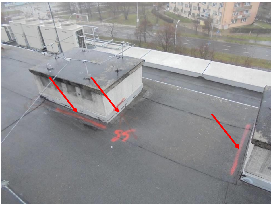
Foto 112. Nieszczelność nr 85 – brak szczelnego połączenia izolacji wodochronnej ze ścianami kominów.
