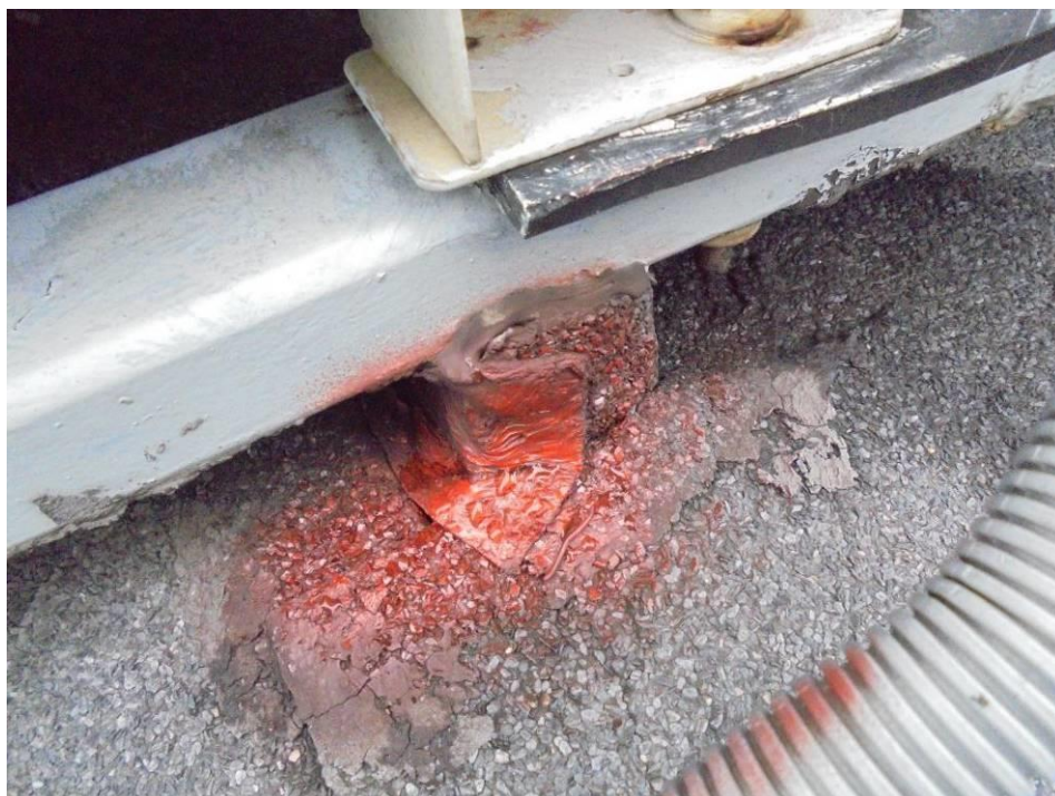
Foto 74. Nieszczelne połączenie papy z podstawą urządzenia.
