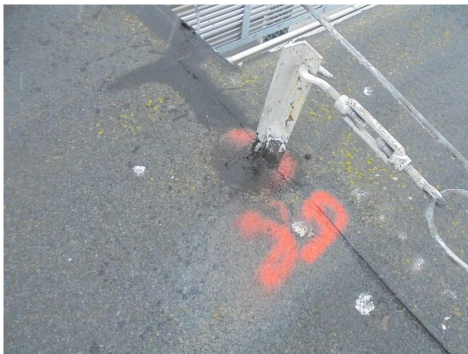
Foto 115. Nieszczelność nr 88 – brak prawidłowego uszczelnienia słupka mocującego instalację odgromową do połaci dachu.
