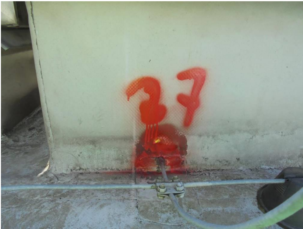
Foto 36. Nieszczelność nr 27 – nieszczelne przejście słupka instalacji odgromowej przez ścianę.
