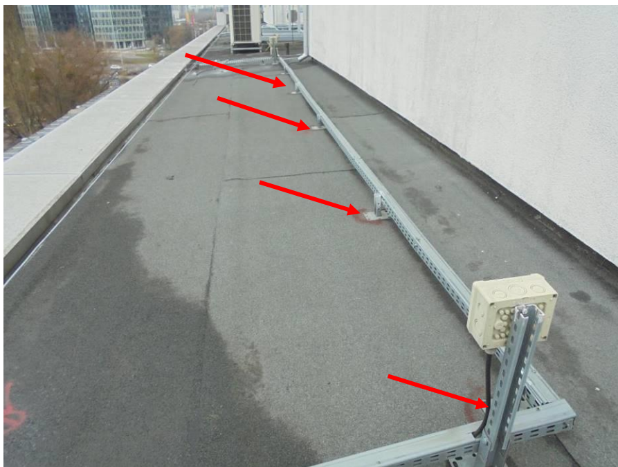
Foto 87. Nieszczelność nr 63 - brak uszczelnienia mocowania korytka kablowego do połaci dachu – patrz zbliżenie na foto poniżej.
