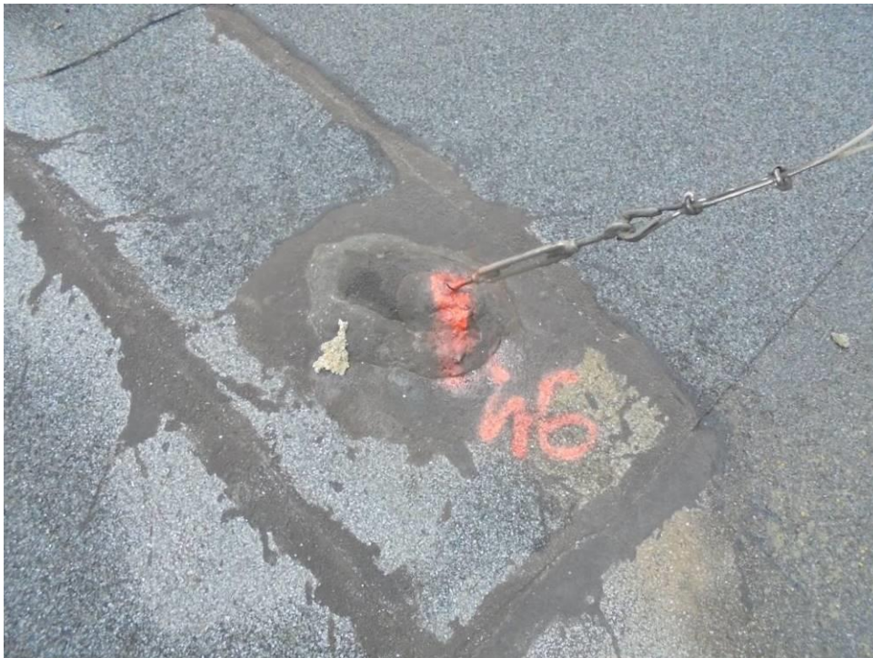
Foto 68. Nieszczelność nr 46 – brak prawidłowego uszczelnienia mocowania instalacji odgromowej do połaci dachu.
