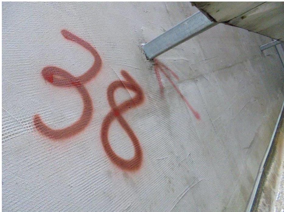
Foto 47. Nieszczelność nr 38 – brak prawidłowego uszczelnienia stalowej konstrukcji zamocowanej do ściany budynku.
