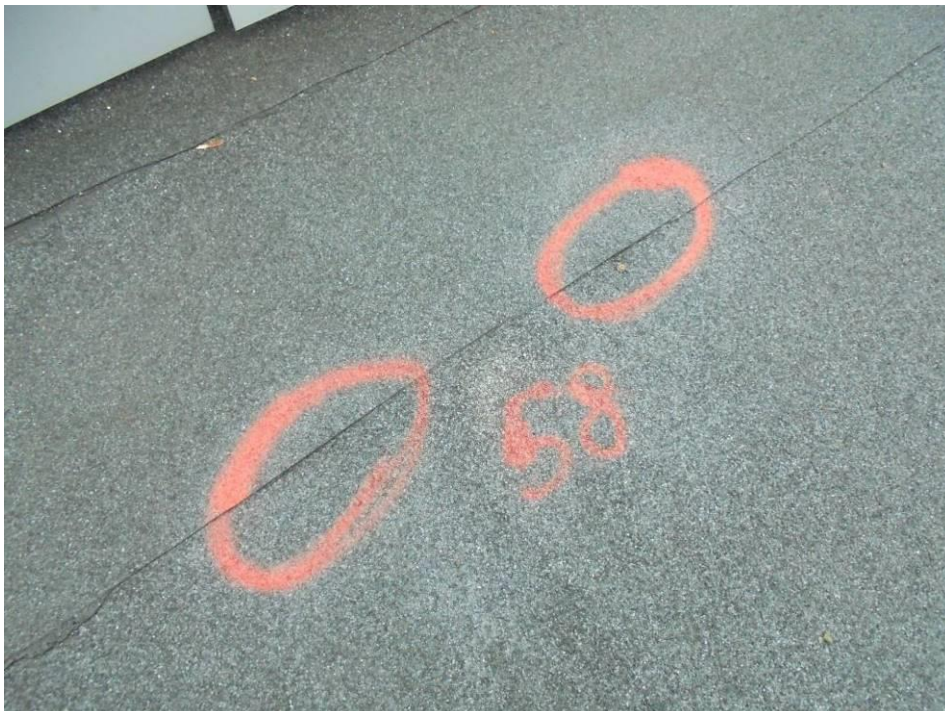
Foto 81. Nieszczelność nr 58 – rozszczelnienia styków pomiędzy sąsiednimi arkuszami papy.
