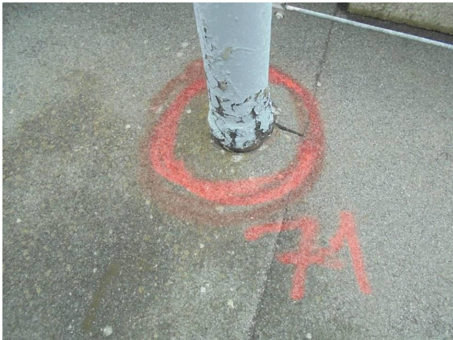
Foto 97. Nieszczelność nr 71 – nieszczelny styk izolacji wodochronnej z przebiciem rurowym.
