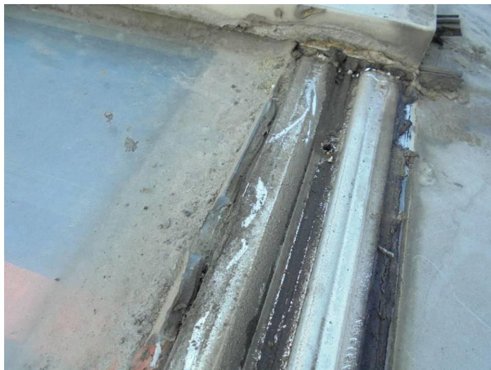
Foto 57. Zdegradowana uszczelka pomiędzy przeszkleniem świetlika a profilem poprzecznym. Woda spływająca ze świetlika zatrzymuje się na listwie poprzecznej i z powodu braku uszczelki penetruje do wnętrza budynku.
