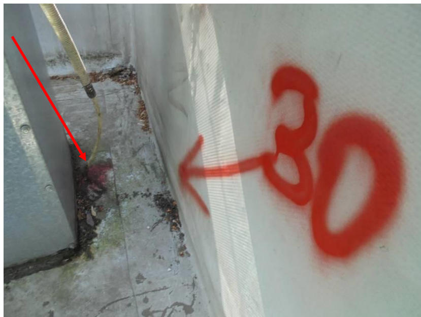
Foto 39. Nieszczelność nr 30 – brak prawidłowego uszczelnienia przejścia kabli przez połączenie dachu.
