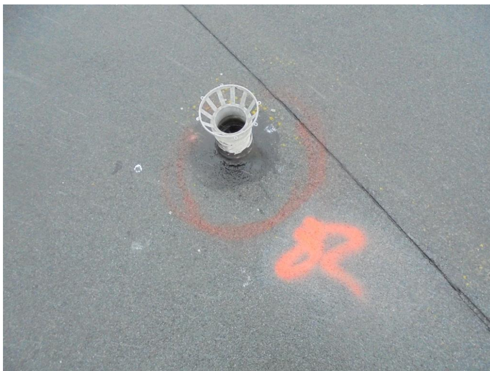
Foto 109. Nieszczelność nr 82 – brak uszczelnienia przebicia rurowego.
