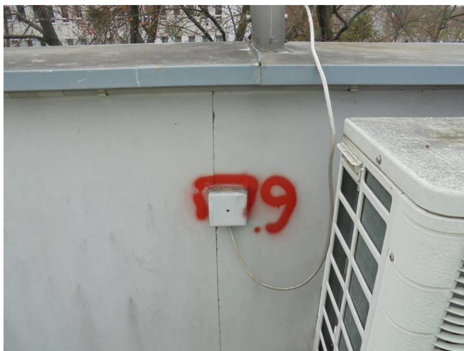
Foto 17. Nieszczelność nr 9 – nieszczelne połączenie pionowej izolacji wodochronnej z plastikową obudową.
