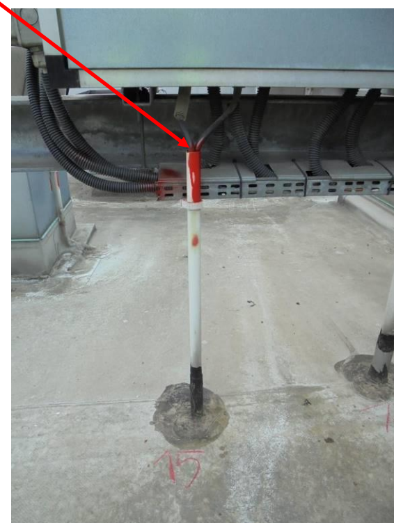
Foto 23. Nieszczelność nr 15 – opis jw.
