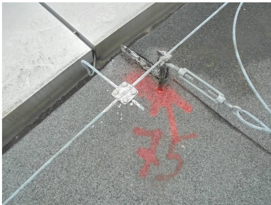
Foto 101. Nieszczelność nr 75 - brak prawidłowego uszczelnienia mocowania instalacji odgromowej do połaci dachu.
