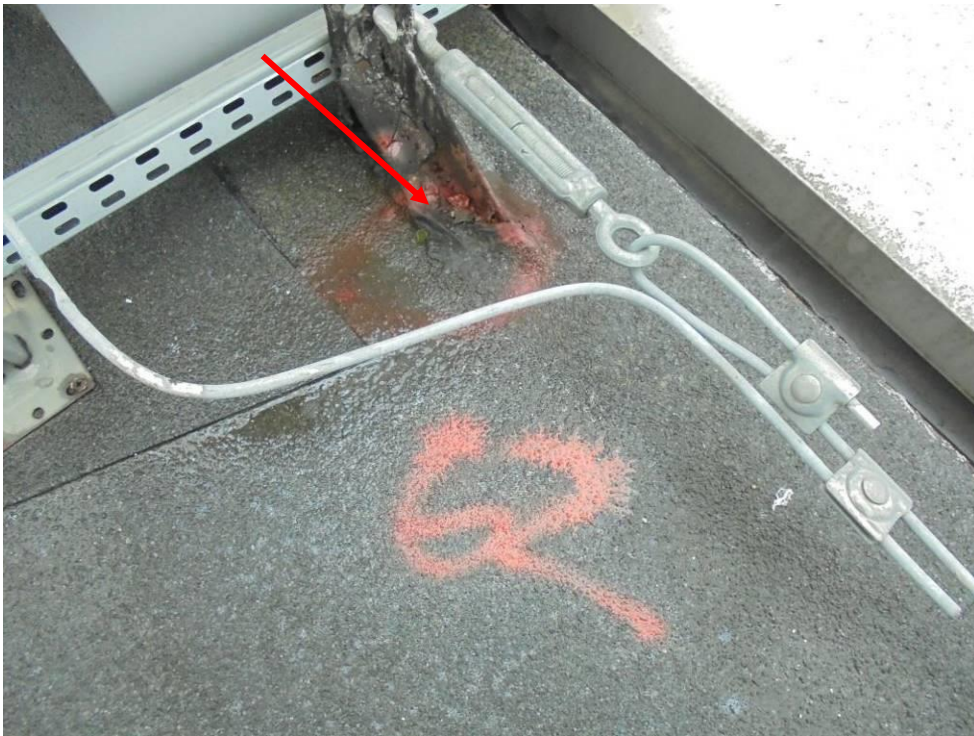
Foto 86. Nieszczelność nr 62 - brak prawidłowego uszczelnienia mocowania instalacji odgromowej do połaci dachu.
