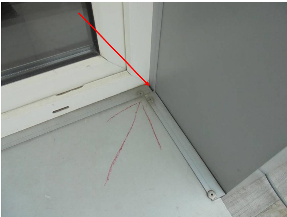
Foto 5. Nieszczelność nr 1 - woda wcieka pomiędzy parapet podokienny i okładzinę ścienną a następnie wpływa za izolację wodochronną i penetruje do wnętrza budynku.
