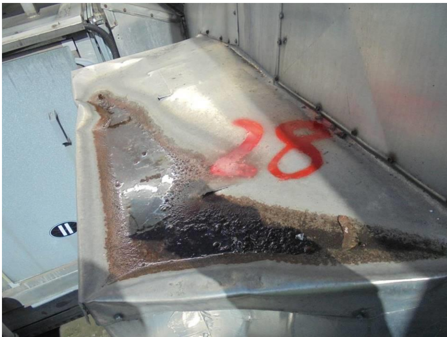
Foto 37. Nieszczelność nr 28 – uszkodzona obudowa kanału wentylacyjnego.
