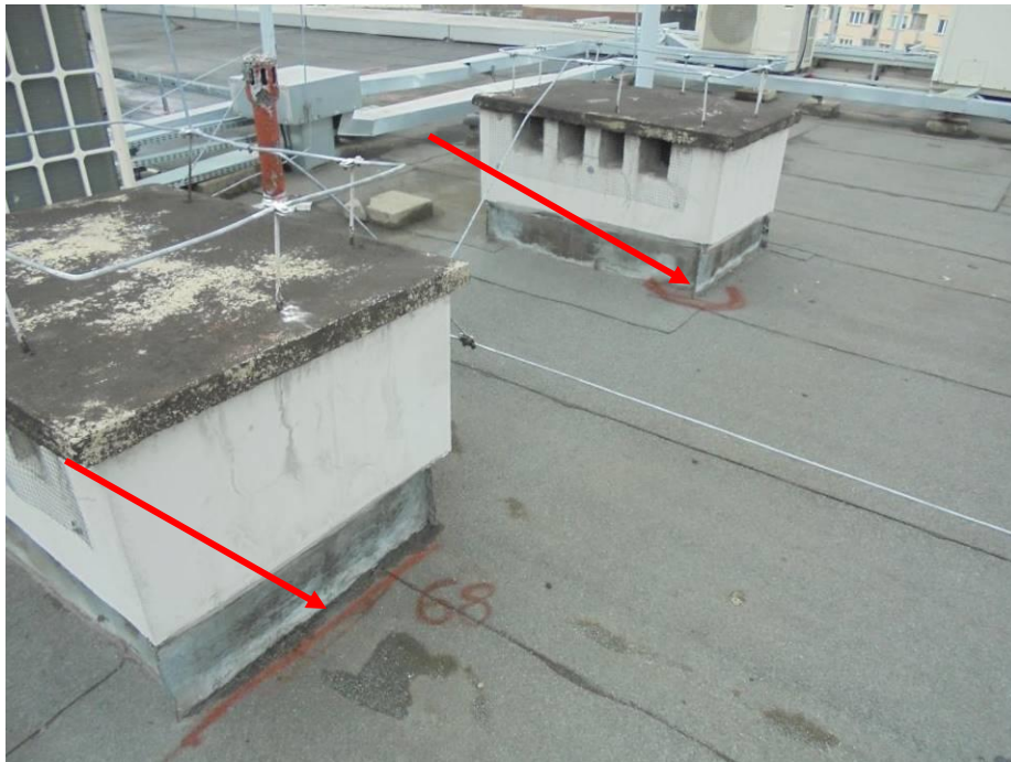
Foto 94. Nieszczelność nr 68 – nieszczelny styk izolacji wodochronnej z ścianami komina.
