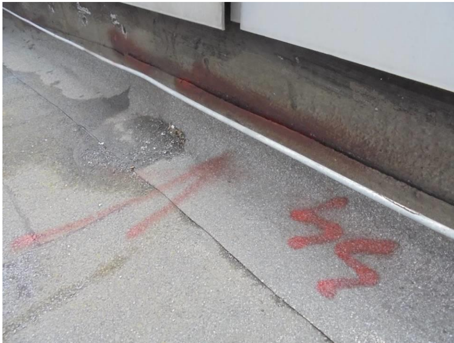
Foto 66. Nieszczelność nr 44 – odspojenie izolacji wodochronnej od ściany atyki.
