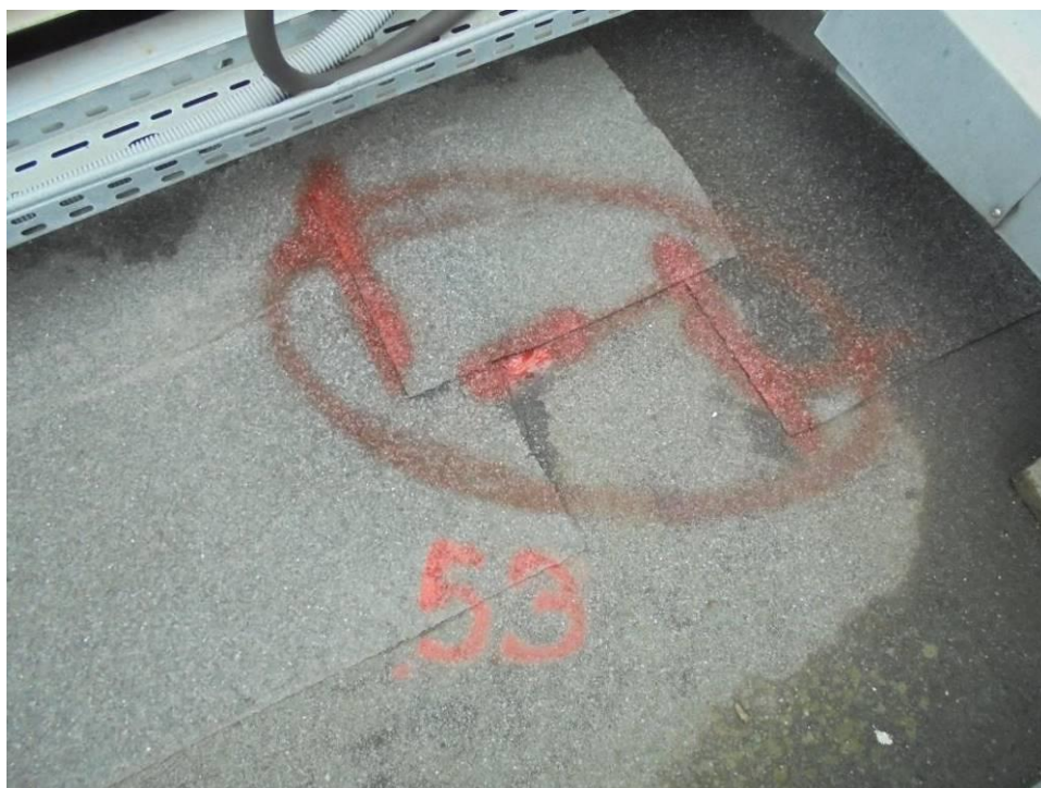
Foto 75. Nieszczelność nr 53 – rozszczelnienie styku pomiędzy sąsiednimi arkuszami papy.
