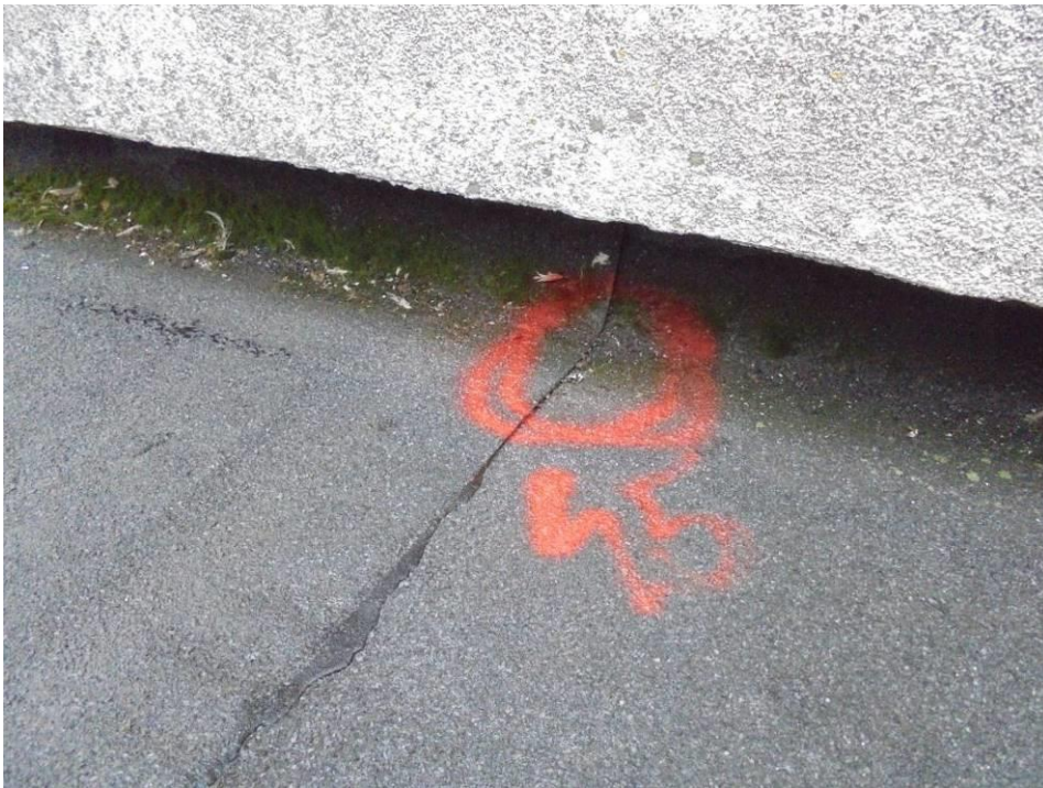
Foto 67. Nieszczelność nr 45 – rozszczelnienie styku pomiędzy sąsiednimi arkuszami papy.
