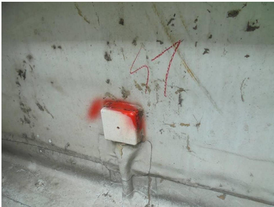
Foto 53. Nieszczelność nr 41 – nieszczelne połączenie pionowej izolacji wodochronnej z plastikową obudową.
