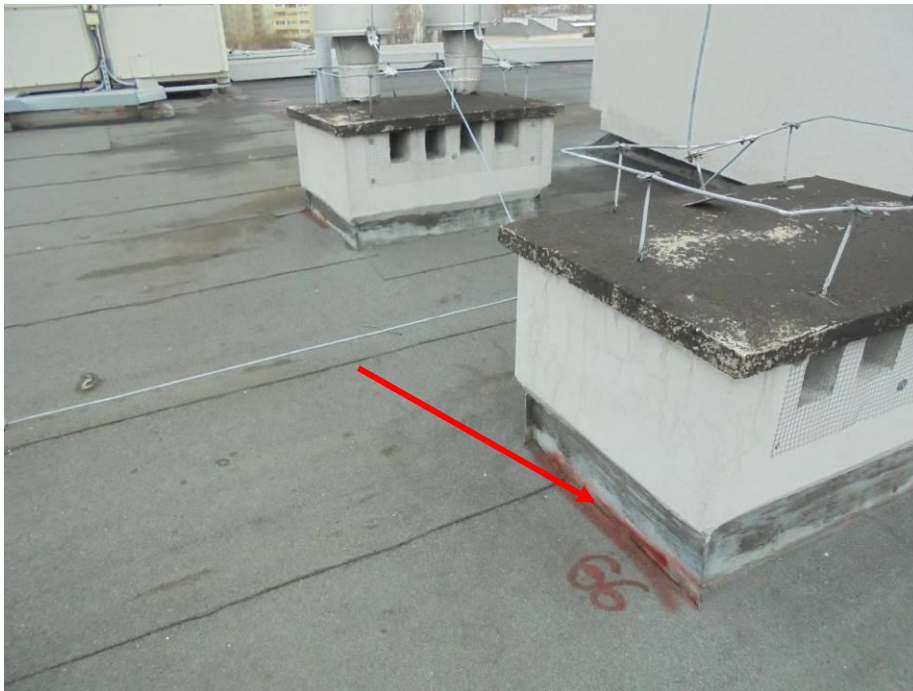
Foto 92. Nieszczelność nr 66 – nieszczelny styk izolacji wodochronnej z ścianami komina.
