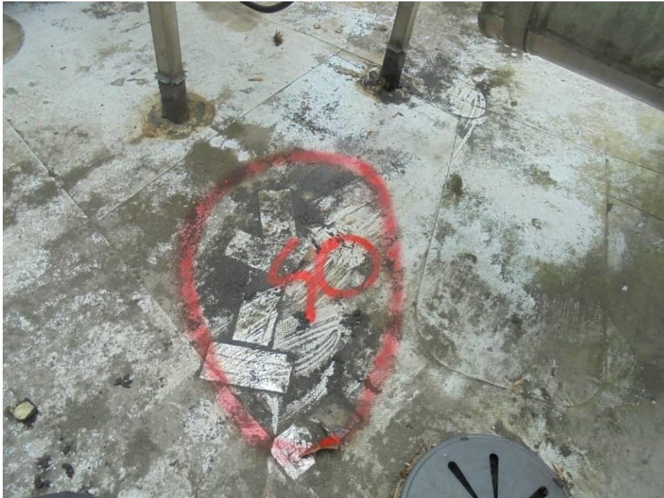
Foto 52. Nieszczelność nr 40 – odspojenie taśmy w miejscu nieprawidłowo wykonanej naprawy nieszczelności na połaci dachu.
