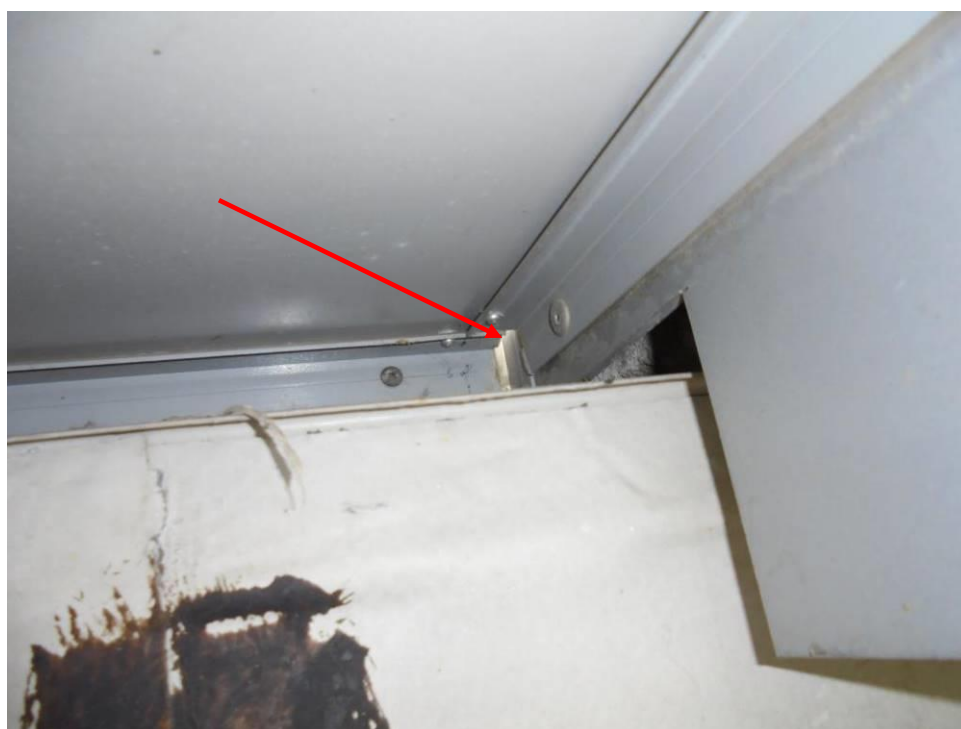
Foto 7. Widoczne szczeliny pomiędzy parapetem i okładziną elewacyjną (widok od spodu parapetu) przez które woda wpływa do wnętrza przegrody.
