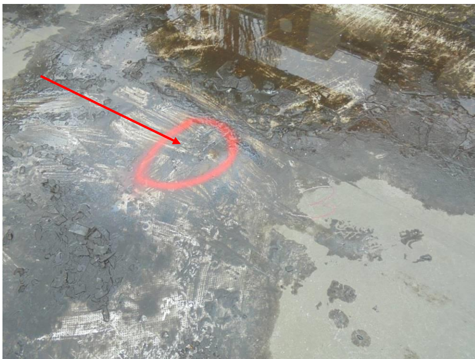
Foto 9. Nieszczelność nr 3 – uszkodzenie mechaniczne izolacji wodochronnej.
