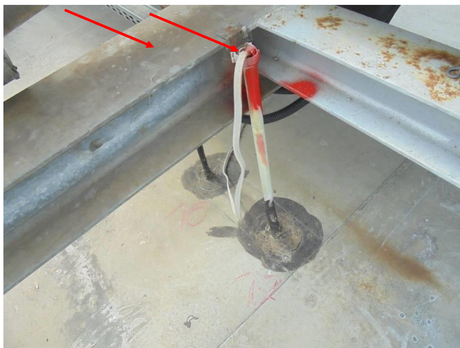
Foto 24. Nieszczelność nr 16,17 – opis jw.
