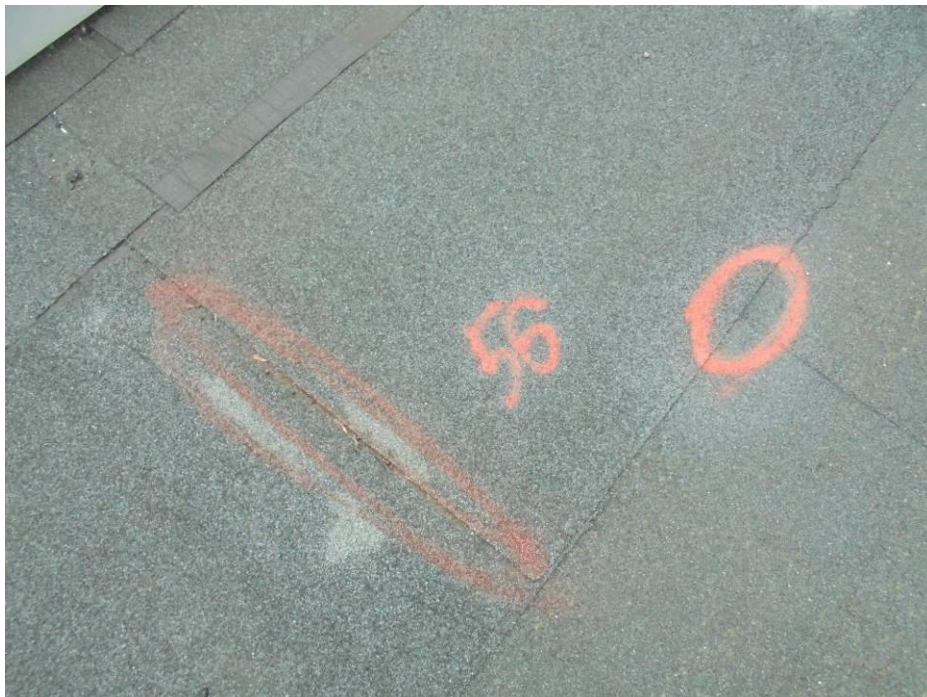
Foto 79. Nieszczelność nr 56 – rozszczelnienia styków pomiędzy sąsiednimi arkuszami papy.
