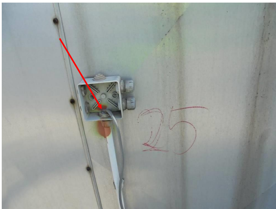
Foto 33. Nieszczelność nr 25 – nieszczelny wlot osłonki kabli przechodzących przez izolację wodochronną wprowadza wodę od góry pod membranę.
