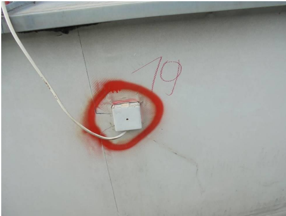
Foto 26. Nieszczelność nr 19 – nieszczelne połączenie pionowej izolacji wodochronnej z plastikową obudową.
