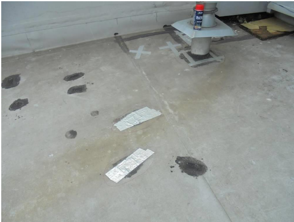
Foto 3. Na dachu widoczne są liczne naprawy izolacji wodochronnej wykonane przy użyciu masy płynnej lub taśmy butylowej. Taki sposób naprawy nie gwarantuje długotrwałej szczelności.
