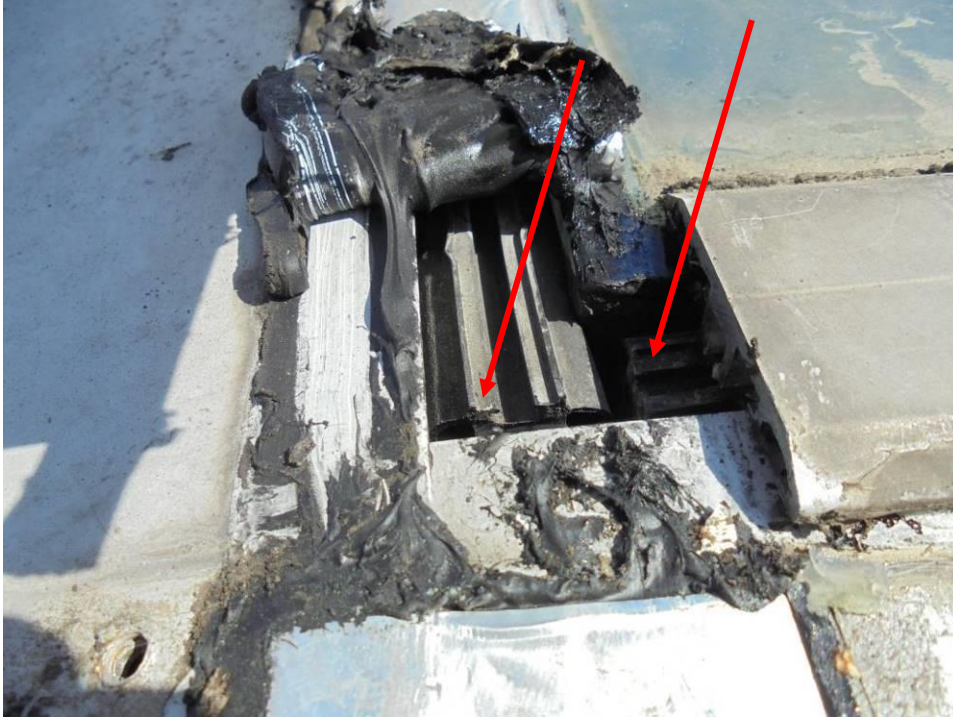
Foto 62. Widoczne profile odprowadzające skropliny ze świetlika. Profile te najprawdopodobniej w wyniku procesów starzeniowych, uległy skurczeniu i w chwili obecnej wprowadzają skropliny do wnętrza obiektu.
