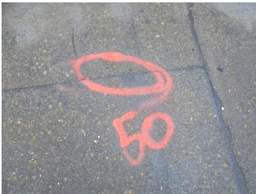
Foto 71. Nieszczelność nr 50 – rozszczelnienie styku pomiędzy sąsiednimi arkuszami papy.
