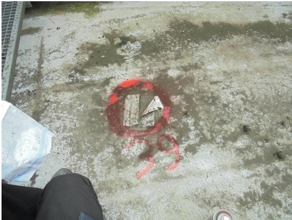
Foto 51. Nieszczelność nr 39 – odspojenie taśmy w miejscu nieprawidłowo wykonanej naprawy nieszczelności na połaci dachu.
