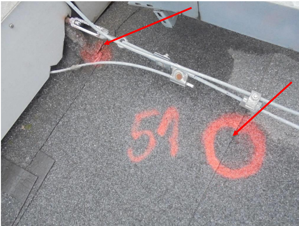
Foto 72. Nieszczelność nr 51 – rozszczelnienia styków pomiędzy sąsiednimi arkuszami papy.
