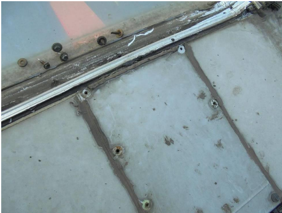
Foto 58. Widoczna korozja śrub mocujących dolną obróbkę blacharska świetlika świadczy o wciekaniu wody po śrubach do wnętrza przegrody.
