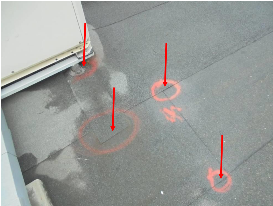
Foto 76. Nieszczelność nr 54 – rozszczerlenia styków pomiędzy sąsiednimi arkuszami papy oraz nieszczelne połączenie papy z podstawami urządzenia .
