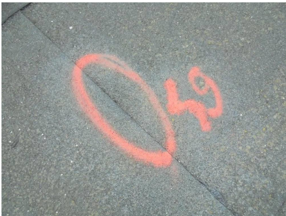
Foto 70. Nieszczelność nr 49 – rozszczelnienie styku pomiędzy sąsiednimi arkuszami papy.
