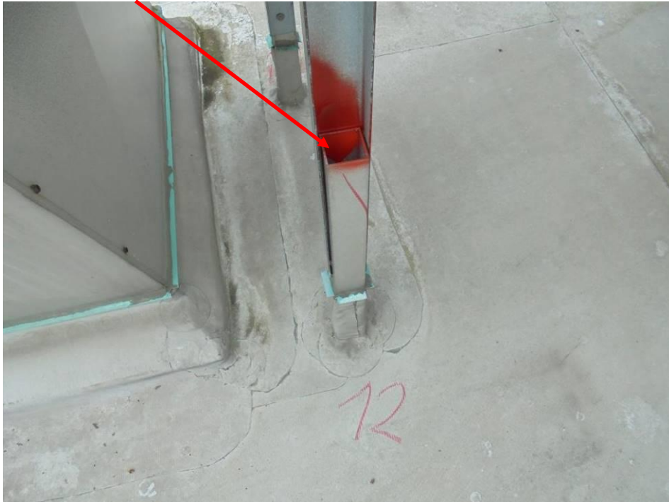
Foto 20. Nieszczelność nr 12 – brak zabezpieczenia słupka podkonstrukcji przed wciekaniem wody opadowej.
