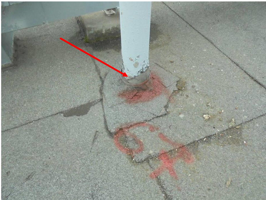
Foto 93. Nieszczelność nr 67 – nieszczelny styk izolacji wodochronnej z przebiciem rurowym.
