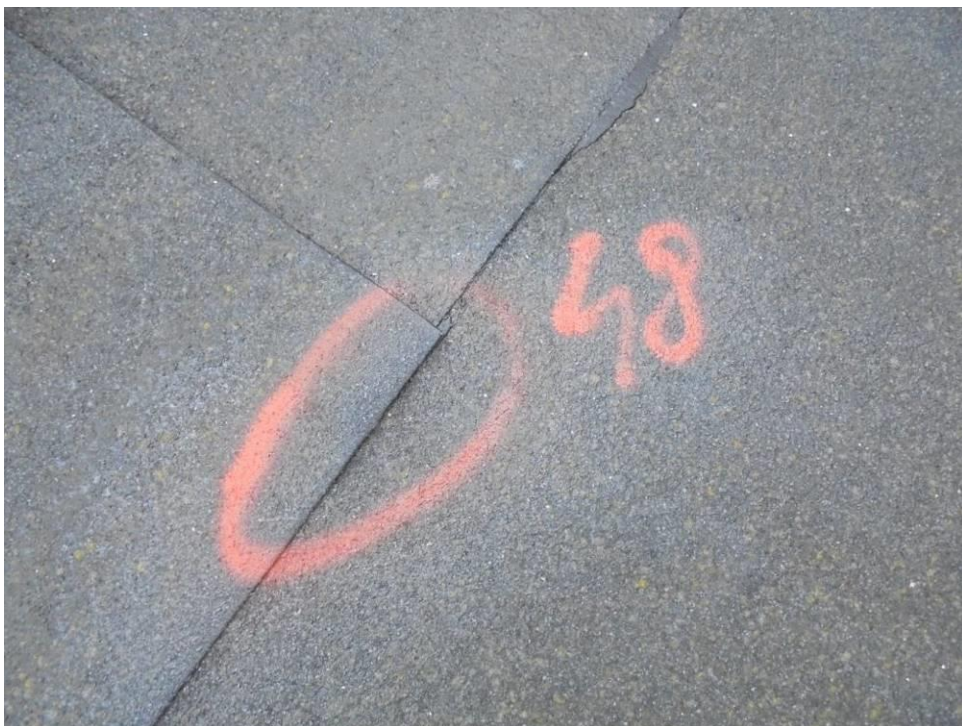
Foto 69. Nieszczelność nr 48 – rozszczelnienie styku pomiędzy sąsiednimi arkuszami papy.
