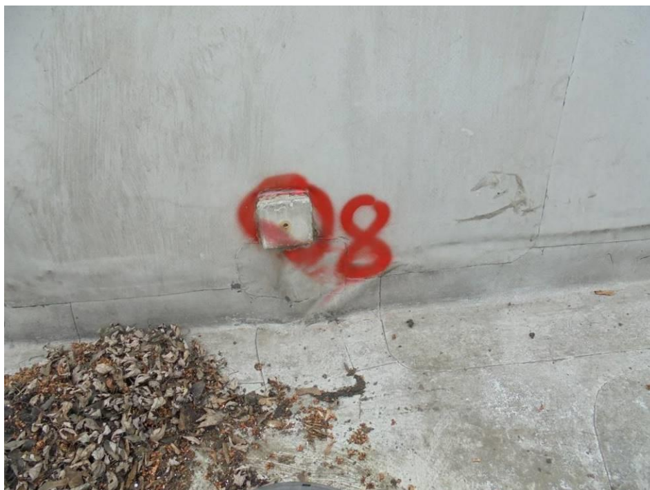
Foto 16. Nieszczelność nr 8 – nieszczelne połączenie pionowej izolacji wodochronnej z plastikową obudową.
