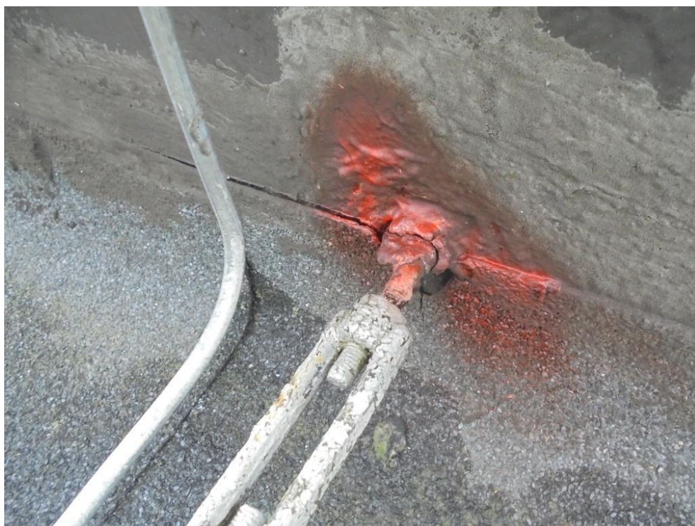
Foto 85. Brak prawidłowego uszczelnienia mocowania instalacji odgromowej do ściany attyki.
