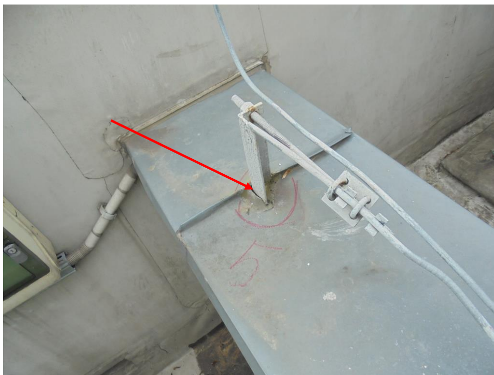
Foto 11. Nieszczelność nr 5 – brak uszczelnienia mocowania instalacji odgromowej do atyki.
