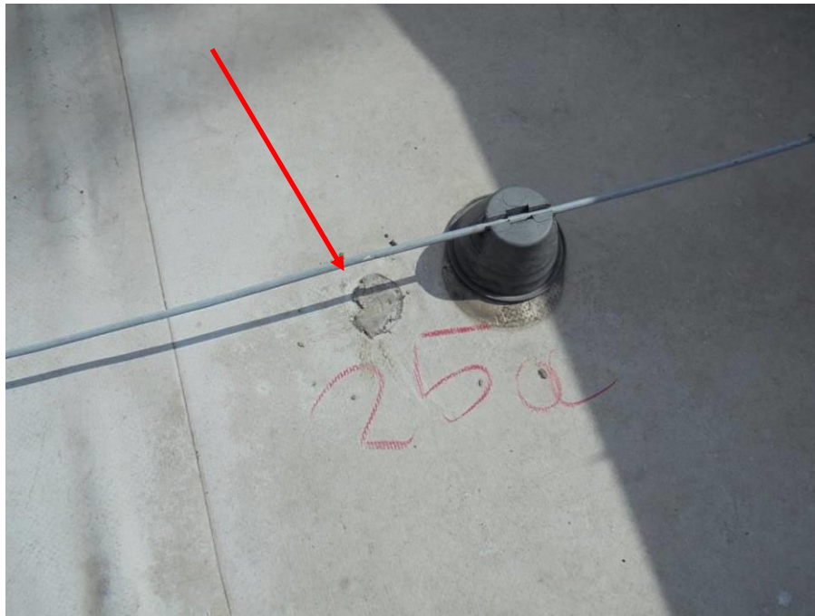
Foto 34. Nieszczelność nr 25a – uszkodzenie mechaniczne izolacji wodochronnej na połaci dachu.
