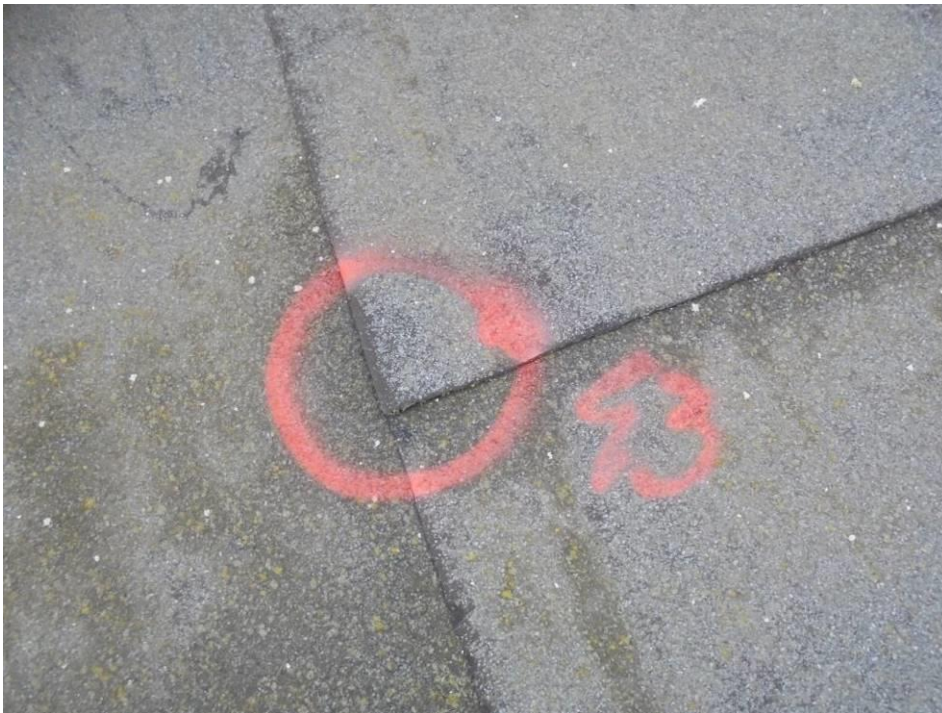
Foto 65. Nieszczelność nr 43 – rozszczelnienie styku pomiędzy sąsiednimi arkuszami papy.
