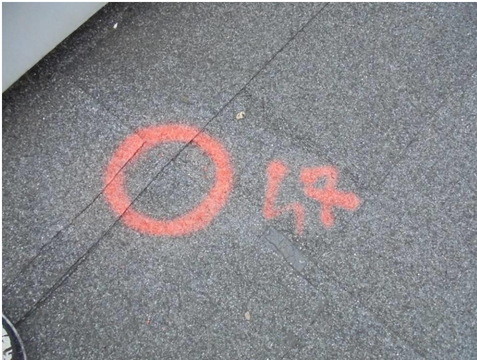
Foto 68. Nieszczelność nr 47 – rozszczelnienie styku pomiędzy sąsiednimi arkuszami papy.
