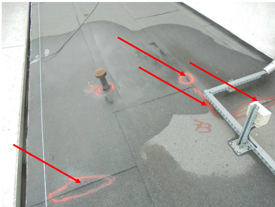
Foto 99. Nieszczelność nr 73 – rozszczelnienia styków pomiędzy sąsiednimi arkuszami papy.
