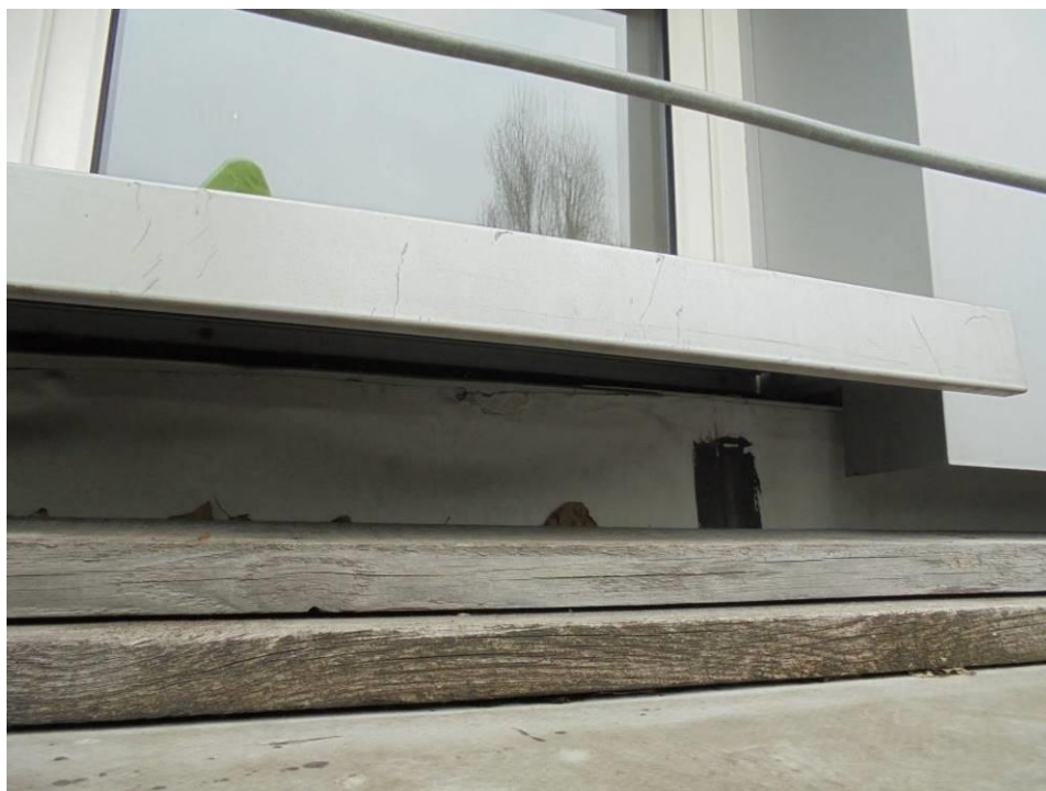
Foto 6. Widoczny styk izolacji wodochronnej ze ścianą budynku pod parapetem – patrz również foto poniżej.
