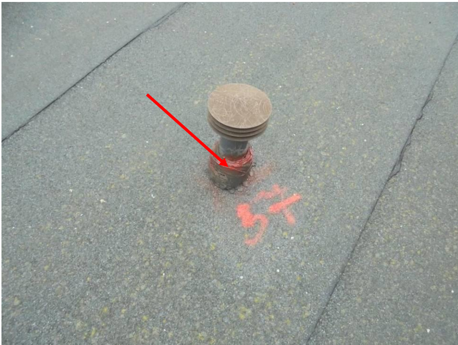
Foto 80. Nieszczelność nr 57 - nieszczelny styk izolacji wodochronnej z kominkiem wentylacyjnym.
