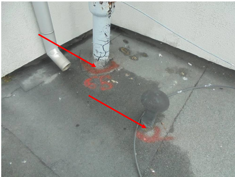
Foto 91. Nieszczelność nr 65 – nieszczelny styk izolacji wodochronnej z przebiciem rurowym i kominkiem wentylacyjnym.
