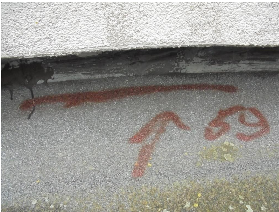
Foto 82. Nieszczelność nr 59 – nieszczelny styk izolacji wodochronnej ze ścianą budynku (brak mocowania mechanicznego papy).
