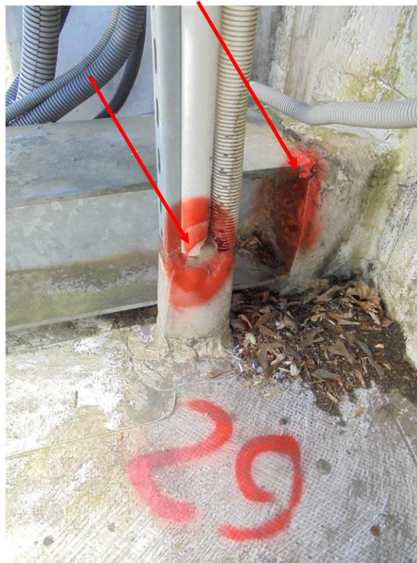
Foto 38. Nieszczelność nr 29 – brak prawidłowego uszczelnienia przejścia kabli przez połączenie dachu oraz przejścia metalowej konstrukcji przez ścianę.
