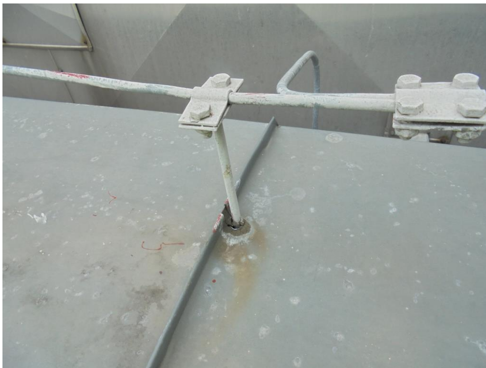
Foto 13. Brak uszczelnienia mocowania instalacji odgromowej do atyki.
