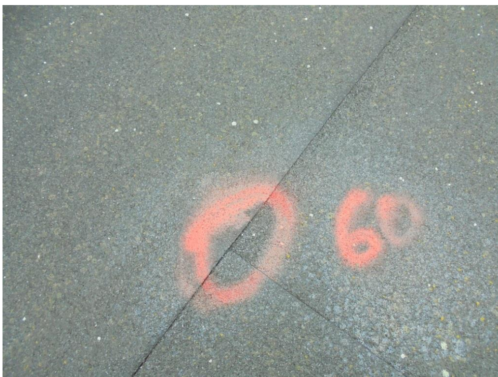
Foto 83. Nieszczelność nr 60 – rozszczelnienie styku pomiędzy sąsiednimi arkuszami papy.
