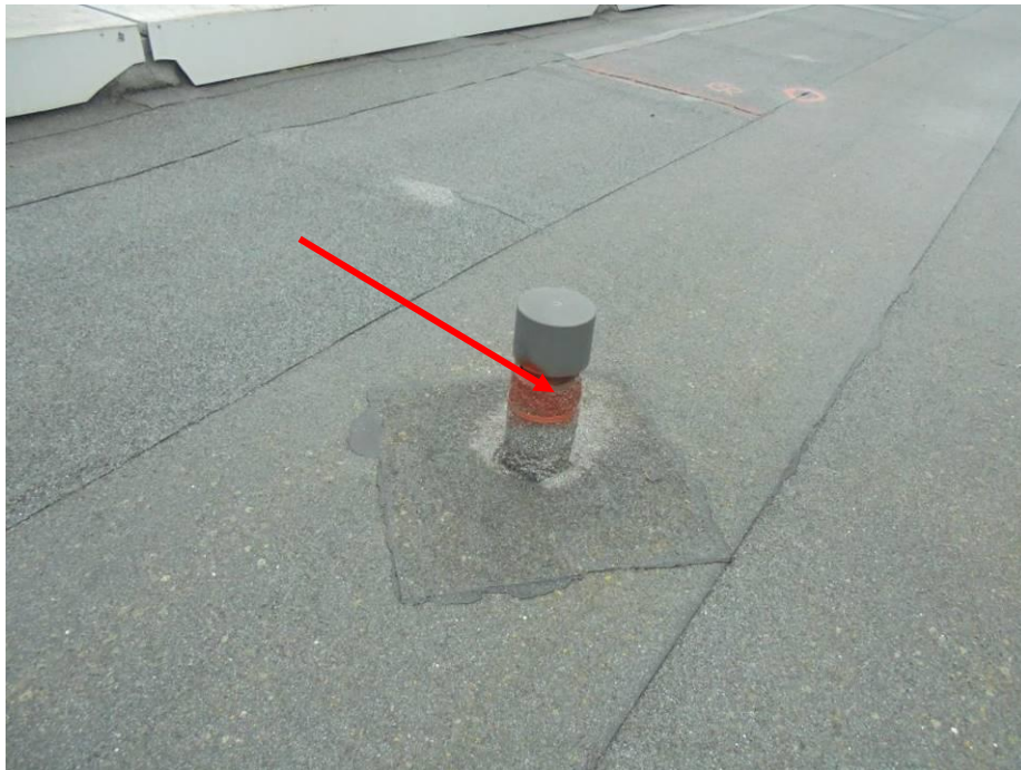
Foto 78. Nieszczelny styk izolacji wodochronnej z kominkiem wentylacyjnym.
