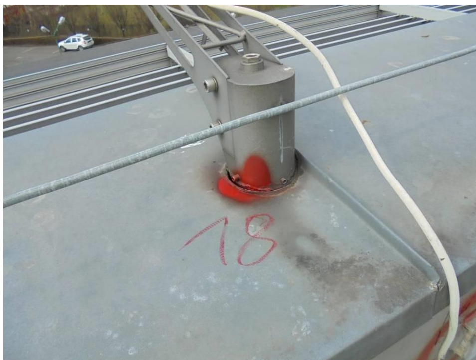
Foto 25. Nieszczelność nr 18 – brak uszczelnienia mocowania podkonstrukcji do atyki.
