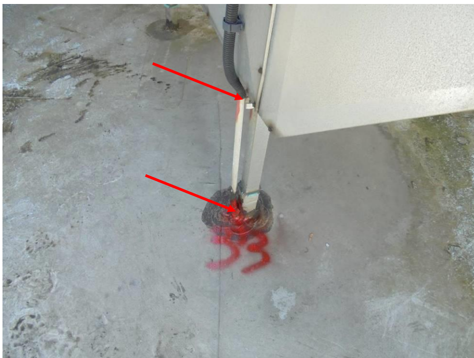
Foto 42. Nieszczelność nr 33 – nieszczelność w miejscu przejścia słupka podkonstrukcji przez połąć dachu. Ponadto nieszczelny wlot osłonki kabli przechodzących przez izolację wodochronną wprowadza wodę od góry pod membranę.
