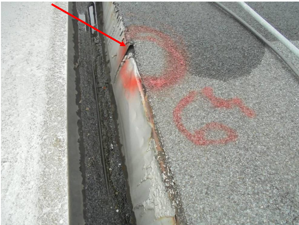
Foto 89. Nieszczelność nr 64 – nieszczelność na styku pomiędzy papą a obróbkami blacharskimi na krawędzi zewnętrznej dachu (przy korycie).
