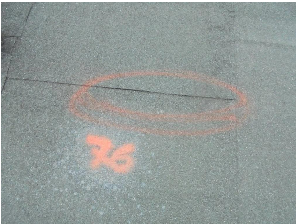
Foto 103. Nieszczelność nr 76 – rozszczelnienie styku pomiędzy sąsiednimi arkuszami papy.
