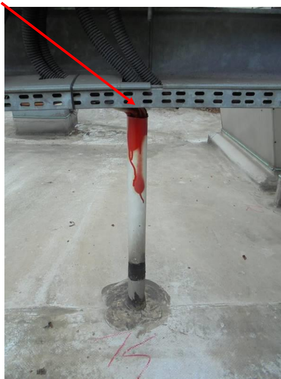
Foto 22. Nieszczelność nr 14 – nieszczelny wlot osłonki kabli przechodzących przez izolację wodochronną wprowadza wodę od góry pod membranę.
