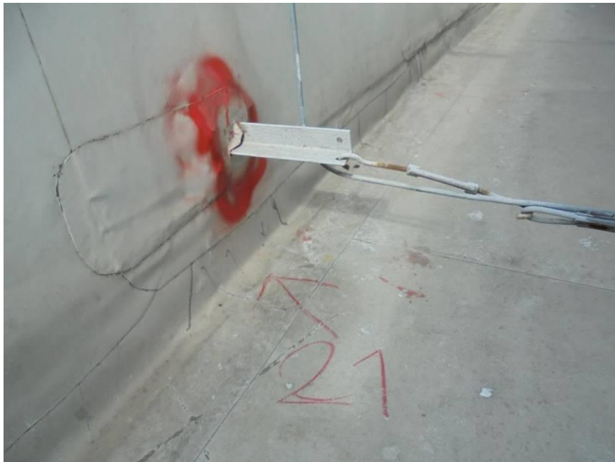
Foto 28. Nieszczelność nr 21 – nieszczelne przejście słupka instalacji odgromowej przez ścianę.
