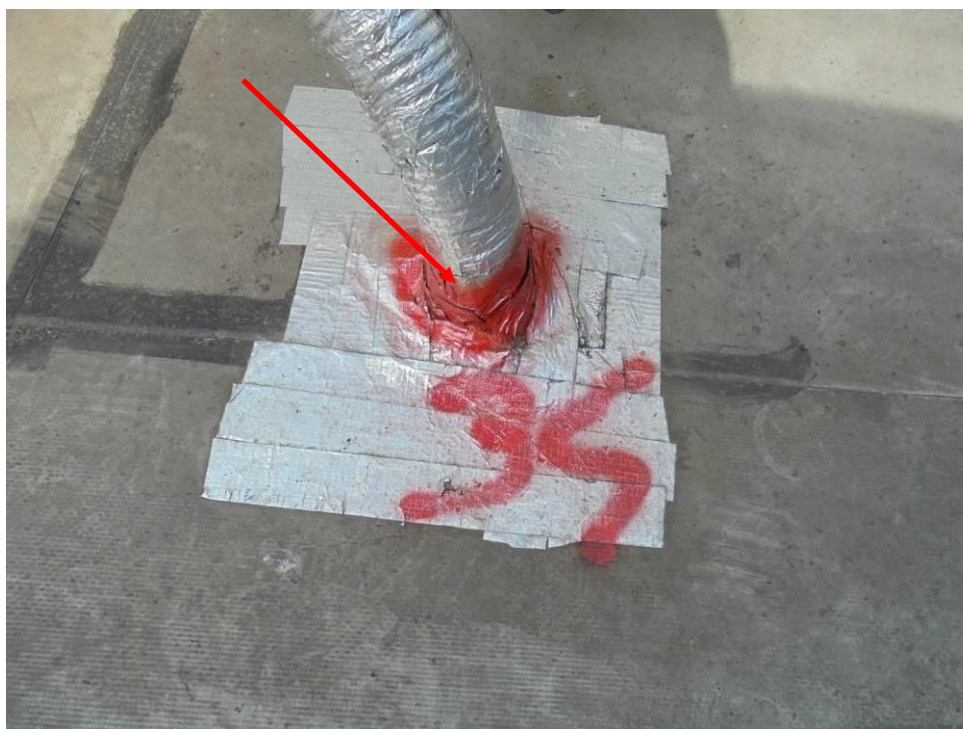
Foto 43. Nieszczelność nr 34 – nieprawidłowo uszczelnione przejście kabli w peszlu przez połąć dachu.
