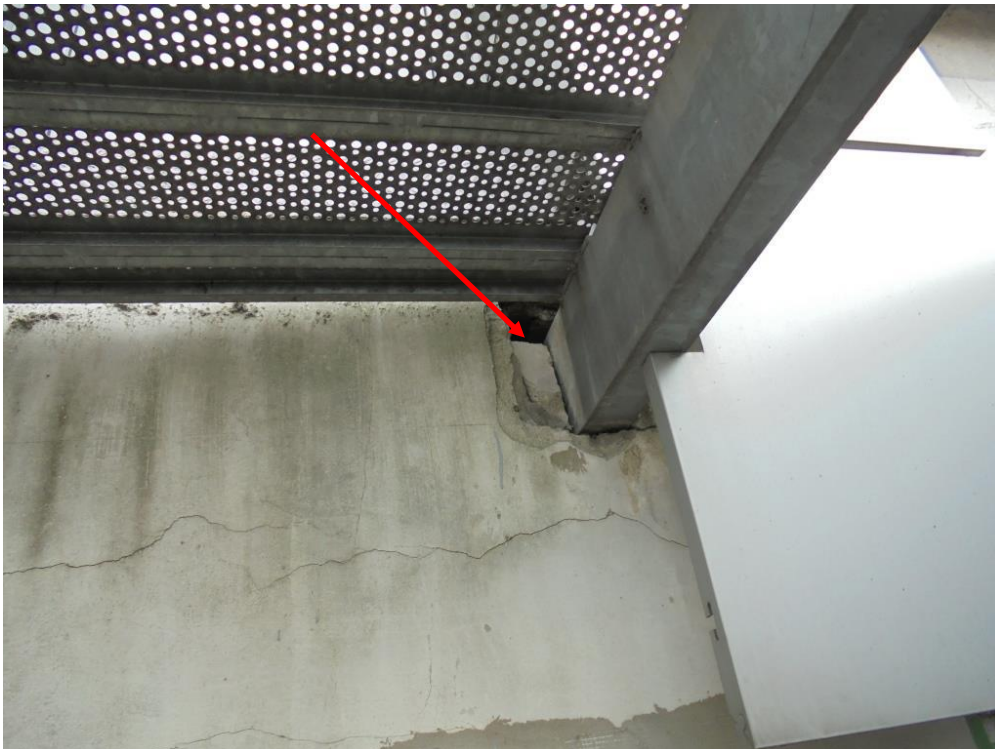
Foto 50. Ubytek elewacji w miejscu mocowania konstrukcji stalowej do ściany przy progu drzwi.
