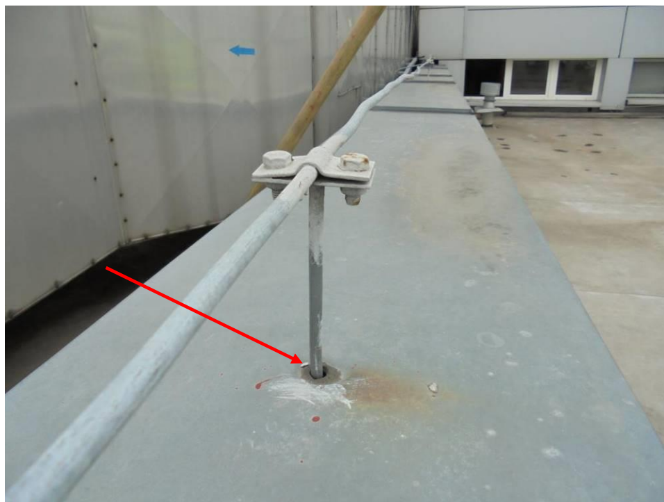
Foto 12. Brak uszczelnienia mocowania instalacji odgromowej do atyki.
