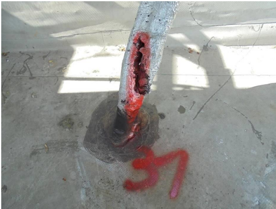
Foto 40. Nieszczelność nr 31 – brak prawidłowego uszczelnienia przejścia kabli przez połączenie dachu.
