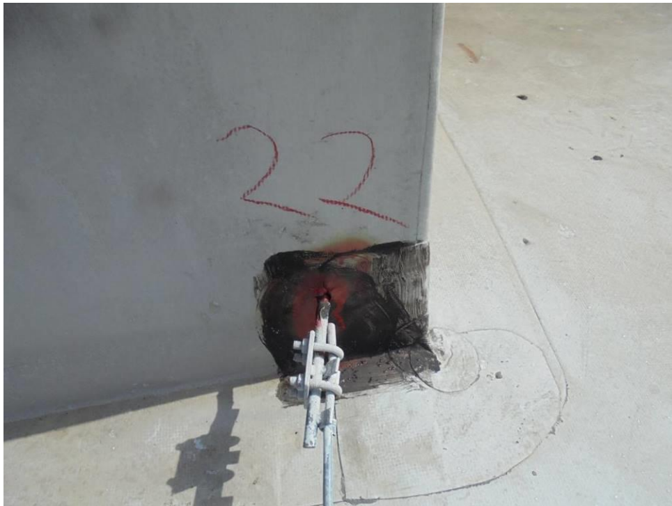
Foto 30. Nieszczelność nr 22 – nieszczelne mocowanie instalacji odgromowej do ściany.
