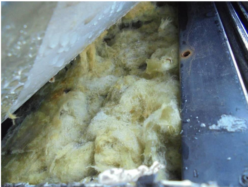
Foto 59. Widoczna wilgoć pomiędzy dolnym profilem świetlika a ociepleniem na jego podstawie (pod membrana PVC).
