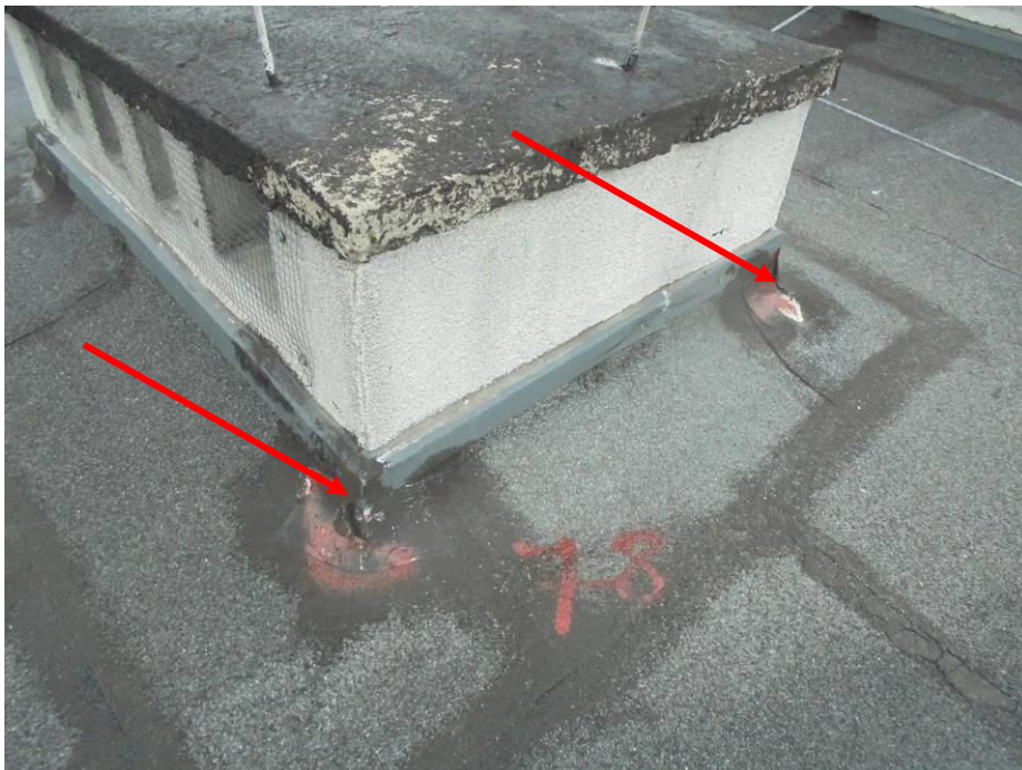
Foto 105. Nieszczelność nr 78 – rozszczelnienia izolacji wodochronnej w narożach komina.
