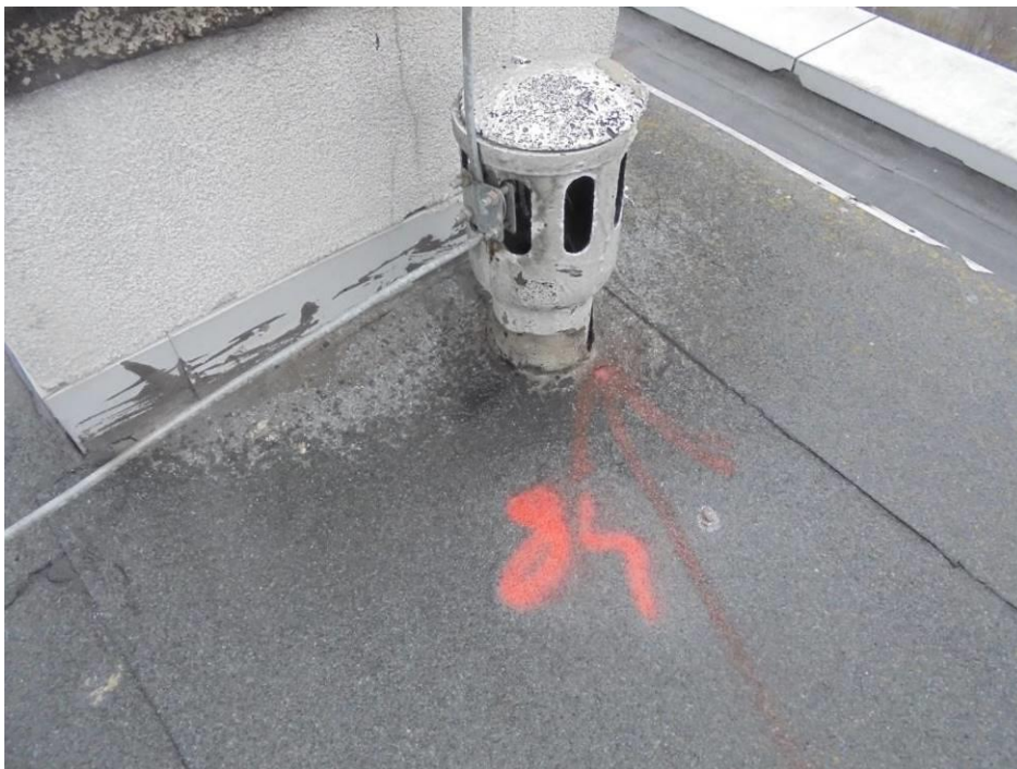
Foto 111. Nieszczelność nr 84 – brak szczelnego połączenia izolacji wodochronnej z kominkiem wentylacyjnym.
