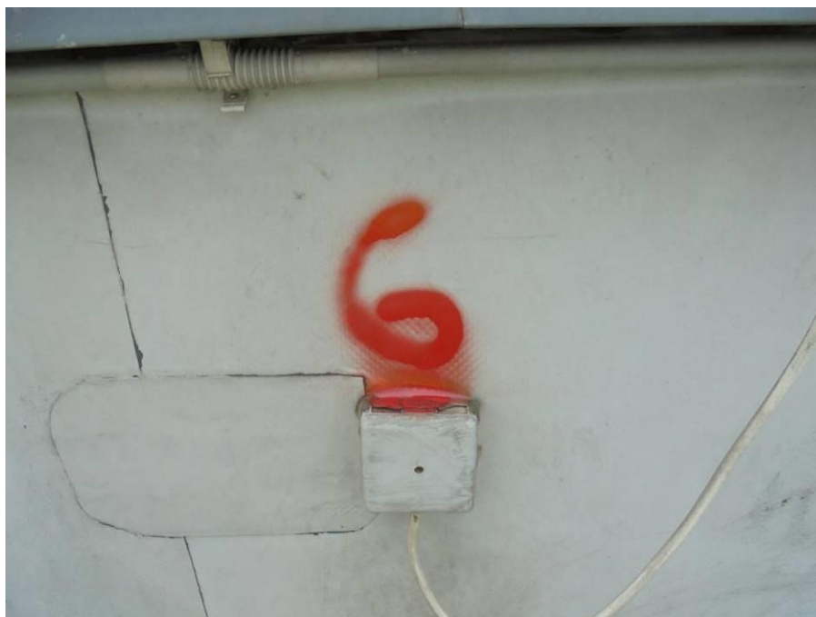
Foto 14. Nieszczelność nr 6 – nieszczelne połączenie pionowej izolacji wodochronnej z plastikową obudową.
