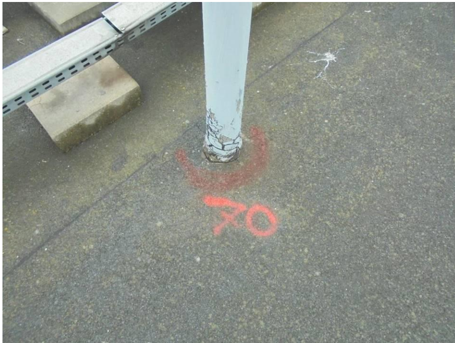
Foto 96. Nieszczelność nr 70 – nieszczelny styk izolacji wodochronnej z przebiciem rurowym.
