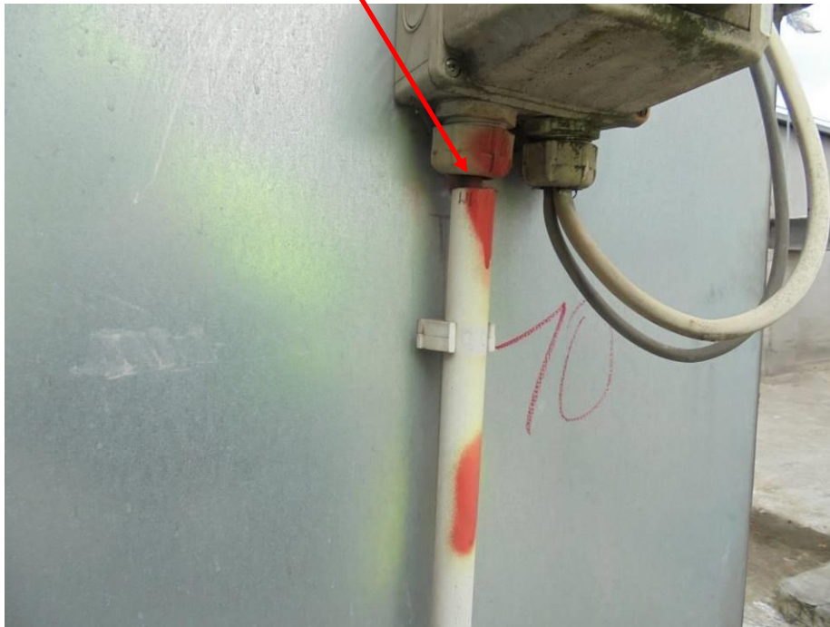
Foto 18. Nieszczelność nr 10 – nieszczelny wlot osłonki kabli przechodzących przez izolację wodochronną wprowadza wodę od góry pod membranę.
