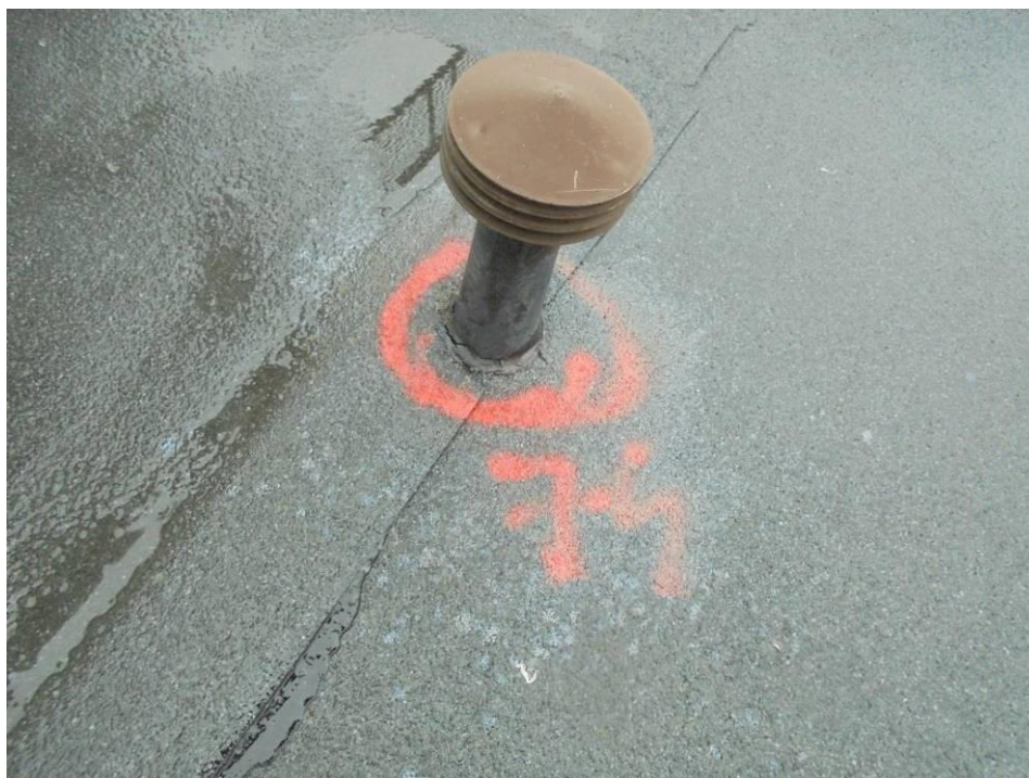
Foto 100. Nieszczelność nr 74 – nieszczelny styk izolacji wodochronnej z kominkiem wentylacyjnym.
