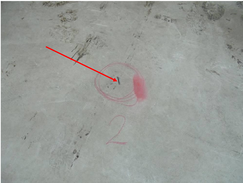
Foto 8. Nieszczelność nr 2 – uszkodzenie mechaniczne izolacji wodochronnej.
