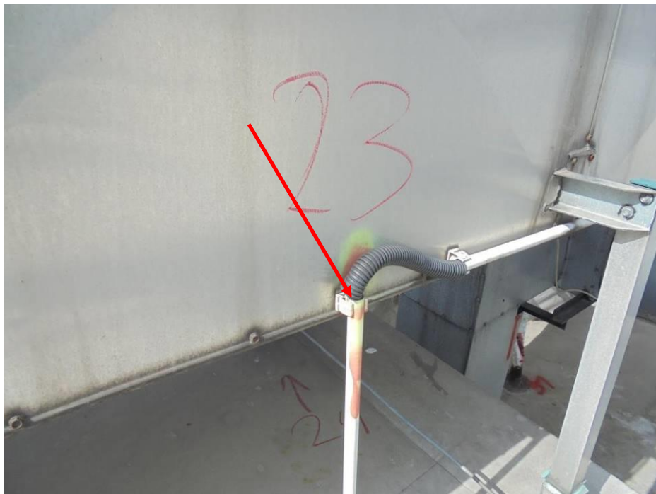
Foto 31. Nieszczelność nr 23 – nieszczelny wlot osłonki kabli przechodzących przez izolację wodochronną wprowadza wodę od góry pod membranę.
