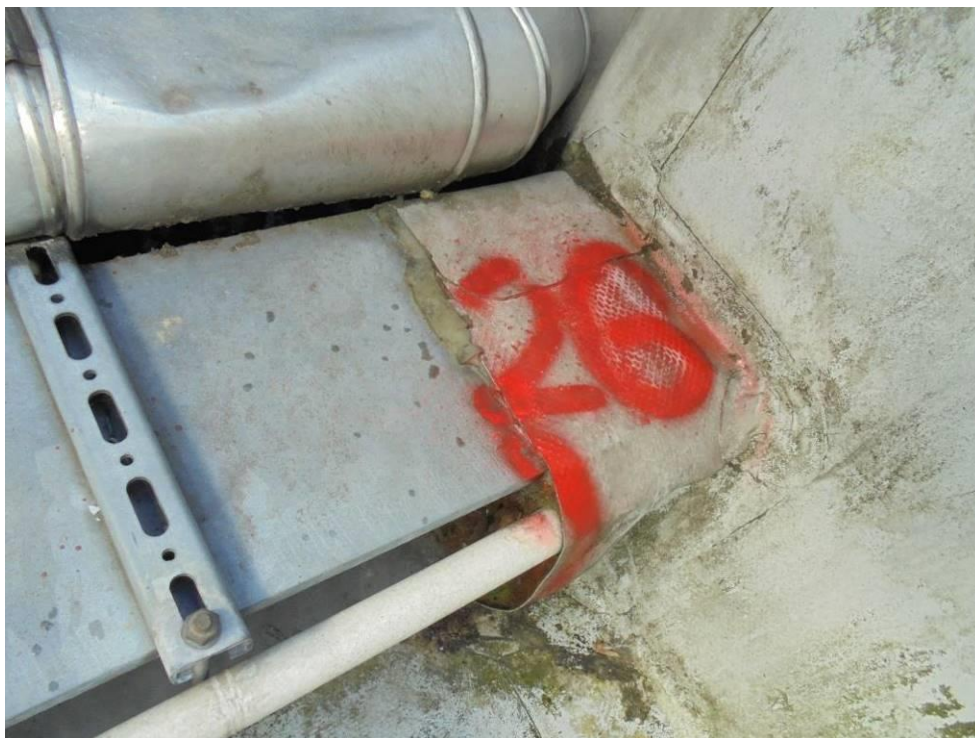
Foto 35. Nieszczelność nr 26 – brak prawidłowego uszczelnienia przejścia korytka kablowego przez ścianę budynku.
