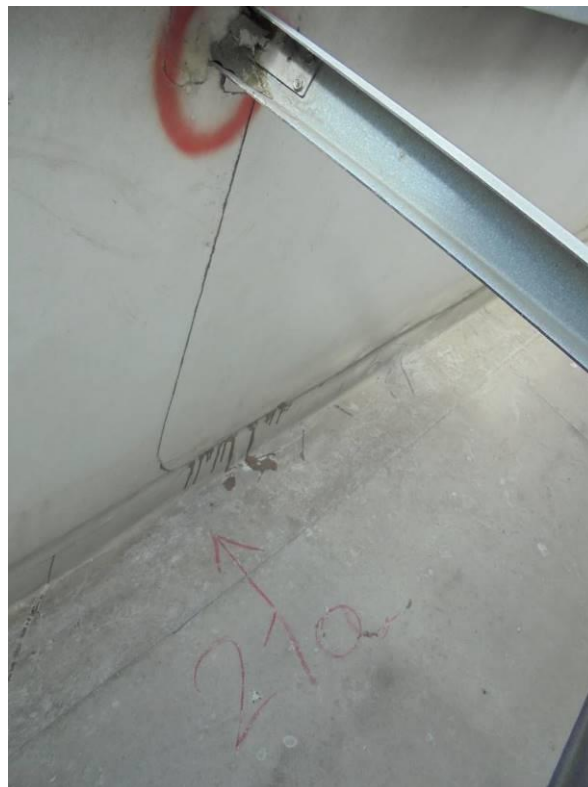
Foto 29. Nieszczelność nr 21a – brak prawidłowego połączenia izolacji wodochronnej na attyce ze stalową konstrukcją przebijającą membranę.
