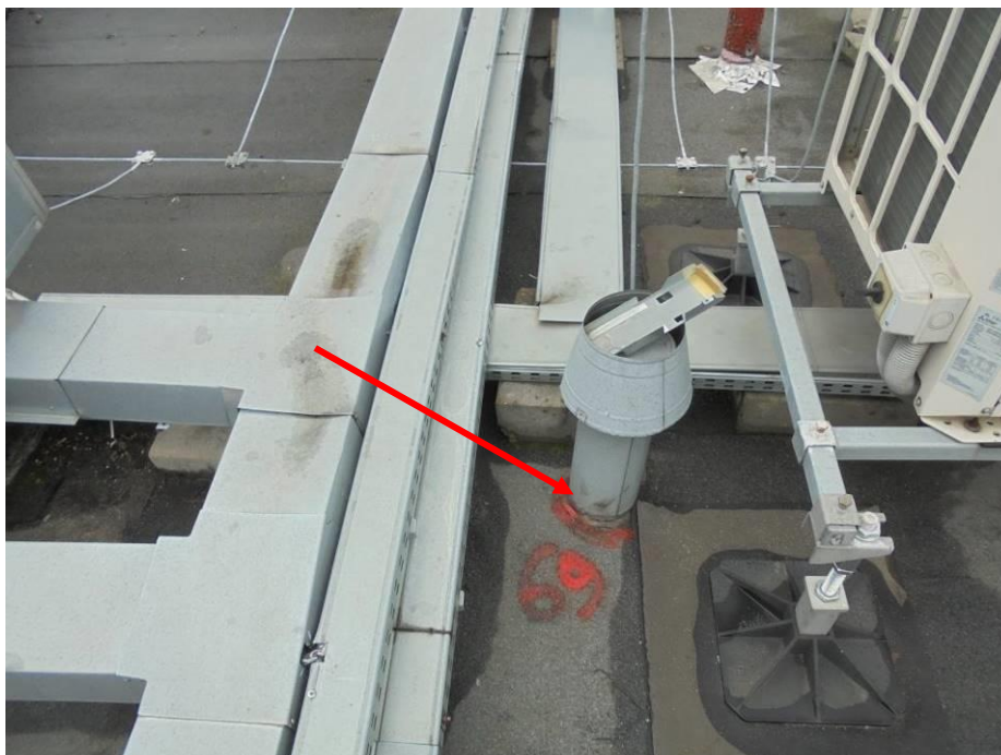
Foto 95. Nieszczelność nr 69 – nieszczelny styk izolacji wodochronnej z kominkiem wentylacyjnym.
