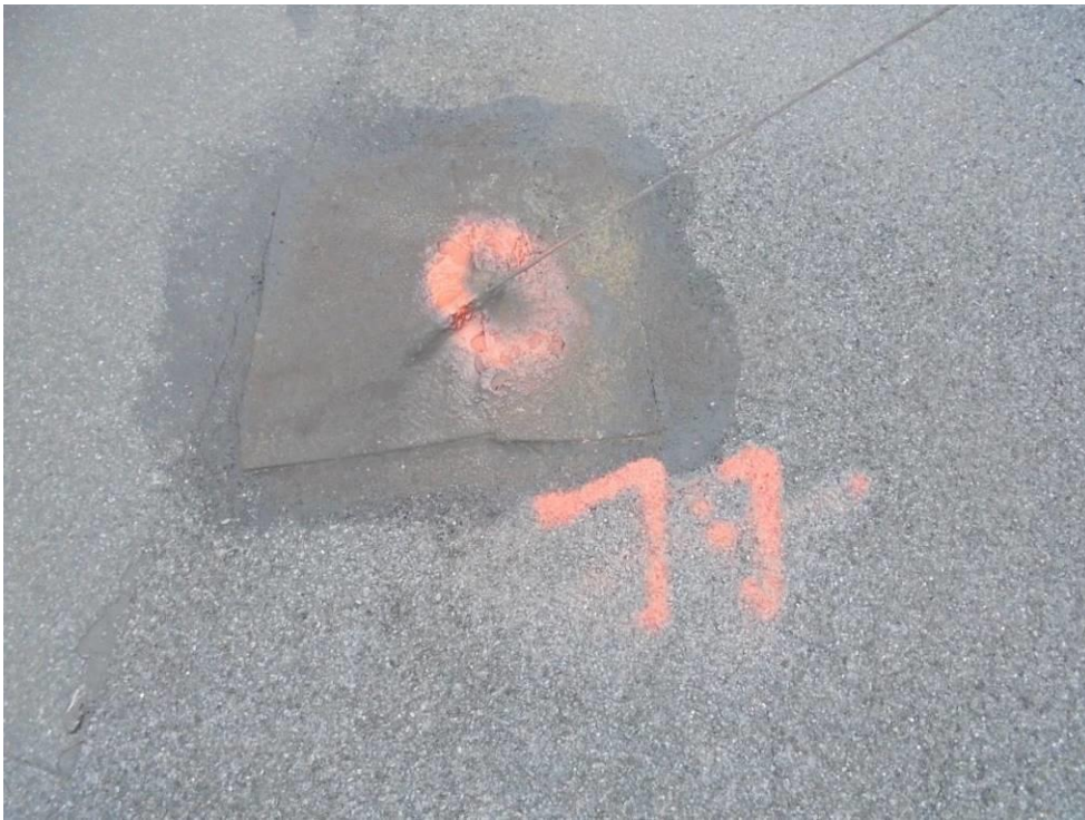
Foto 104. Nieszczelność nr 77 – nieszczelność w miejscu mocowania liny stalowej do połączenia dachu.
