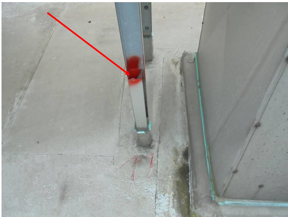
Foto 19. Nieszczelność nr 11 – brak zabezpieczenia słupka podkonstrukcji przed wciekaniem wody opadowej.
