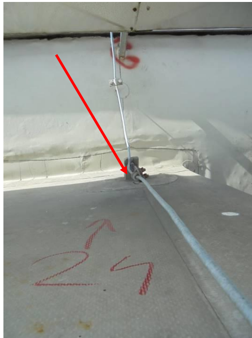
Foto 32. Nieszczelność nr 24 – nieszczelne przejście słupka instalacji odgromowej przez izolację wodochronną.
