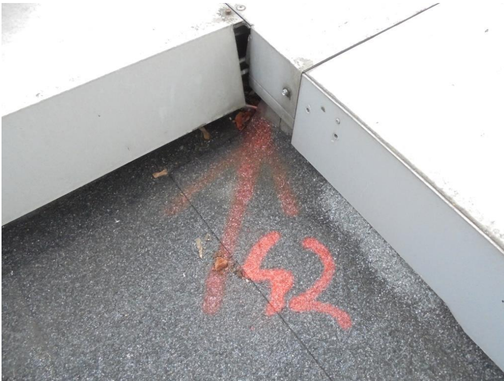
Foto 64. Nieszczelność nr 42 – rozszczelnienie styku pomiędzy sąsiednimi arkuszami papy.
