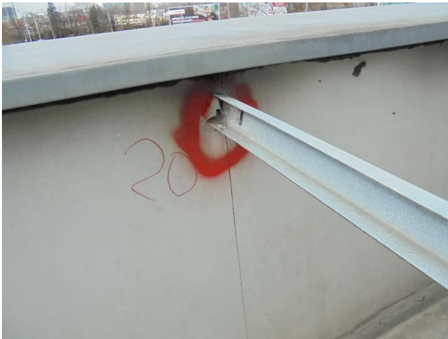
Foto 27. Nieszczelność nr 20 – brak prawidłowego połączenia izolacji wodochronnej na attyce ze stalową konstrukcją przebijającą membranę.
