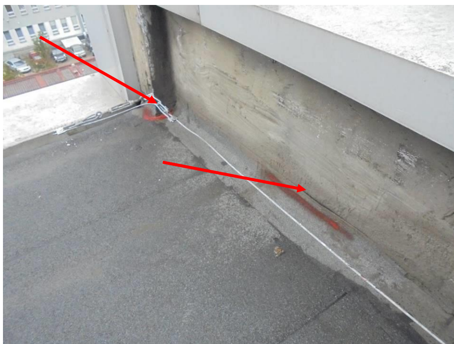
Foto 108. Nieszczelność nr 81 – odspojenie izolacji wodochronnej od ściany atyki.
