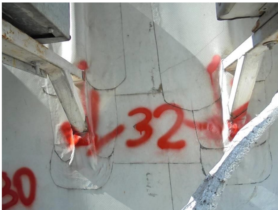
Foto 41. Nieszczelność nr 32 – nieszczelność na połączeniu izolacji wodochronnej z konstrukcją mocującą wentylator.
