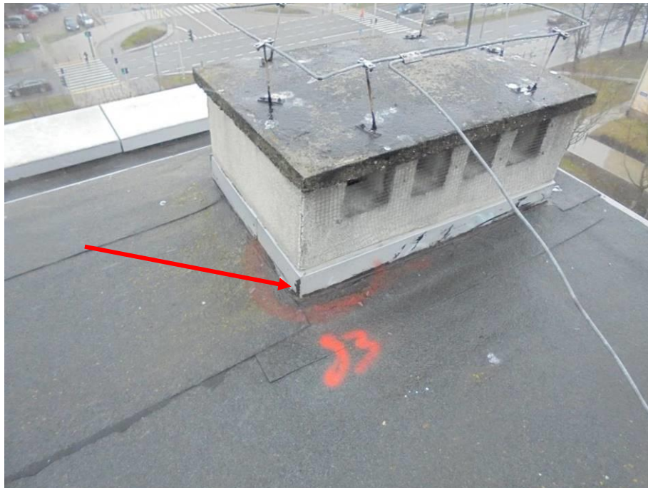
Foto 110. Nieszczelność nr 83 – brak szczelnego połączenia izolacji wodochronnej ze ścianami komina.
