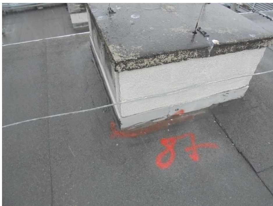
Foto 114. Nieszczelność nr 87 – brak szczelnego połączenia izolacji wodochronnej ze ścianami komina.
