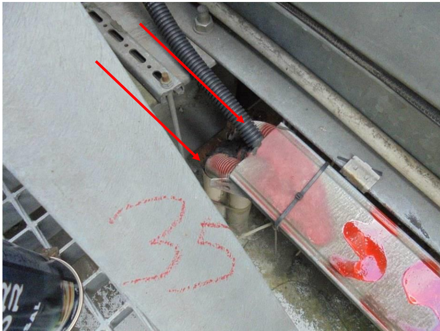
Foto 44. Nieszczelność nr 35 – nieprawidłowo uszczelnione przejście kabli w peszlu przez połąć dachu.
