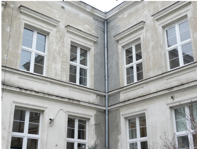
Foto nr 38 Ubytki tynku patio południe po stronie SP213 i przetarcie tynk
