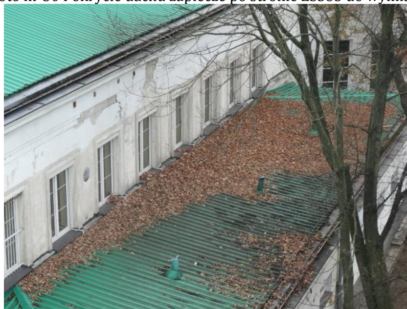
Foto nr 30 Pokrycie dachu zaplecze po stronie ZSS85 do wymiany
