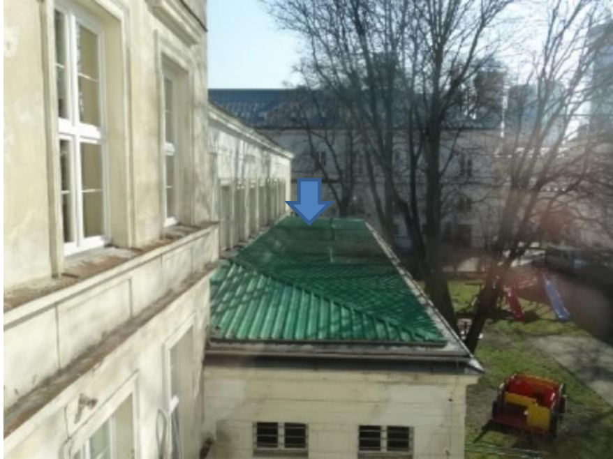
Foto nr 14 Patio ZSS85 ślady naprawy elewacji do zagruntowania
