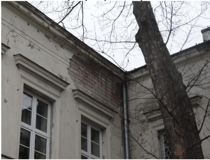
Foto 32 Ubytki tynku po stronie patio SP213
