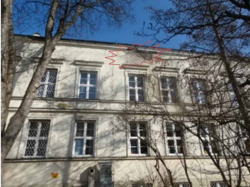
Foto nr 5. Patio SP 213 ubytki tynku gzymsu i ściany oraz przetarcie tynku
