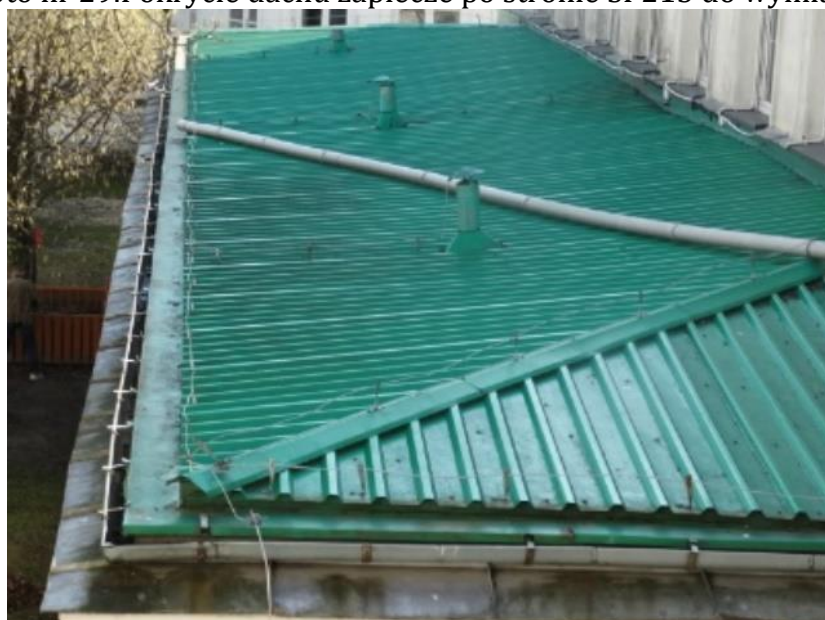
Foto nr 29. Pokrycie dachu zaplecze po stronie SP213 do wymiany
