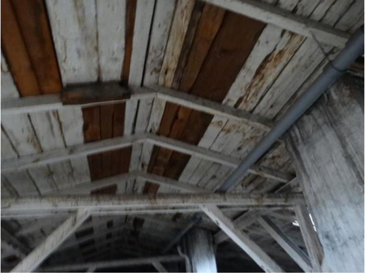
Fot. 8 - Korozja więźby dachowej budynek główny część środkowa
