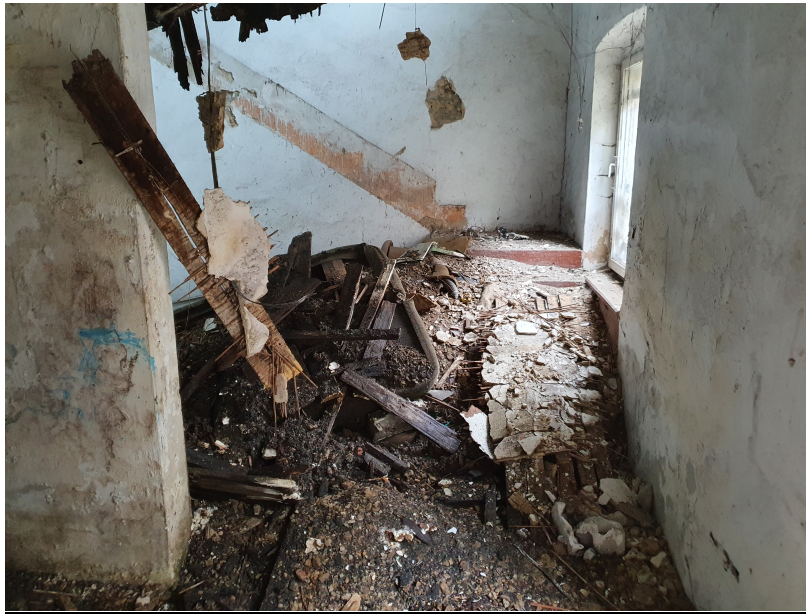
Zdj.3 . Widok stanu technicznego wnętrza budynku gospodarczego – zawalona konstrukcja schodów na pierwsze piętro
