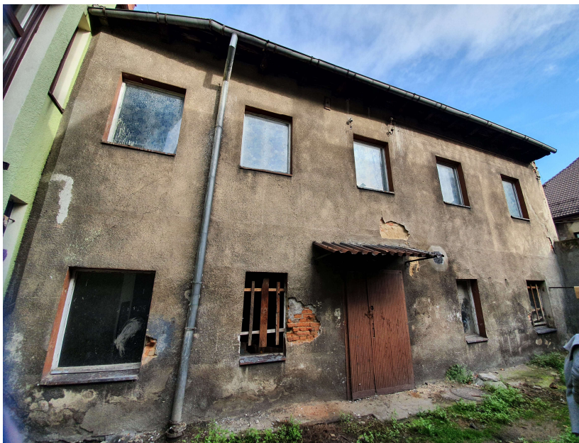
Zdj.1 . Widok elewacji frontowej budynku - widoczne liczne uszkodzenia elewacji.
