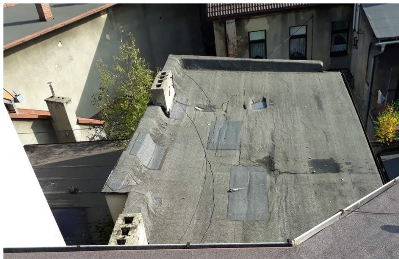
Zdj.2 . Widok dachu budynku gospodarczego - widoczne liczne uszkodzenia konstrukcji dachu oraz widoczny dach budynku gospodarczego na posesji sąsiadującej po lewej stronie zdjęcia.
