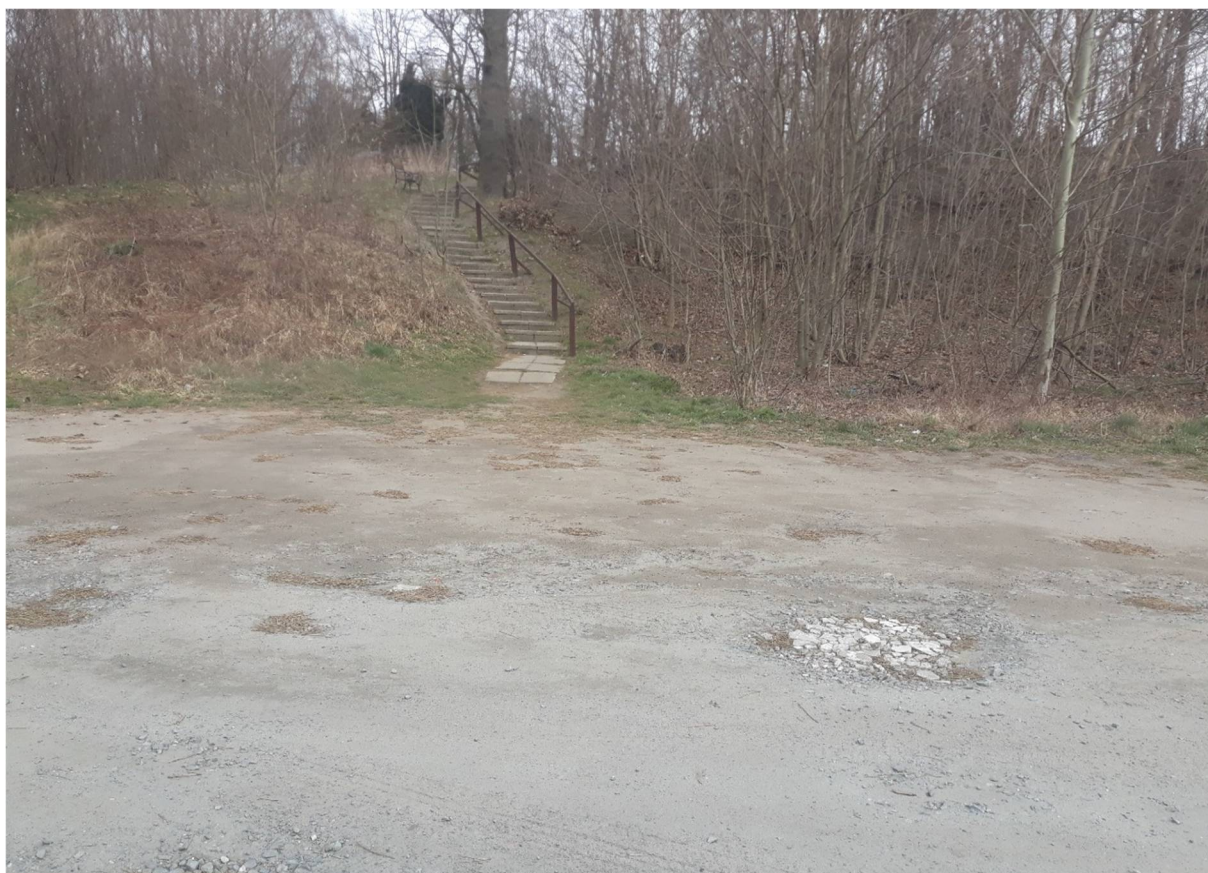
Rysunek 14. Ul. Sportowa – schody prowadzące do cmentarza (wymaga się wykonania dojścia od parkingu oraz od chodnika do uwidocznionych schodów)
