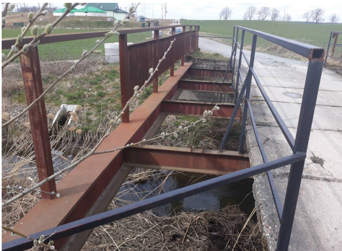
Rysunek 7. Most nad Styną. Uwidoczniła konstrukcja mostu wraz z tymczasową balustradą wewnętrzną.
