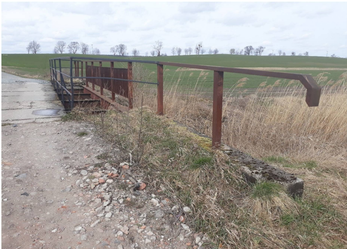
Rysunek 5. Most nad Styną widok prawej części balustrady – na fotografii widać brak elementów balustrady.
