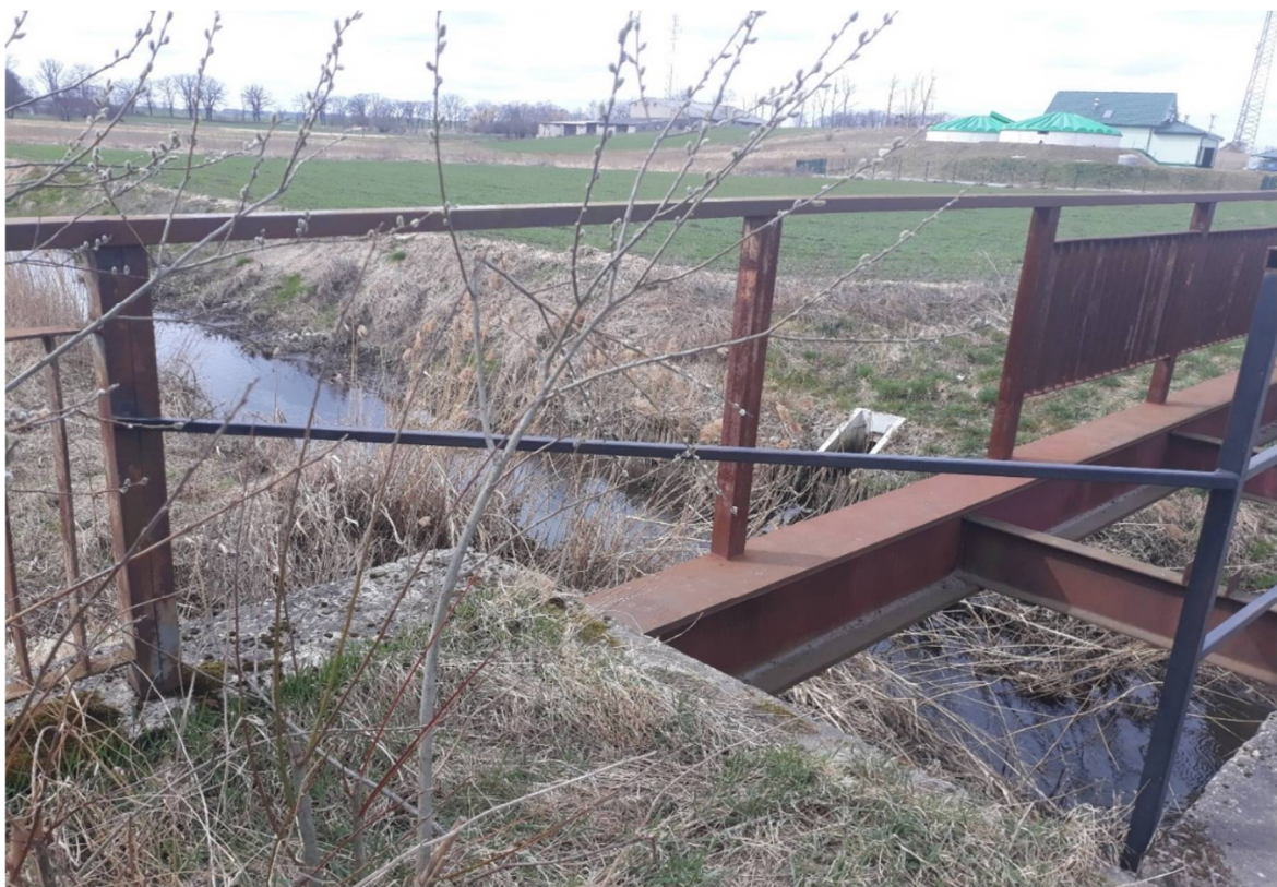
Rysunek 6. Most nad Styną widok na lewą część balustrady – na fotografii widać brak elementów balustrady.
