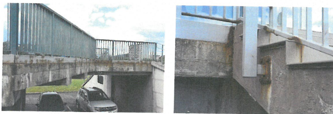
Fot. 16. Korozja obróbek i balustrad
