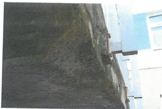
Fot. 9. Korozja i ubytki betonu w płycie biegowej schodów
