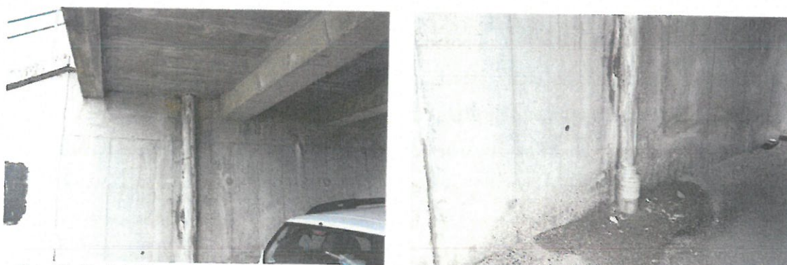
Fot. 17. Zacieki i korozja betonu na murze oporowym przy połączeniu segmentu nr 1 z nasypem
