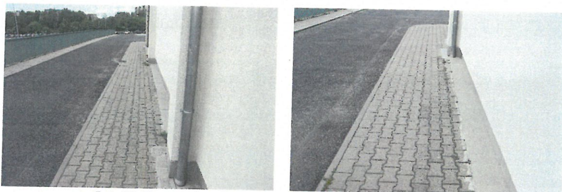
Fot. 12. Stan nawierzchni wzdłuż ściany podłużnej budynku SOR-u
