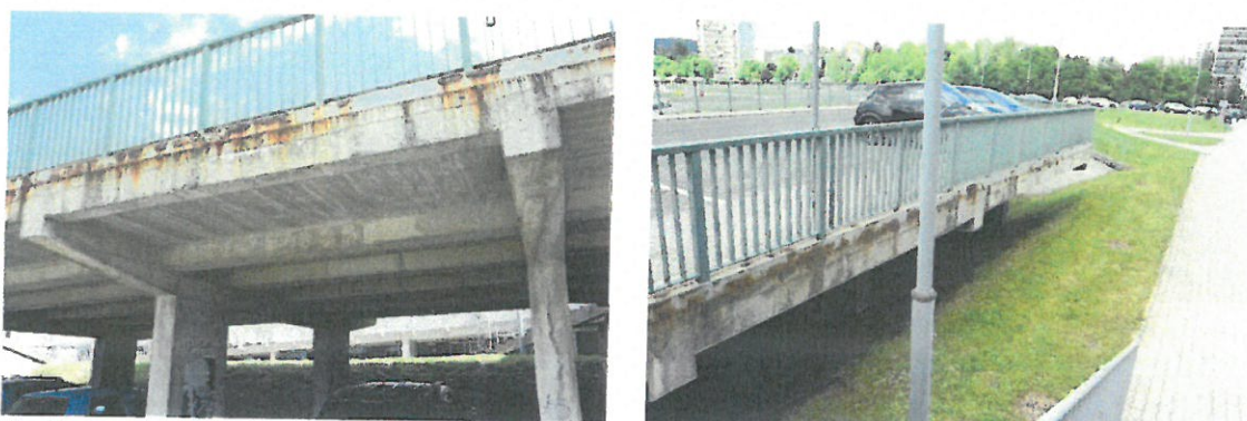
Fot. 15. Korozja obróbek i balustrad
