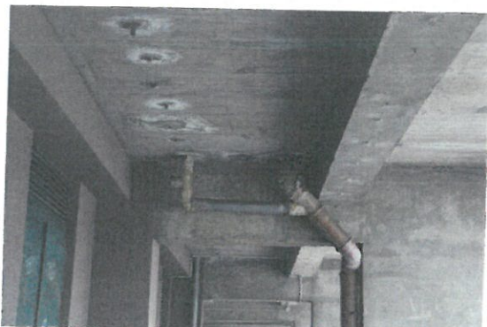
Fot. 7. Nieszczelność odpływu kanalizacji deszczowej, korozja betonu i instalacji
