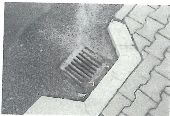
Fot. 8. Niedrożność odpływu (kratki) kanalizacji deszczowej
