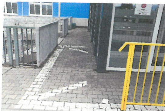
Fot. 13. Stan nawierzchni wzdłuż ściany przybudówki do budynku SOR-u
