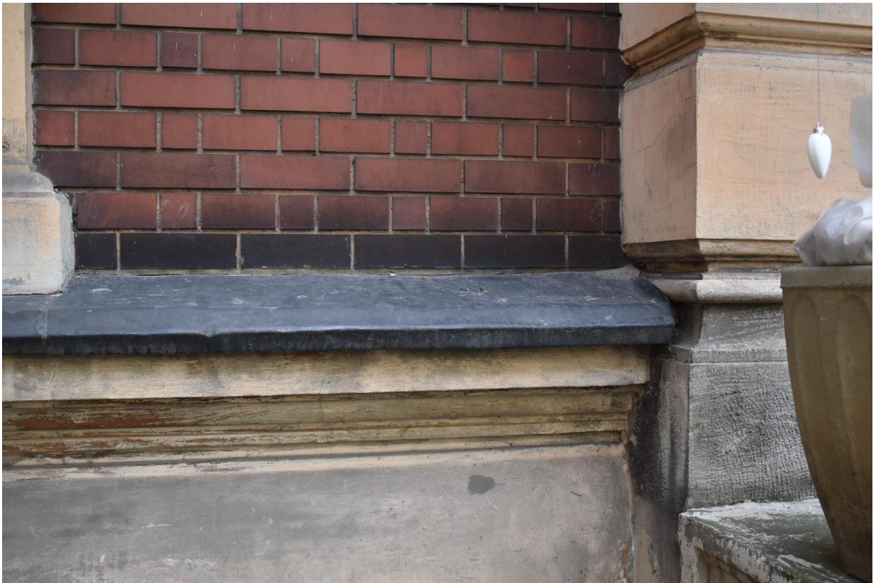
Fot. nr 31 Dom „Pod Stańczykiem”, obecnie Collegium Sanoockie UJ, ul. Batorego 12 w Krakowie. Detal części parterowej. Widoczna uszkodzona obróbka blacharska. Stan przed konserwacją. Kraków, grudzień 2016 r.
