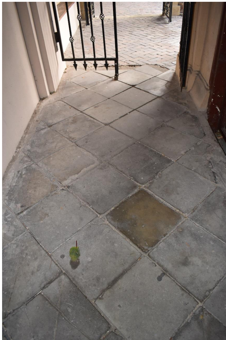
Fot. nr 56 Dom „Pod Stańczykiem”, obecnie Collegium Sanockie UJ, ul. Batorego 12 w Krakowie. Kamienna posadzka w sieni. Widoczne zabrudzenie powierzchni, brak zaprawy w spoinach, pęknięcia płyt. Stan przed konserwacją. Kraków, grudzień 2016 r. fot. K. Sułkowska
