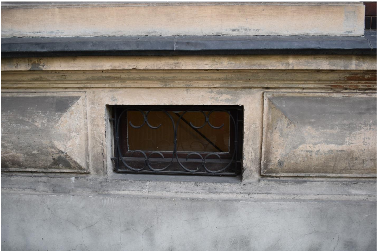
Fot. nr 32 Dom „Pod Stańczykiem”, obecnie Collegium Sanoockie UJ, ul. Batorego 12 w Krakowie. Zbliżenie cokołu z oknem piwnicznym. Widoczne silne zabrudzenie powierzchni, spękania zaprawy oraz zatarcia cokołu zaprawą cementową. Stan przed konserwacją. Kraków, grudzień 2016 r.
