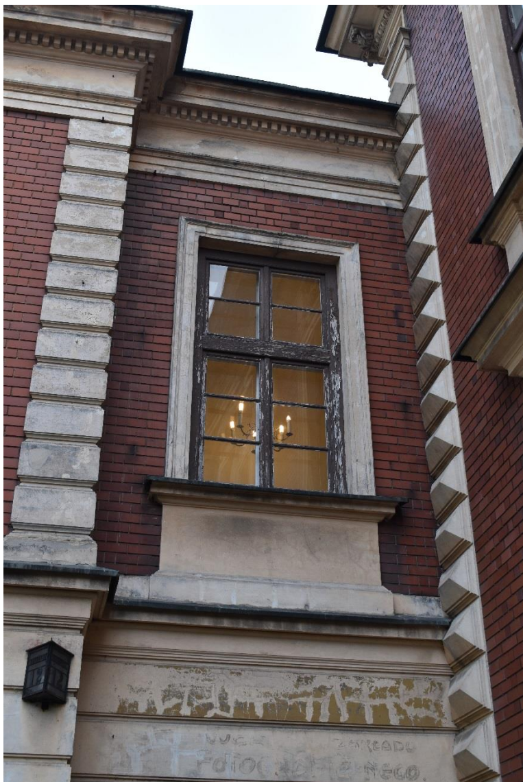
Fot. nr 20 Dom „Pod Stańczykiem”, obecnie Collegium Sanockie UJ, ul. Batoiego 12 w Krakowie. Okno nad przejściem na dziedziniec. Na boniowaniu widoczny zamazany napis informujący o przejściu do zakładu fotograficznego. Stan przed konserwacją. Kraków, grudzień 2016 r. fot. K. Sulowska
