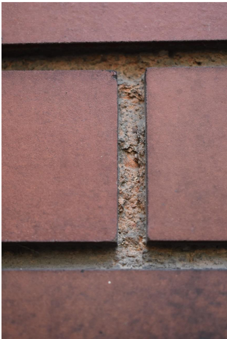
Fot. nr 24 Dom „Pod Stańczykiem”, obecnie Collegium Sanockie UJ, ul. Batorego 12 w Krakowie. Zbliżenie spoiny wstku ceglanoego. Widoczna pierwotna ceglata warstwa malarska. Stan przed konserwacją. Kraków, grudzień 2016 r. fot. K. Sulowska
