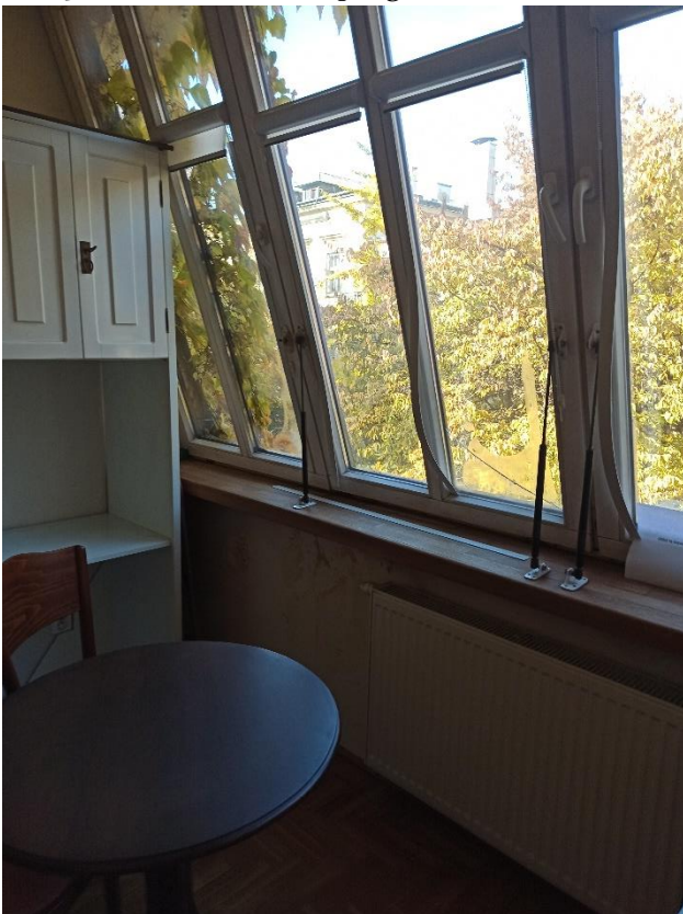
Fot. 4. Widoczne zawilgocenia spowodowane nieszczelnościami obróbek blacharskich i kwater okiennych
