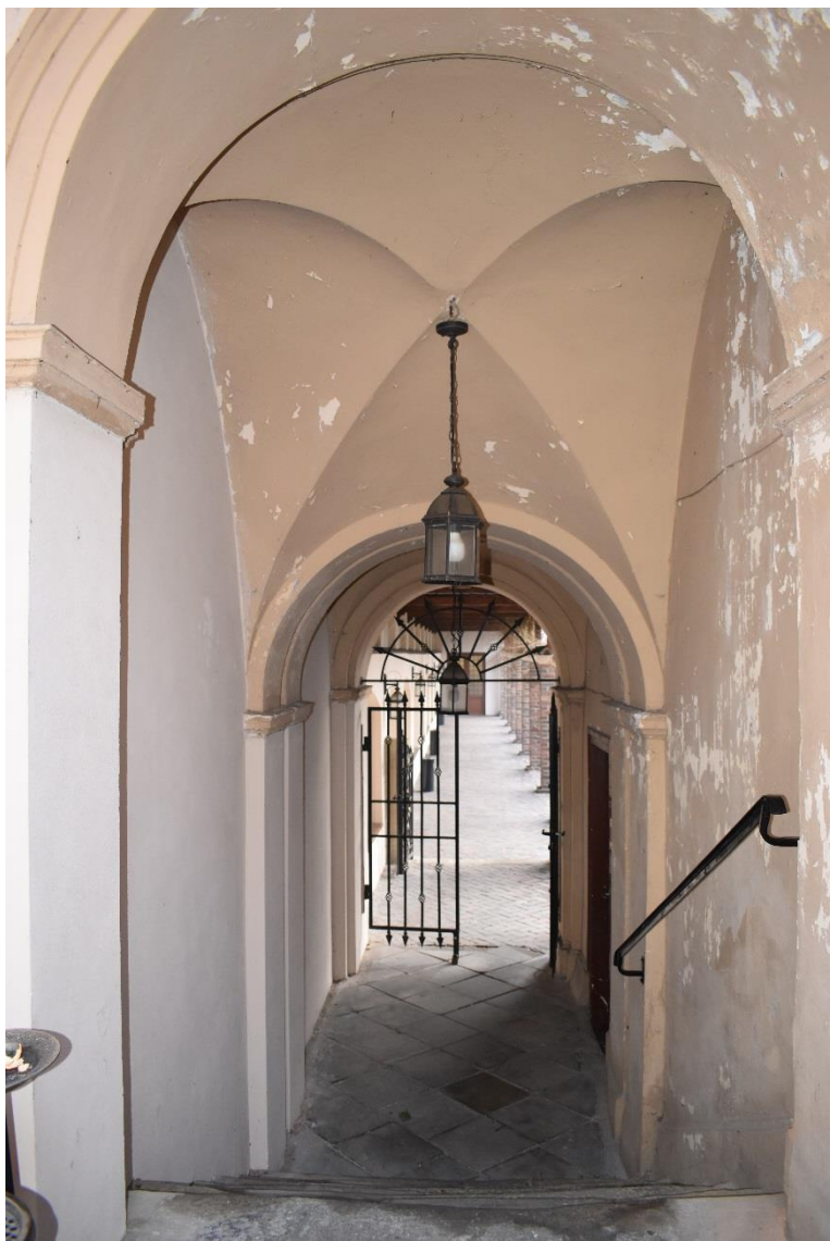
Fot. nr 10 Dom „Pod Stańczykiem”, obecnie Collegium Sanockie UJ, ul. Batorego 12 w Krakowie. Widok wnętrza sieni. Widoczne ubytki farby na ścianach. Stan przed konserwacją. Kraków, grudzień 2016 r. fot. K. Sulkowska
