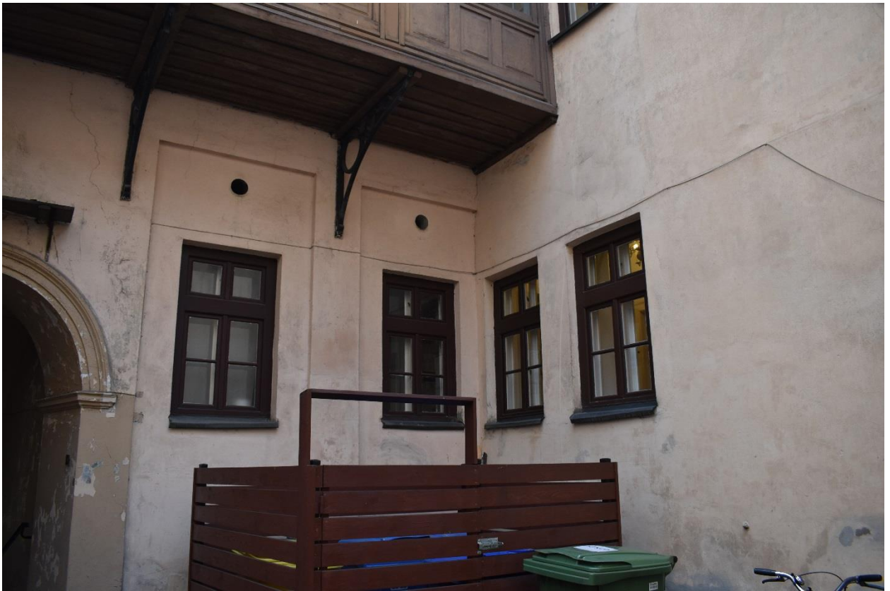
Fot. nr 6 Dom „Pod Stańczykiem”, obecnie Collegium Sanoockie UJ, ul. Batorego 12 w Krakowie. Zbliżenie okien parteru dziedzińca w przejściu do ogrodu. Stan przed konserwacją. Kraków, grudzień 2016 r.
