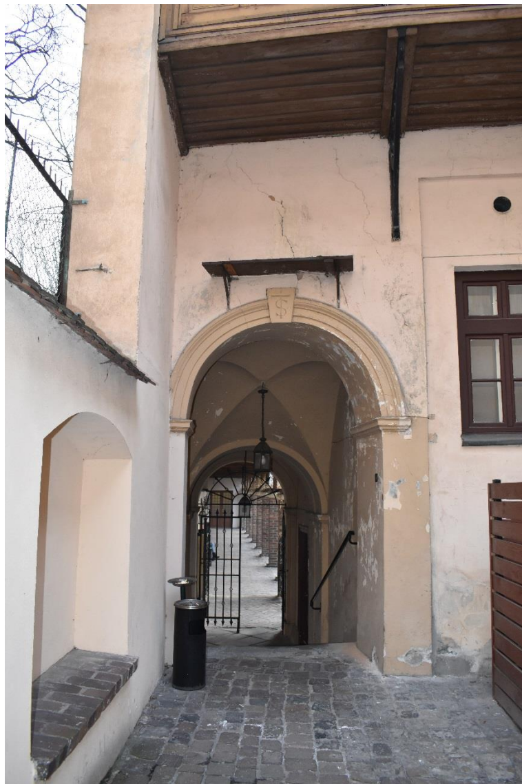
Fot. nr 9 Dom „Pod Stańczykiem”, obecnie Collegium Sanockie UJ, ul. Batorego 12 w Krakowie. Sień w przejściu do ogrodu. Nad portalem widoczny brak grupy rzeźbiarskiej. Stan przed konserwacją. Kraków, grudzień 2016 r. fot. K. Sułkowska
