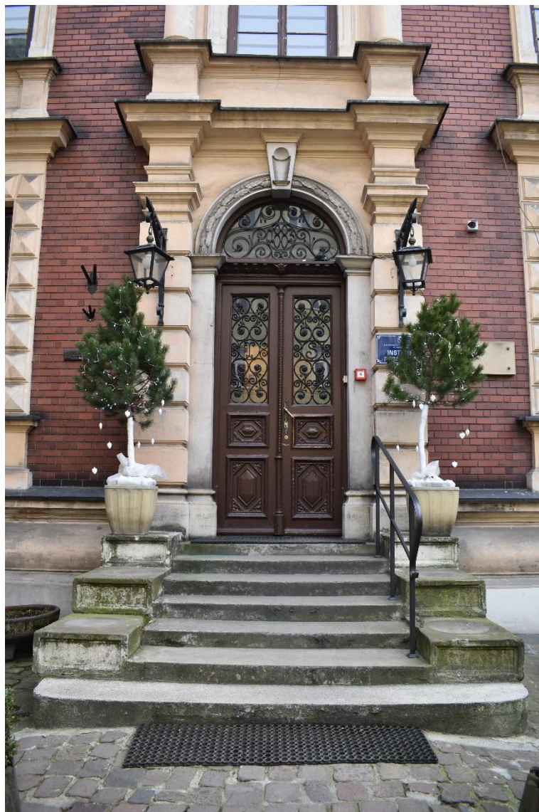
Fot. nr 25 Dom „Pod Stańczykiem”, obecnie Collegium Sanockie UJ, ul. Batorego 12 w Krakowie. Widok ogólny schodów i drzwi wejścia do willi. Stan przed konserwacją. Kraków, grudzień 2016 r. fot. K. Sulowska
