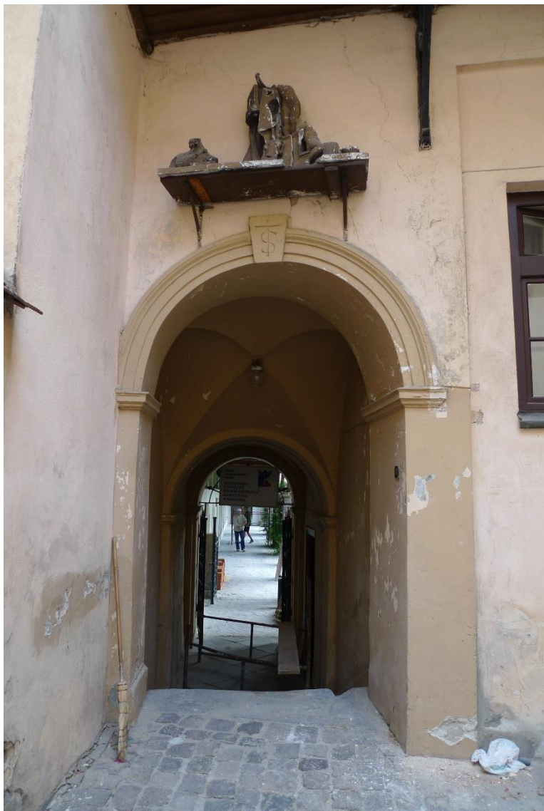
Fot. nr 8 Dom „Pod Stańczykiem”, obecnie Collegium Sanockie UJ, ul. Batorego 12 w Krakowie. Sień w przejściu do ogrodu. Nad portalem widoczna grupa rzeźbiarska. Stan przed konserwacją. Kraków, lipiec 2013 r. fot. K. Sułkowska
