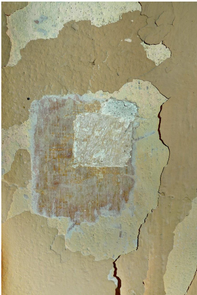
Fot. nr 55 Dom „Pod Stańczykiem”, obecnie Collegium Sanockie UJ, ul. Batorego 12 w Krakowie. Odkrywka na ścianie w sieni. Widoczna pierwotna ugrowa warstwa malarska. Stan przed konserwacją. Kraków, grudzień 2016 r. fot. K. Sułkowska
