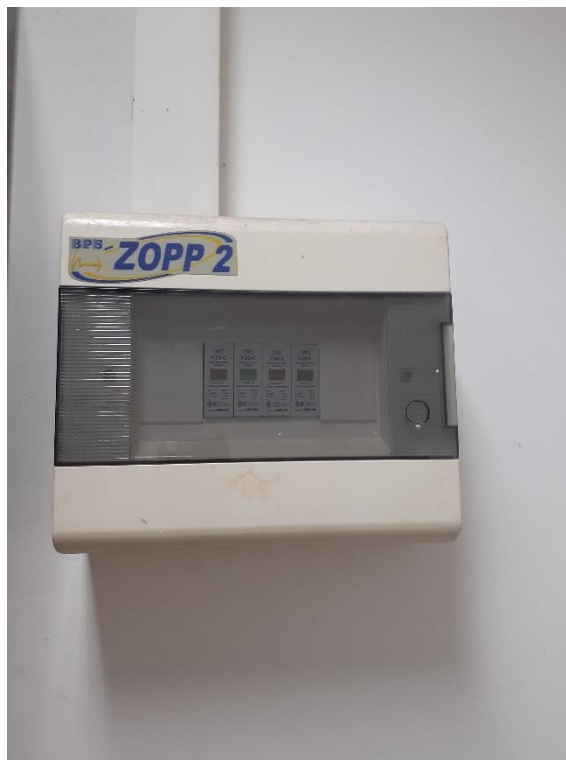
Istniejące zabezpieczenie przepięciowe budynku
