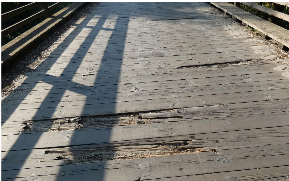
Fot. 2. Ubytki i deformacja nawierzchni na obiekcie, zanieczyszczenia nawierzchni jezdni
