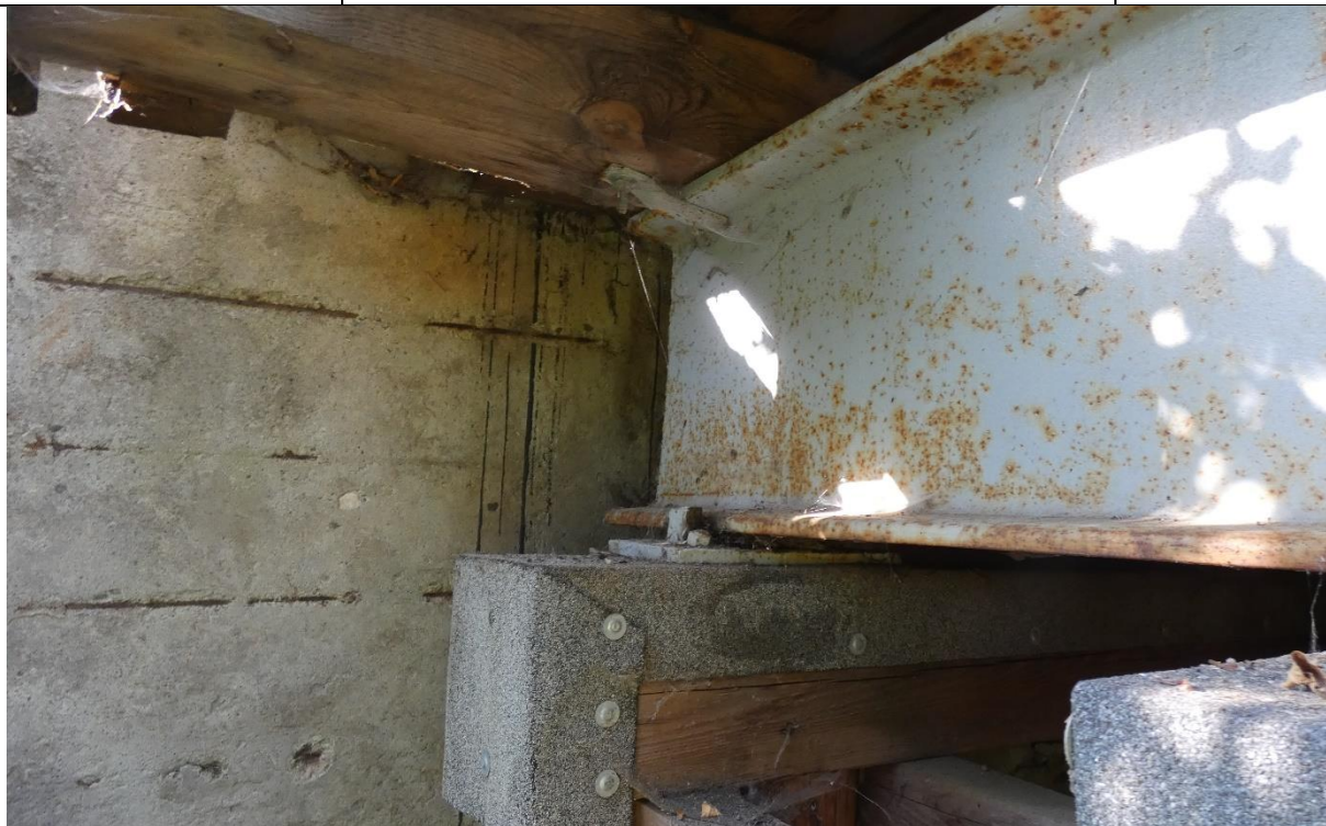
Fot. 9. Zacieki, ogniska korozji, zanieczyszczenia na konstrukcji stalowej przęsła obiektu
