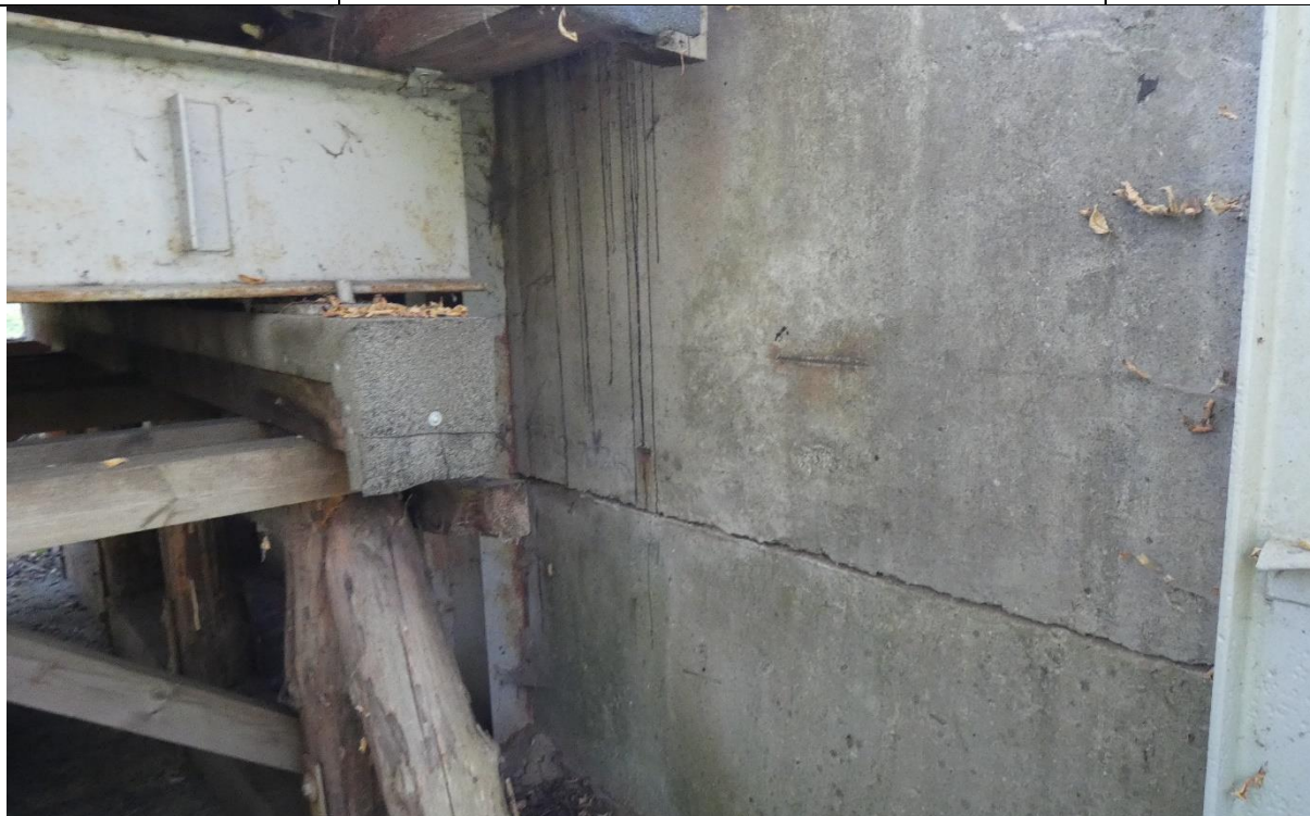
Fot. 3. Zanieczyszczenia i zacieki na betonową ściankę zapleczną
