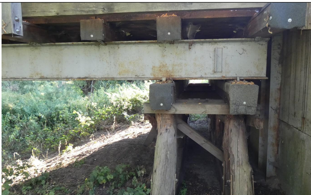
Fot. 4. Korozja biologiczna, zanieczyszczenia i zarysowania drewnianych bali jako podpór obiektu
