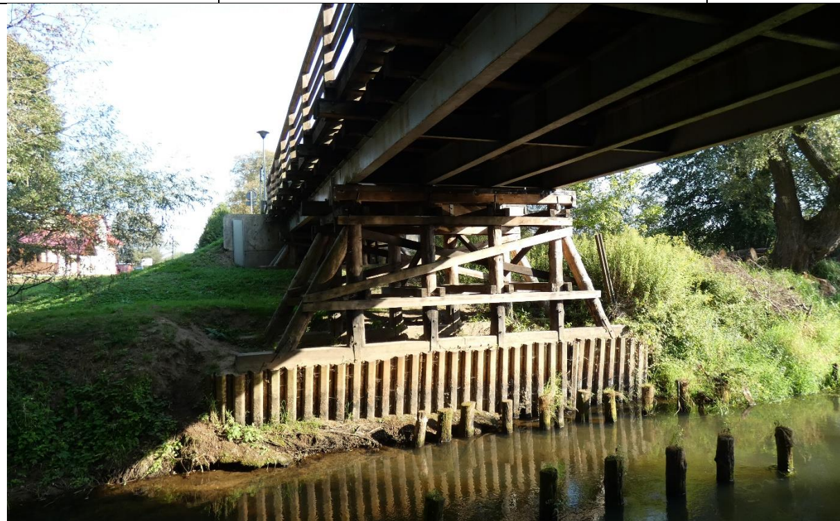
Fot. 17. Widok na przeszkodę – pozostawione pale w korycie rzeki
