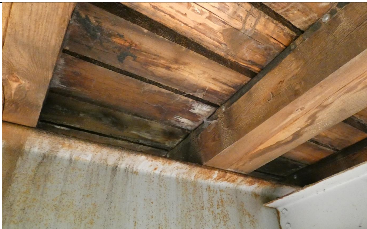
Fot. 14. Zacieki, wykwyty ogniska korozji biologicznej, gnicie drewnianego pomostu
