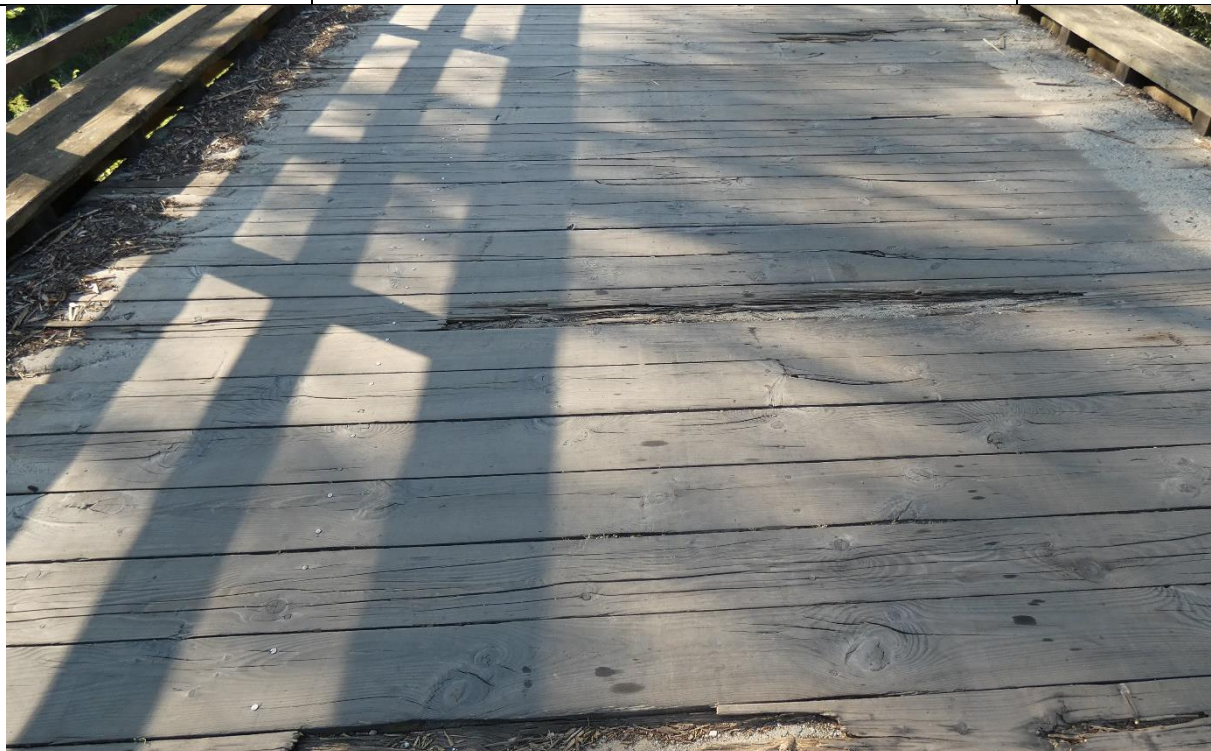
Fot. 1. Ubytki i deformacja nawierzchni na obiekcie, zanieczyszczenia nawierzchni jezdni
