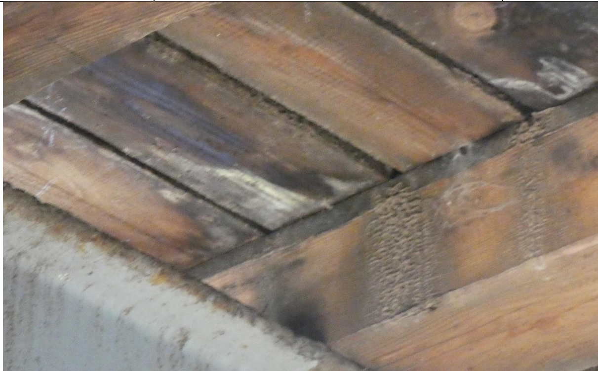
Fot. 13. Zacieki, wykwyty ogniska korozji biologicznej, gnicie drewnianego pomostu
