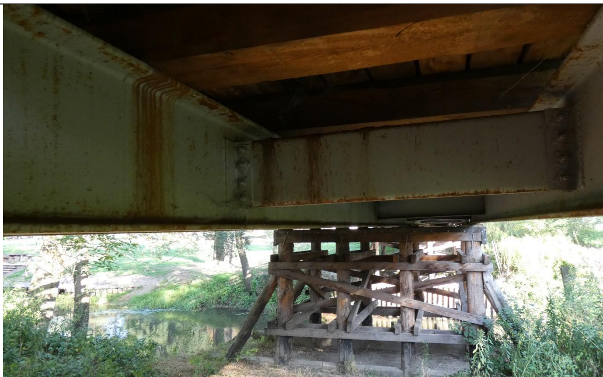
Fot. 10. Zacieki, ogniska korozji, zanieczyszczenia na konstrukcji stalowej przęsła obiektu
