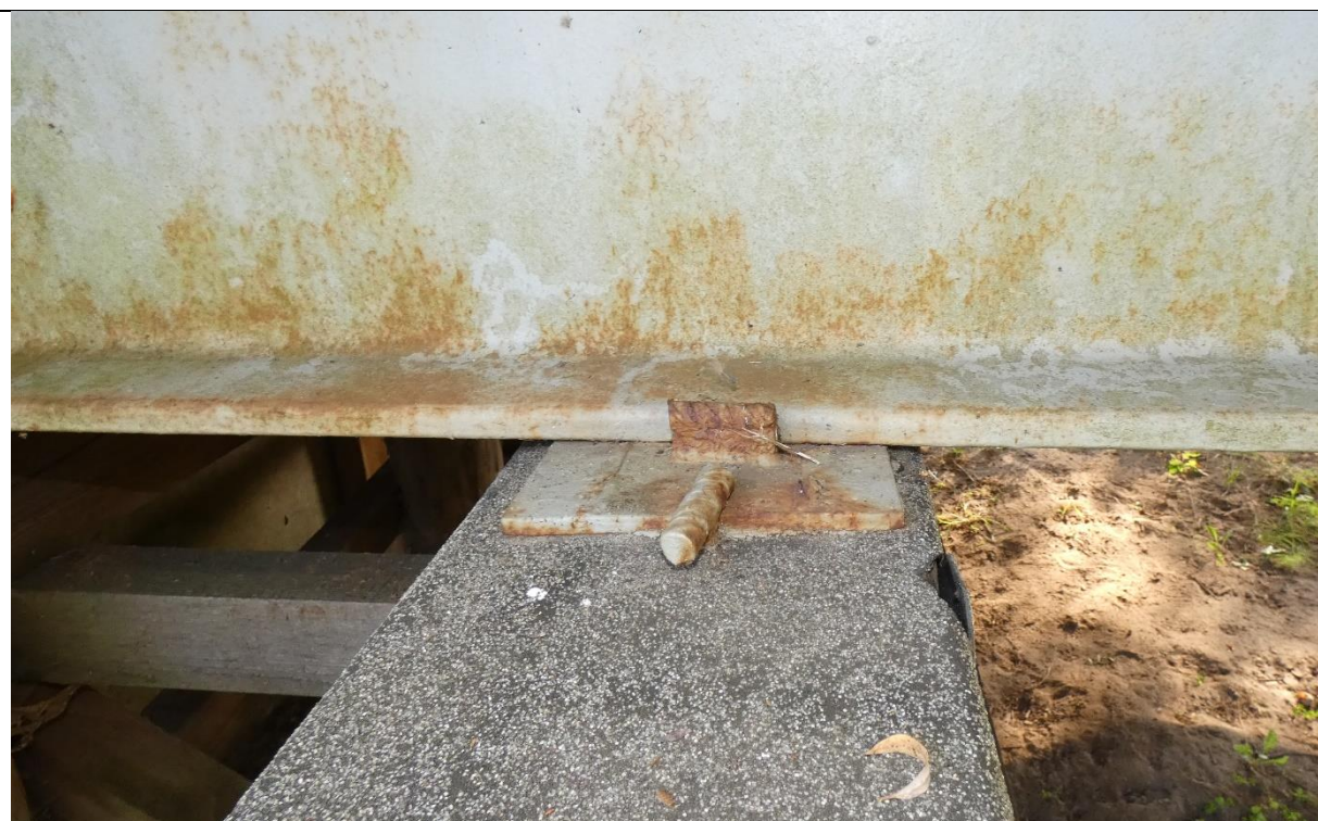
Fot. 18. Korozja łożysk i dźwigarów przęsła
