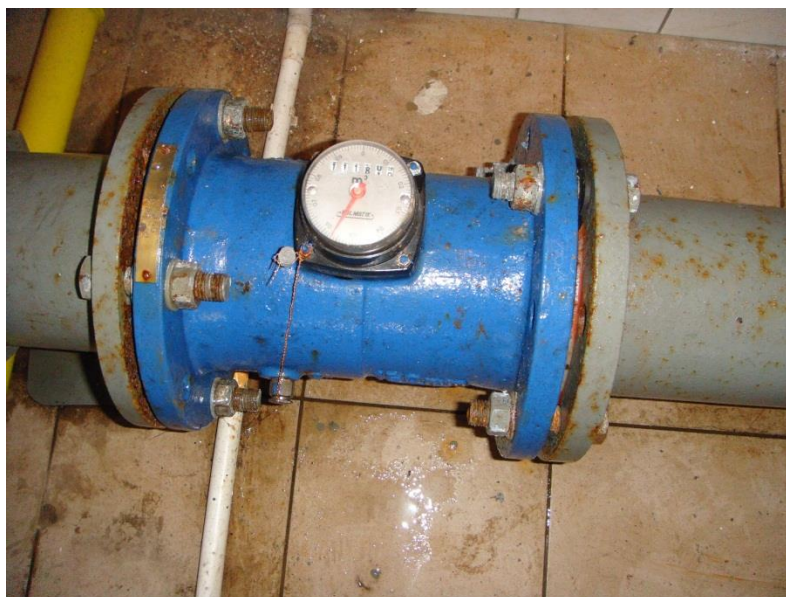
Pomiar wody uzdatnionej – wodomierz MZ \varnothing 100 mm
