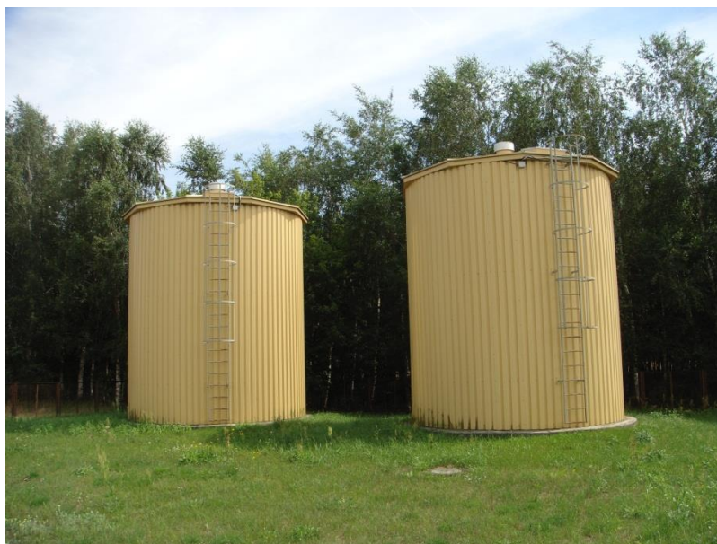
Zbiornik wody uzdatnionej 2 \times 100 \text{ m}^3
