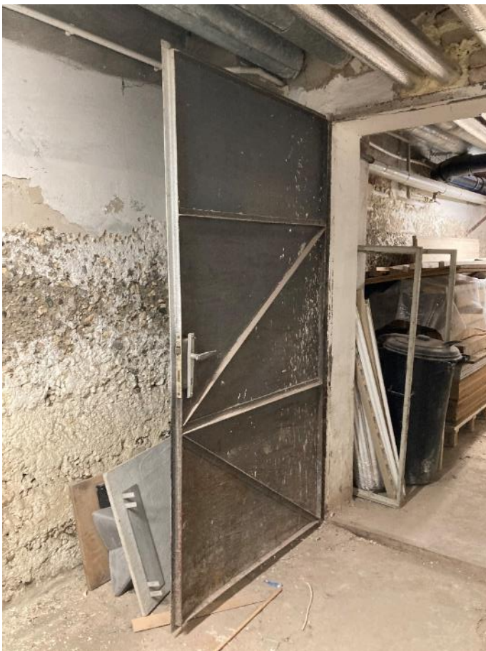
Fot. 57. Dawne Muzeum Techniczno-Przemysłowe, ul Smoleńsk 9, Kraków. Piwnice. Uszkodzona ściana żelbetowa z ubytkami tynków. Stan przed konserwacją. Czerwiec 2022. Fot. K. Sułkowska.
