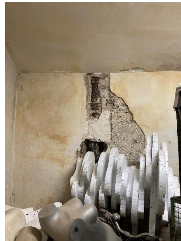
Fot. 32. Dawne Muzeum Techniczno-Przemysłowe, ul Smoleńsk 9, Kraków. Piwnice. Ubytki i zabrudzenie tynków. Stan przed konserwacją. Czerwiec 2022. Fot. K. Sułkowska.
