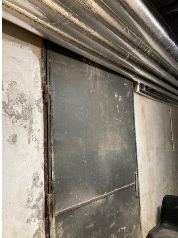
Fot. 53. Dawne Muzeum Techniczno-Przemysłowe, ul Smoleńsk 9, Kraków. Piwnice. Pierwotne drzwi stalowe. Stan przed konserwacją. Czerwiec 2022. Fot. K. Sułkowska.
