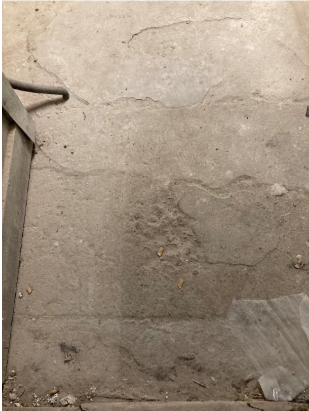
Fot. 46. Dawne Muzeum Techniczno-Przemysłowe, ul Smoleńsk 9, Kraków. Piwnice. Uszkodzona wylewka betonowa. Stan przed konserwacją. Czerwiec 2022. Fot. K. Sułkowska.
