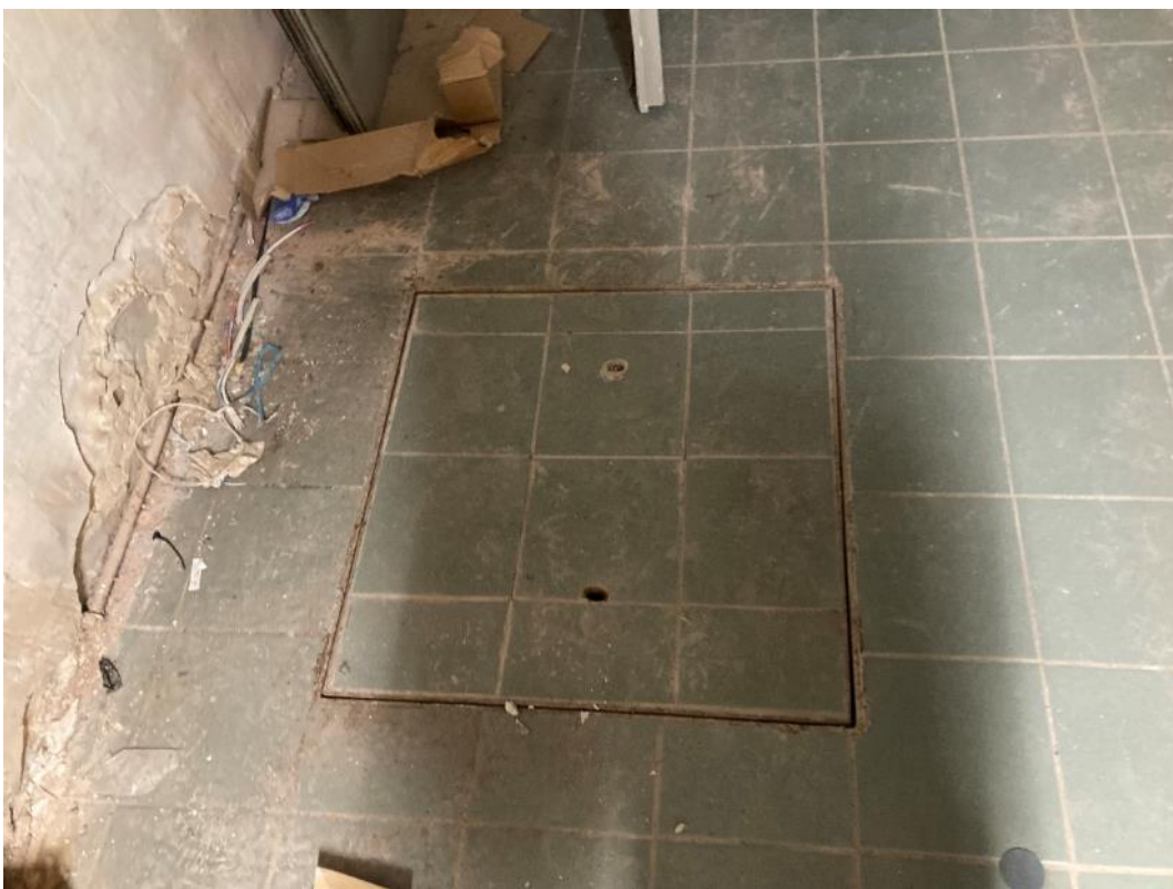
Fot. 36. Dawne Muzeum Techniczno-Przemysłowe, ul Smoleńsk 9, Kraków. Piwnice. Uszkodzona wtórna posadzka ceramiczna. Stan przed konserwacją. Czerwiec 2022. Fot. K. Sułkowska.
