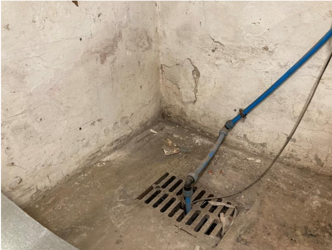
Fot. 64. Dawne Muzeum Techniczno-Przemysłowe, ul Smoleńsk 9, Kraków. Piwnice. Kratka kanalizacyjna w posadzce z wylewki betonowej. Stan przed konserwacją. Czerwiec 2022. Fot. K. Sułkowska.
