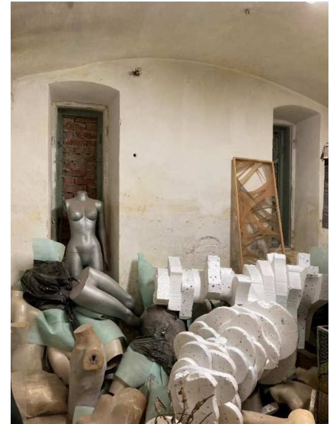
Fot. 15. Dawne Muzeum Techniczno-Przemysłowe, ul Smoleńsk 9, Kraków. Piwnice. Zamurowane pierwotne otwory okienne. Stan przed konserwacją. Czerwiec 2022. Fot. K. Sułkowska.
