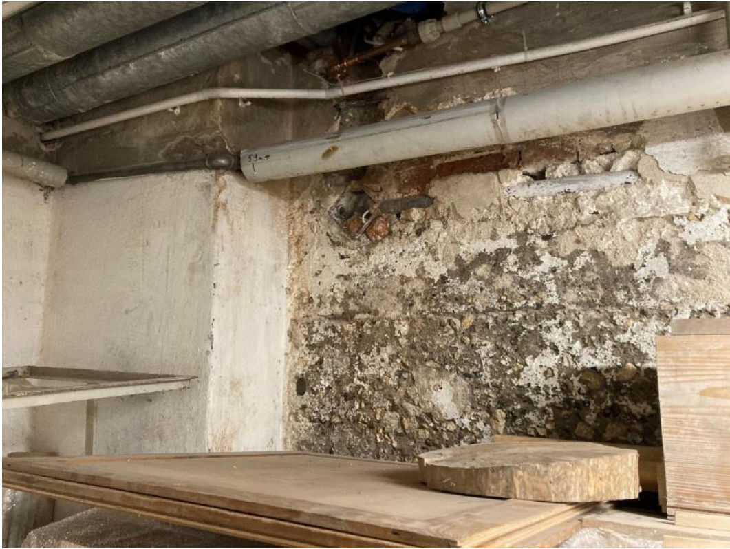
Fot. 1 Dawne Muzeum Techniczno-Przemysłowe, ul Smoleńsk 9, Kraków. Piwnice. Ubytki tynków. Widoczna ściana żelbetowa. Stan przed konserwacją. Czerwiec 2022. Fot. K. Sułkowska.
