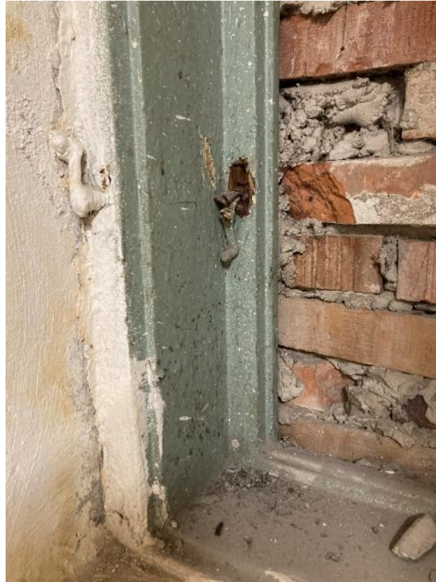
Fot. 17. Dawne Muzeum Techniczno-Przemysłowe, ul Smoleńsk 9, Kraków. Piwnice. Zamurowany pierwotny otwór okienny. Stan przed konserwacją. Czerwiec 2022. Fot. K. Sułkowska.
