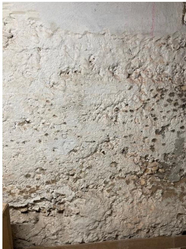
Fot. 50. Dawne Muzeum Techniczno-Przemysłowe, ul Smoleńsk 9, Kraków. Piwnice. Uszkodzona ściana żelbetowa z ubytkami tynków. Stan przed konserwacją. Czerwiec 2022. Fot. K. Sułkowska.
