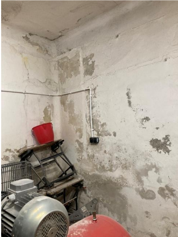
Fot. 22. Dawne Muzeum Techniczno-Przemysłowe, ul Smoleńsk 9, Kraków. Piwnice. Uszkodzenia tynku. Stan przed konserwacją. Czerwiec 2022. Fot. K. Sułkowska.
