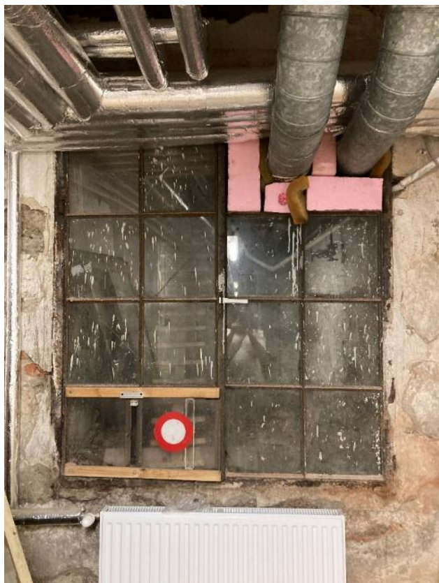
Fot. 59. Dawne Muzeum Techniczno-Przemysłowe, ul Smoleńsk 9, Kraków. Piwnice. Przekształcone oryginalne stalowe wielopolowe okno, skorodowane. Szklenie zaplamione farbą. Stan przed konserwacją. Czerwiec 2022. Fot. K. Sułkowska.
