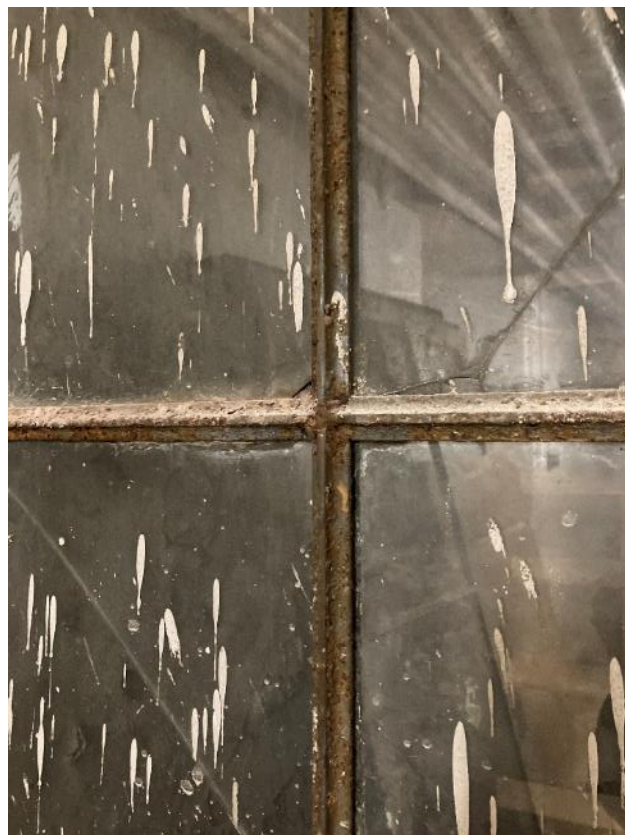
Fot. 60. Dawne Muzeum Techniczno-Przemysłowe, ul Smoleńsk 9, Kraków. Piwnice. Przekształcone oryginalne stalowe wielopolowe okno, skorodowane. Szklenie zaplamione farbą. Stan przed konserwacją. Czerwiec 2022. Fot. K. Sułkowska.
