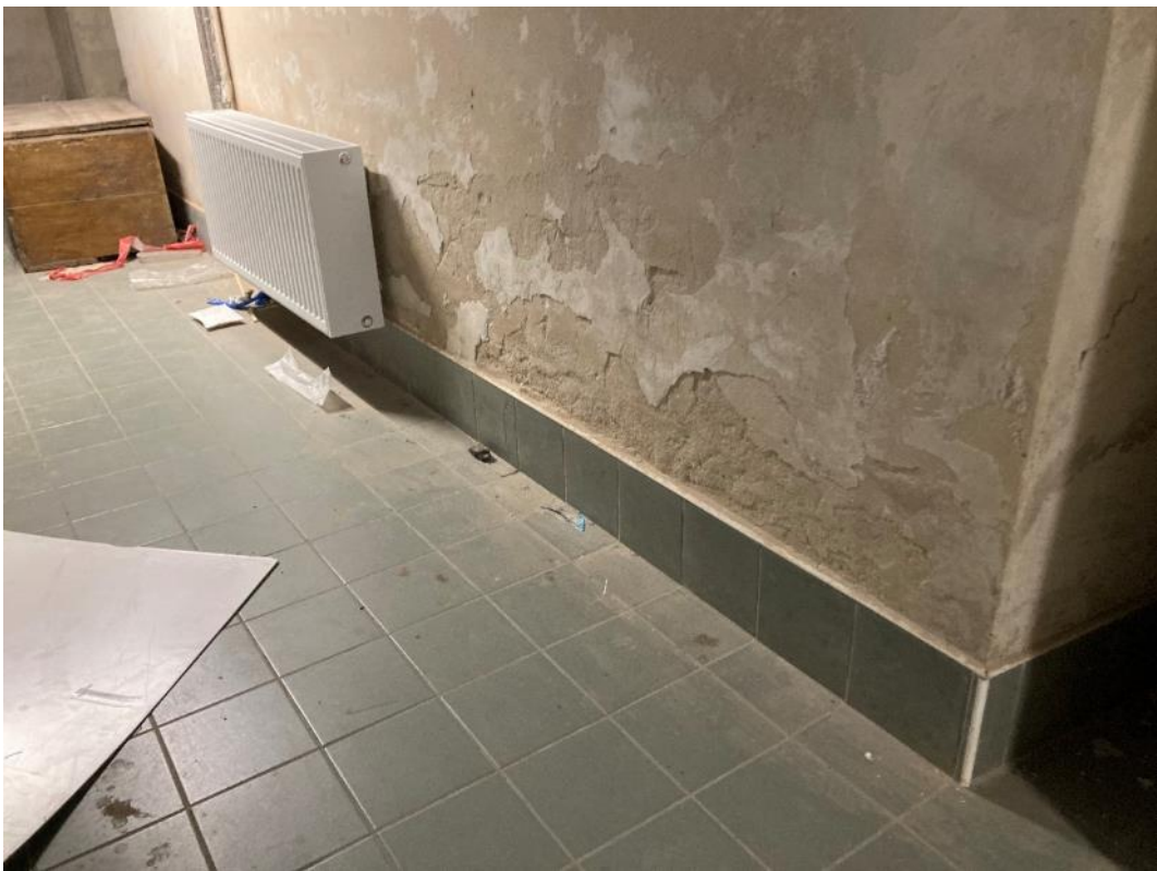
Fot. 34. Dawne Muzeum Techniczno-Przemysłowe, ul Smoleńsk 9, Kraków. Piwnice. Ubytki tynków. Stan przed konserwacją. Czerwiec 2022. Fot. K. Sułkowska.
