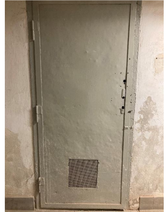
Fot. 42. Dawne Muzeum Techniczno-Przemysłowe, ul Smoleńsk 9, Kraków. Piwnice. Przekształcone historyczne drzwi stalowe. Stan przed konserwacją. Czerwiec 2022. Fot. K. Sułkowska.
