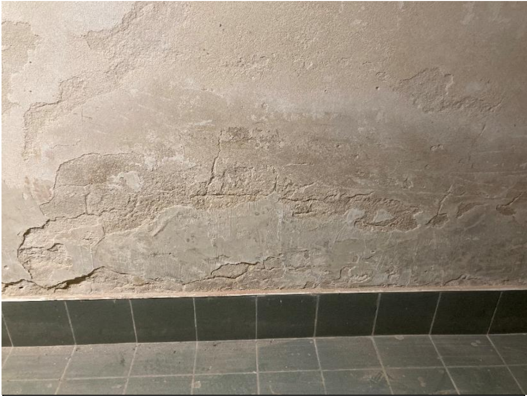
Fot. 33. Dawne Muzeum Techniczno-Przemysłowe, ul Smoleńsk 9, Kraków. Piwnice. Ubytki tynków. Stan przed konserwacją. Czerwiec 2022. Fot. K. Sułkowska.
