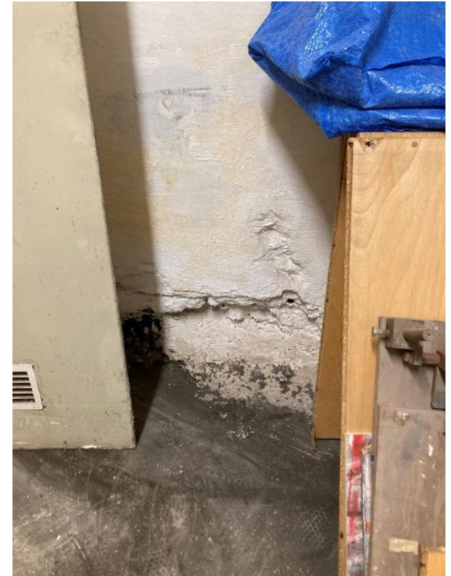
Fot. 27. Dawne Muzeum Techniczno-Przemysłowe, ul Smoleńsk 9, Kraków. Piwnice. Ubytki tynków. Stan przed konserwacją. Czerwiec 2022. Fot. K. Sułkowska.
