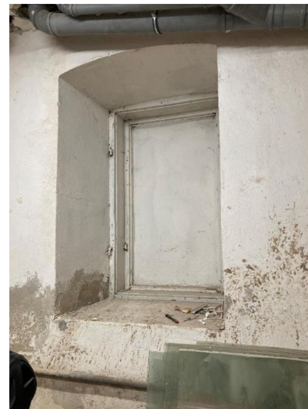
Fot. 21. Dawne Muzeum Techniczno-Przemysłowe, ul Smoleńsk 9, Kraków. Piwnice. Pierwotny zabliendowany otwór okienny. Stan przed konserwacją. Czerwiec 2022. Fot. K. Sułkowska.
