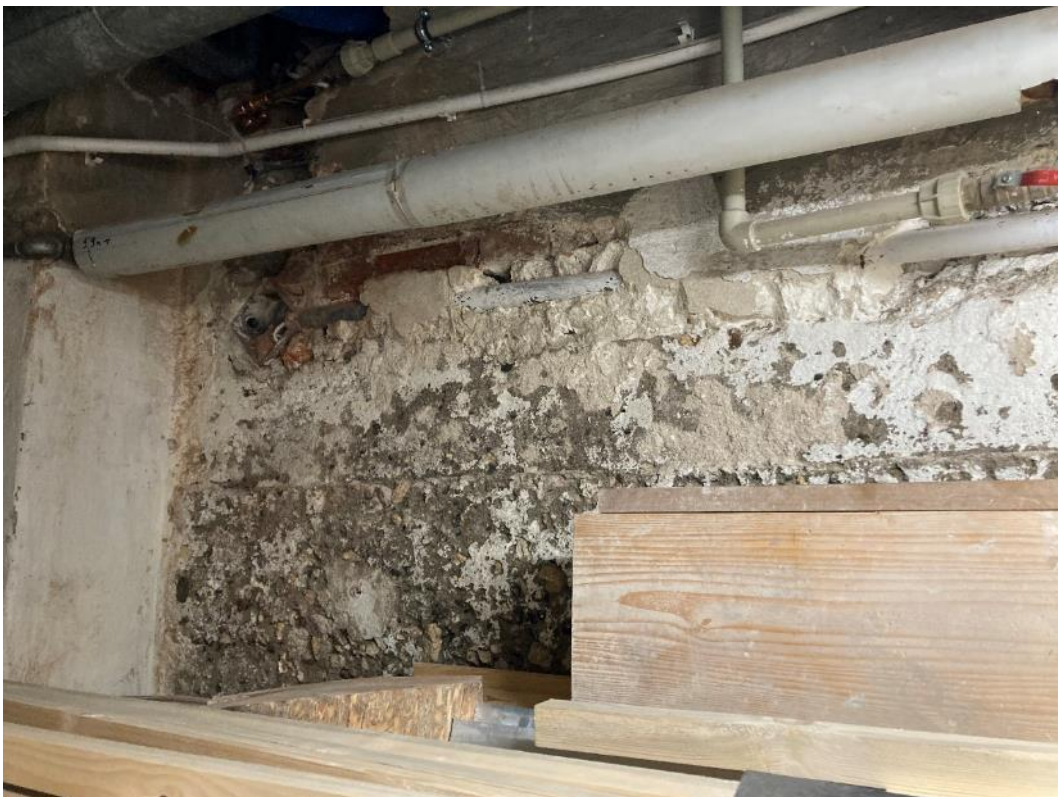
Fot. 56. Dawne Muzeum Techniczno-Przemysłowe, ul Smoleńsk 9, Kraków. Piwnice. Uszkodzona ściana żelbetowa z ubytkami tynków. Stan przed konserwacją. Czerwiec 2022. Fot. K. Sułkowska.
