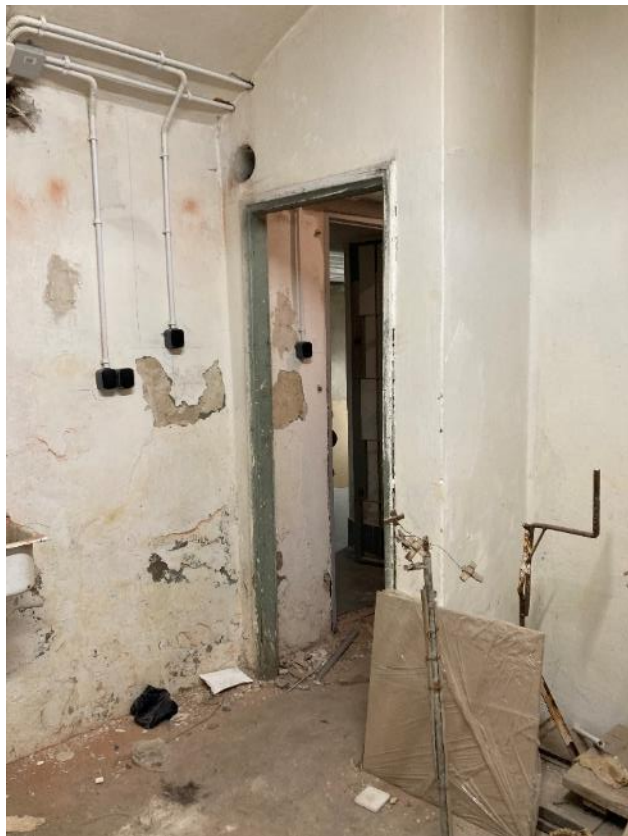
Fot. 30. Dawne Muzeum Techniczno-Przemysłowe, ul Smoleńsk 9, Kraków. Piwnice. Ubytki i zabrudzenie tynków. Stan przed konserwacją. Czerwiec 2022. Fot. K. Sułkowska.
