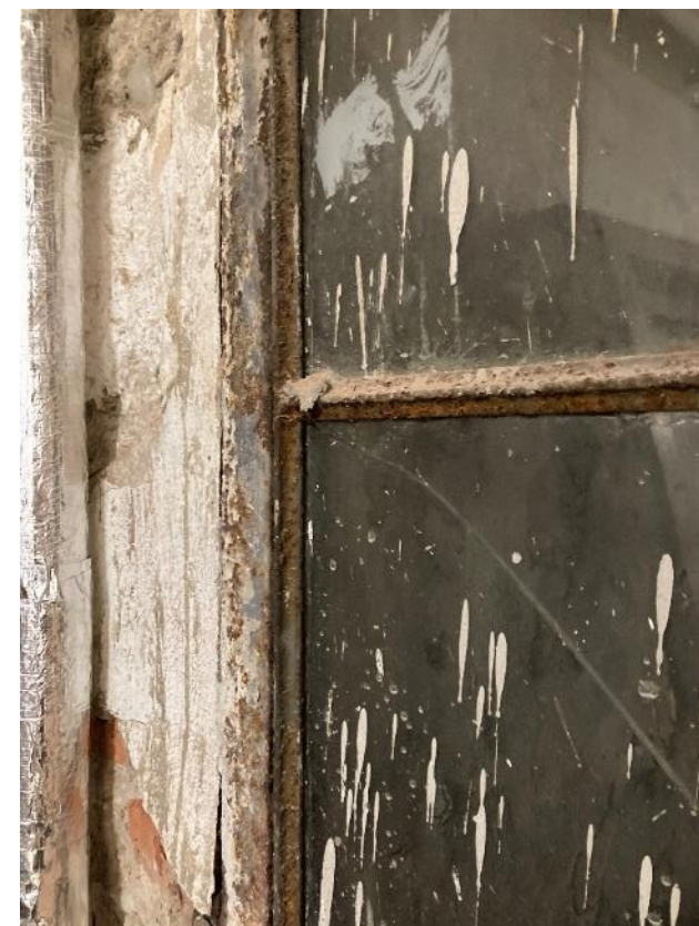
Fot. 61. Dawne Muzeum Techniczno-Przemysłowe, ul Smoleńsk 9, Kraków. Piwnice. Przekształcone oryginalne stalowe wielopolowe okno, skorodowane. Szklenie zaplamione farbą. Stan przed konserwacją. Czerwiec 2022. Fot. K. Sułkowska.
