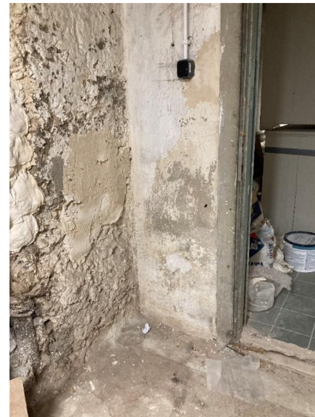
Fot. 51. Dawne Muzeum Techniczno-Przemysłowe, ul Smoleńsk 9, Kraków. Piwnice. Uszkodzona ściana żelbetowa z ubytkami tynków. Stan przed konserwacją. Czerwiec 2022. Fot. K. Sułkowska.
