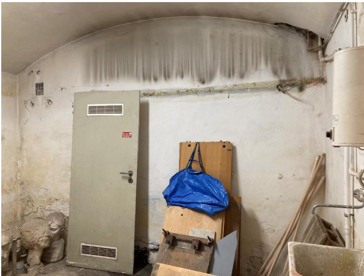
Fot. 29. Dawne Muzeum Techniczno-Przemysłowe, ul Smoleńsk 9, Kraków. Piwnice. Ubytki i zabrudzenie tynków. Stan przed konserwacją. Czerwiec 2022. Fot. K. Sułkowska.
