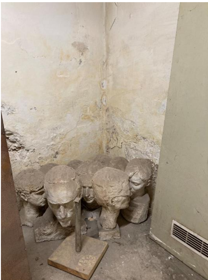
Fot. 28. Dawne Muzeum Techniczno-Przemysłowe, ul Smoleńsk 9, Kraków. Piwnice. Ubytki tynków. Stan przed konserwacją. Czerwiec 2022. Fot. K. Sułkowska.
