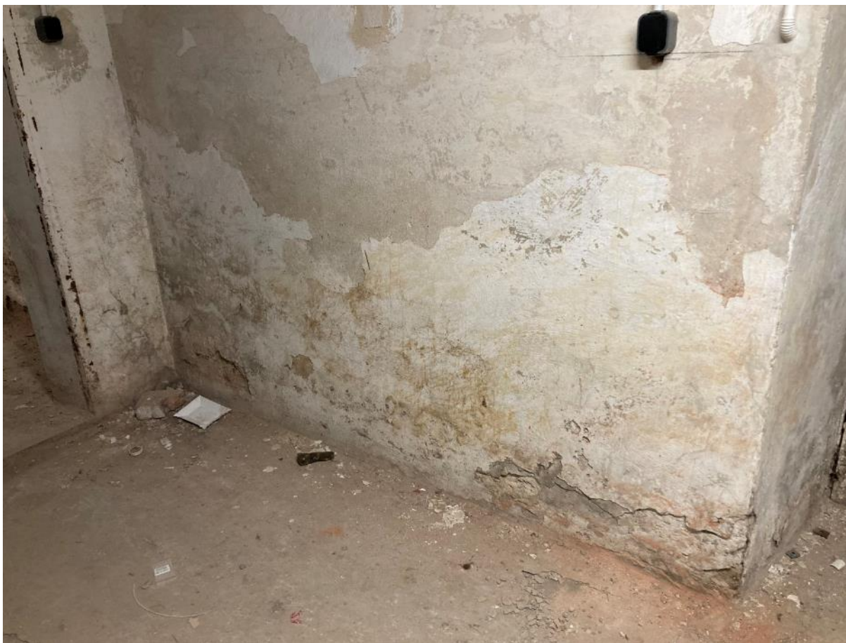
Fot. 69. Dawne Muzeum Techniczno-Przemysłowe, ul Smoleńsk 9, Kraków. Piwnice. Uszkodzenia dolnych partii ścian. Stan przed konserwacją. Czerwiec 2022. Fot. K. Sułkowska.
