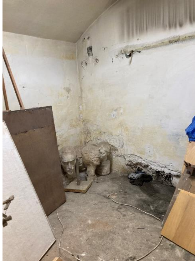
Fot. 11. Dawne Muzeum Techniczno-Przemysłowe, ul Smoleńsk 9, Kraków. Piwnice. Ubytki tynków. Stan przed konserwacją. Czerwiec 2022. Fot. K. Sułkowska.
