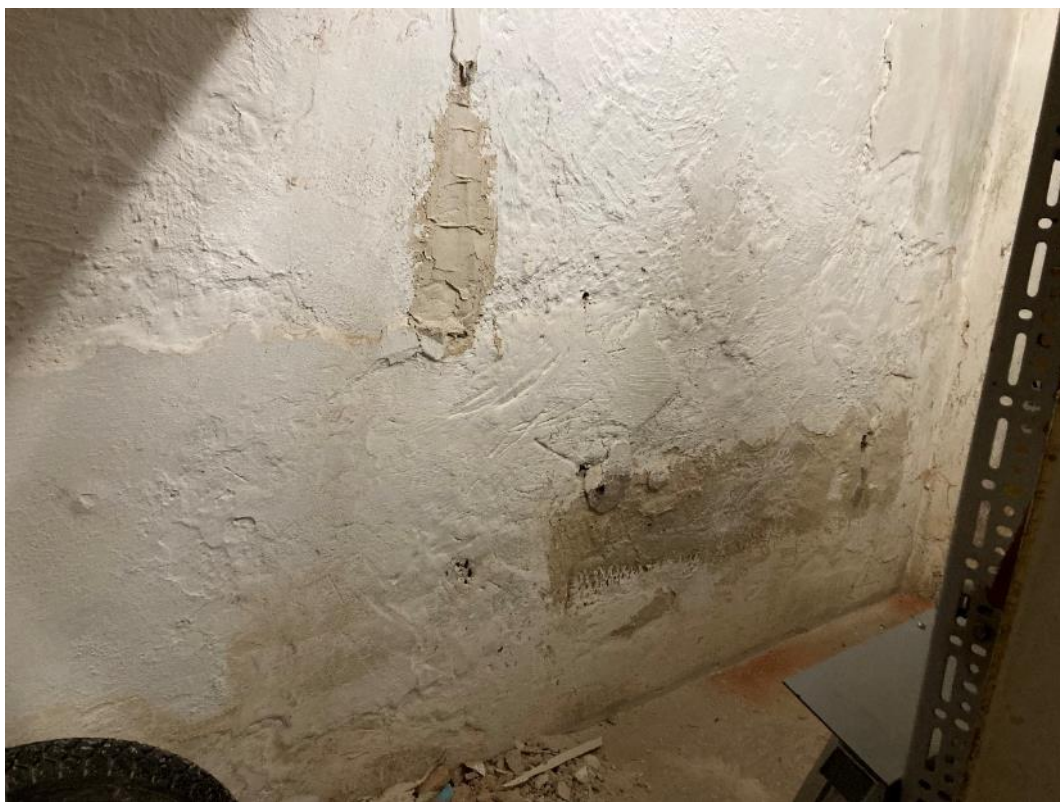
Fot. 4 Dawne Muzeum Techniczno-Przemysłowe, ul Smoleńsk 9, Kraków. Piwnice. Ubytki tynków. Stan przed konserwacją. Czerwiec 2022. Fot. K. Sułkowska.
