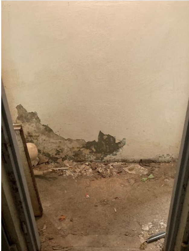
Fot. 10. Dawne Muzeum Techniczno-Przemysłowe, ul Smoleńsk 9, Kraków. Piwnice. Ubytki tynków. Stan przed konserwacją. Czerwiec 2022. Fot. K. Sułkowska.
