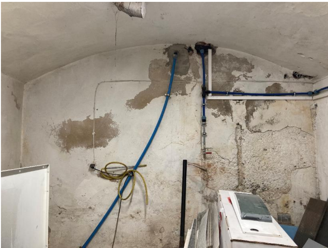
Fot. 63. Dawne Muzeum Techniczno-Przemysłowe, ul Smoleńsk 9, Kraków. Piwnice. Uszkodzone tynki. Stan przed konserwacją. Czerwiec 2022. Fot. K. Sułkowska.
