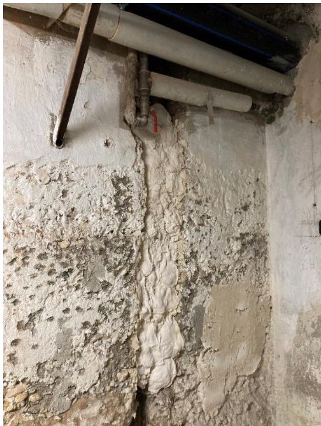
Fot. 49. Dawne Muzeum Techniczno-Przemysłowe, ul Smoleńsk 9, Kraków. Piwnice. Uszkodzona ściana żelbetowa z ubytkami tynków. Stan przed konserwacją. Czerwiec 2022. Fot. K. Sułkowska.
