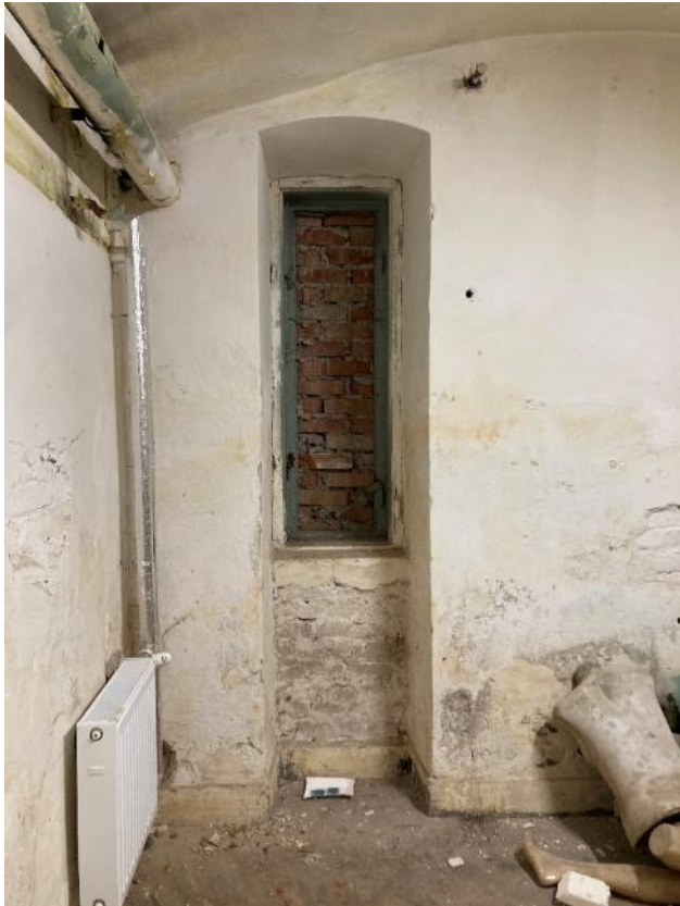
Fot. 13. Dawne Muzeum Techniczno-Przemysłowe, ul Smoleńsk 9, Kraków. Piwnice. Zamurowany pierwotny otwór okienny. Stan przed konserwacją. Czerwiec 2022. Fot. K. Sułkowska.
