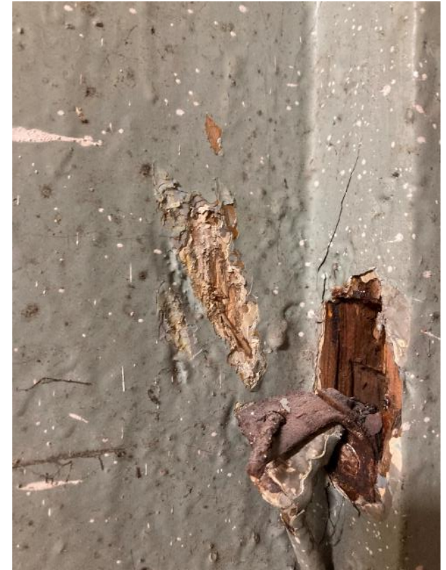
Fot. 18. Dawne Muzeum Techniczno-Przemysłowe, ul Smoleńsk 9, Kraków. Piwnice. Zamurowany pierwotny otwór okienny. Fragment oryginalnej ślusarki i naturalna odkrywka warstw malarskich. Stan przed konserwacją. Czerwiec 2022. Fot. K. Sułkowska.
