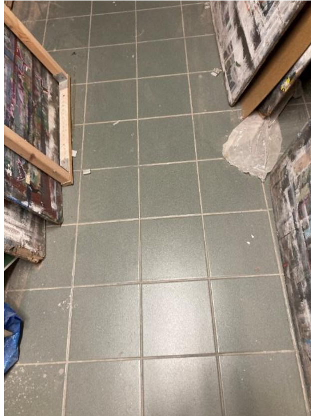
Fot. 26. Dawne Muzeum Techniczno-Przemysłowe, ul Smoleńsk 9, Kraków. Piwnice. Wtórna posadzka ceramiczna. Stan przed konserwacją. Czerwiec 2022. Fot. K. Sułkowska.
