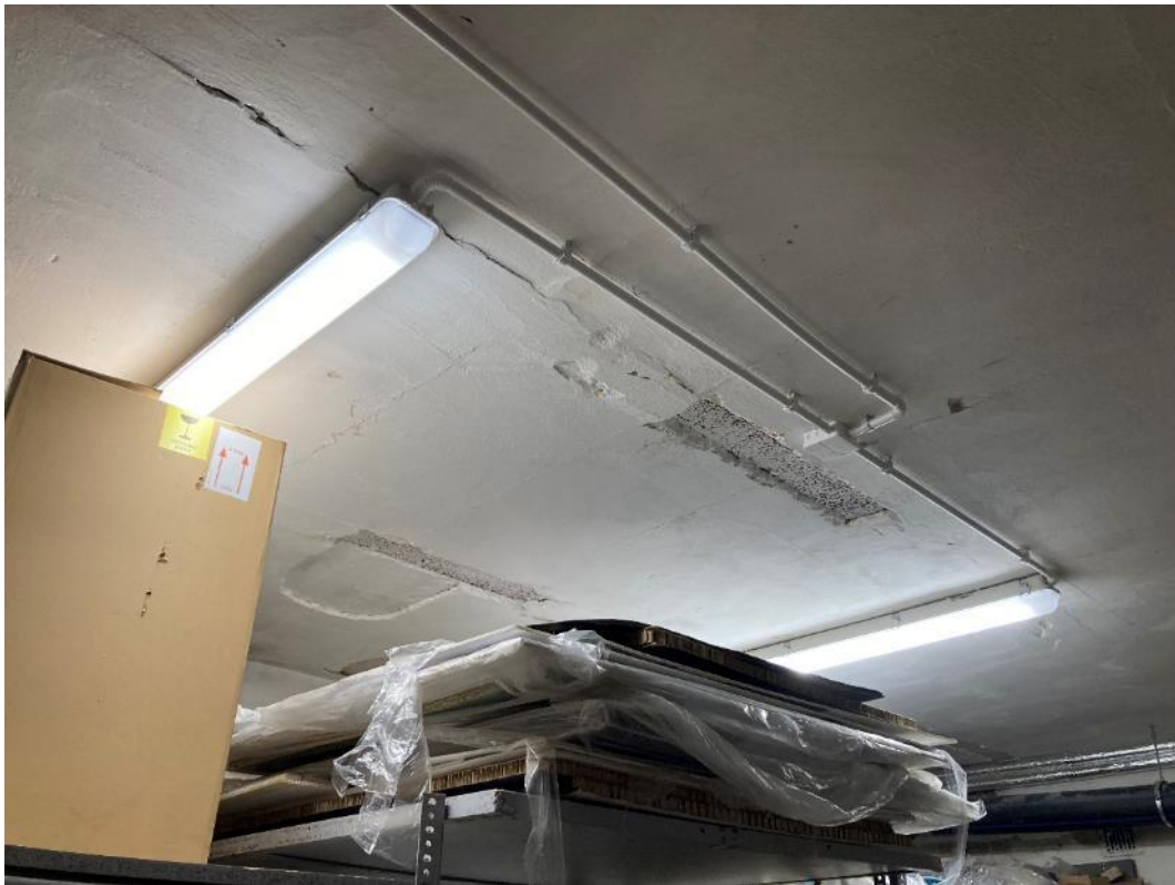
Fot. 3 Dawne Muzeum Techniczno-Przemysłowe, ul Smoleńsk 9, Kraków. Piwnice. Ubytki i pęknięcia tynków. Stan przed konserwacją. Czerwiec 2022. Fot. K. Sułkowska.
