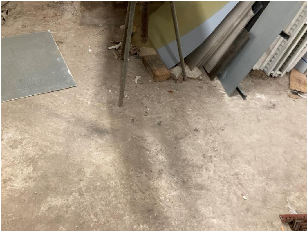
Fot. 62. Dawne Muzeum Techniczno-Przemysłowe, ul Smoleńsk 9, Kraków. Piwnice. Wylewka betonowa. Stan przed konserwacją. Czerwiec 2022. Fot. K. Sułkowska.
