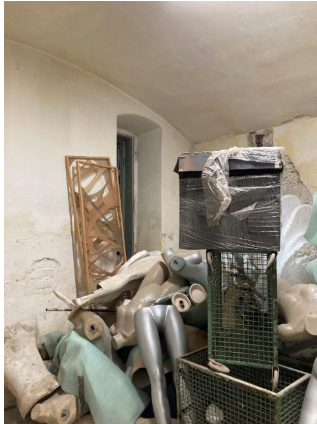
Fot. 14. Dawne Muzeum Techniczno-Przemysłowe, ul Smoleńsk 9, Kraków. Piwnice. Zamurowany pierwotny otwór okienny. Stan przed konserwacją. Czerwiec 2022. Fot. K. Sułkowska.
