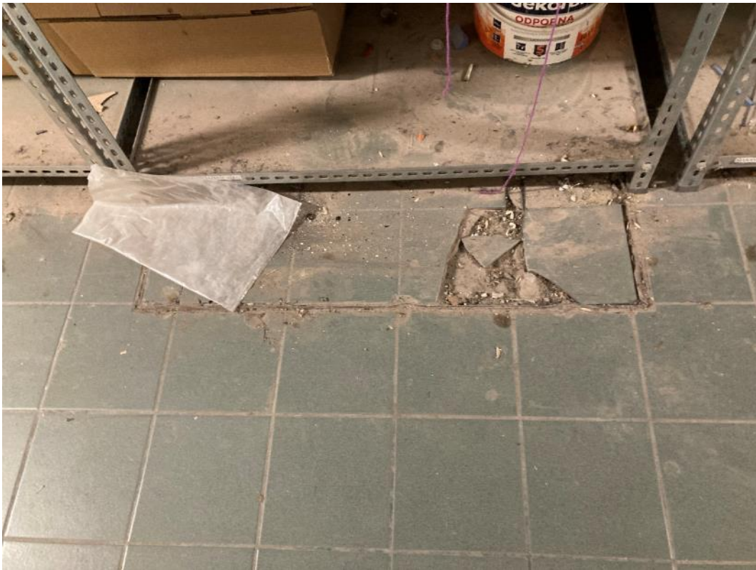
Fot. 35. Dawne Muzeum Techniczno-Przemysłowe, ul Smoleńsk 9, Kraków. Piwnice. Uszkodzona wtórna posadzka ceramiczna. Stan przed konserwacją. Czerwiec 2022. Fot. K. Sułkowska.
