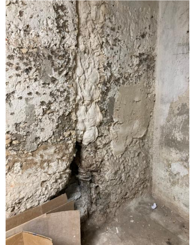
Fot. 48. Dawne Muzeum Techniczno-Przemysłowe, ul Smoleńsk 9, Kraków. Piwnice. Uszkodzona ściana żelbetowa z ubytkami tynków. Stan przed konserwacją. Czerwiec 2022. Fot. K. Sułkowska.
