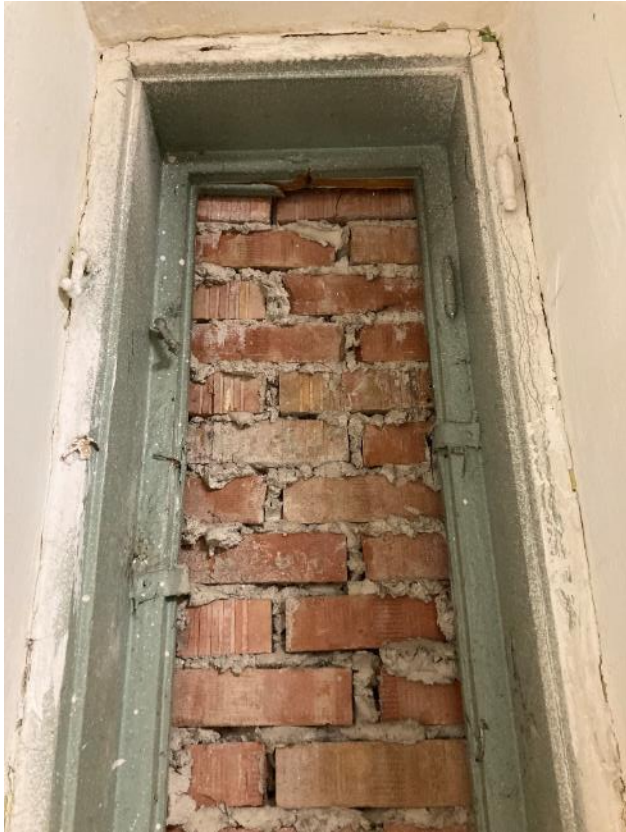
Fot. 16. Dawne Muzeum Techniczno-Przemysłowe, ul Smoleńsk 9, Kraków. Piwnice. Zamurowany pierwotny otwór okienny. Stan przed konserwacją. Czerwiec 2022. Fot. K. Sułkowska.
