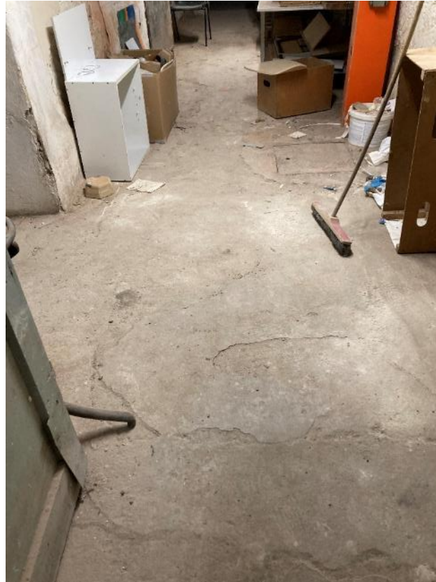
Fot. 47. Dawne Muzeum Techniczno-Przemysłowe, ul Smoleńsk 9, Kraków. Piwnice. Uszkodzona wylewka betonowa. Stan przed konserwacją. Czerwiec 2022. Fot. K. Sułkowska.
