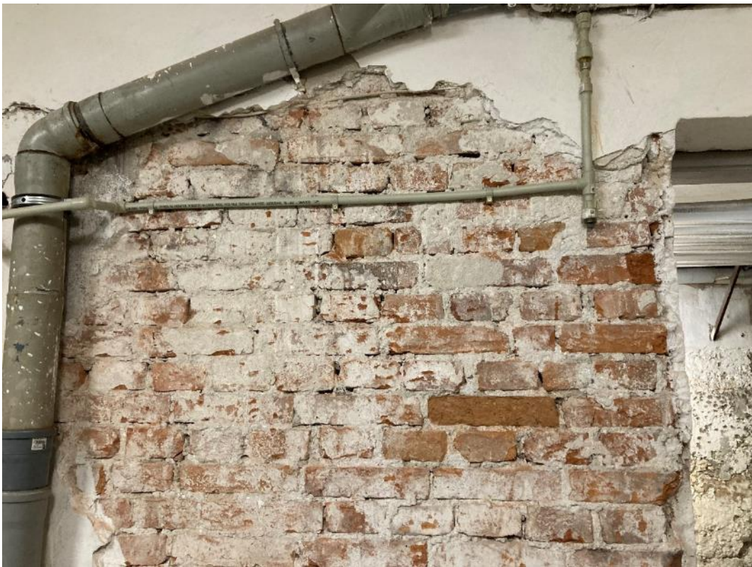
Fot. 2 Dawne Muzeum Techniczno-Przemysłowe, ul Smoleńsk 9, Kraków. Piwnice. Ubytki tynków. Stan przed konserwacją. Czerwiec 2022. Fot. K. Sułkowska.
