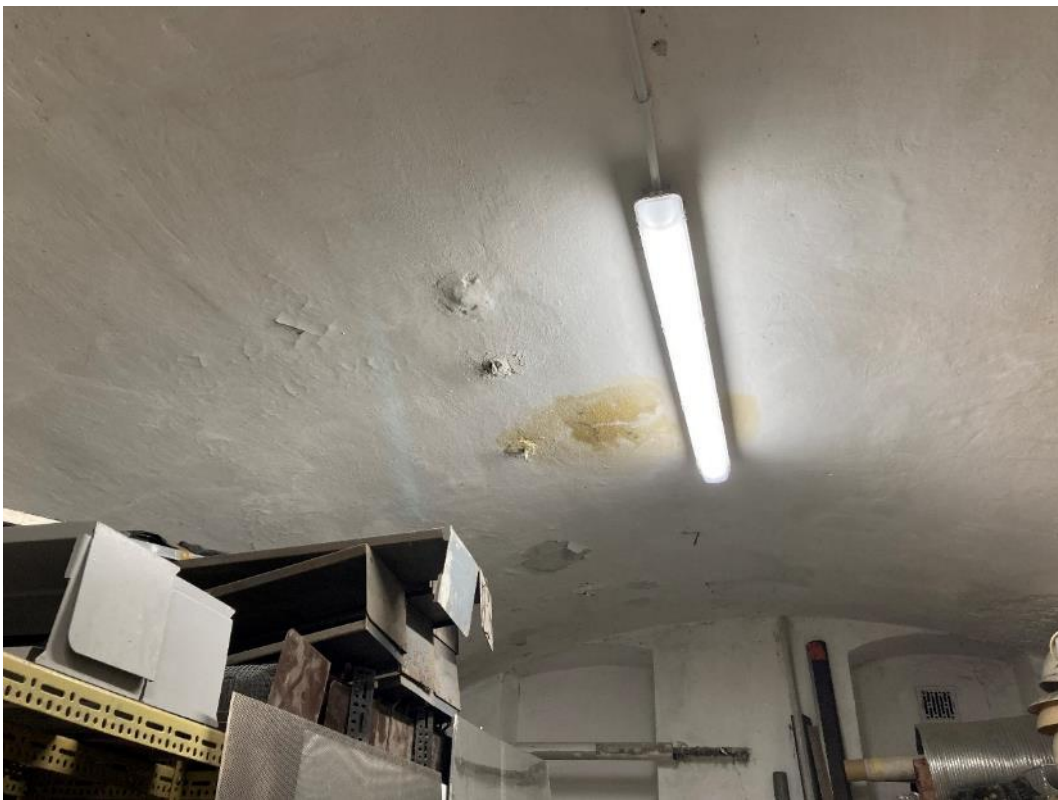
Fot. 65. Dawne Muzeum Techniczno-Przemysłowe, ul Smoleńsk 9, Kraków. Piwnice. Spękania i przebarwienia tynku w obrębie sufitu pomieszczenia. Stan przed konserwacją. Czerwiec 2022. Fot. K. Sułkowska.
