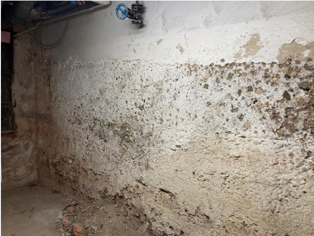
Fot. 55. Dawne Muzeum Techniczno-Przemysłowe, ul Smoleńsk 9, Kraków. Piwnice. Uszkodzona ściana żelbetowa z ubytkami tynków. Stan przed konserwacją. Czerwiec 2022. Fot. K. Sułkowska.
