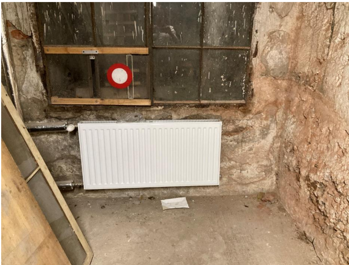
Fot. 58. Dawne Muzeum Techniczno-Przemysłowe, ul Smoleńsk 9, Kraków. Piwnice. Przekształcone oryginalne stalowe wielopolowe okno, skorodowane. Szklenie zaplamione farbą. Stan przed konserwacją. Czerwiec 2022. Fot. K. Sułkowska.
