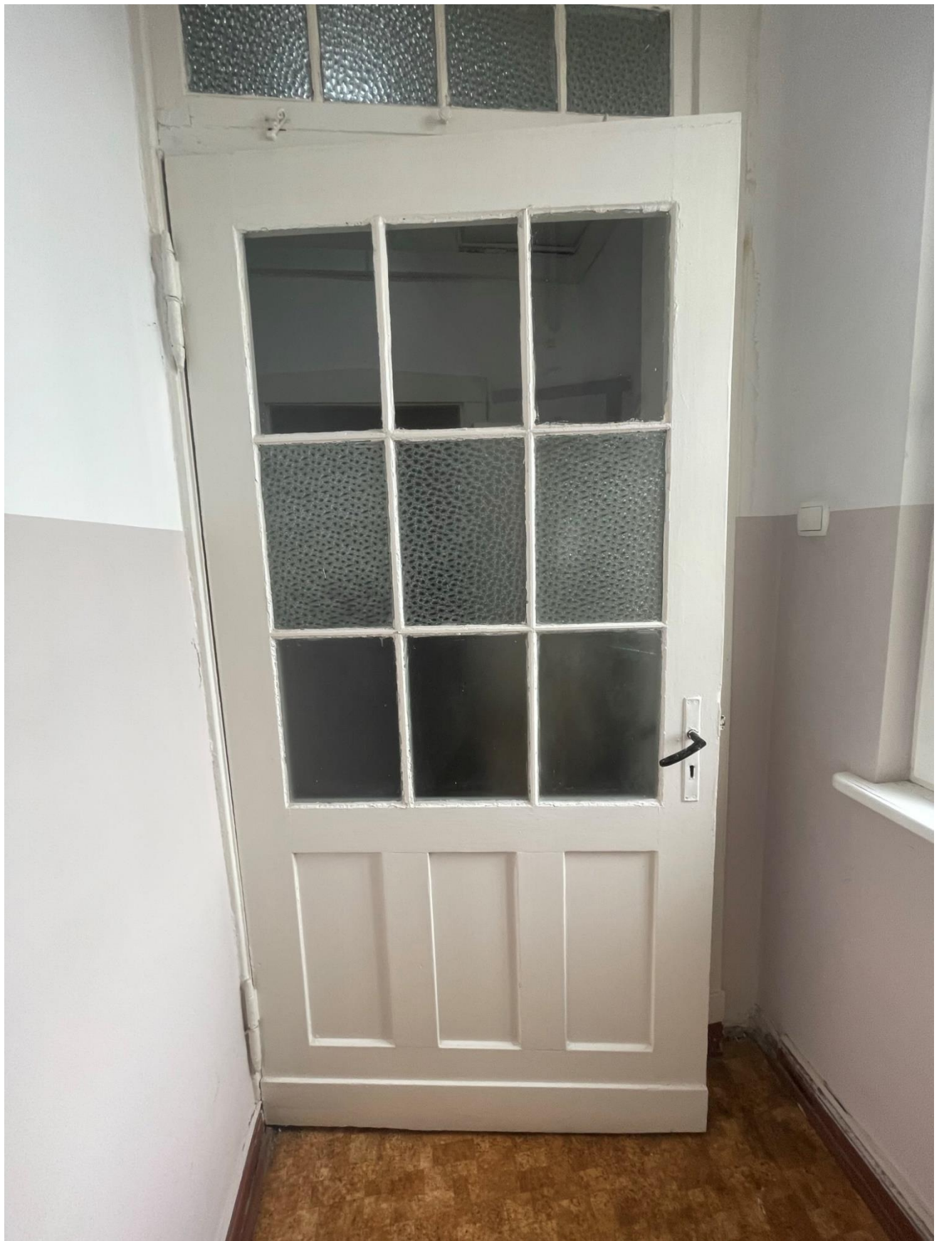
Drzwi D4 skrzydło z częściowo zachowanym szkleniem
