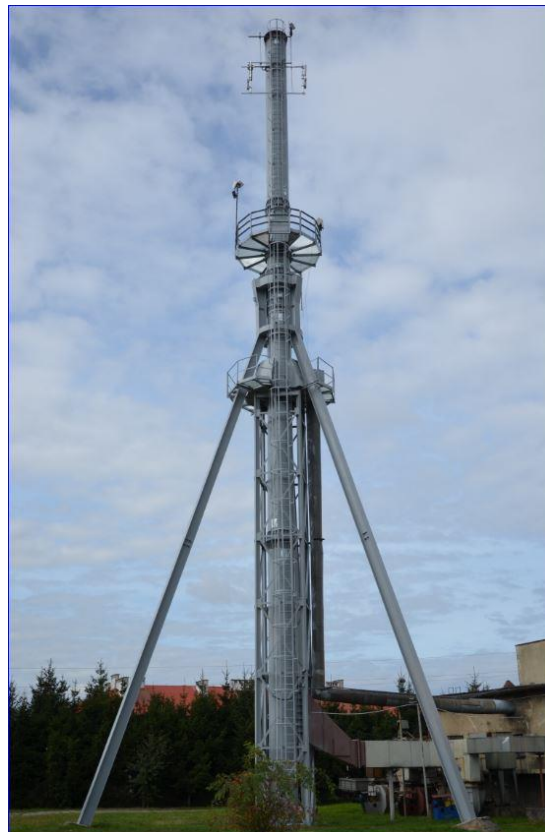
Komin na kotłowni w Starej Łubiance
