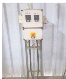
l) Hala magazynowa B5 – rozdzielnia główna
