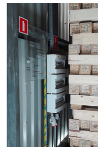
d) Budynek nr 4 – rozdzielnia
