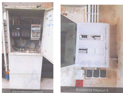
d) Budynek nr 2 – złącze kablowe, rozdzielnia główna
