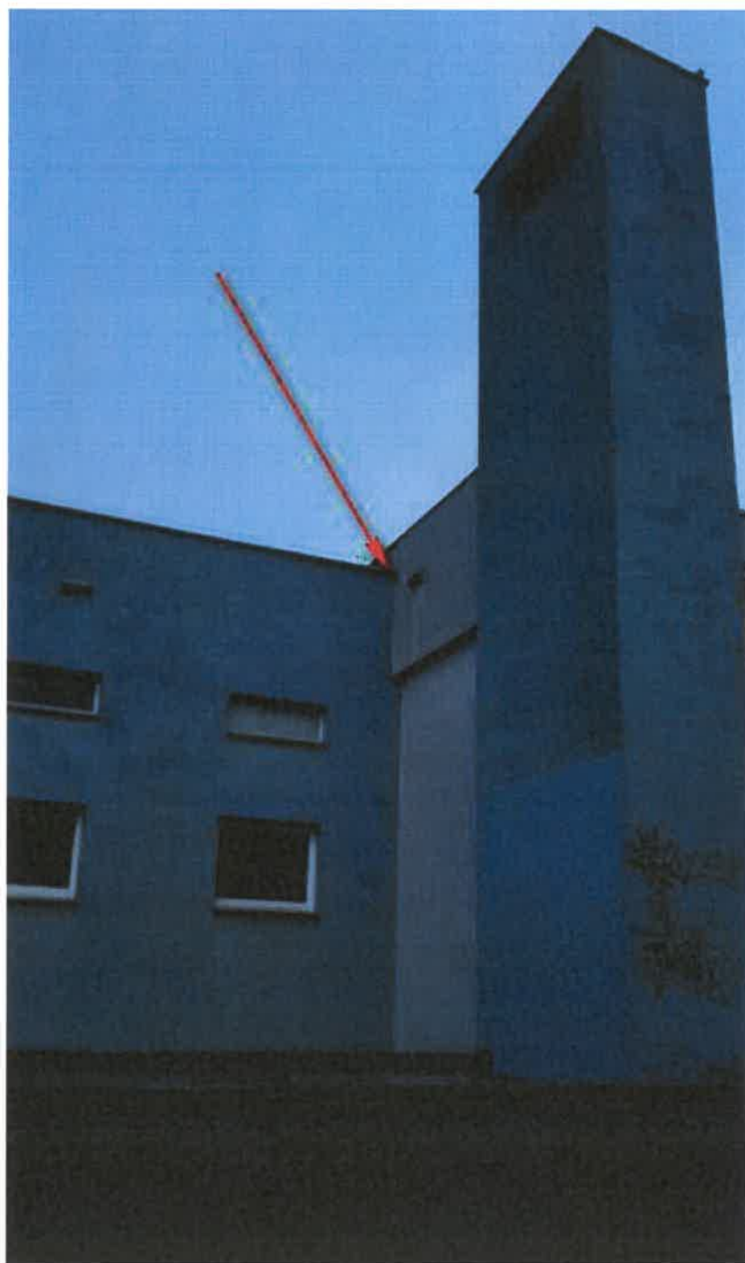
Zdjęcie 6 Stwierdzone miejsca gniazdowania wróbla domowego w tylnej ścianie budynku Wydziału humanistycznego.
