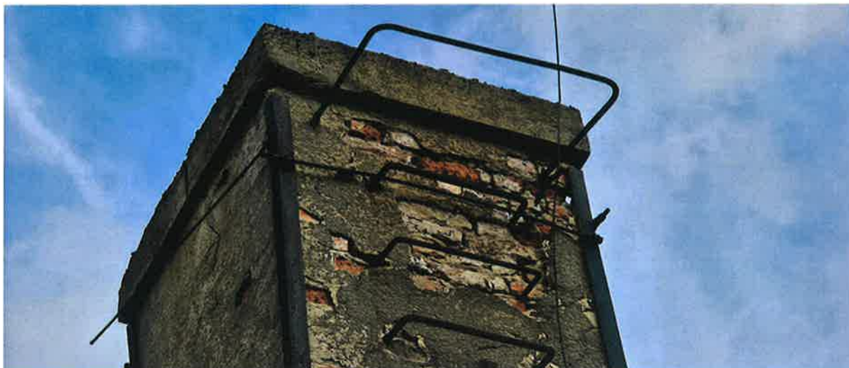
Fot. nr 10 – Pęknięcia i ubytki tynku komina nad kotłownią
