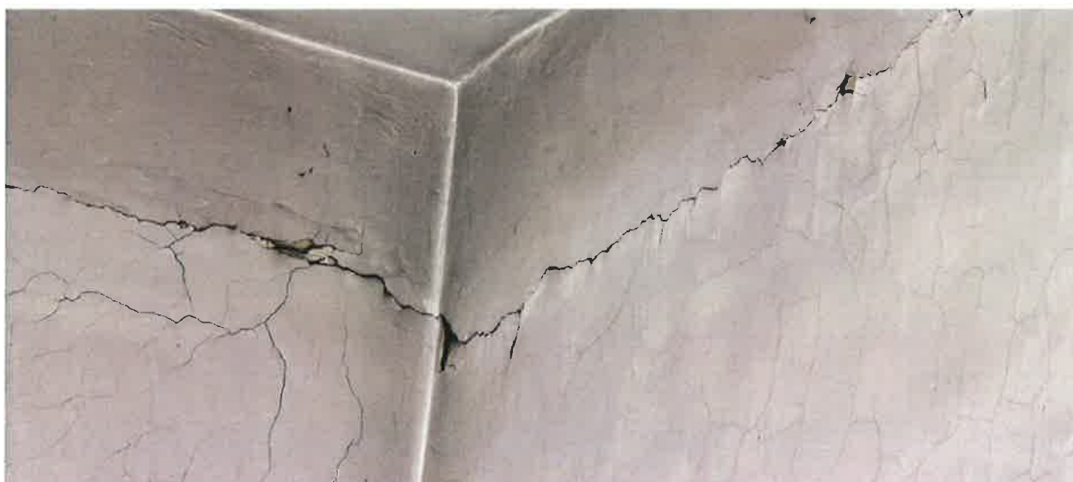
Fot. nr 23 – Pęknięcie ściany na klatce schodowej
