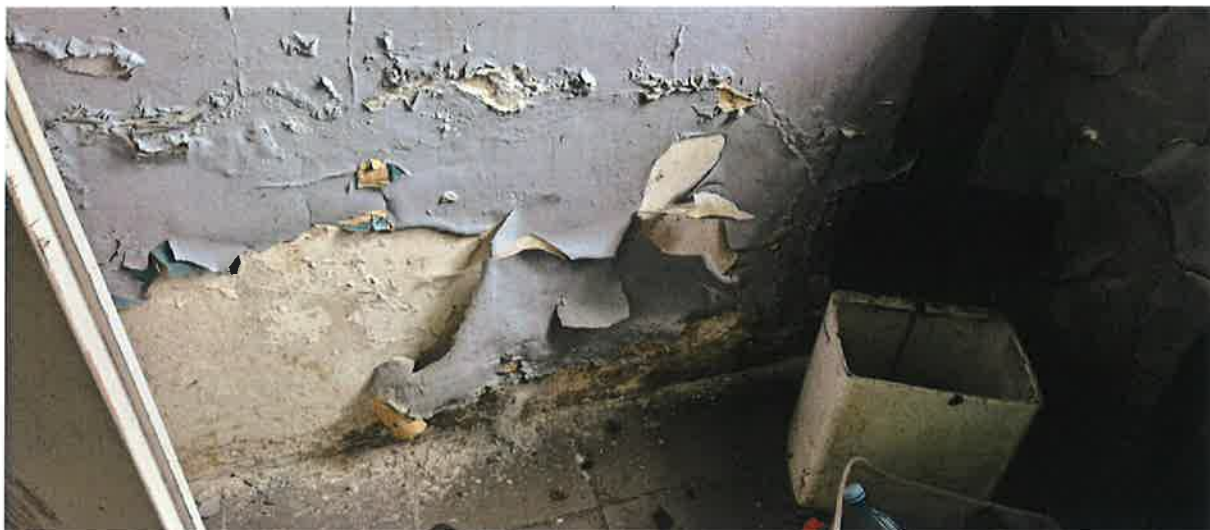
Fot. nr 16 – Podciąganie kapilarne na ścianie
