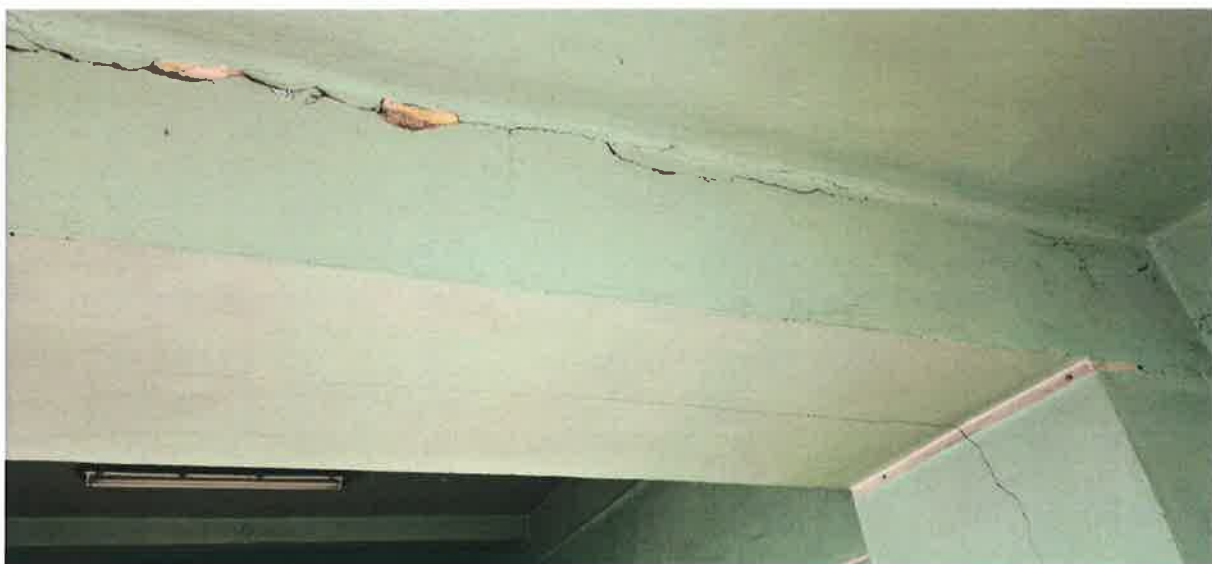
Fot. nr 15 – Pęknięcie pomiędzy sufitem a podciągami
