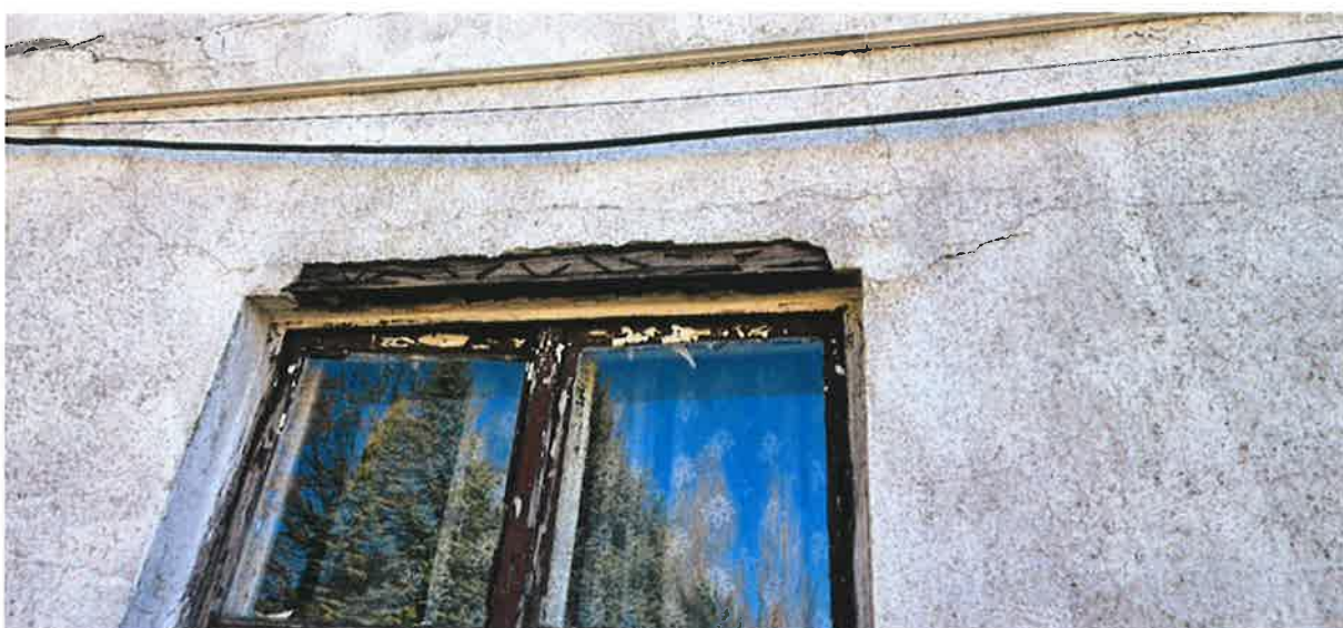
Fot. nr 8 – Nadproże drewniane nad oknem
