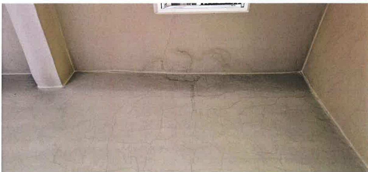
Fot. nr 21 – Zacieki i pęknięcia na ścianie i suficie
