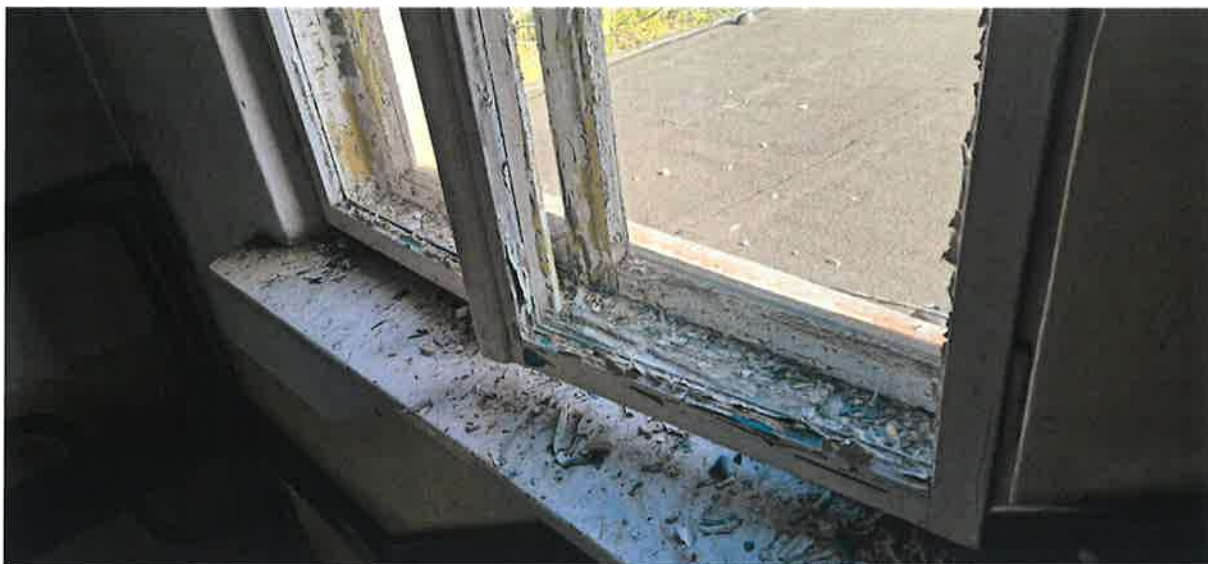
Fot. nr 28 – Zły stan techniczny okna
