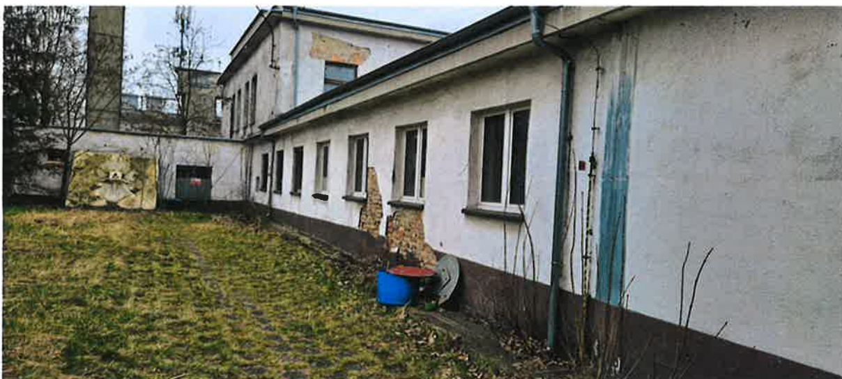
Fot. nr 1 – Odpadający tynk na elewacjach
