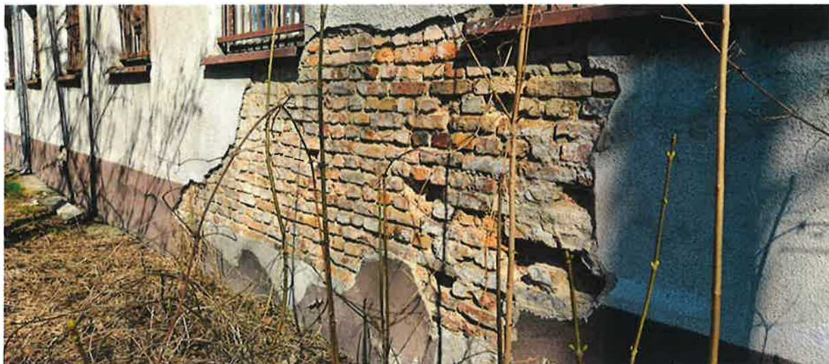
Fot. nr 7 – Odpadający tynk i pęknięcie ściany
