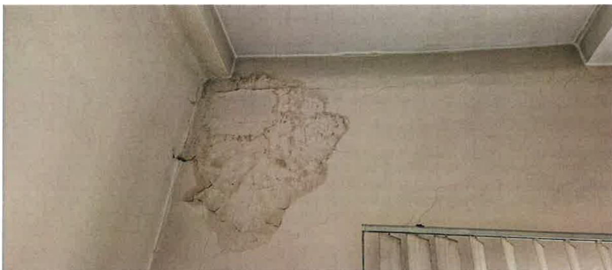
Fot. nr 19 – Zacieki i pęknięcia na ścianie
