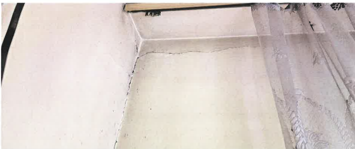
Fot. nr 24 – Pęknięcie ściany
