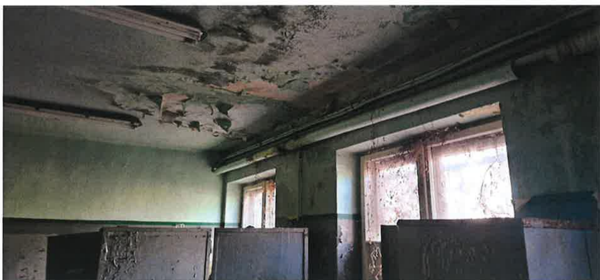
Fot. nr 18 – Odpadająca farba na suficie i ścianach w szatni
