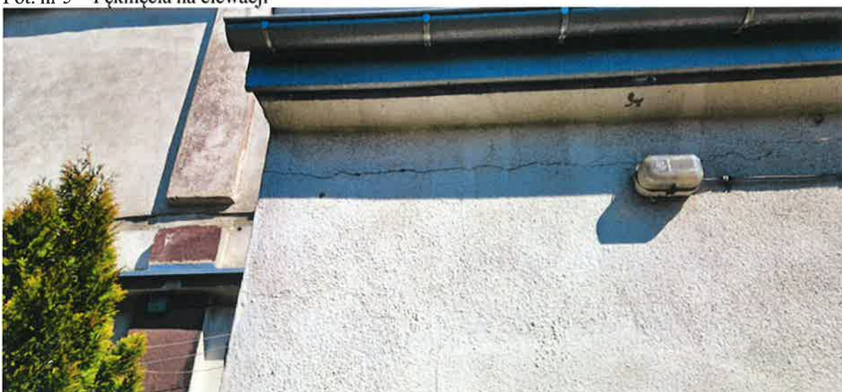
Fot. nr 6 – Pęknięcie ściany
