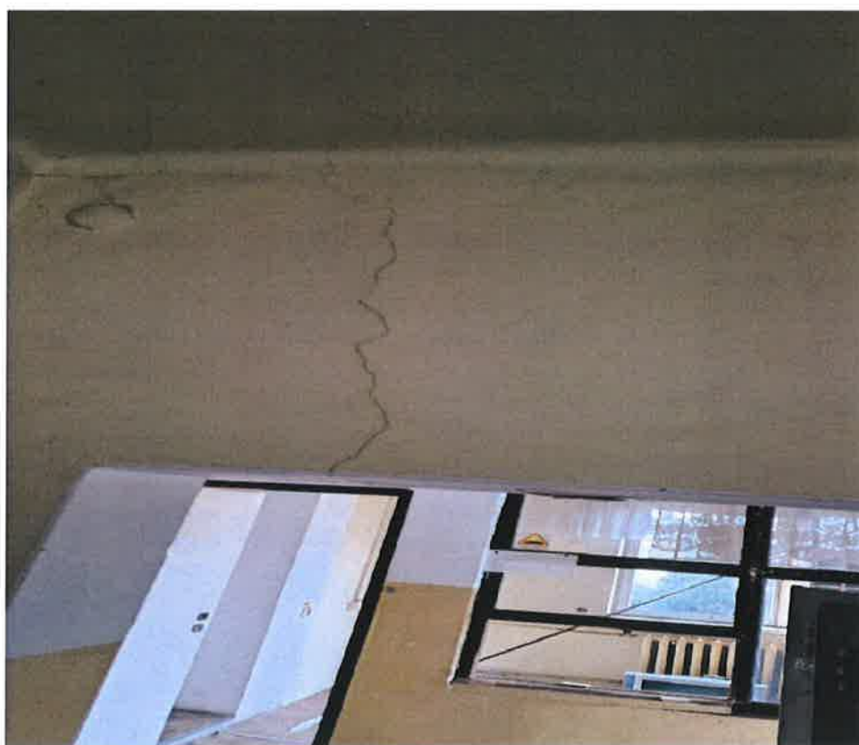
Fot. nr 29 – Pęknięcie ściany i nadproża
