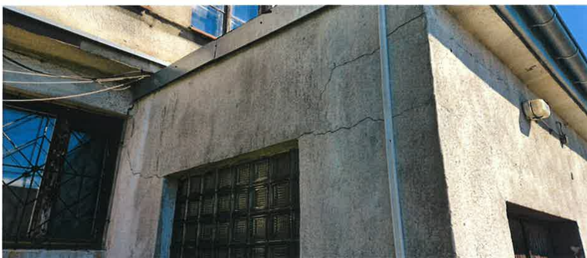
Fot. nr 5 – Pęknięcia na elewacji
