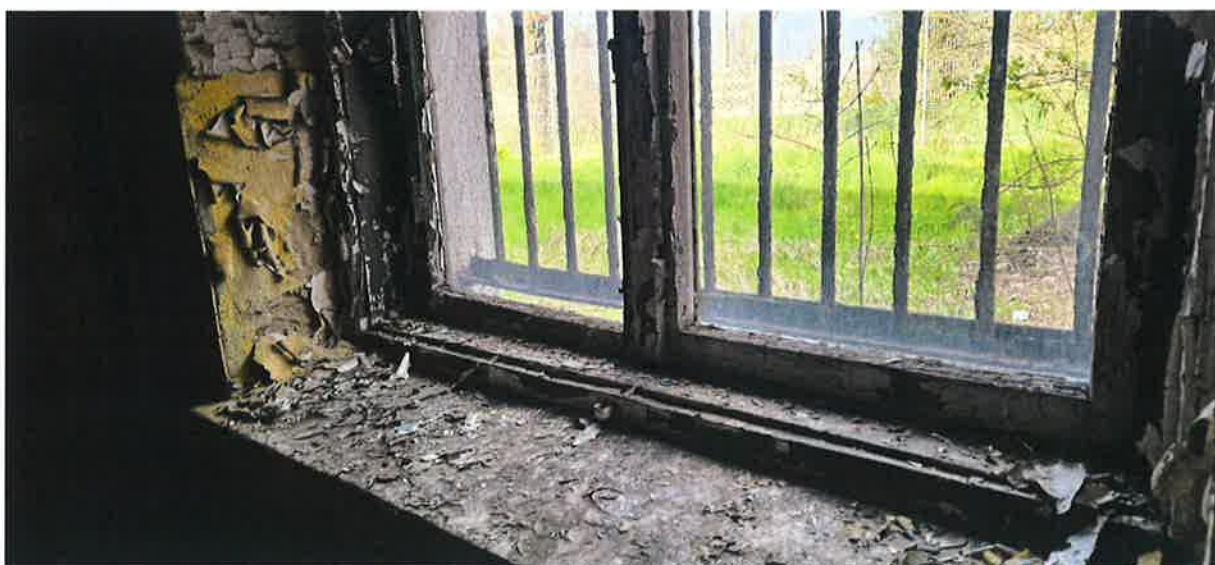
Fot. nr 27 – Zły stan techniczny okna
