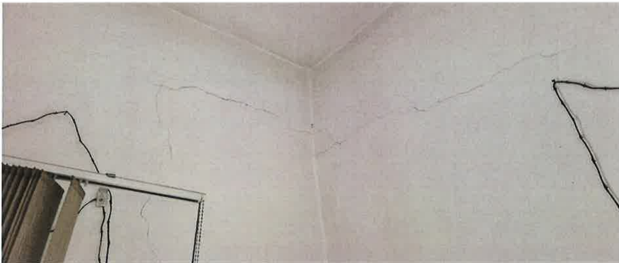
Fot. nr 25 – Pęknięcie na ścianie
