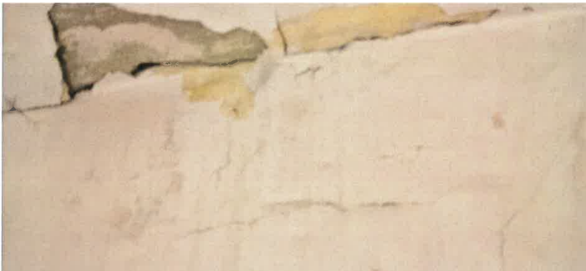
Fot. nr 22 – Pęknięcie na ścianie
