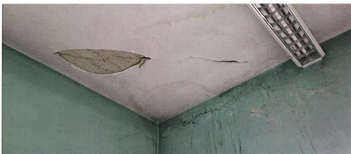
Fot. nr 20 – Zacieki i pęknięcia na ścianie i suficie. Pęknięcie stropu żelbetowego.
