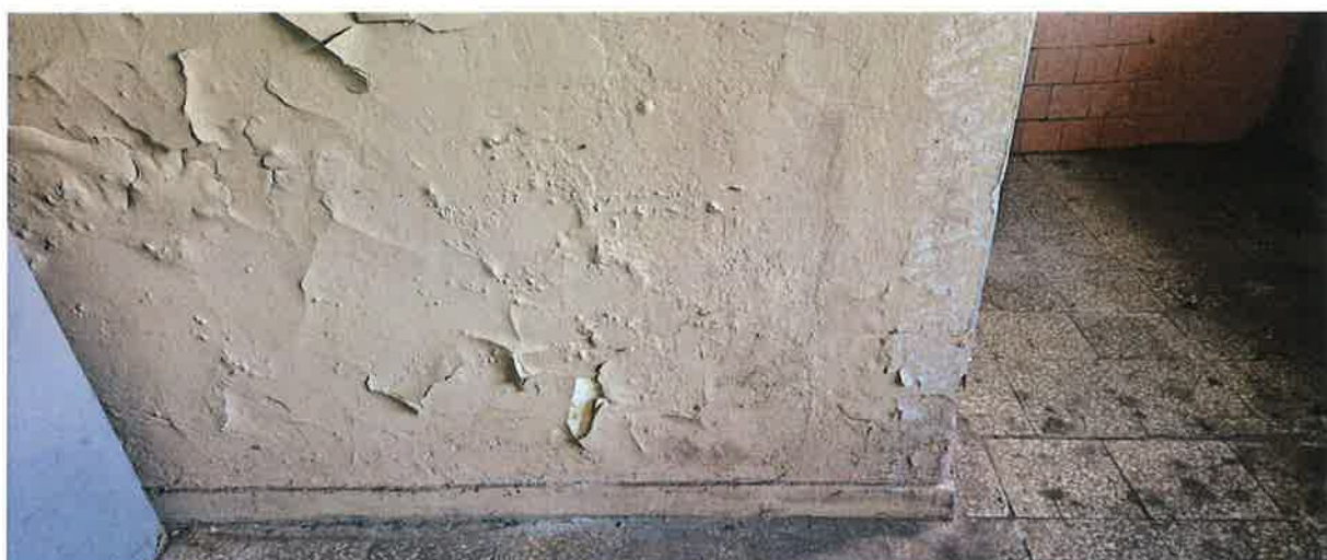
Fot. nr 17 – Podciąganie kapilarne na ścianie
