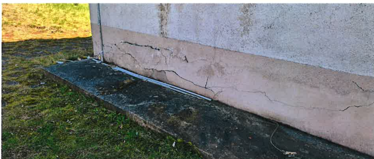
Fot. nr 2 – Pęknięcia i odparzony tynk na elewacji
