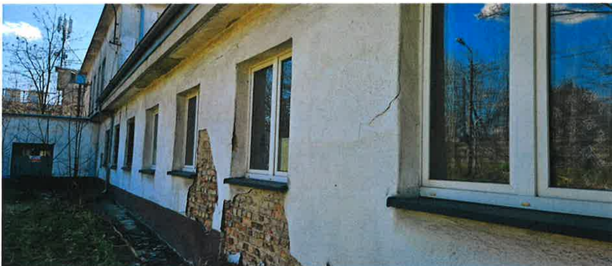
Fot. nr 4 – Odpadający tynk i pęknięcie ściany
