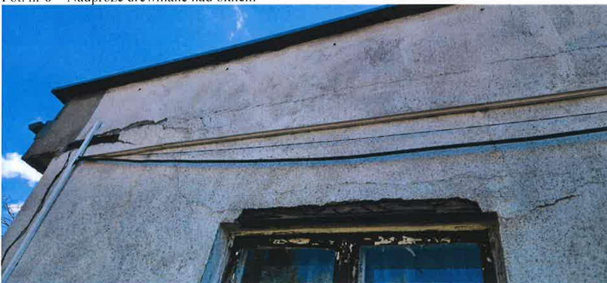
Fot. nr 9 – Pęknięcia ściany
