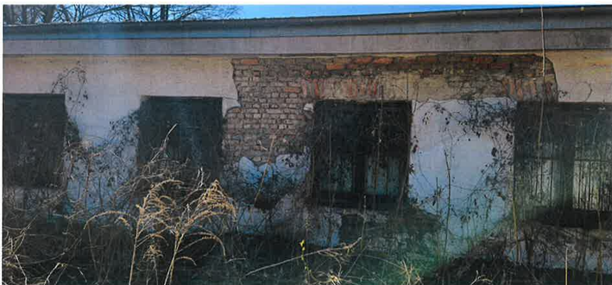
Fot. nr 3 – Pęknięcia i odparzony tynk na elewacji
