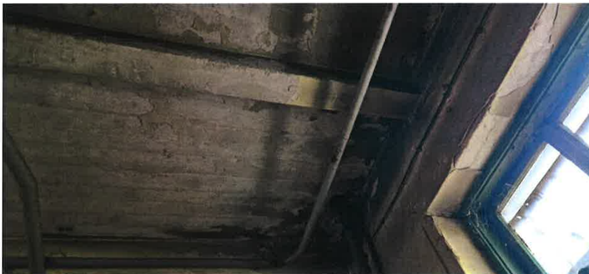
Fot. nr 13 – Sufit w kotłowni - zacieki
