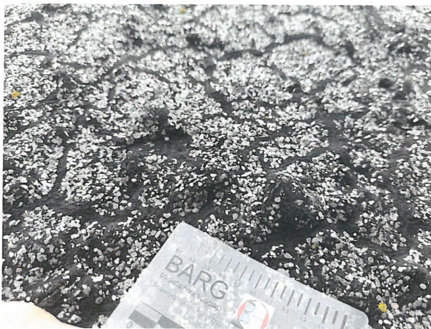
Fot. 7.12 Uszkodzenie dachu – bąble na powierzchni papy
