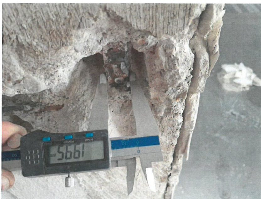
Fot. 8.27 Odkrywka zbrojenia – słup nr 1 – zbrojenie główne – pręt kwadratowy 20 mm
