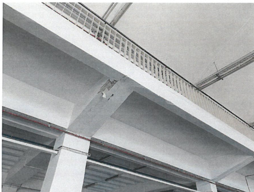
Fot. 7.31 Wykruszenia fragmentów tynku – konstrukcja antresoli
