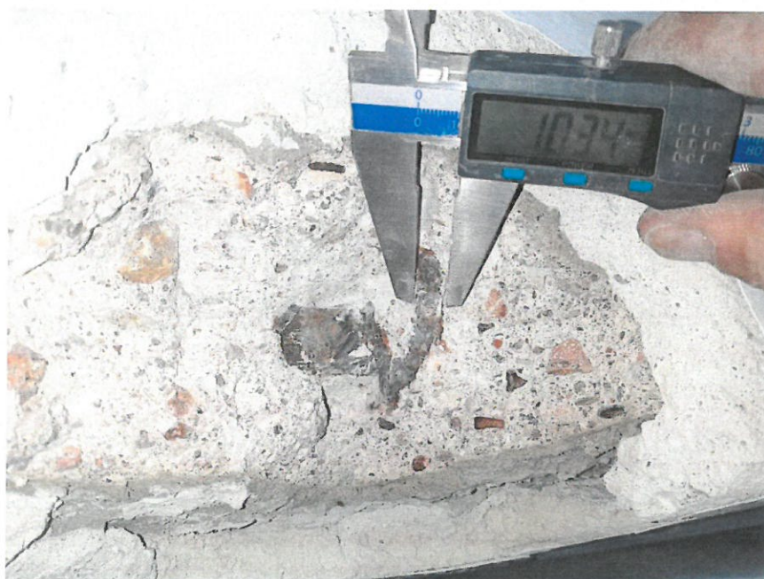
Fot. 8.14 Odkrywka zbrojenia – strop płaski – podciąg poprzeczny - pręt \varnothing 10 mm
