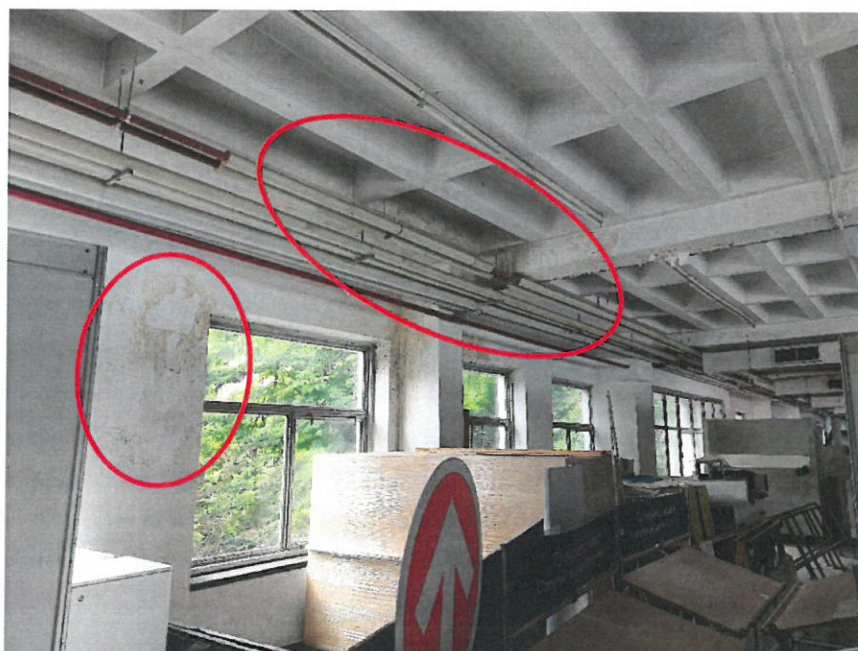
Fot. 7.29 Miejsca przecieków – konstrukcja dachu płaskiego nad antresolą
