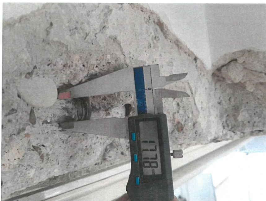
Fot. 8.11 Odkrywka zbrojenia – strop płaski – żebro pkt 3 – pręt główny 18 mm
