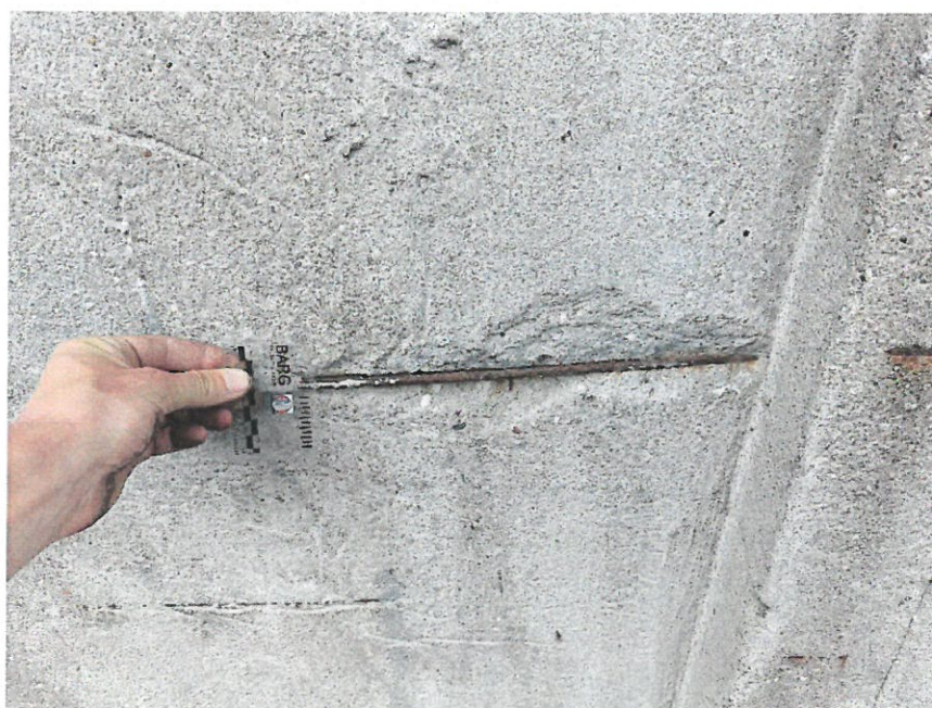
Fot. 7.25 Odślonięte pręty zbrojeniowe – korozja stali
