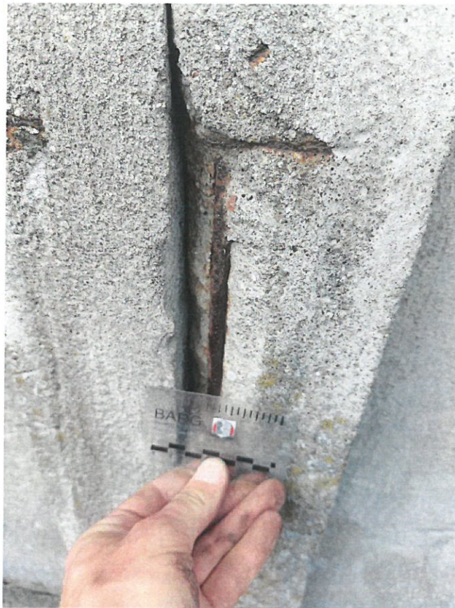
Fot. 7.22 Wykruszenie otuliny zbrojiny – ściana attykowa
