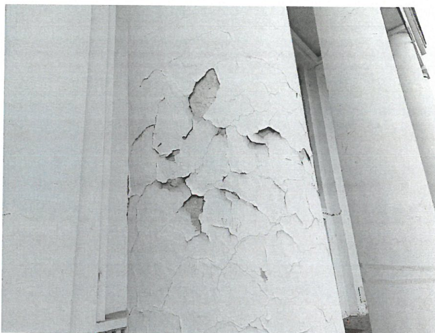
Fot. 7.6 Uszkodzenia tynków na kolumnach portyków
