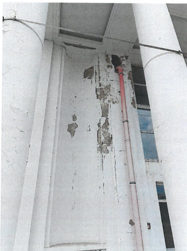
Fot. 7.5 Uszkodzenia ściany ceglanej – montaż odwodnienia
