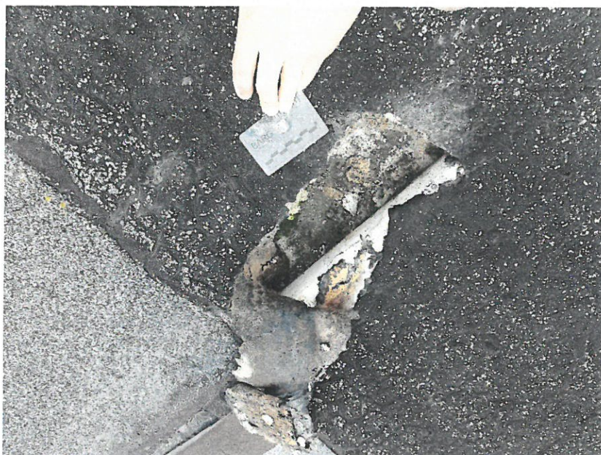
Fot. 7.16 Ubytki w warstwie izolacji oraz papy
