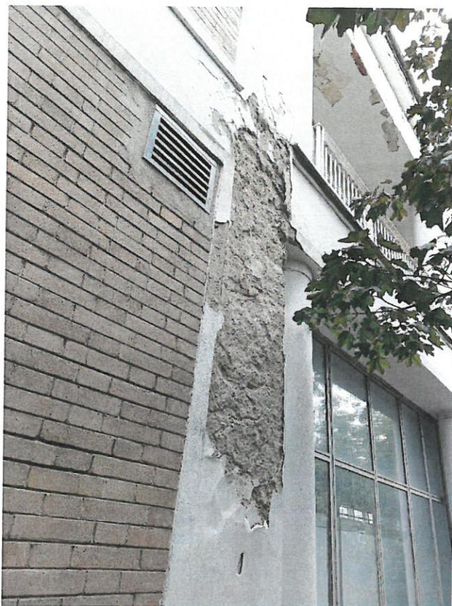
Fot. 7.2 Widok uszkodzeń elewacji – wykruszenia tynków
