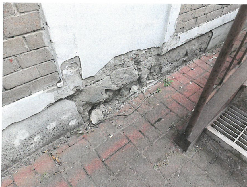
Fot. 7.7 Wykruszenia elementów elewacji przy gruncie
