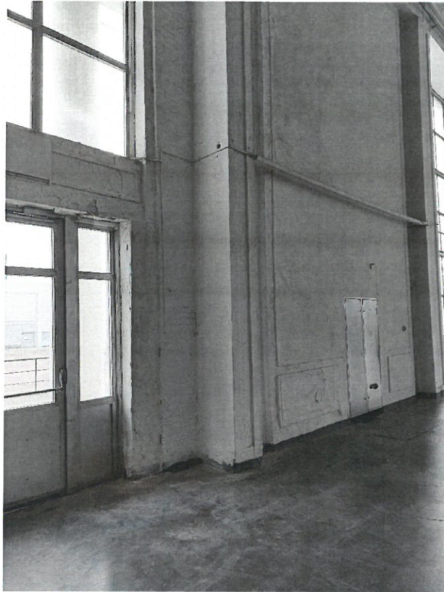
Fot. 7.32 Zły stan techniczny pokrycia ścian zewnętrznych – braki w pokryciu tynkiem, wykruszenia oraz odspojenia tynku
