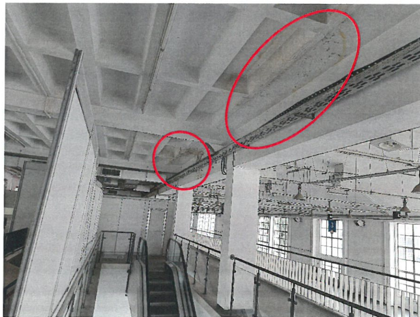
Fot. 7.33 Odsparowanie się farby i tynku – miejsca przecieków - strop płaski
