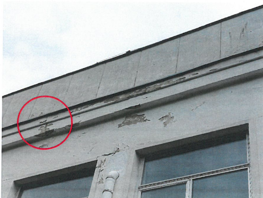
Fot. 7.3 Uszkodzenia elewacji – odspojenia warstwy tynku oraz zarysowania (kolor czerwony)
