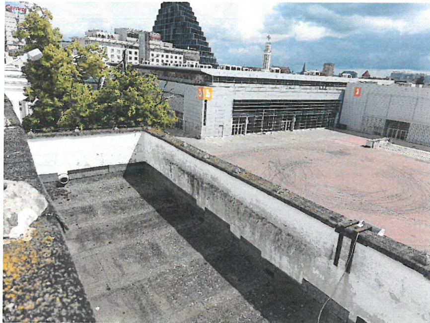
Fot. 7.26 Stan pokrycia dachowego portyków – widoczna korozja biologiczna
