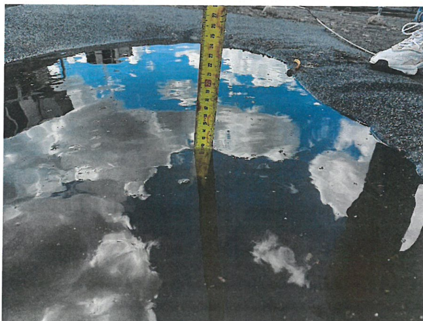
Fot. 7.11 Uszkodzenie dachu – miejsce gromadzenia się wody deszczowej – maksymalna głębokość kałuży 12 cm
