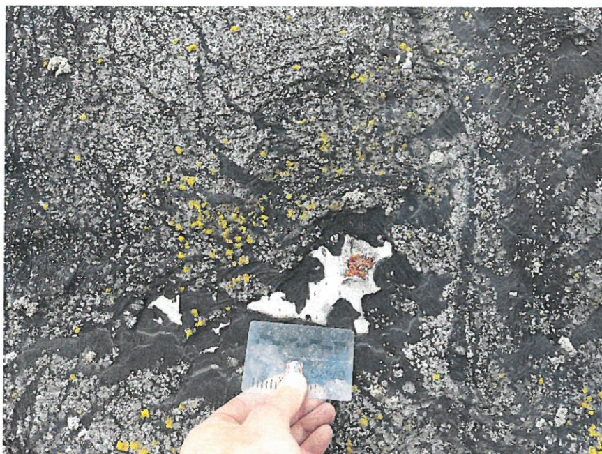
Fot. 7.19 Występowanie porostów oraz ubytki papy
