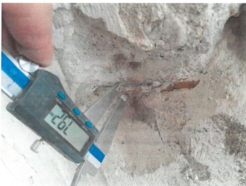
Fot. 8.28 Odkrywka zbrojenia - słup nr 1 – pomiar strzemienia – pręt okrągły \varnothing 8 mm
