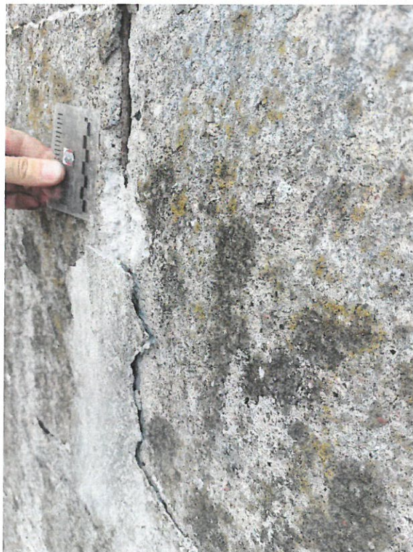
Fot. 7.21 Wykruszenia otuliny zbrojenia – widoczne stosowanie warstw naprawczych. Korozja zbrojenia stalowego
