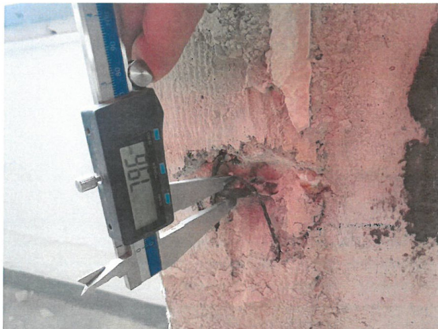
Fot. 8.32 Odkrywka zbrojenia – słup nr 6 – pomiar strzemienia – pręt okrągły \varnothing 8 mm
