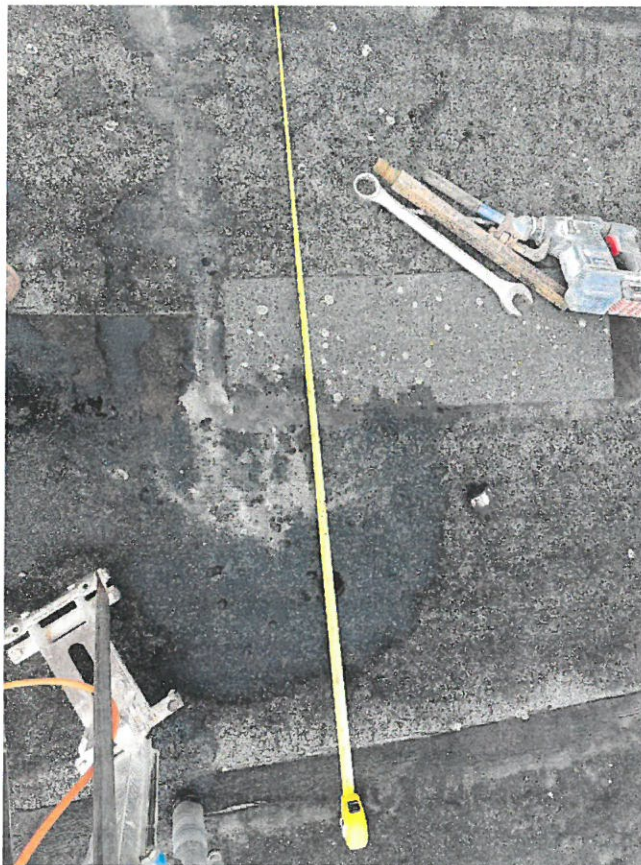
Fot. 8.3 Lokalizacja odwiertu nr 2 – konstrukcja dachu płaskiego. Na miarce odległość odwiertu w linii prostej do ściany attykowej.
