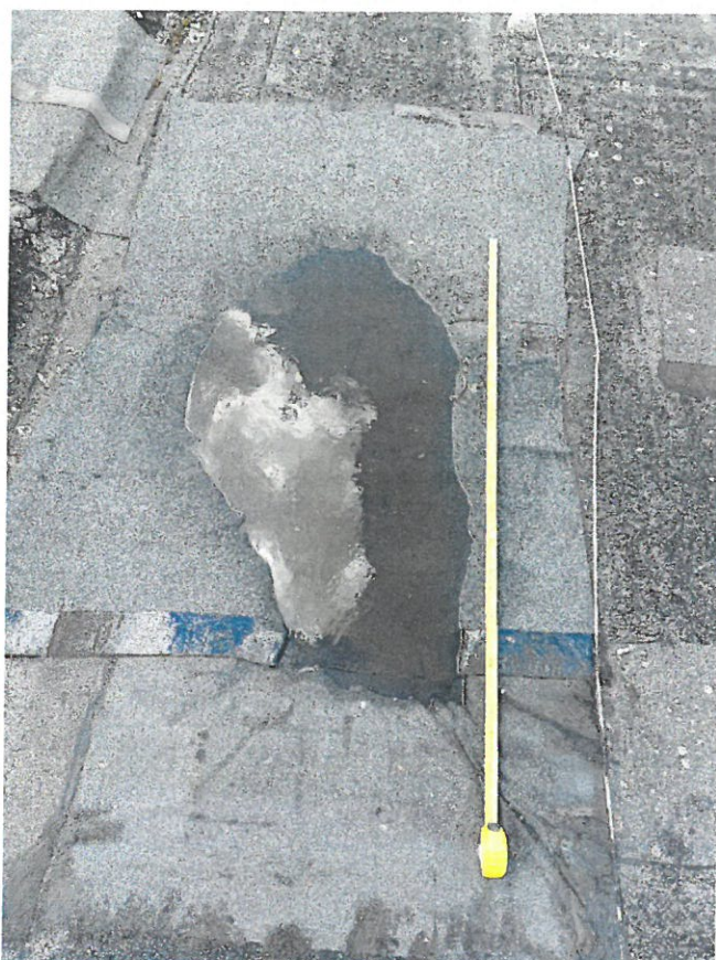
Fot. 7.10 Uszkodzenie dachu – miejsce gromadzenia się wody deszczowej
