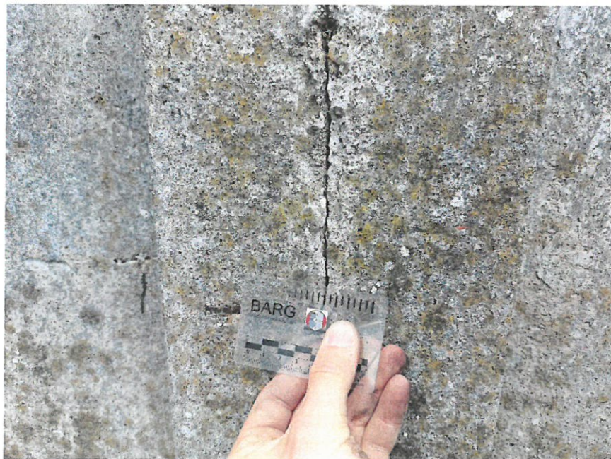
Fot. 7.23 Zarysowania ściany attykowej – 0,7mm
