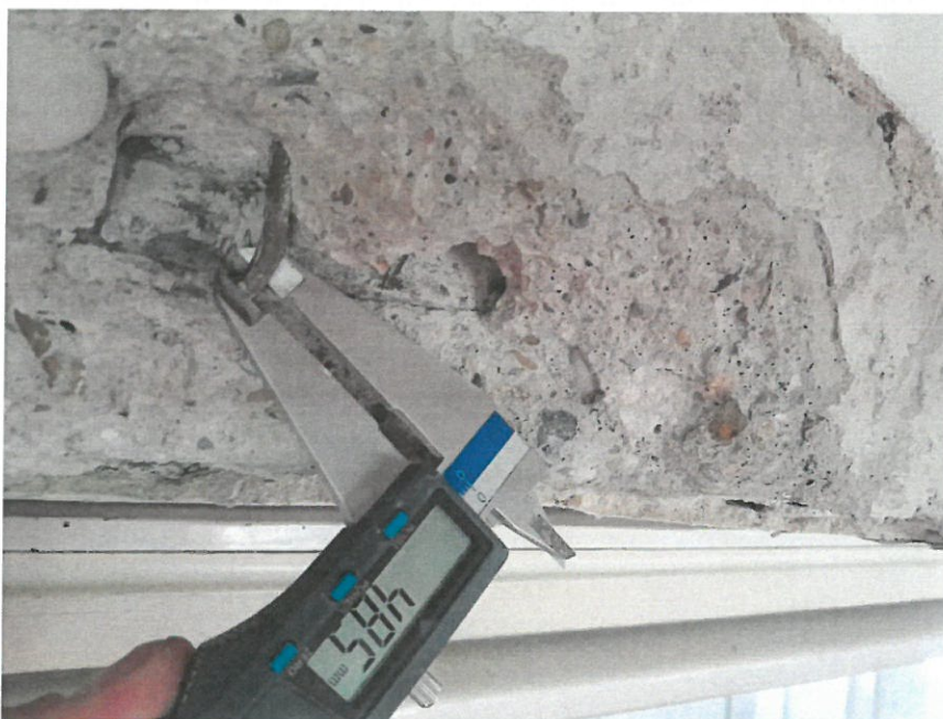
Fot. 8.11 Odkrywka zbrojenia – strop płaski – strzemię pkt 3 – pręt \varnothing 4,5 mm
