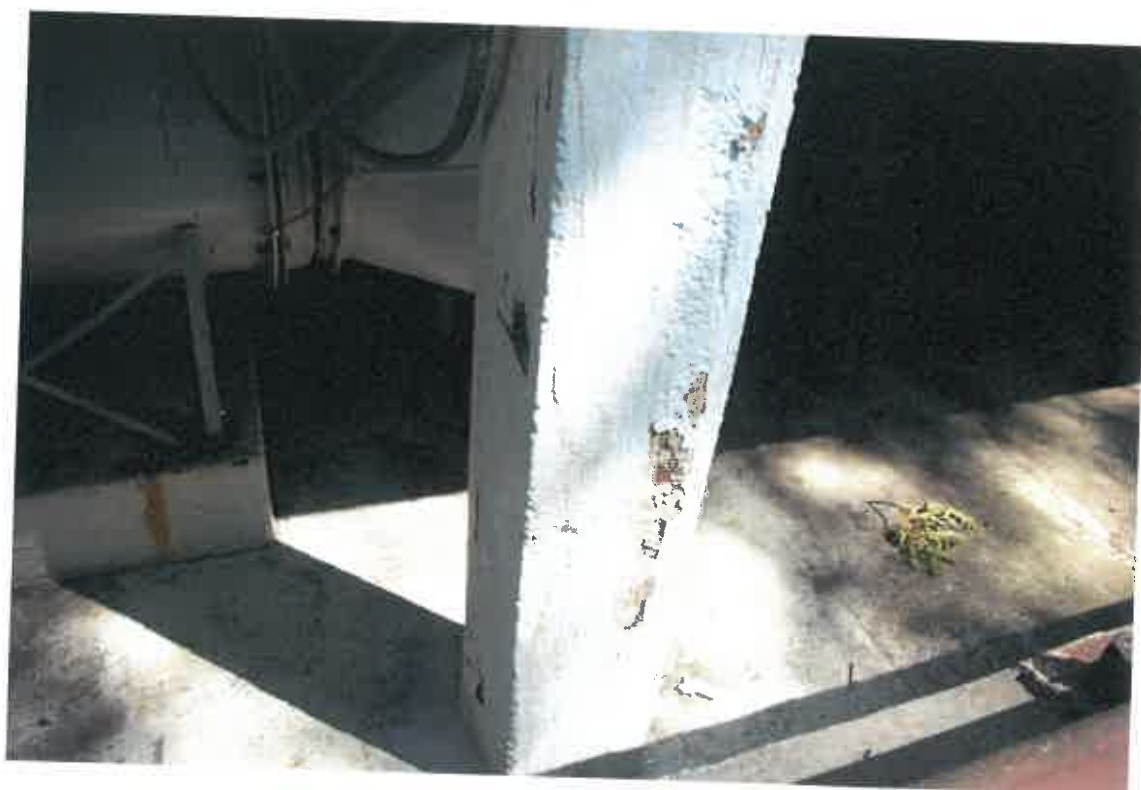
Widoczne uszkodzenia słupów
