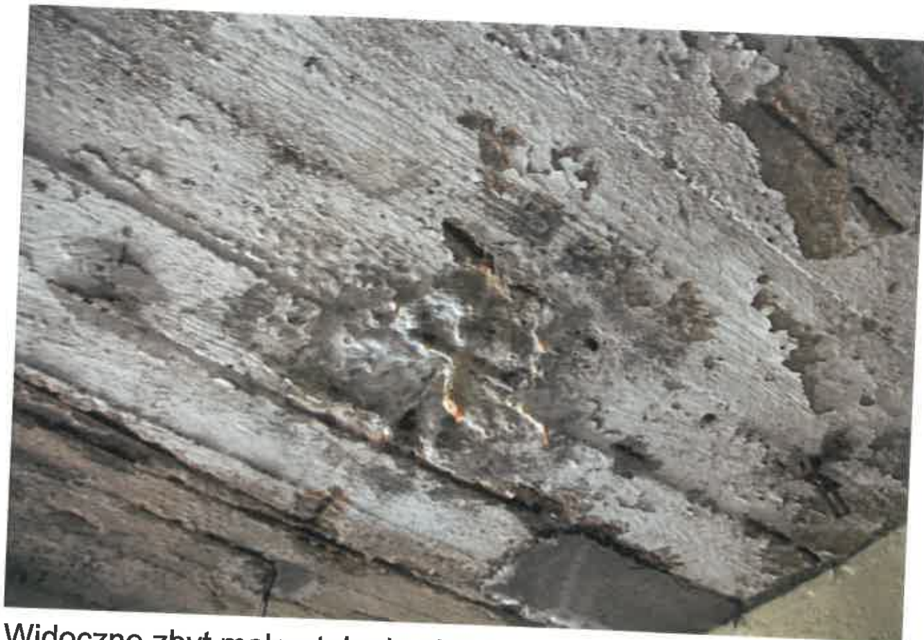
Widoczne zbrojenie belki
