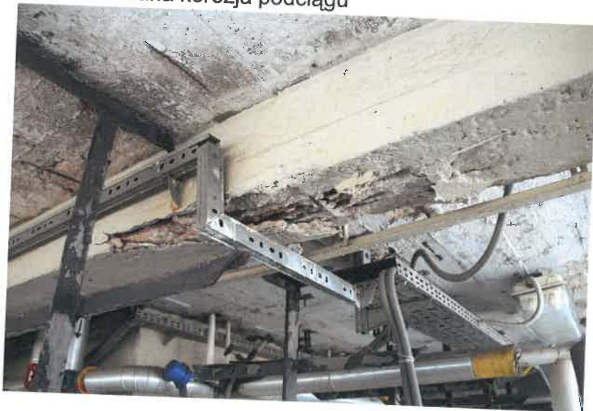
Zaawansowana korozja podciagu
