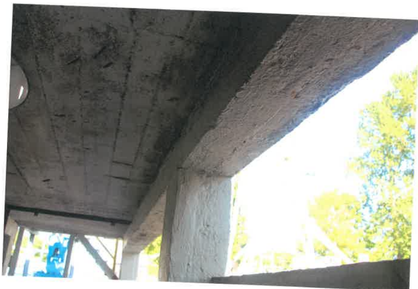
Widoczne zbyt małe otulenie zbrojenia
