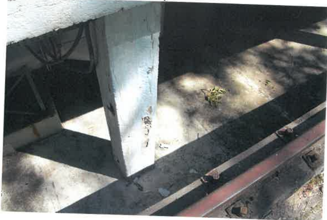
Widoczne uszkodzenia słupów
