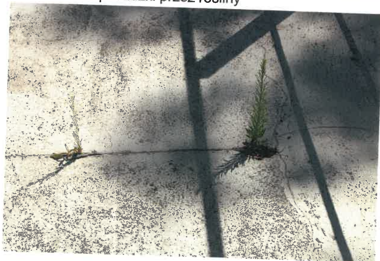
Uszkodzenia posadzki przez rośliny
