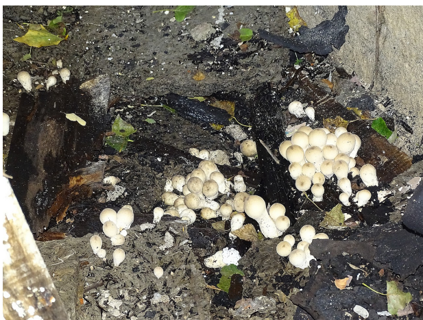
Fot 13 Piętro pom. 08 – intensywne zagrzybienie
