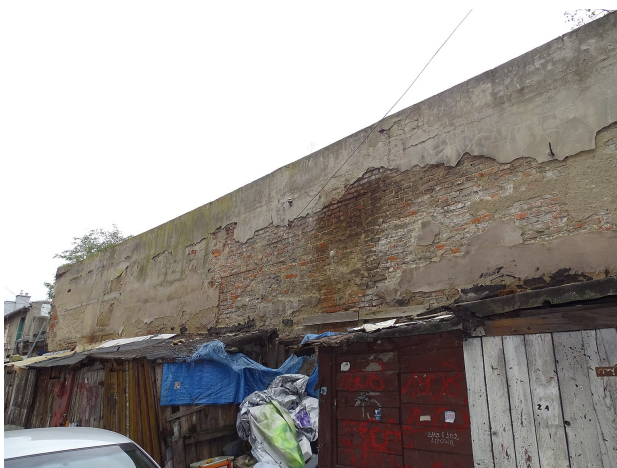
Fot 7 Elewacja południowa – zmurzały mur oraz ubytki wyprawy tynkarskiej
