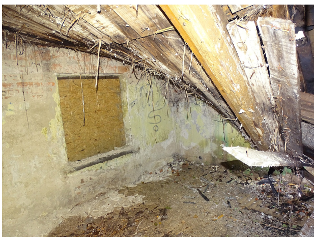
Fot 15 Piętro pom. 08 – zawalony stropodach.
