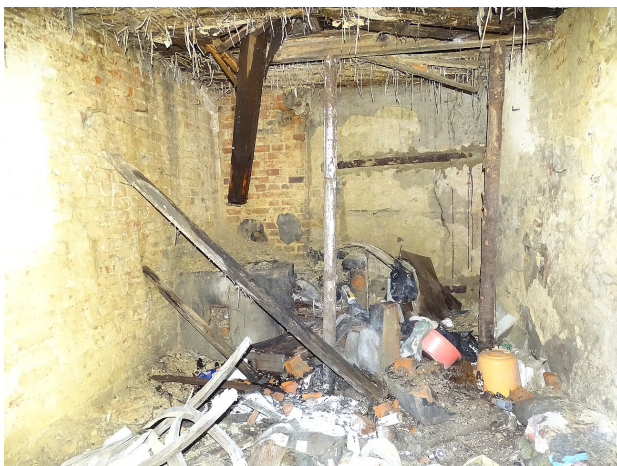
Fot 9 Parter pom. nr 02 – uszkodzony strop
