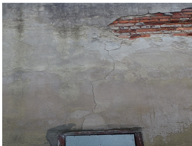
Fot 6 Elewacja wschodnia – rysa pionowa
