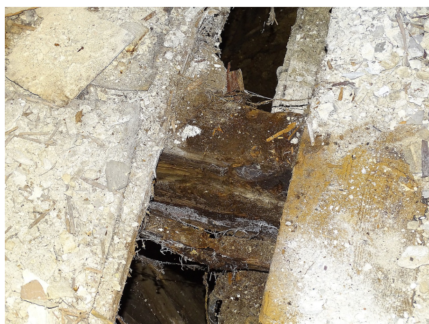
Fot 12 Odkrywka stropu piętro pom. 08 – zmurzała zagrzybiona końcówka belki stropowej.
