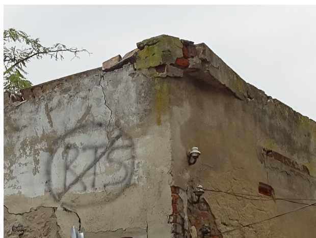
Fot 8 Narożnik południowo-zachodni – uszkodzony odspojony ogniomur i rysa pionowa.
