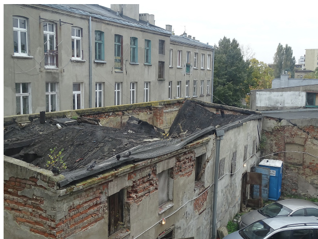
Fot 18 Widok-zawalony stropodach
