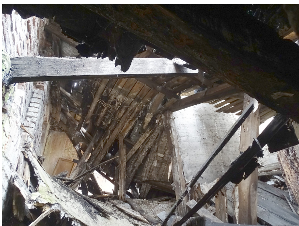
Fot 17 Zawalisko-stropodach i strop w fragmencie „ABCD A
