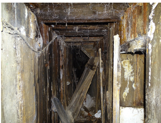
Fot 11 Parter pom. nr 04 – korozja drewna, intensywne zagrzybienie
