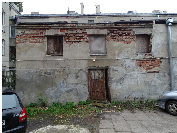
Fot 2 Elewacja północna – ubytki i wykruszenie cegieł
