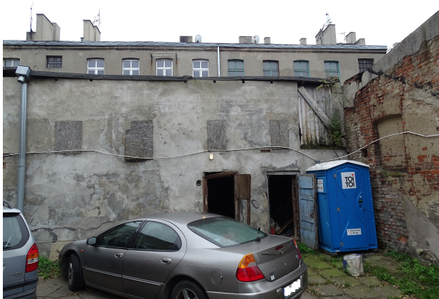
Fot 3 Elewacja północna – zawilgocenie muru.
