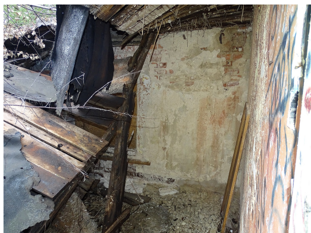
Fot 16 Piętro pom. 07 – zawalony stropodach.
