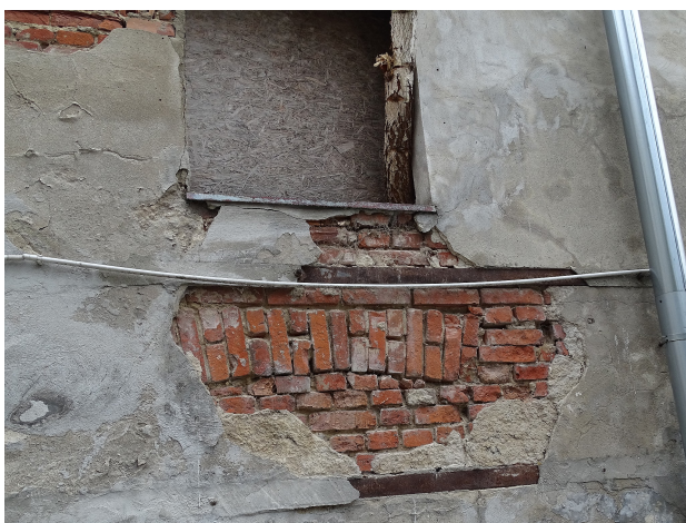
Fot 5 Elewacja północna – ubytki i wykruszenie cegieł
