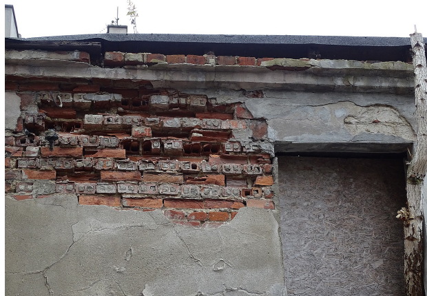
Fot 4 Elewacja północna – ubytki i wykruszenie cegieł
