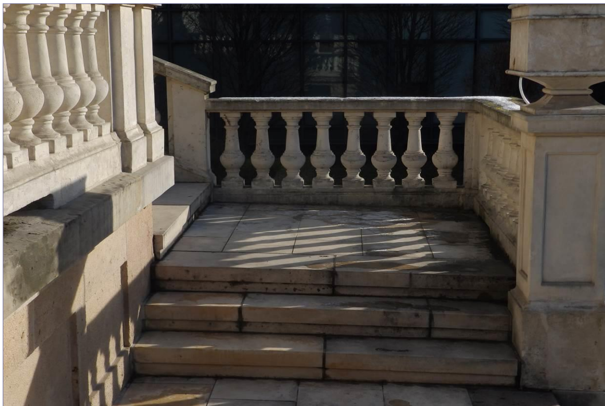
schody z prawej strony (widok na wschód) - zabrudzony kamień; mocno widoczne zawilgocone z korozją biologiczną spoinowanie
