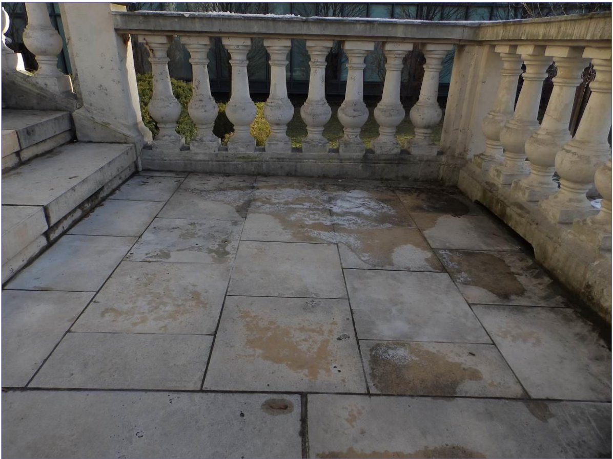
brak hydrofobizacji- zawilgocenie i korozja biologiczna; kumulacja pod stopnicami; uszkodzenia spoin – braki i wykruszenia; drobne niteczkowate spękania płyt
