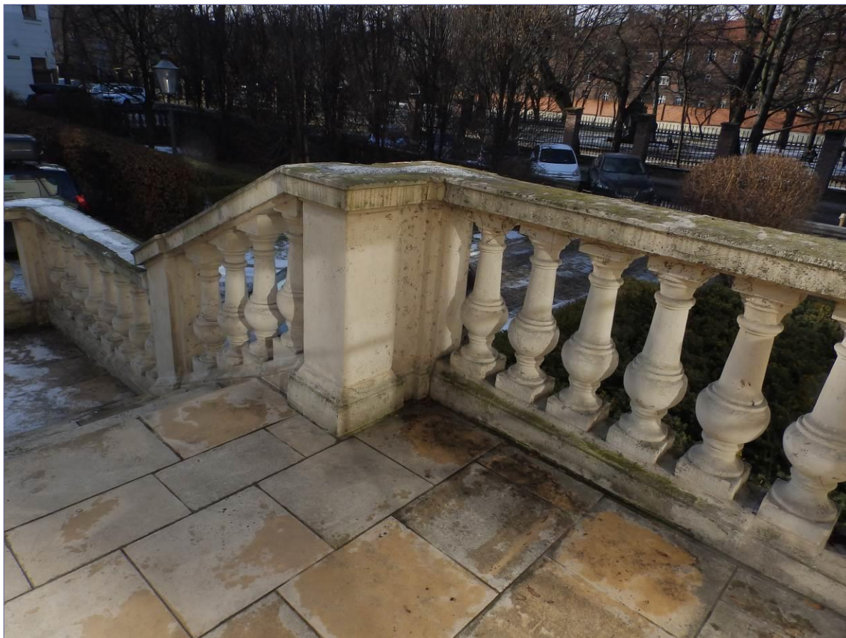
zejście z tarasu od wschodu, korozja biologiczna na postumentach balustradach i podstawach pod tralkami, oraz na parapetach
