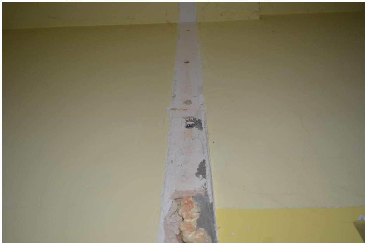
Fot. 38 Ślad po usuniętych, wtórnych ścianach działowych. (fot. K. J.)
