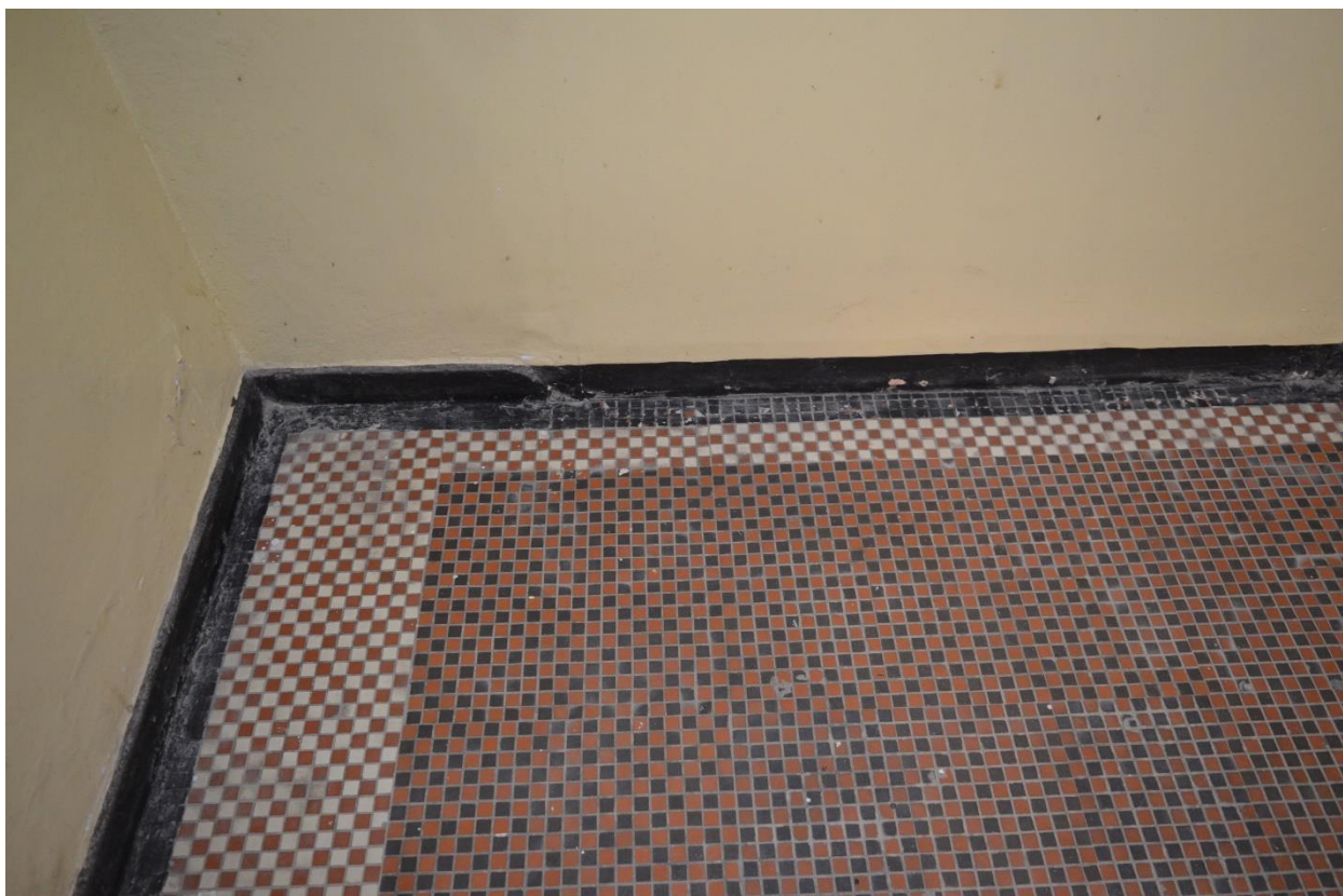
Fot. 5 Zachowany fragment mozaikowej posadzki ceramicznej w pomieszczeniu bocznym holu przy windzie. (fot. K.J.)
