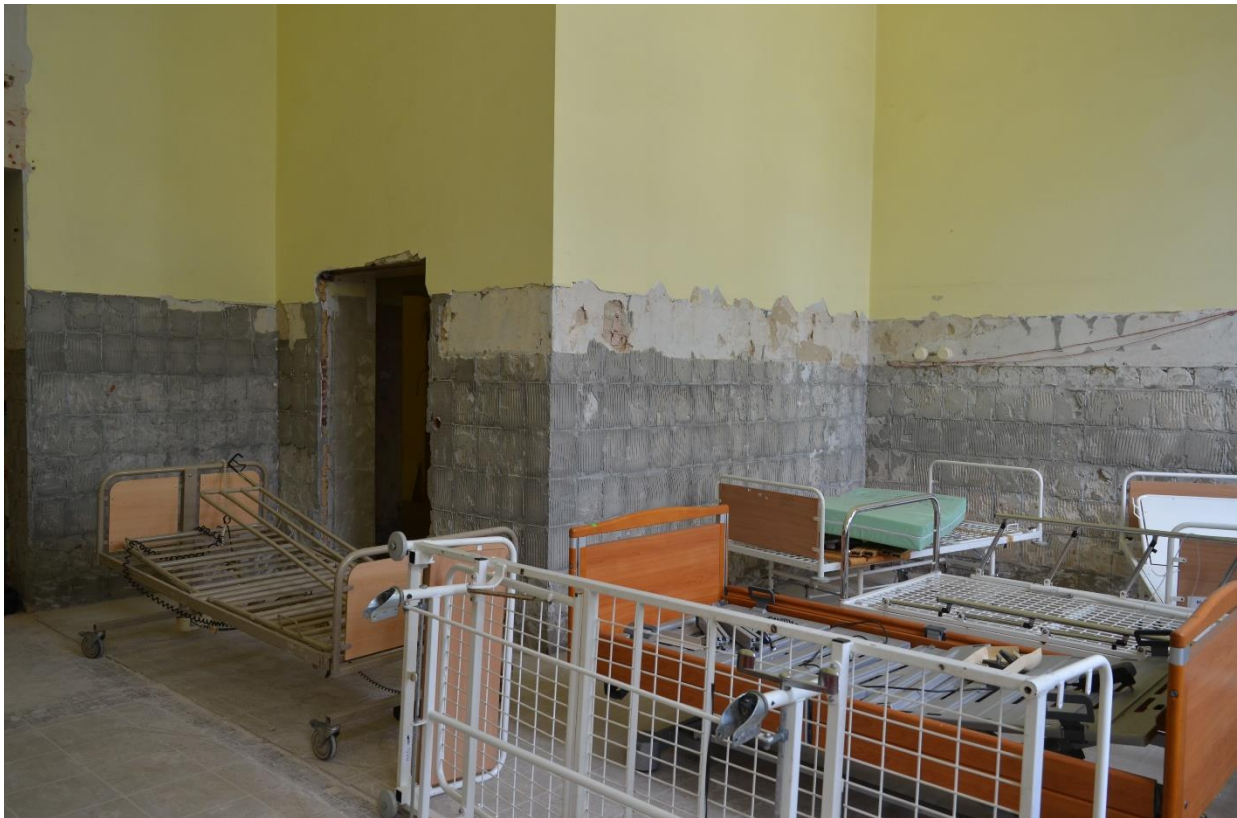
Fot. 30 Widok na jedną ze ścian dawnej kuchni. Widać ślady kleju po skutych płytkach. (fot. K.J.)
