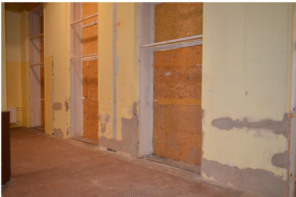
Fot. 9 Widok na ściany wewnętrzne holu oraz otwory drzwiowe i okienne po ściągnięciu historycznej stolarki poddanej pracom konserwatorsko-restauratorskim. (fot. K.J.)
