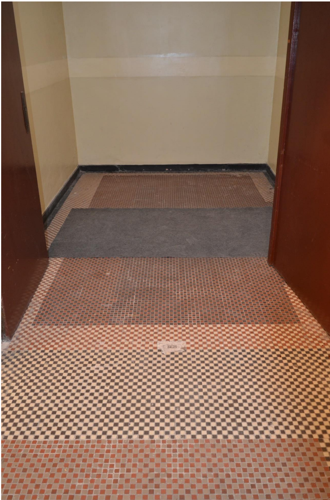
Fot. 18 Zachowany fragment przedwojennego układu posadzki w pomieszczeniu przy windzie w holu. (fot. K.J.)
