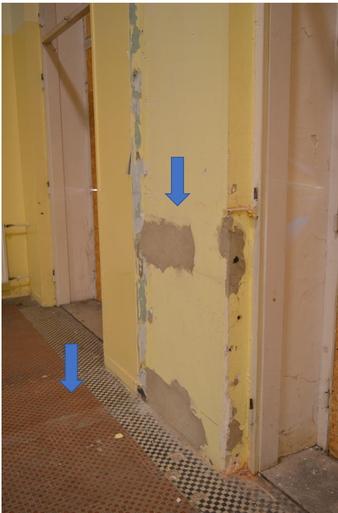
Fot. 10 Widok na wtórne uzupełnienia zaprawy jednej ze ścian. Widoczne spiętrzenie posadzki (fot. K.J.)
