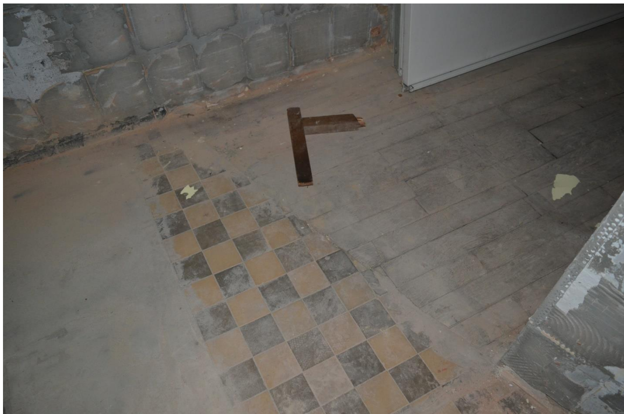
Fot. 40 Wtórnie przełożone, oryginalne, dębowe klepki parkietu na styku z być może historycznymi płytkami z czasu powstania obiektu. (fot. K.J.)
