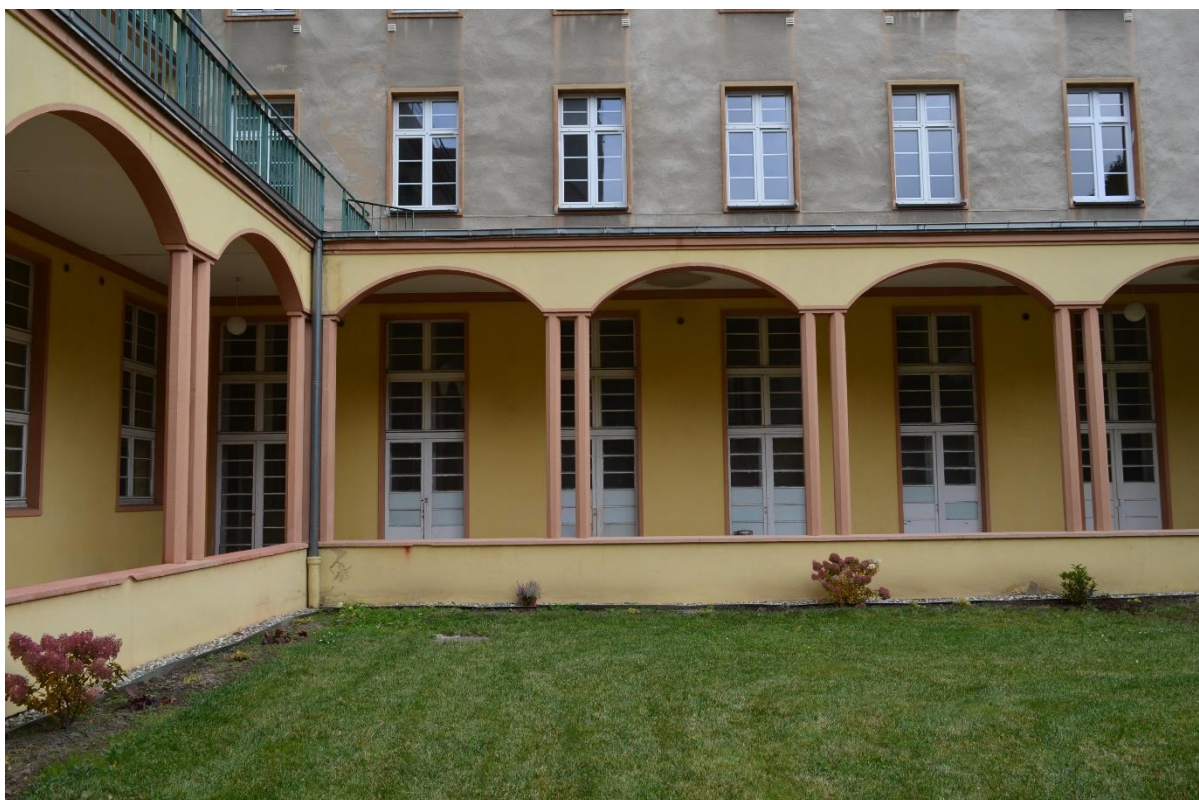
Fot. 8 Widok na stolarkę drzwiową i okienną od strony krużganków. (fot. K.J.)
