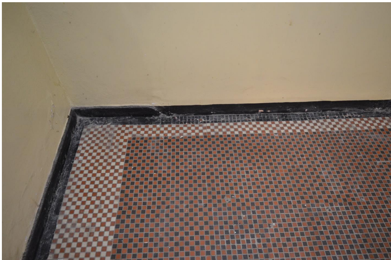
Fot. 19 Zbliżenie na fragment zachowanej posadzki w rogu pomieszczenia przy windzie. Widoczny układ kolorystyczny kostek oraz przemalowany na czarno fragment posadzki. (fot. K.J.)
