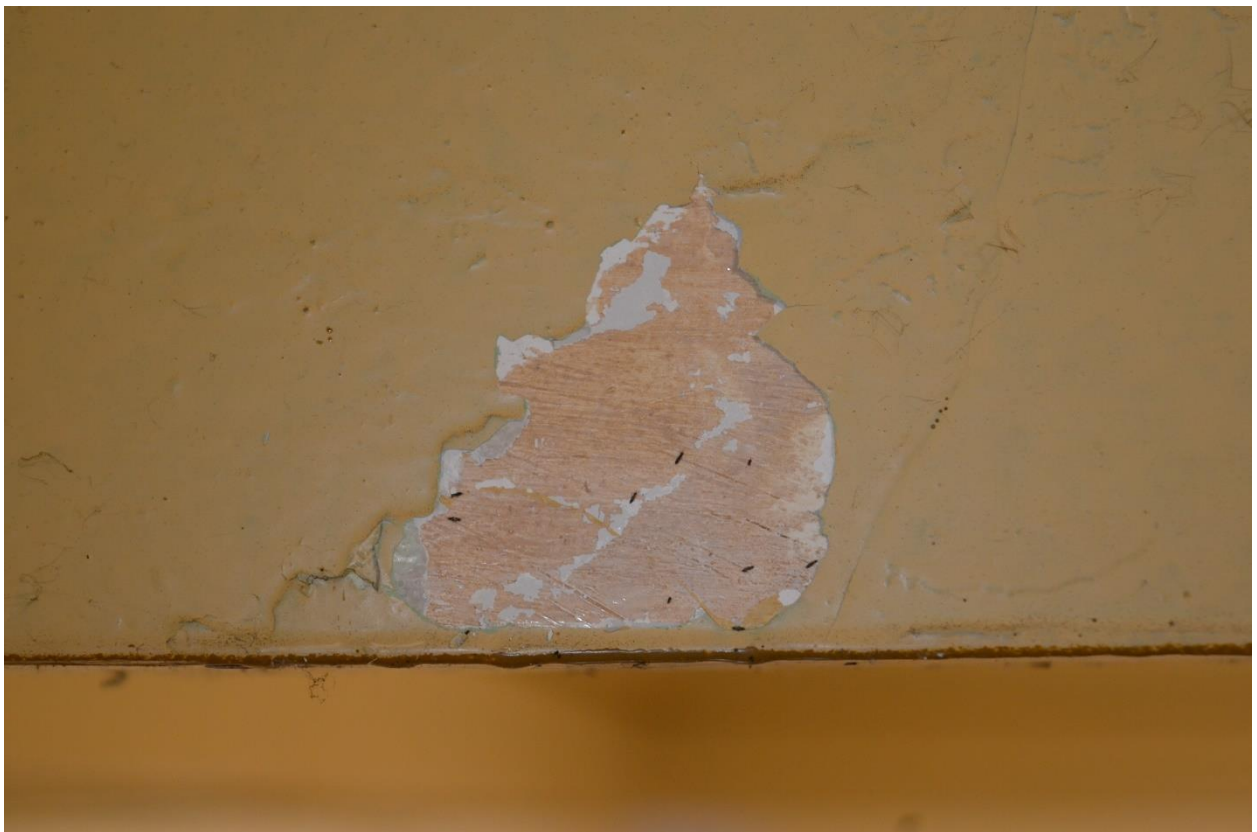
Fot. 54 Odkrywka sondażowa z widoczną warstwą malarską w formie mazerunku(?). (fot. K.J.)
