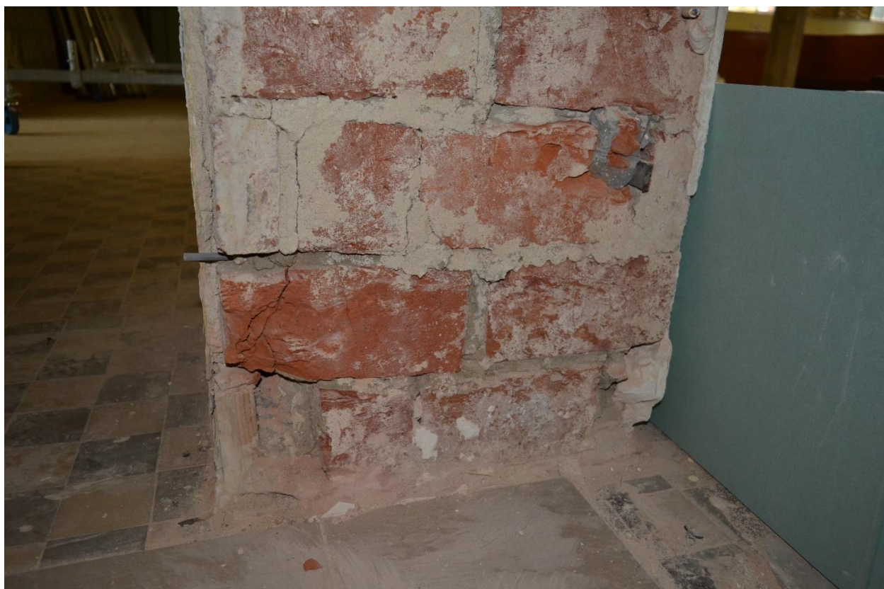
Fot. 41 Jeden z filarów korytarza - pozbawiony warstwy tynku. (fot. K.J.)
