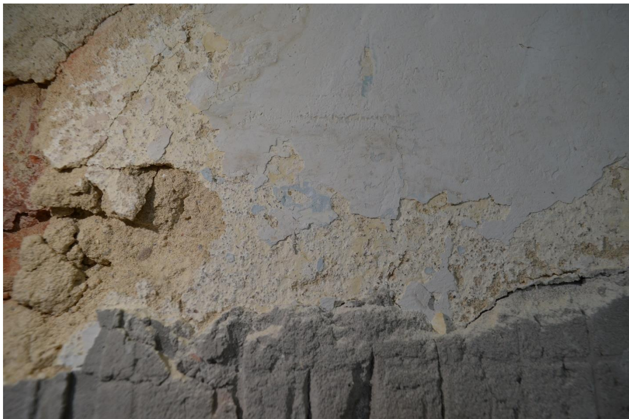
Fot. 37 Fragment odsłoniętego, oryginalnego tynku wapienno-piaskowego z warstwą pobiałą i pierwotnej – jasnożółtej warstwy malarskiej. (fot. K.J.)
