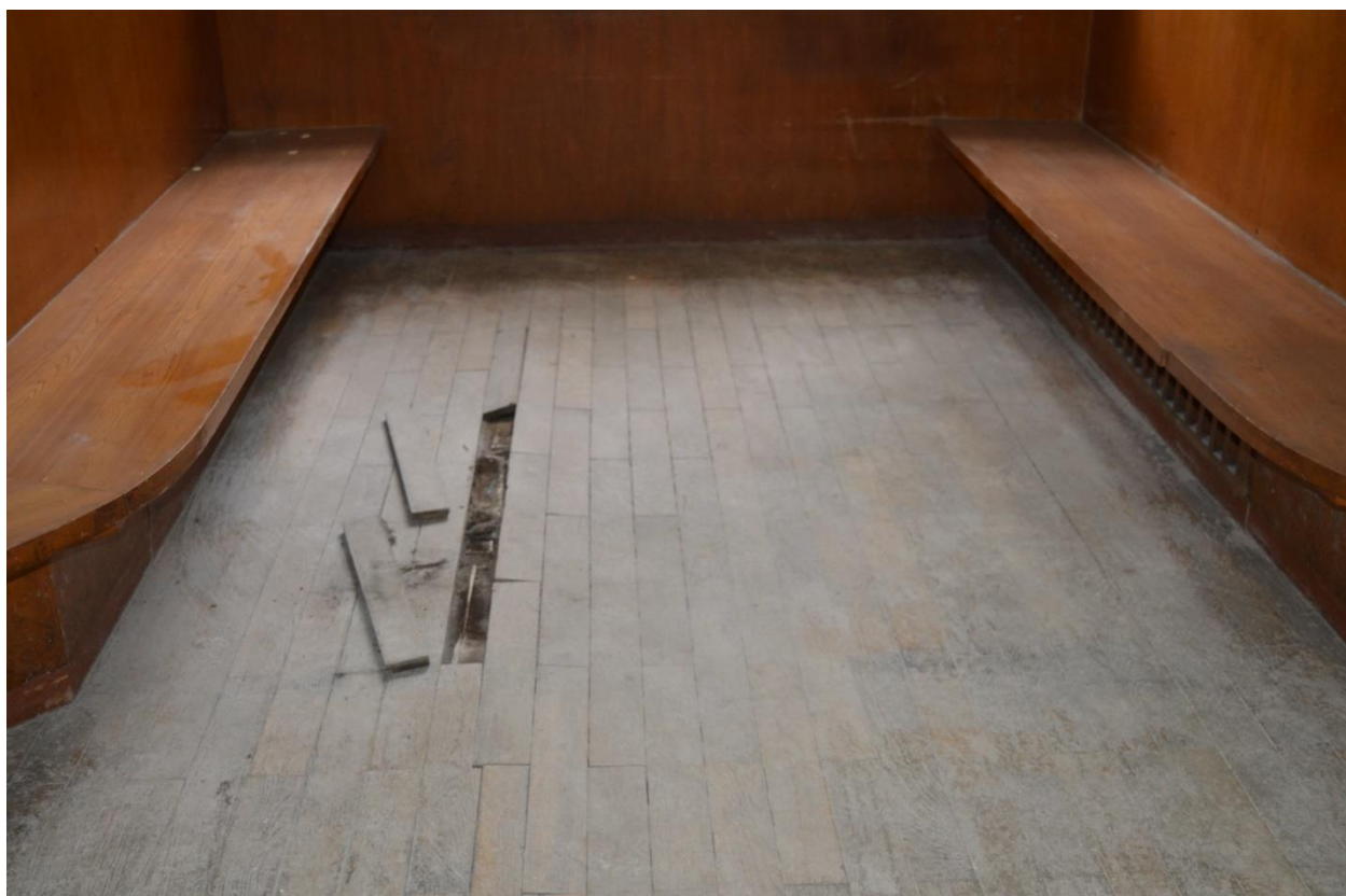
Fot. 44 Fragment parkietu z wyciągniętymi dębowymi klepkami. (fot. K.J.)
