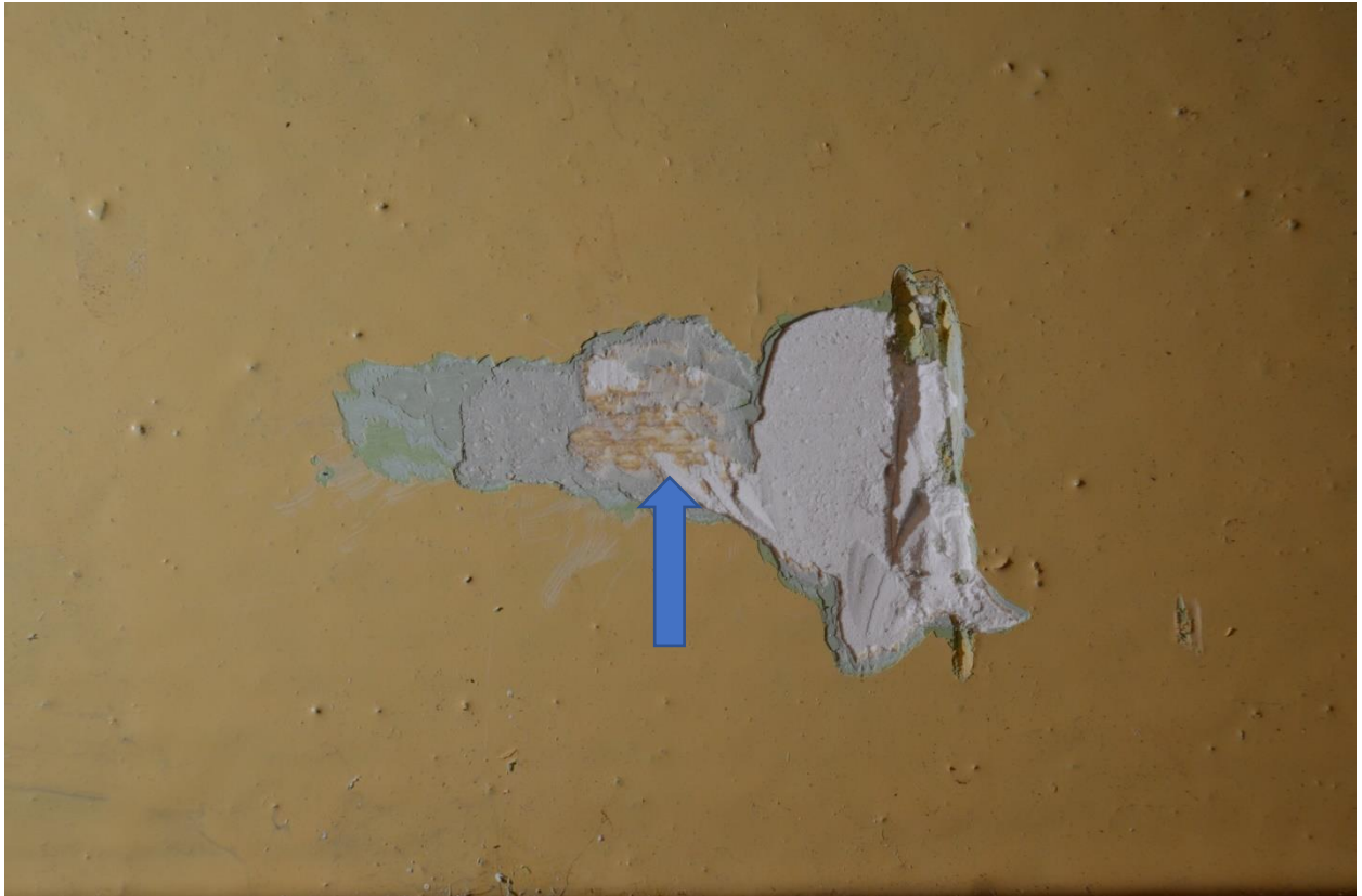
Fot. 53 Niebieska strzałka wskazuje warstwę mazerunku? na jednym z elementów kasetonu. (fot. K.J.)
