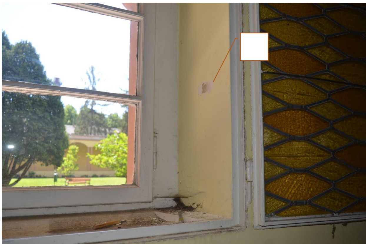
Fot. 70 Wskazanie miejsca wykonania schodkowej odkrywki sondażowej w ościeżu okiennym. (fot. K.J.)
