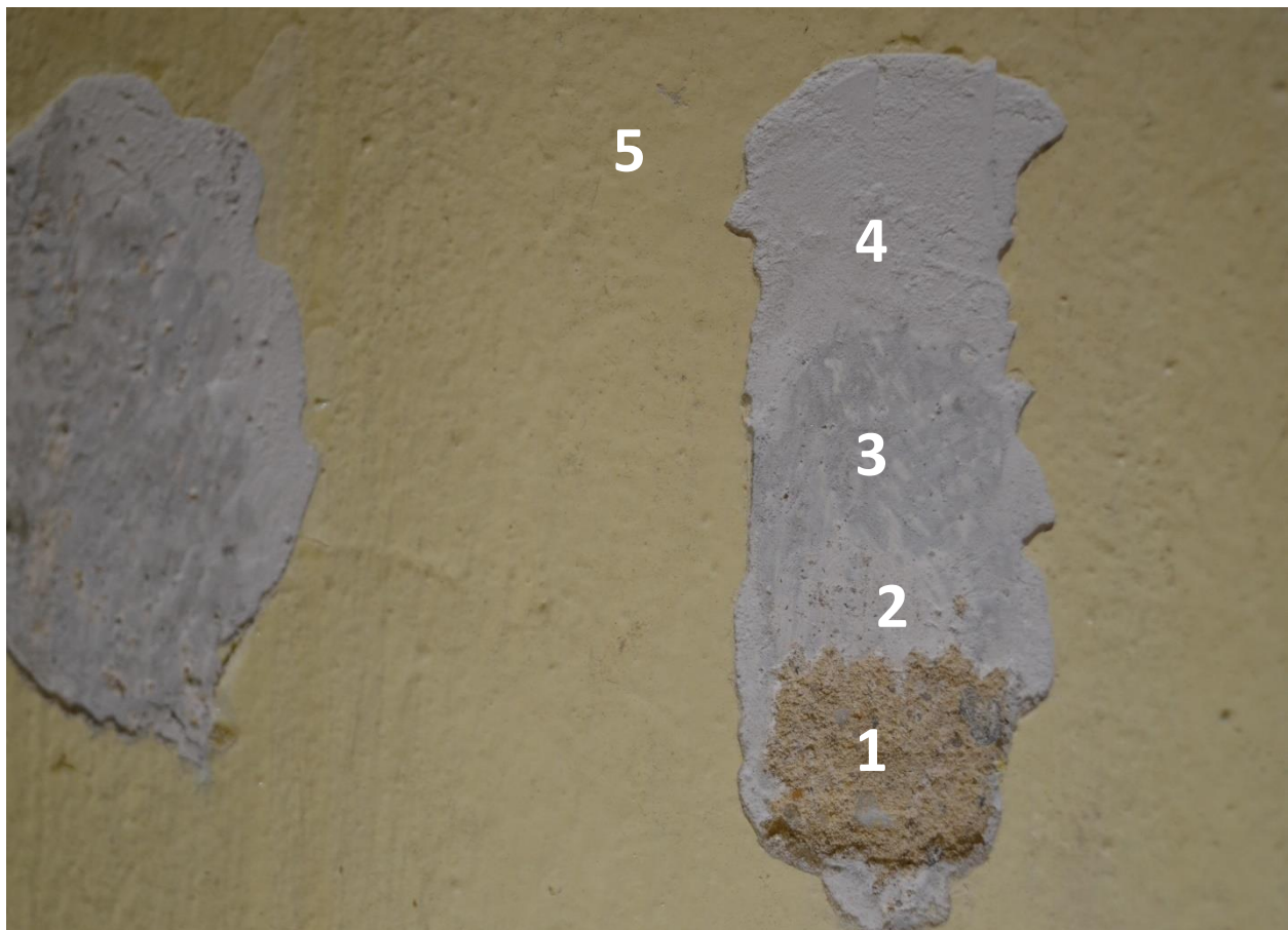
Fot. 49 Odkrywka schodkowa na ścianie za kaloryferem: 1 - zaprawa wapienno-piaskowa, 2 – pobialka wapienna, 3 – pierwotna, szaroblękita warstwa malarska, 4 – biała warstwa szpachli, 5 – żółta warstwa mal.
