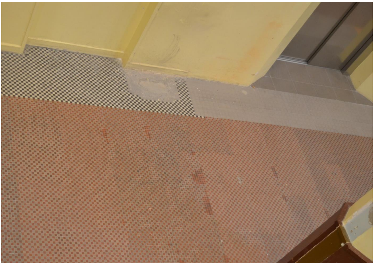
Fot. 58 Mozaikowa posadzka w holu – widok na wtórne uzupełnienia w postaci jasno – i ciemnobieżowych płytek ceramicznych oraz niedobrane kolorystycznie uzupełnienia kostkami oryginalnymi. (fot. K.J.)
