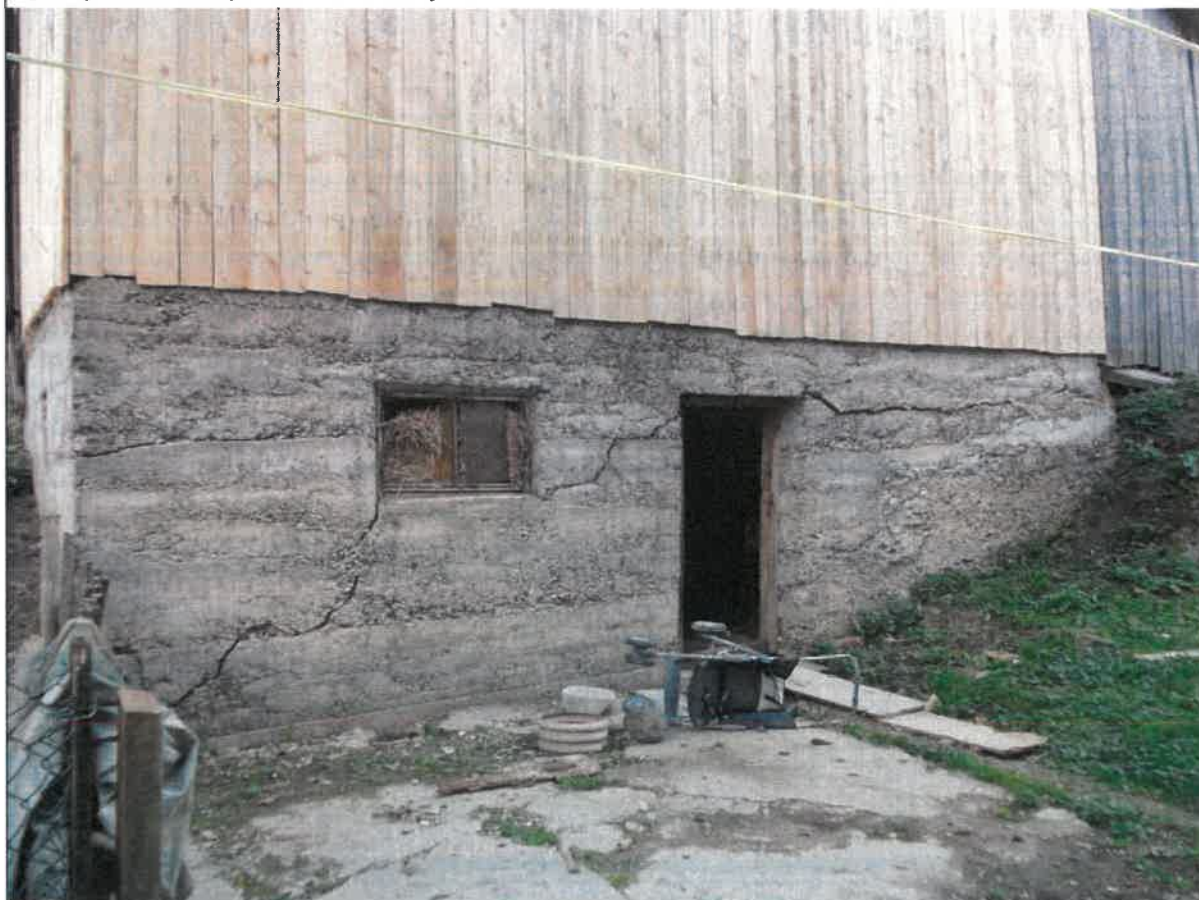
pęknięcia na budynku gospodarczym
