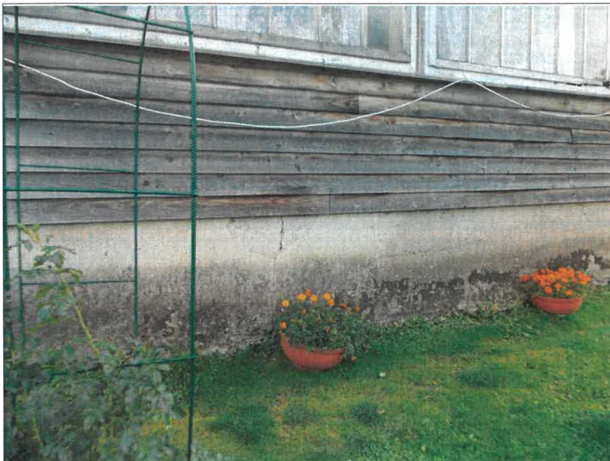
spękana podmurówka w budynku mieszkalnym
