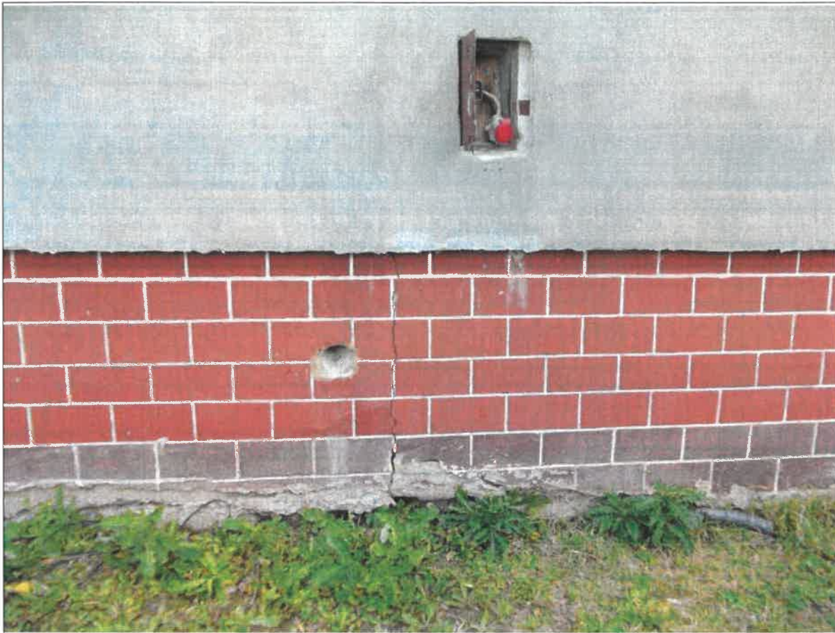
pęknięcia na budynku mieszkalnym
