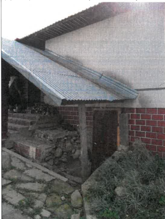
pęknięcia na budynku mieszkalnym
