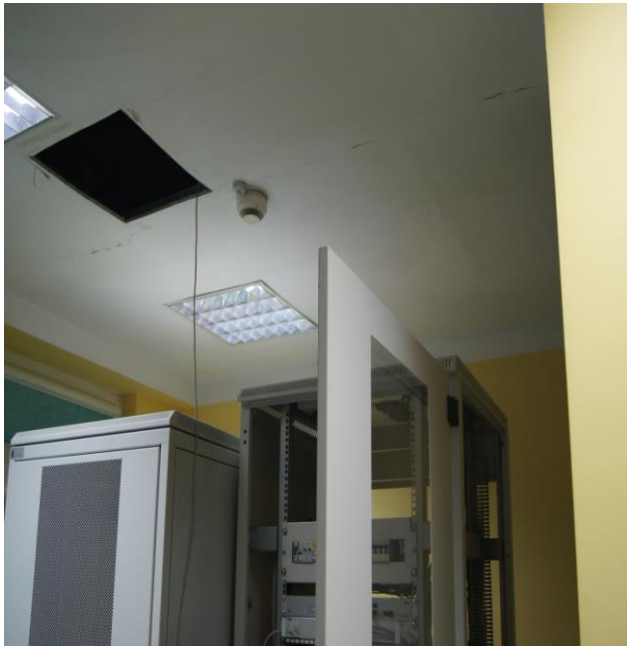
Zawilgocony i zdeformowany strop podwieszony.
