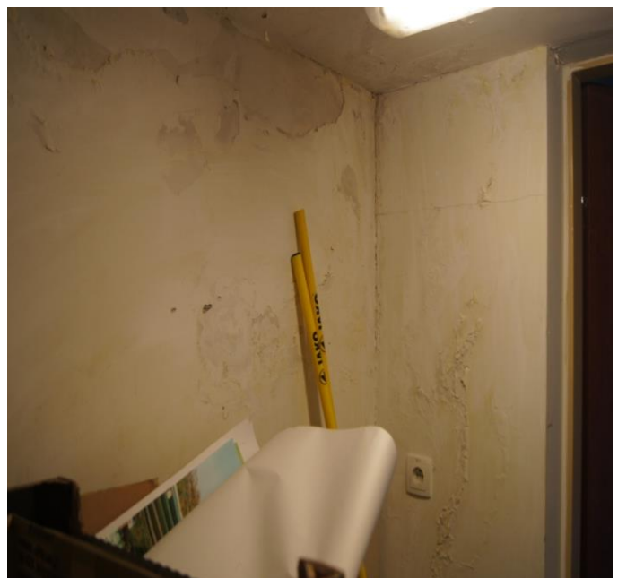
Zawilgocenie ściany zewnętrznej w sąsiedztwie schodów zewnętrznych.
