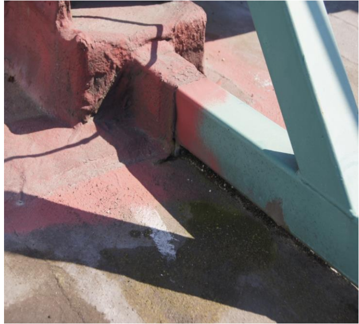
Możliwa penetracja wody pod konstrukcją stalową trybun.
