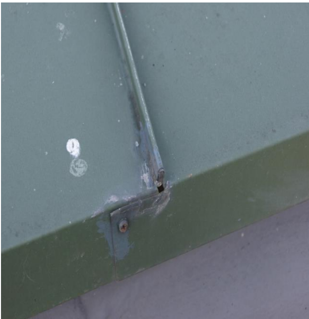
Wadliwie wykonana obróbka blacharska.
