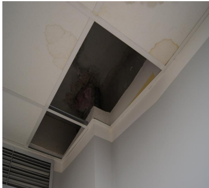
Zawilgocenie stropu i systemowego sufitu podwieszony.
