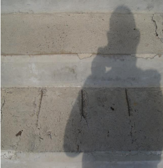
Brak otuliny prętów zbrojenia konstrukcji trybun
