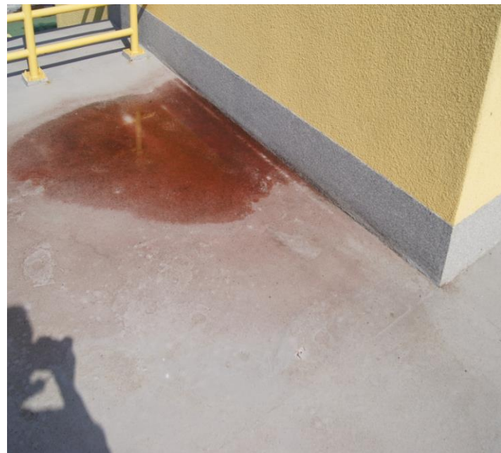
Widoczne zastoiny wody i zarysowania na naprawianej części trybun folią uszczelniającą.
