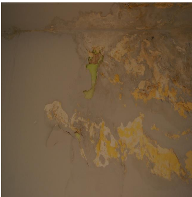
Zawilgocenie ściany zewnętrznej w sąsiedztwie muru oporowego.
