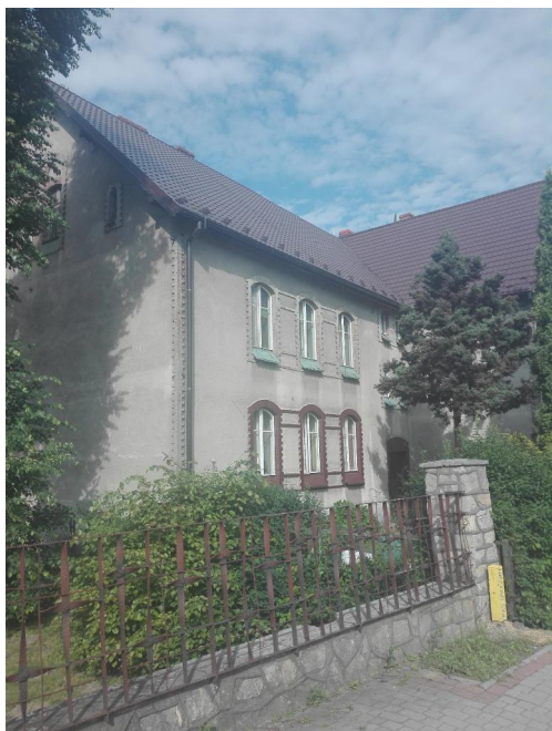
Fot.3 Fragment elewacji północno-wschodniej
