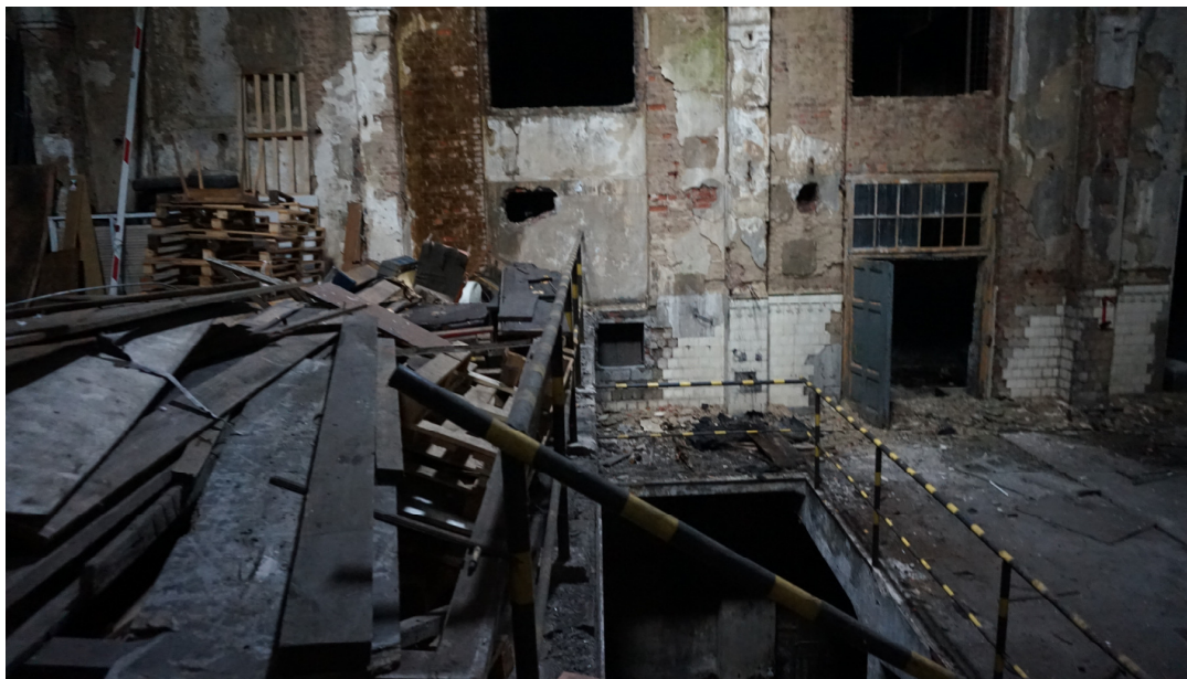
Fot.3 Sytuacja pod uszkodzeniem nr 1.
