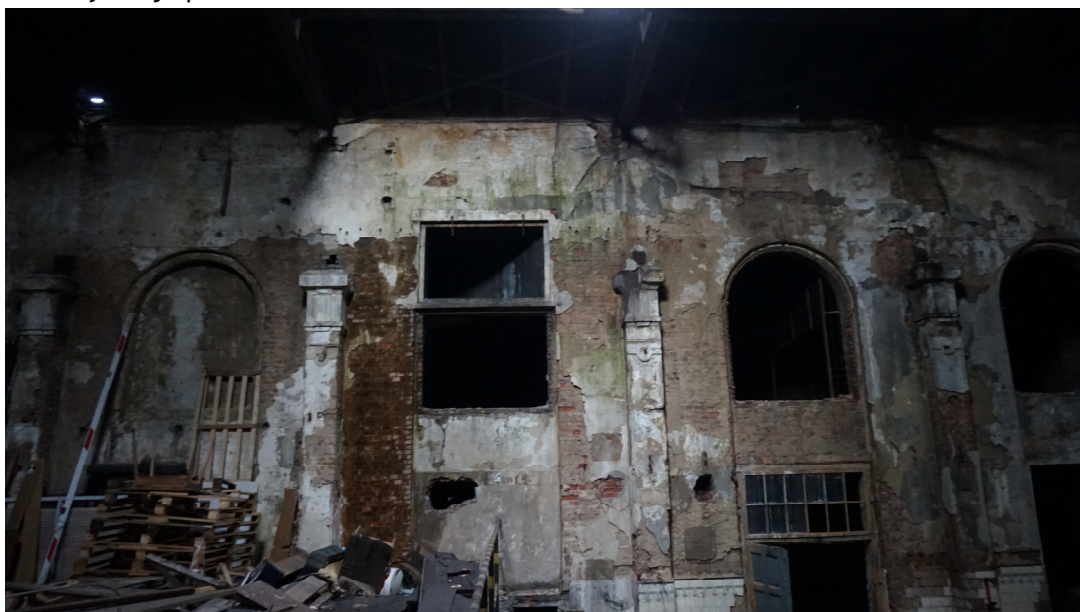
Fot.2 Sytuacja pod uszkodzeniem nr 1.
