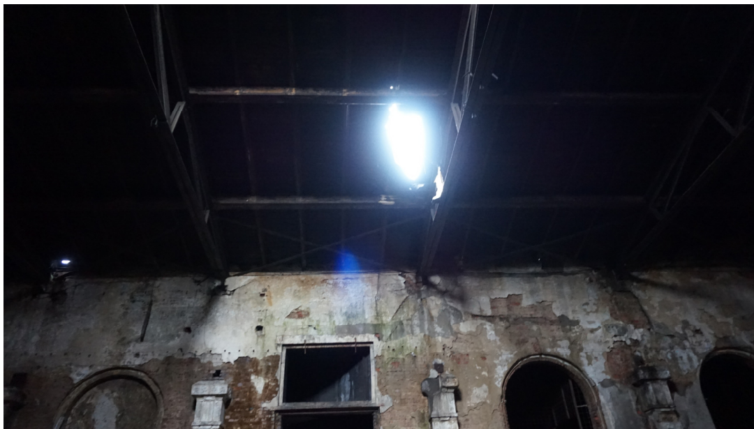
Fot.1 Sytuacja pod uszkodzeniem nr 1.
