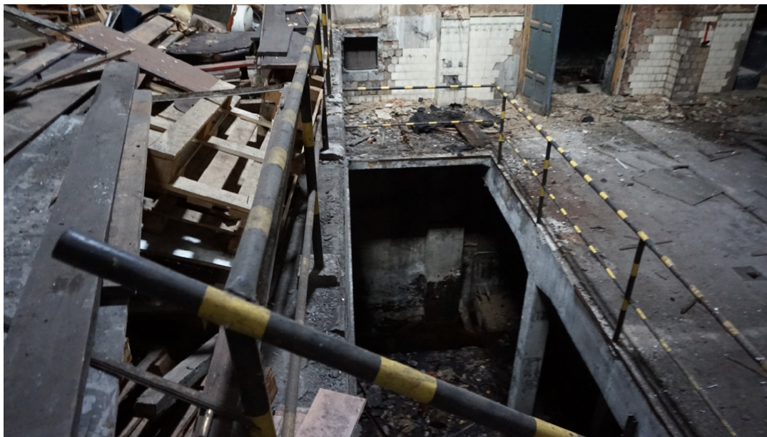
Fot.4 Sytuacja pod uszkodzeniem nr 1 / W miejscu gdzie znajduje się otwór poziom posadzki obniżony jest o kolejne ok 5m/
