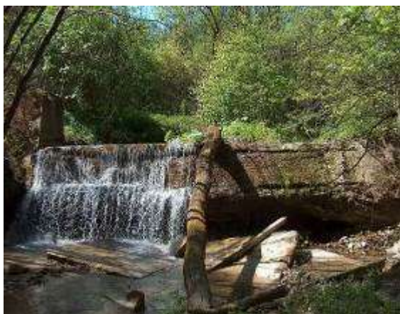
Zniszczony betonowy jaz przerywający ciągłość biologiczną cieku przed przebudową
