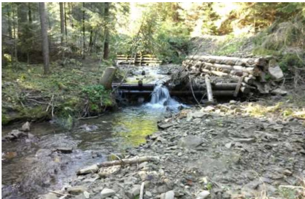
Podmyty próg w rok po wybudowaniu. Brak zamknięcia niecki wypadowej stabilizującego dno. Źródło. Archiwum fotograficzne CKPŚ.
