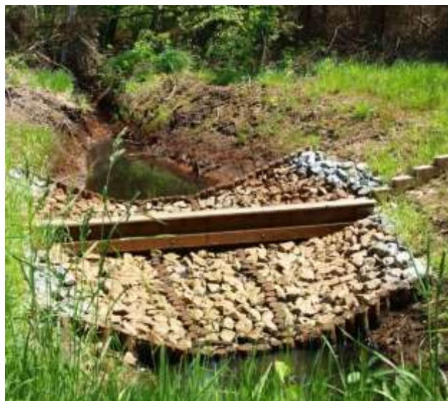
Dobrze ubezpieczony próg z pojedynczej ścianki szczelnej. Fot. Z. Filipek. Źródło: Archiwum CKPŚ.
