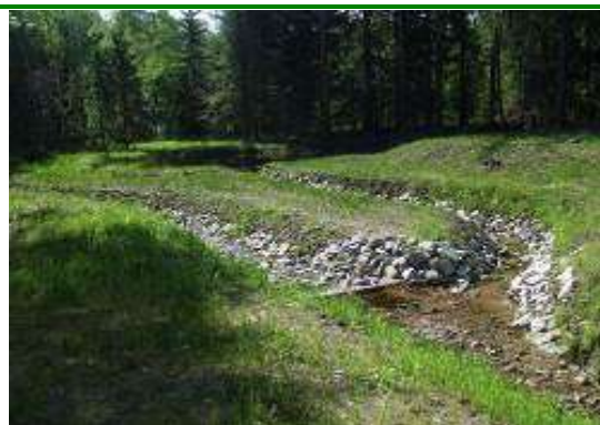
Podział wody na ciek główny – dolot do zbiorników bocznych w N-ctwie Szklarska Poręba. Zródło: Archiwum CKPŚ.
