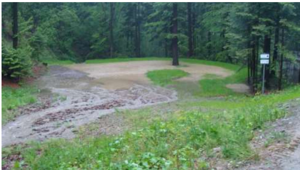
Zbiornik retencyjny na płytę powierzchniową zaraz po wybudowaniu, dodatkowo zasilany wodą spływającą z leśnej drogi – Nadleśnictwo Piwniczna. Źródło: zasoby własne Nadleśnictwa Piwniczna
