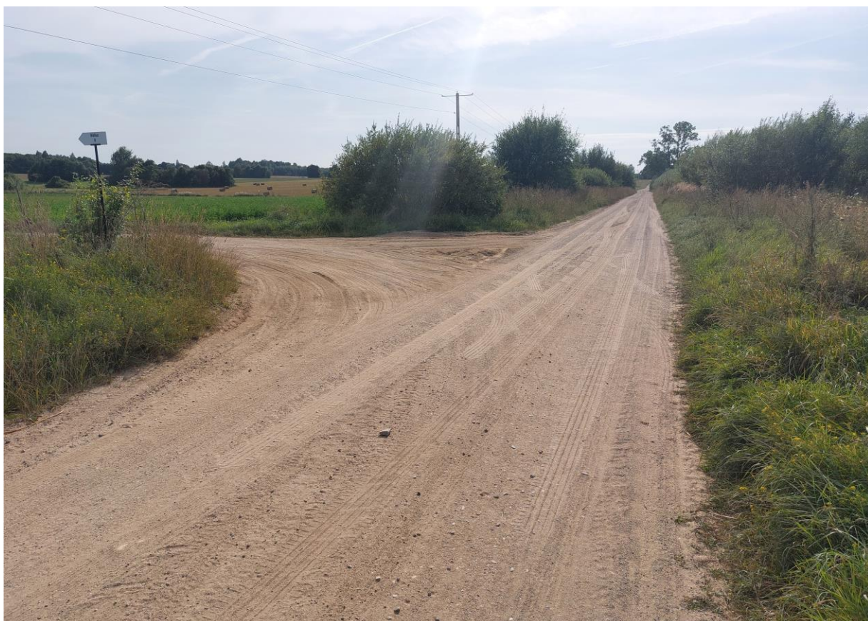
Foto nr 6 Odcinka DG 103601B z widokiem na zakończenie trasy w km 5+800 i skrzyżowanie z drogą dojazdową do siedliska w km 5+770.
