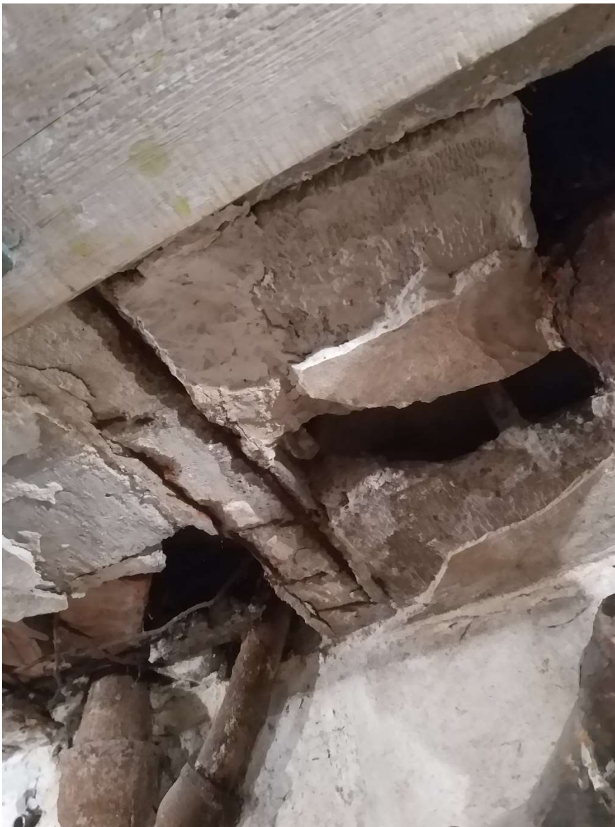
Rys. 1 Widok uszkodzonych elementów stropowych
